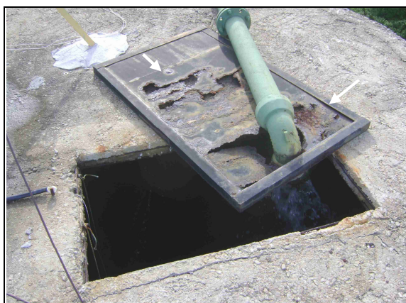
Foto 16 – Tampa do REL-01 deteriorada pela corrosão.
