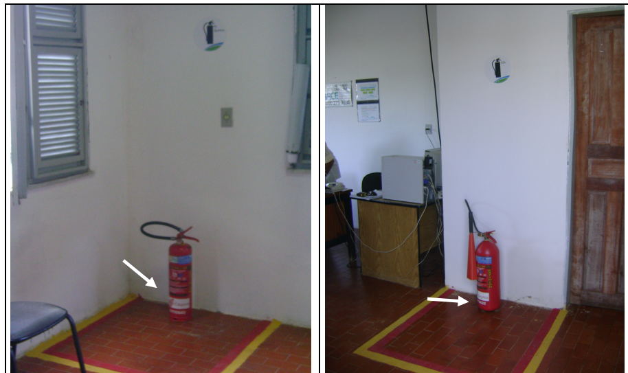
Foto 29 – Extintores de incêndio em local inadequado.
