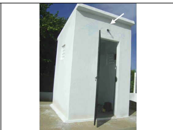
Foto 6 – Iluminação externa instalada do PT-01.
