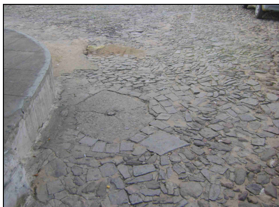
Foto 24 – Registro de manobra localizado na Rua Capitão Francisco Rodrigues.
