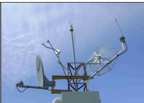
Foto 15 – Ausência de sinalização noturna no REL-01.
