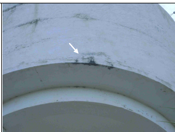
Foto 17 – Vazamento no REL-01.
