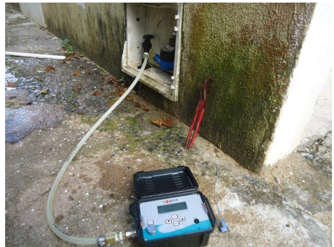
Foto 37 – Medição instantânea de pressão na Rua Rita Belarmino – Escola Valdemar Alcântara.
