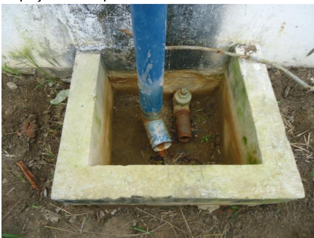
Foto 15 – RAP-07 (Jaburuna): Caixa de descarga de fundo sem grade de proteção.
