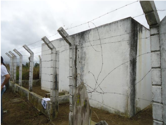
Foto 11 – RAP-07 (Jaburuna): Ausência de identificação e cerca danificada.
