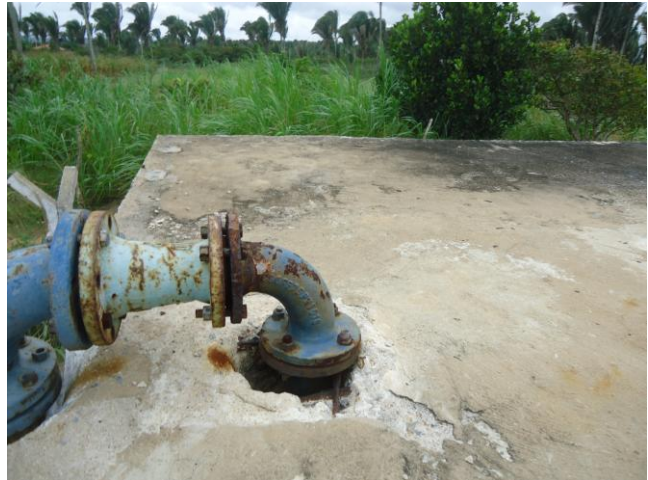
Foto 12 – RAP-07 (Jaburuna): Ausência de tubulação de ventilação e laje de cobertura danificada.
