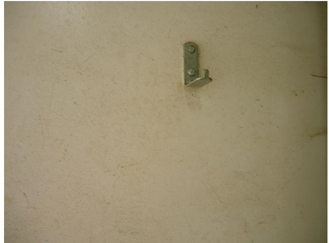
Foto 47 – Almojarifado: ausência de extintor de incêndio.
