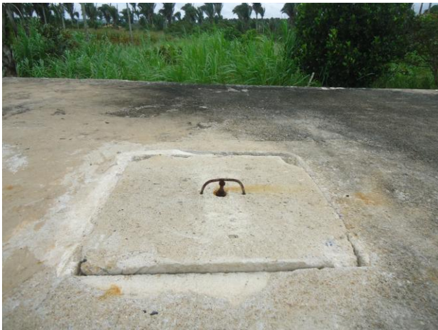
Foto 13 – RAP-07 (Jaburuna): tampa de inspeção inadequada.
