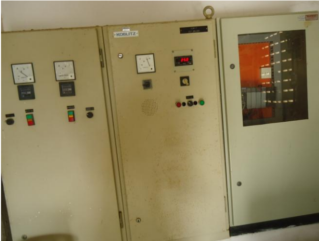
Foto 05 – EEAT-07: quadro de comando.
