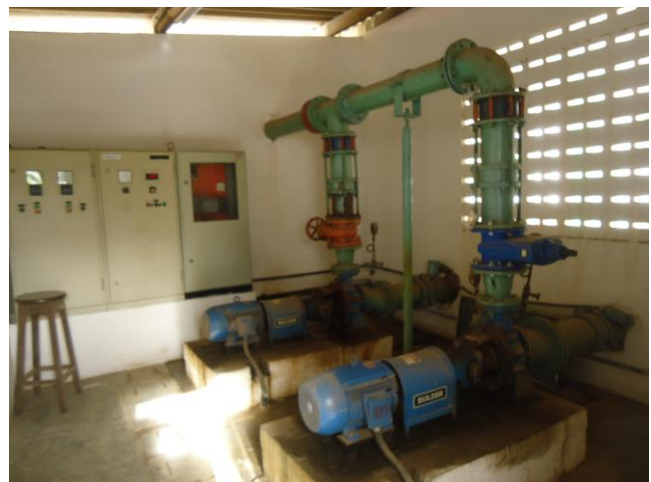
Foto 04 – EEAT-07: conjunto moto-bomba.
