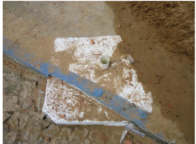
Foto 29 – Rede de distribuição: registro de descarga na Rua Edgar Brito de Macedo(2).
