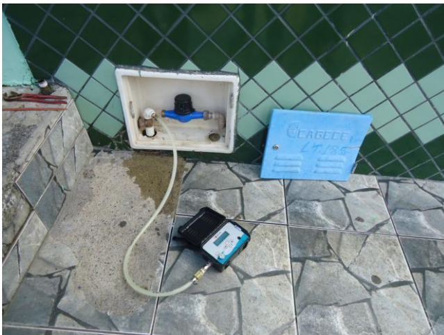
Foto 36 – Medição instantânea de pressão na Rua Prudêncio Furtado, 357 – Centro (Escola)
