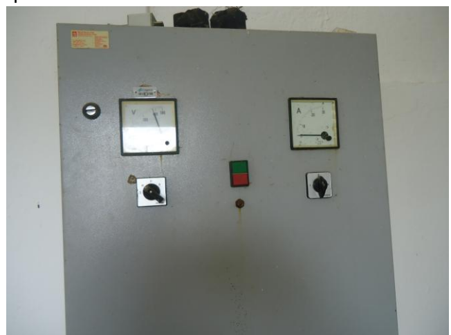
Foto 10 – Booster Jaburuna: quadro de comando.
