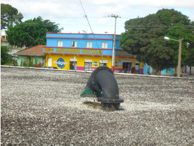
Foto 19 – RAP-08: tubulação de ventilação com tela de proteção.
