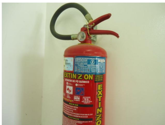
Foto 45 – Loja de Atendimento: extintor de incêndio fora do prazo de validade.
