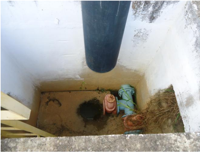
Foto 23 – RAP-08: Caixa de descarga de fundo sem grade de proteção.
