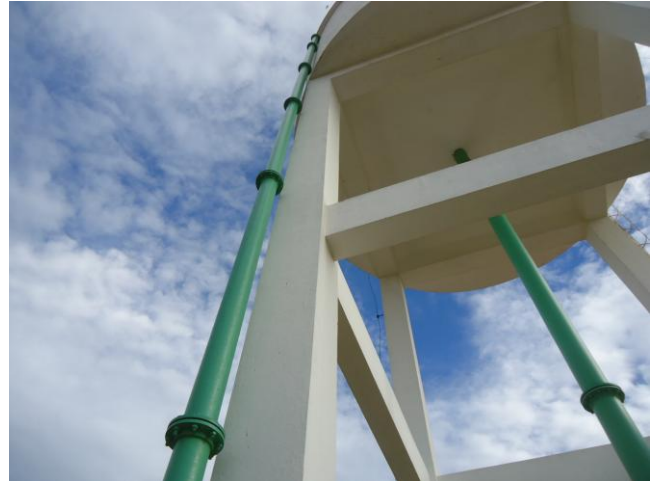
Foto 26 – REL-10: tubulação de entrada de água e tubo extravasador.
