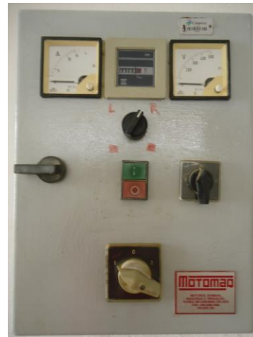
Foto 08 – Booster Sebastião Gomes Parente: quadro de comando.
