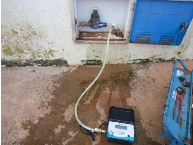
Foto 34 – Medição instantânea de pressão na Rua Cesário Cunha, 219 – N. Sra de Lourdes.
