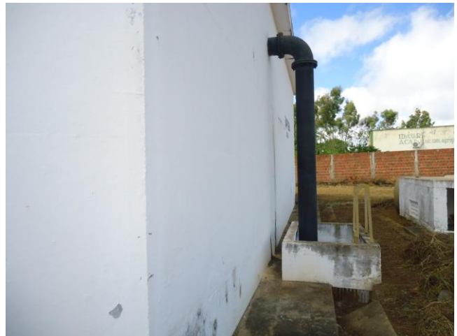
Foto 22 – RAP-08: tubo extravasor.
