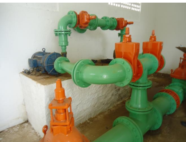
Foto 09 – Booster Jaburuna: ausência de bomba reserva.
