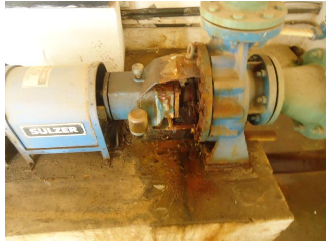
Foto 06 – EEAT-07: Vazamento excessivo na gaxeta.
