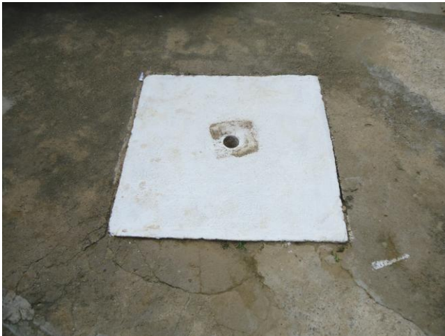
Foto 28 – Rede de distribuição: registro de descarga na Rua Monsenhor Eufrásio Gonçalo(1).
