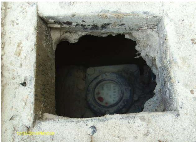
Foto 7 – Macromedidor de água tratada na saída do PT-01.
