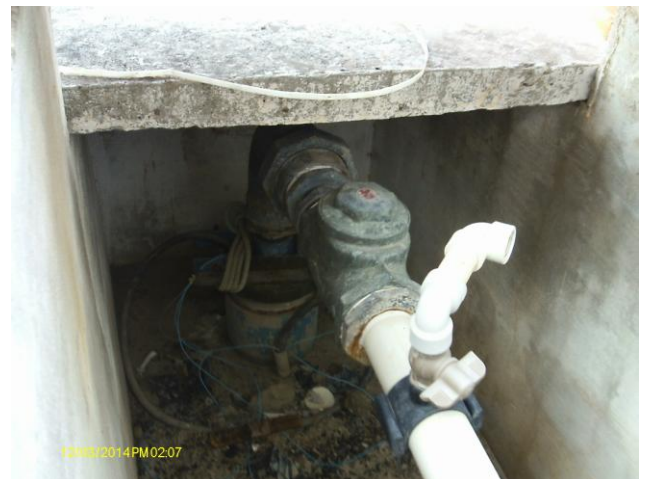
Foto 4 – PT-01: tubulação de recalque.
