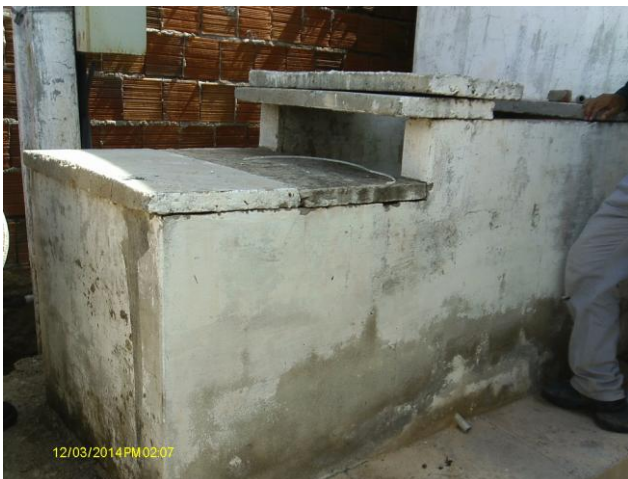
Foto 3 – PT-01: proteção do poço.
