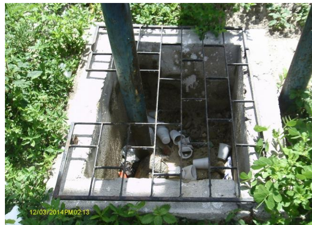
Foto 10 – Caixa de inspeção na área do REL-01, com grade de proteção.
