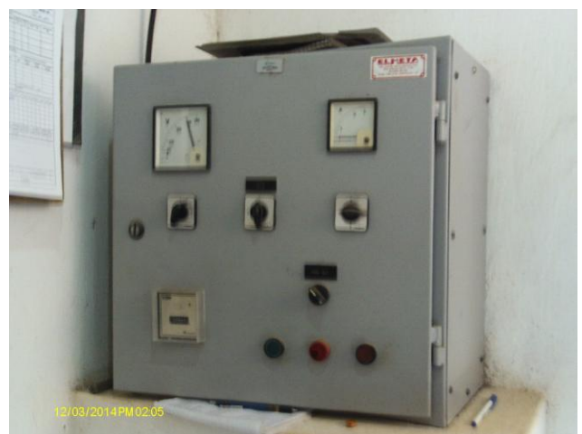
Foto 6 – PT-01: quadro de comando.
