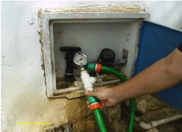
Foto 18 – Medição de pressão na Entrada de Fazendinha, nº 7 (SMS).
