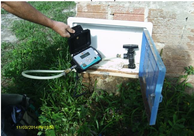
Foto 20 – Medição de pressão com instalação às 16:00h do dia 11/03/14 e retirada às 16:00h do dia 12/03/14, com aparelho datalogger na Rua do Colégio, s/n.
