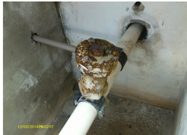
Foto 8 – Ventosa em processo de corrosão.
