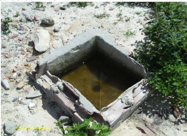
Foto 9 – Caixa de inspeção na área do REL-01, sem grade de proteção.
