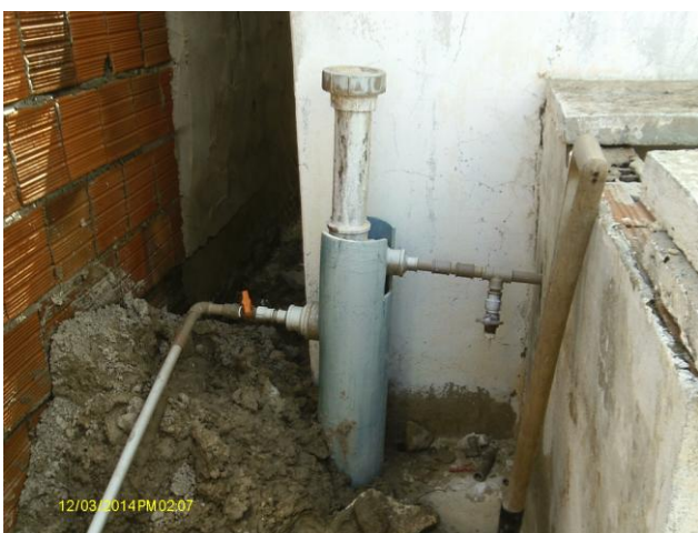
Foto 5 – PT-01: clorador de pastilha.
