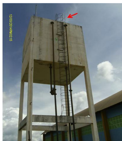
Foto 12 – REL-11: gaiola protetora na escada de acesso.
