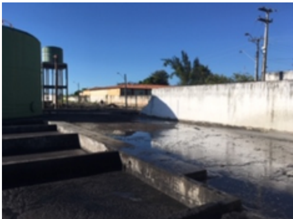
Foto 3 – ETE - Araturi: pátio da ETE inundado de rejeitos e muro danificado.
