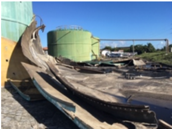
Foto 1 – ETE - Araturi: reator 03 estourado.
