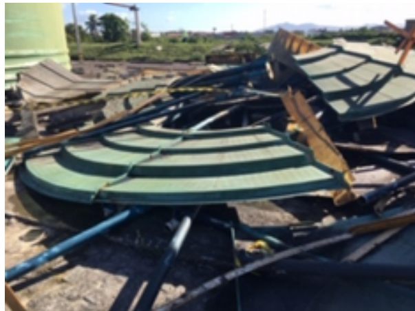
Foto 2 – ETE - Araturi: reator 03 estourado.
