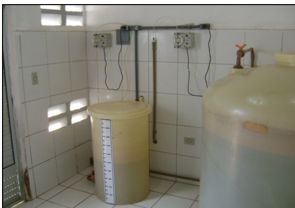
Foto 9 – Dosadores instalados na ETA.
