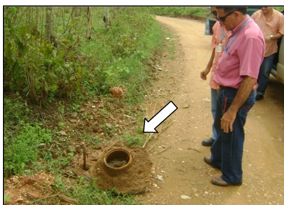
Foto 23 – Registro de descarga da adutora.
