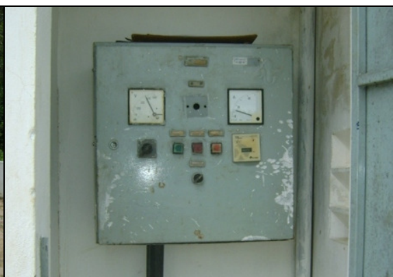
Foto 4 – Quadro de comando do PT-05.
