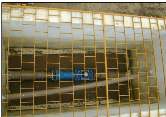
Foto 18 – Macro-medidor instalado na saída do PT-04.
