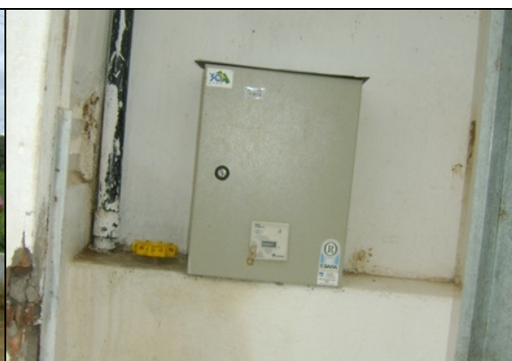
Foto 6 – Quadro de comando do PT-06.
