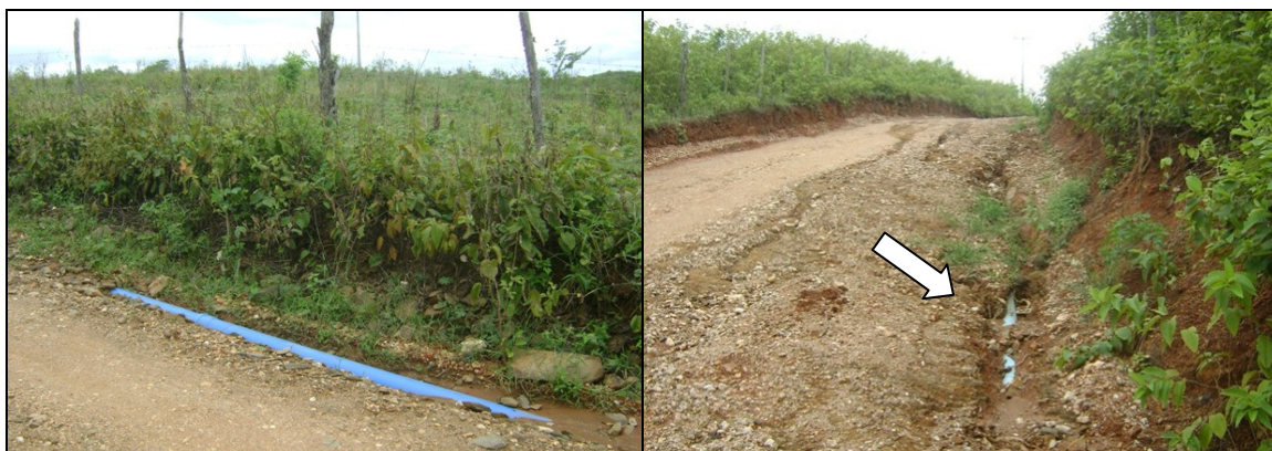
Foto 21 e 22 – Adutora exposta.
