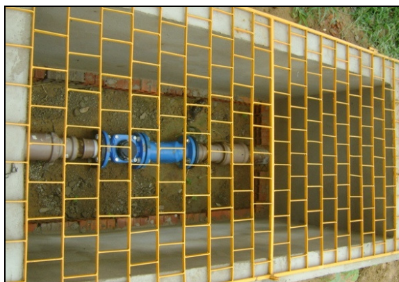
Foto 20 – Macro-medidor instalado na saída do PT-06.
