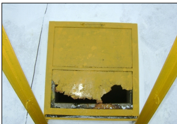
Foto 16 – Tampa do REL-01 oxidada.
