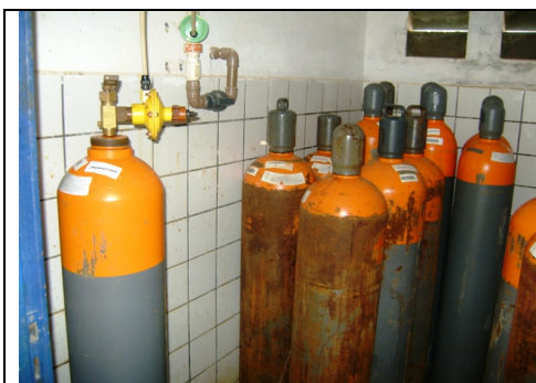
Foto 12 – Cilindros de cloro gasoso
