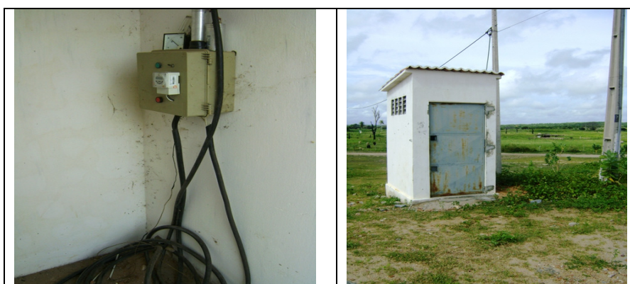
Fotos 22 e 23 – Quadro de comando da EECS-01 e a casa de proteção
