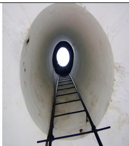
Foto 27 – REL-01 sem tampa
