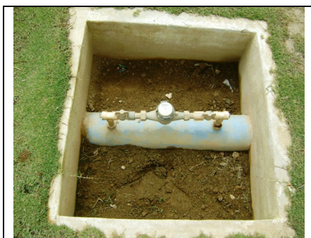
Foto 32 – Medidor proporcional na saída do RAP-01
