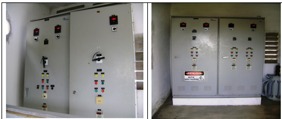
Fotos 24 e 25 – Quadros de comando da EEAT-01 e EELF-01
