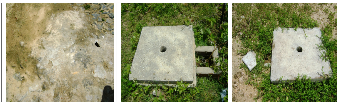
Fotos 35 e 37 – Registros de descarga nas Ruas Dom Luiz, Manoel Castro Filho e SDO (Pq. Vaquejada)
