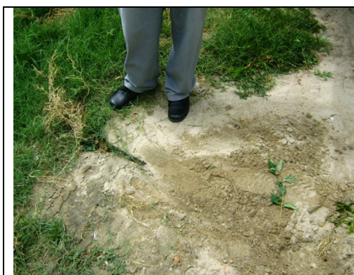
Foto 33 – Adutora de água tratada – registro de descarga soterrado
