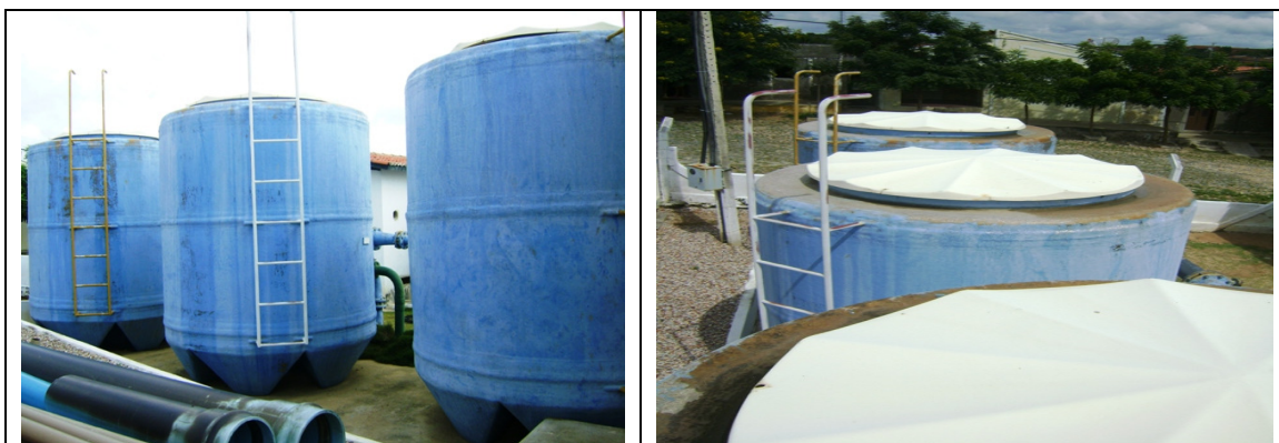
Fotos 5 e 6 – Vistas dos filtros
