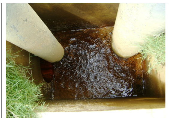
Foto 7 – Registros dos filtros com vazamentos
