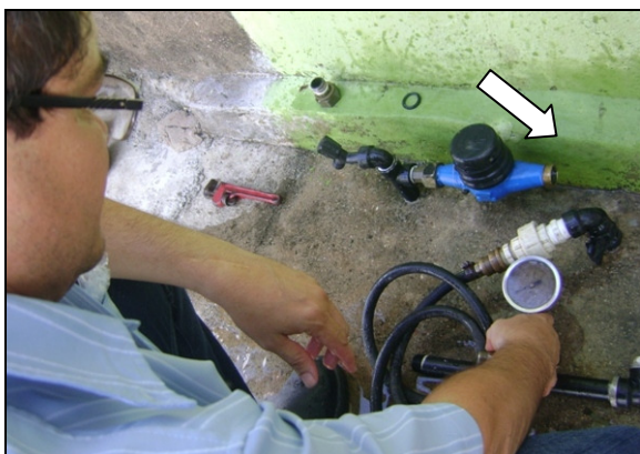
Foto 48 – Medição de pressão na Rua Cel. José Teodoro, FNS 32 - Centro, sem hidrômetro.
