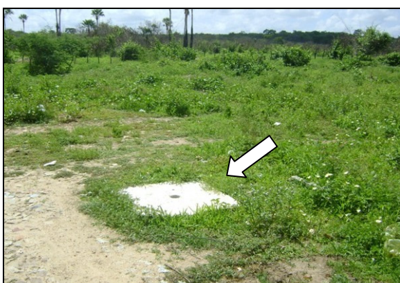
Foto 40 – Registro de descarga localizado na Vila Nova Esperança, Centro.
