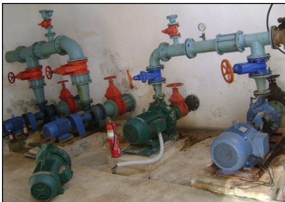
Foto 20 – Elevatórias EELF-01 e EEAT-01.
