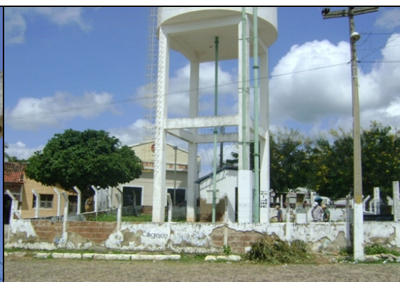
Foto 31 – Reboco do muro externo deteriorado, da área do REL-01.
