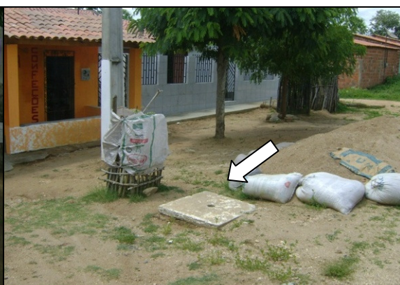
Foto 43 – Registro de descarga localizado na Rua Vila Nova, Centro.
