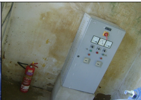
Foto 22 – Quadro de comando da EERD-01.
