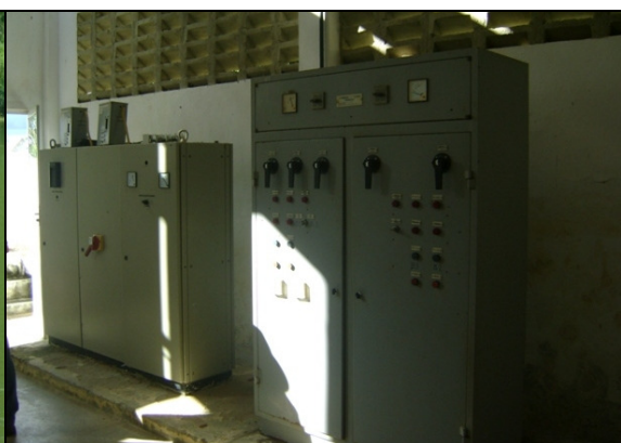
Foto 18 – Quadro de comando das elevatórias EECS-01, EELF-01 e EEAT-01.
