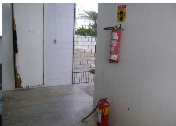
Foto 5 – Extintores de incêndio da casa de química.
