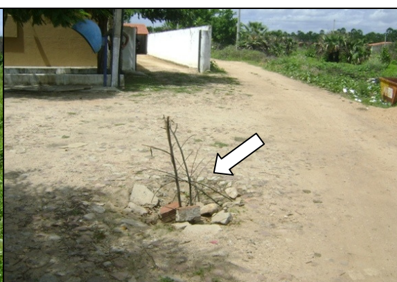
Foto 41 – Registro de descarga sem caixa de proteção, localizado na Rua Santa Luzia, Centro.
