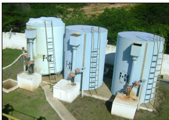
Foto 3 – Vista dos filtros 01 a 03.
