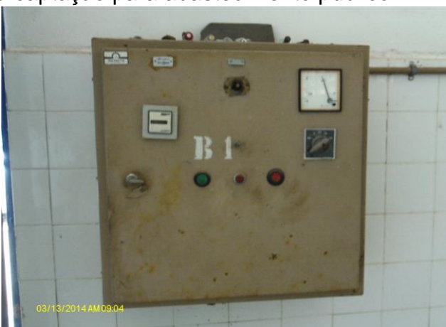
Foto 5 – Quadro de comando da EECS-01.
