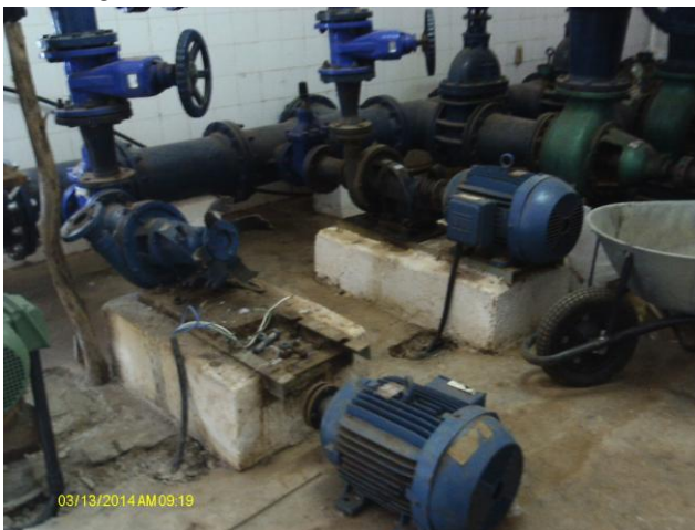
Foto 37 – Conjunto moto-bomba da EELF-01.
