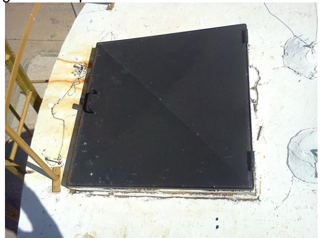
Foto 50 – REL-01: tampa de acesso com adequada vedação.
