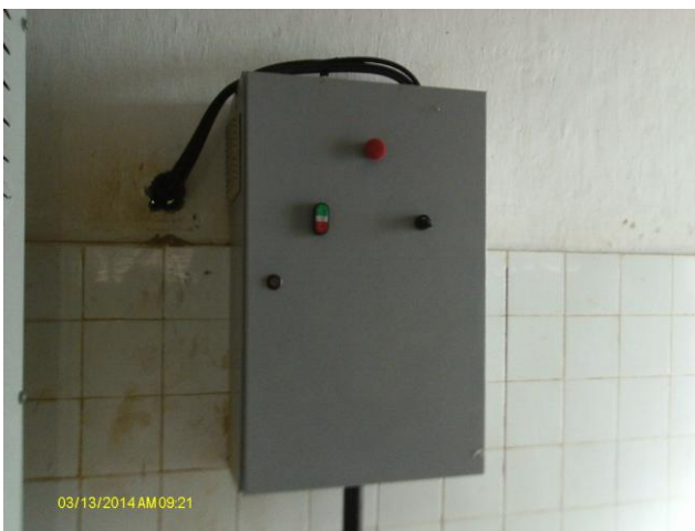
Foto 39 – Quadro de comando da adutora que está em projeto de implantação.
