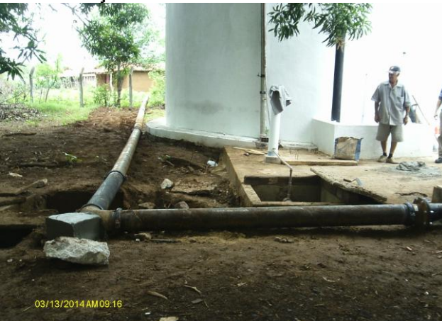
Foto 27 – Adutora de água tratada para o município de Graça na área da ETA de Pacujá.
