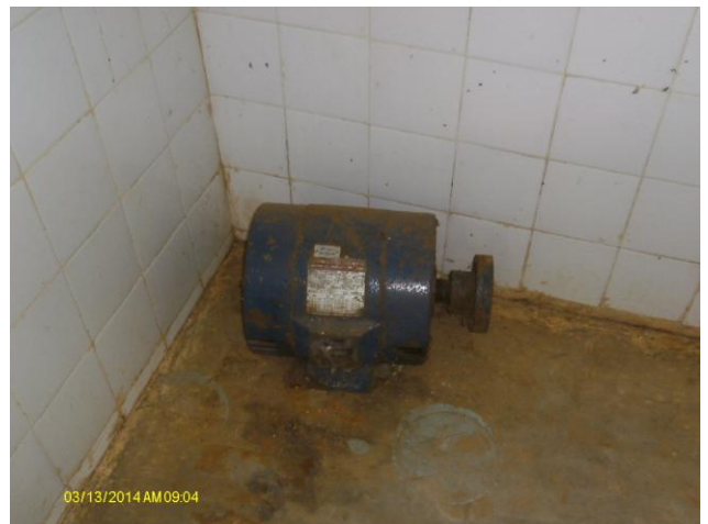
Foto 4 – Bomba reserva da EECS-01.
