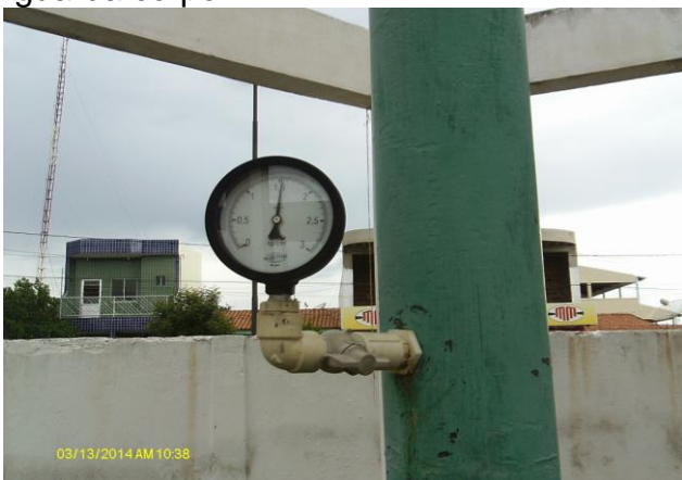
Foto 55 – REL-02: medidor de nível.
