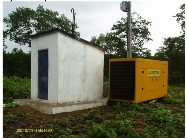
Foto 10 – Gerador de energia e casa do quadro de comando da adutora em implantação.
