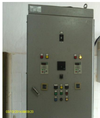
Foto 40 – Quadro de comando da EEAT-01.
