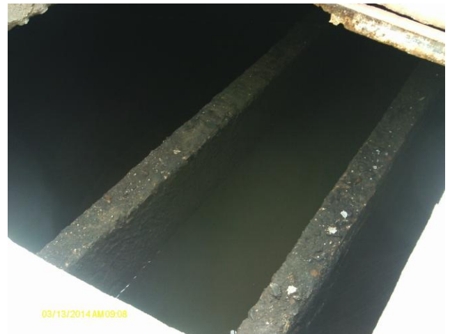
Foto 15 – ETA: vista interna do filtro.
