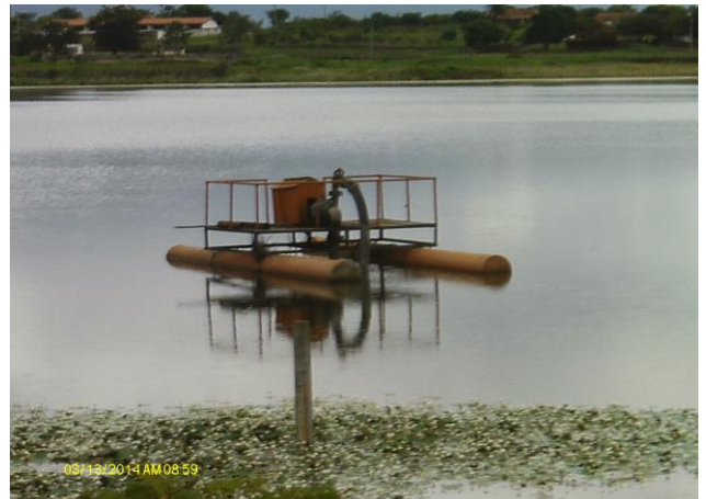
Foto 2 – Conjunto moto-bomba em flutuante.
