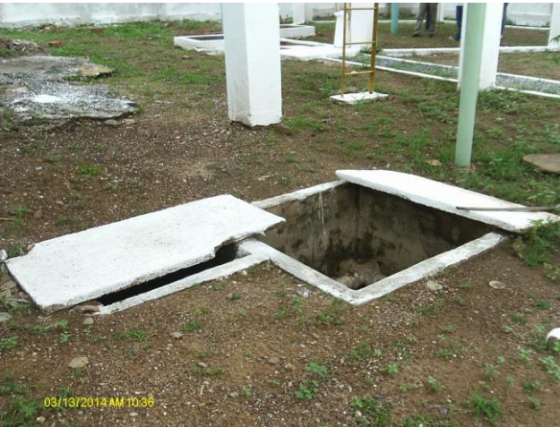
Foto 31 – Caixa de inspeção sem tampa ou grade de proteção na área do REL-01 e REL-02.
