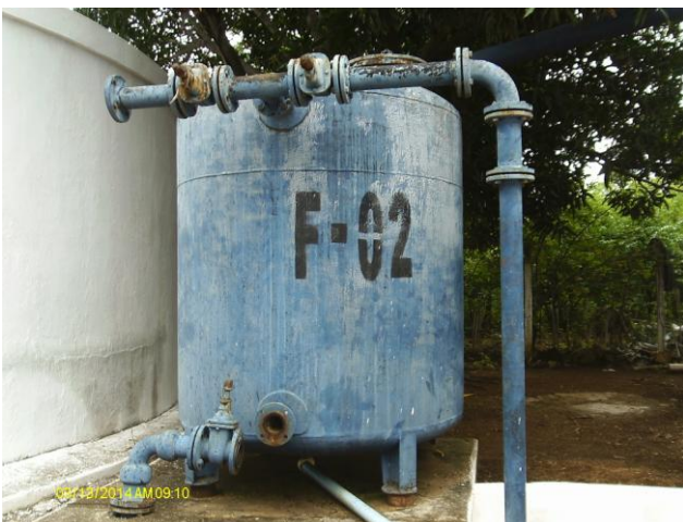
Foto 16 – ETA: filtro desativado.
