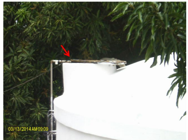
Foto 44 – RAP-01: tampa de inspeção sem a adequada vedação.
