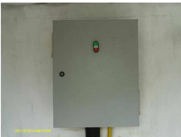
Foto 11 – Quadro de comando da adutora em implantação.
