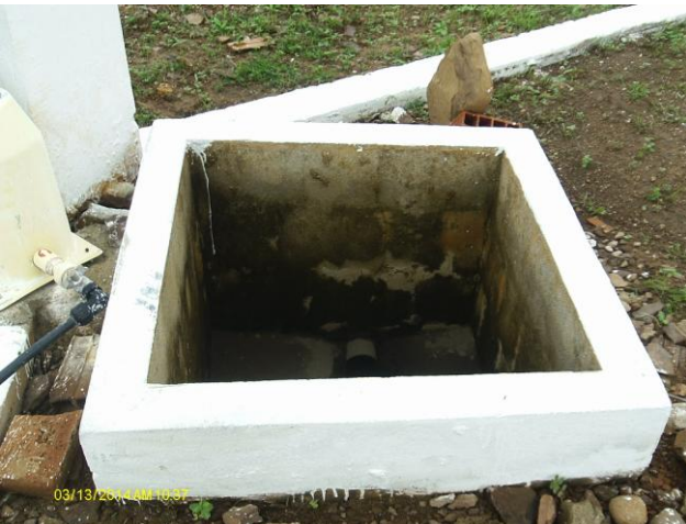
Foto 33 – Caixa de descarga na área do REL-02 sem tampa ou grade de proteção.
