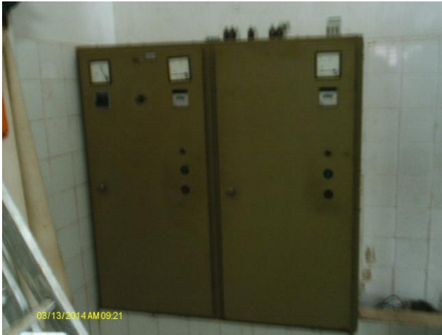
Foto 41 – Quadro de comando da EELF-01.
