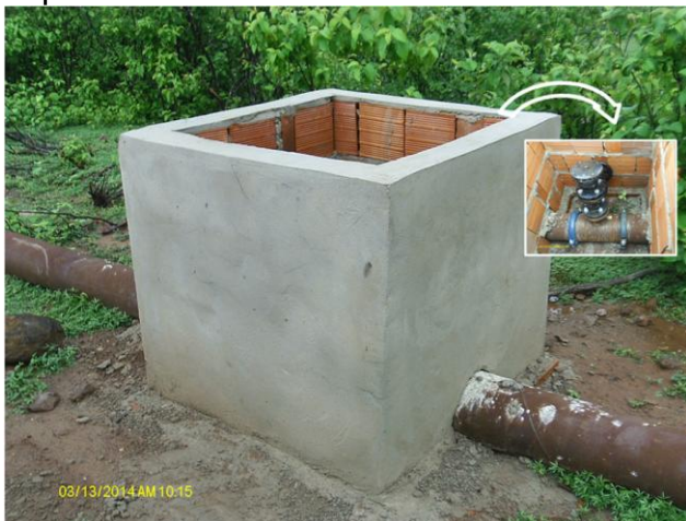
Foto 9 – Caixa de ventosa na adutora de água bruta em projeto de implantação.
