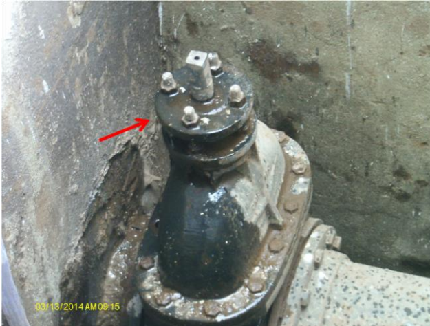
Foto 29 – Registro de água tratada com vazamento na área da ETA.
