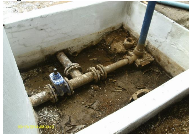
Foto 28 – Caixa de registro na área da ETA sem tampa ou grade de proteção.
