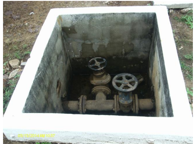
Foto 32 – Caixa de registro sem tampa ou grade de proteção na área do REL-01 e REL-02.
