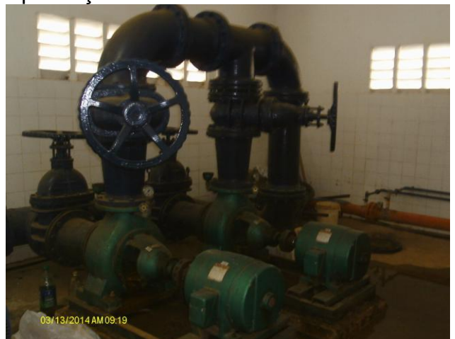
Foto 38 – Conjunto moto-bomba da EEAT-01.
