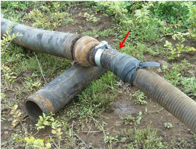
Foto 25 – Vazamento na adutora de água bruta do Açude Coriolano de Souza.
