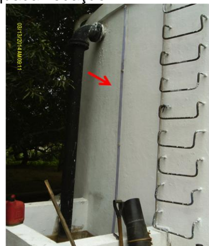
Foto 46 – RAP-01: medidor de nível.
