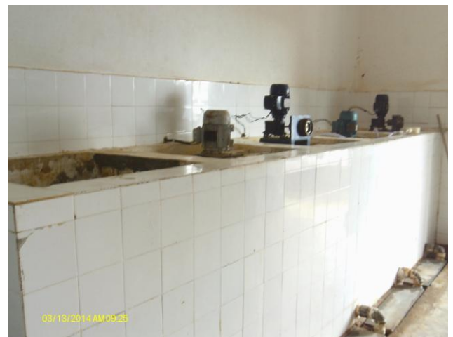
Foto 17 – Tanques de mistura.
