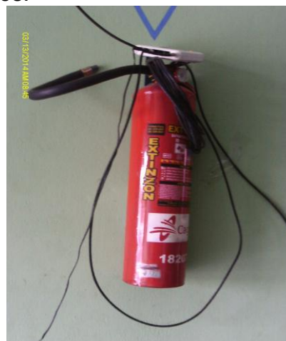
Foto 67 – Extintor de incêndio da loja de atendimento com validade até jun/2016.
