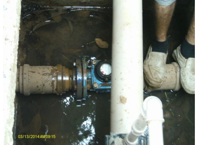
Foto 30 – Macromedidor de água tratada na saída da EEAT-01.
