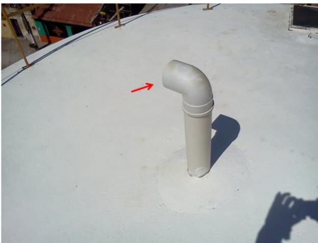
Foto 51 – REL-01: tubulações de ventilação sem tela de proteção.
