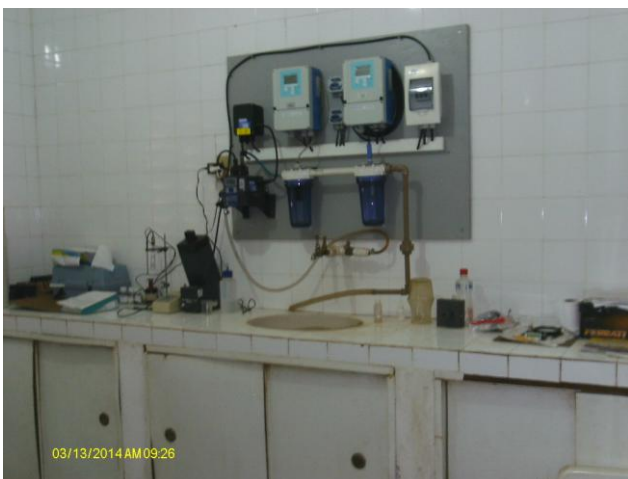
Foto 22 – Vista interna do laboratório da ETA.
