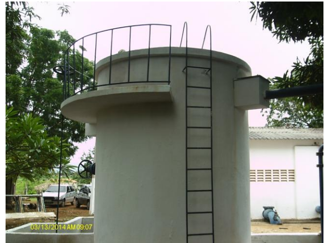
Foto 13 – ETA: filtro sem identificação.
