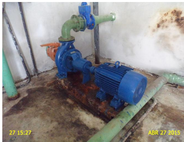
Foto 1 – EELF-01: sem bomba reserva.
