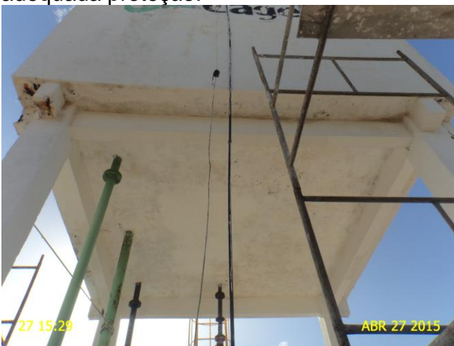
Foto 8 – REL-01: pintura deteriorada.
