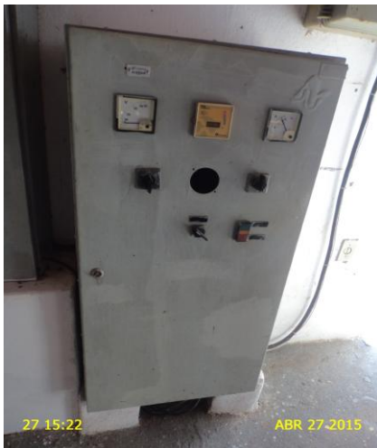
Foto 2 – EEAT-01: quadro de comando com voltímetro sem funcionar.
