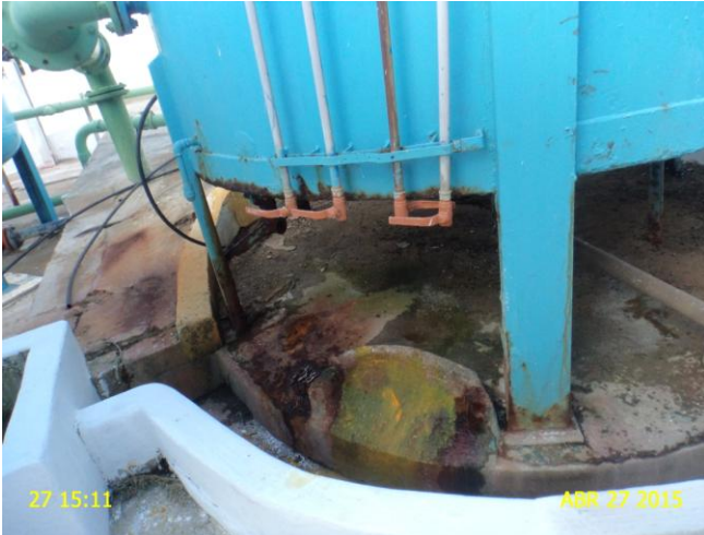
Foto 4 – Floccodecantador com corrosão.
