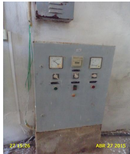
Foto 3 – EEAT-02: quadro de comando com amperímetro sem funcionar.
