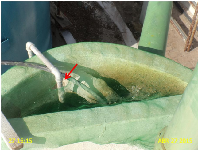
Foto 6 – RAP-02: tela de proteção sem a adequada proteção.
