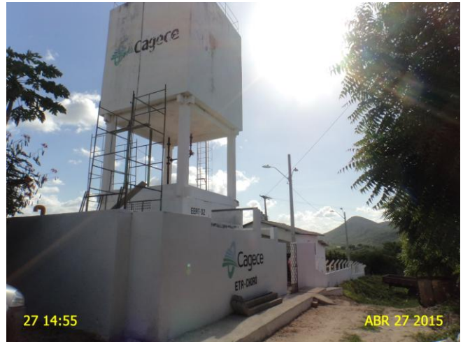
Foto 7 – REL-01: pintura deteriorada.
