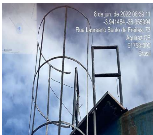
Foto 4 - ETA Tapera: Filtro com escada enferrujada.
