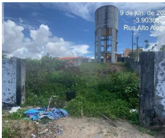
Foto 22 - Prainha: Reservatório sem portão e servindo como depósito de lixo.
