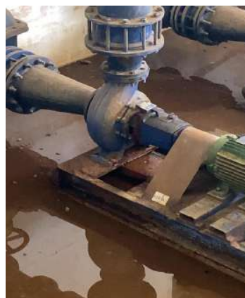
Foto 16 - ETA Riviera: Estação elevatória de lavagem dos filtros com vazamento.
