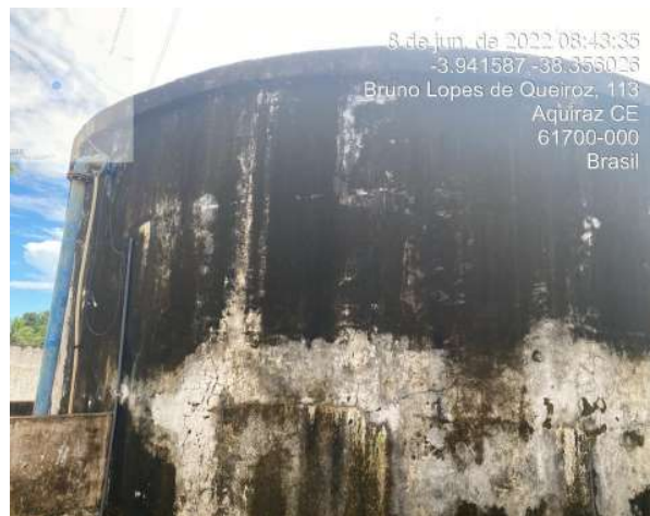
Foto 10 - RAP de Tapera: Péssimas condições de conservação.
