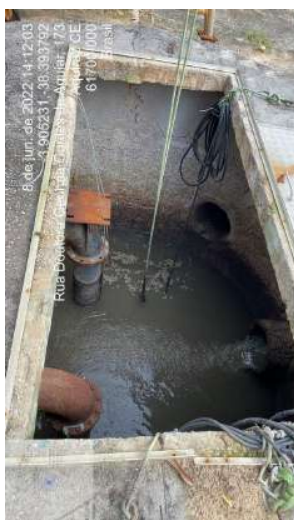
Foto 35 - EEE-04 – Poço de sucção sem grade de proteção
