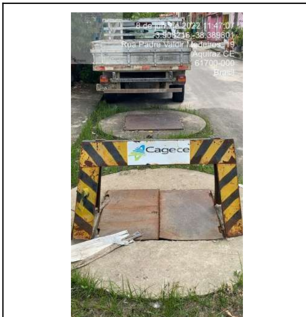
Foto 37 - EEE-05 Sede: Elevatória instalada na própria via com riscos de acidente.
