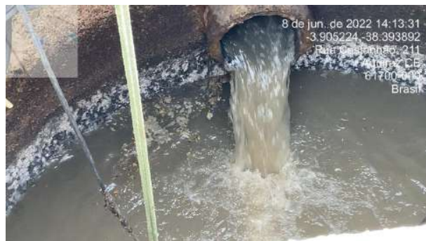
Foto 34 - EEE Final 4: Poço de sucção sem gradeamento.
