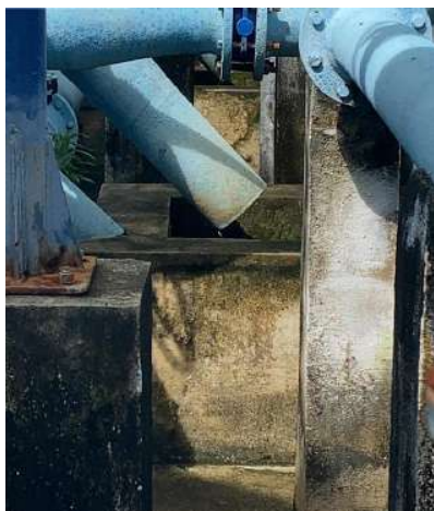
Foto 17 - ETA Riviera: Vazamento no F-03 Riviera.
