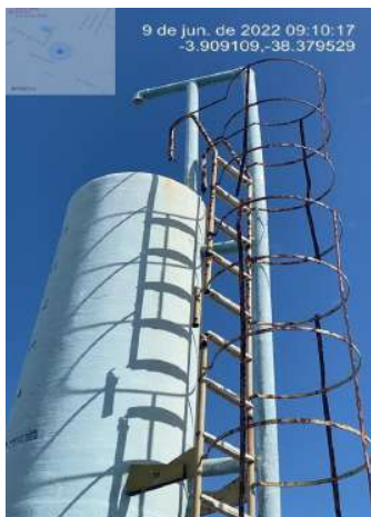
Foto 21 - ETA Sede: escada da torre de nível com corrosão.
