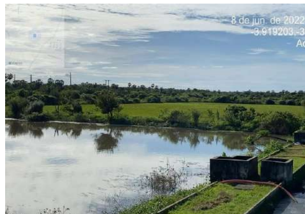
Foto 42 - Não funcionamento das caixas divisoras da lagoa anaeróbia da ETE Sede.
