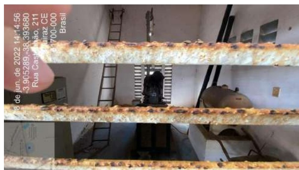
Foto 36 - EEE-04 – Gerador sem funcionamento.
