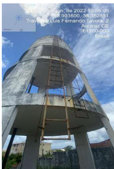
Foto 23 - Reservatório da Prainha: escada enferrujada.
