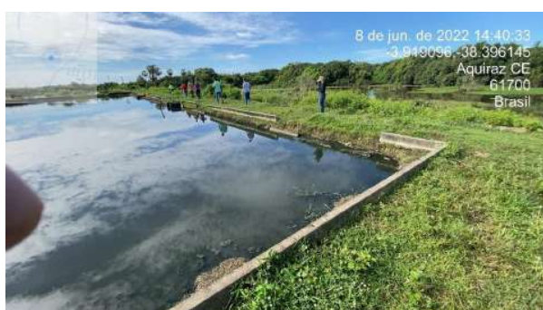
Foto 45 - Desmoronamento e ausência de placas de proteção dos taludes em todas as lagoas da ETE Sede.
