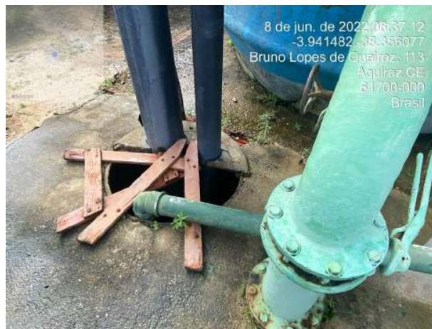
Foto 6 - Condições de segurança inadequadas na área do filtro da ETA.
