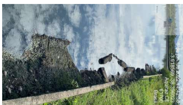
Foto 46 - Desmoronamento e ausência de placas de proteção dos taludes em todas as lagoas da ETE Sede.
