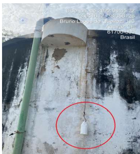
Foto 3 - ETA Tapera: Cloração inadequada no RAP com uso de balde em Tapera.
