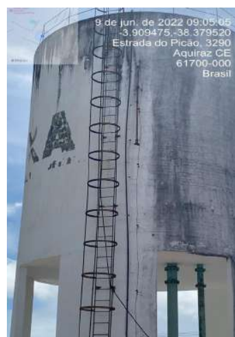
Foto 20 - ETA Sede: escada com corrosão do reservatório elevado e para-raios solto no REL-02.
