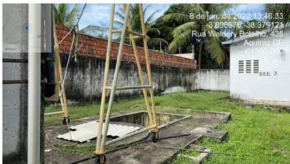
Foto 33 - EEE-03 Sede: Gerador sem funcionamento.
