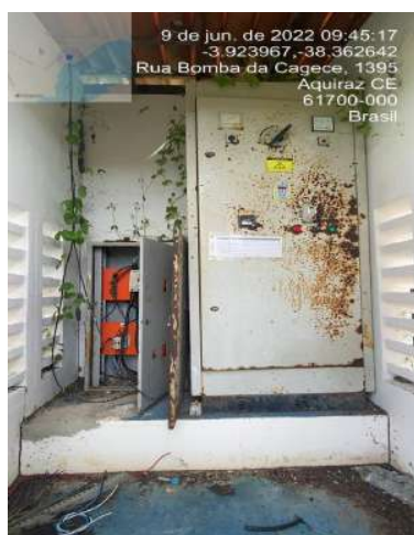
Foto 19 - Sede: manutenção inadequada do quadro de comando e das instalações em geral da EEAB.
