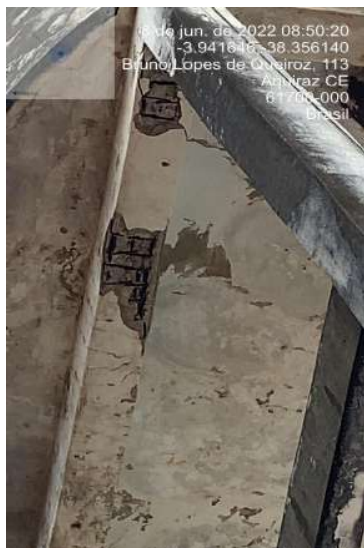
Foto 9 - REL-01 de Tapera: com estrutura deteriorada.
