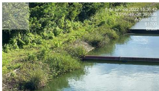
Foto 32 - ETE Riviera: ausência de manutenção na lagoa de maturação.
