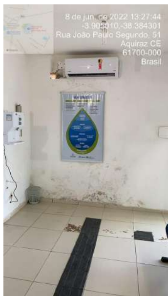
Foto 27 - Escritório comercial com paredes e teto mofado – insalubre para atendimento aos usuários.
