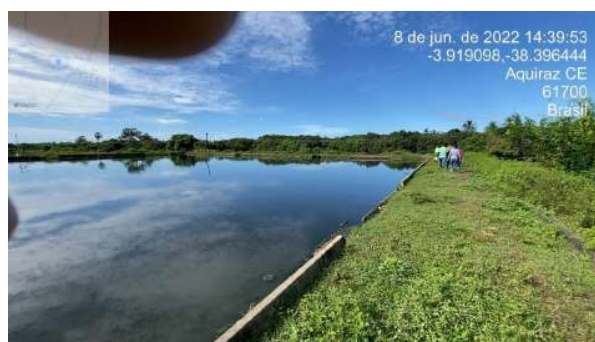
Foto 44 - Desmoronamento e ausência de placas de proteção dos taludes em todas as lagoas da ETE Sede.
