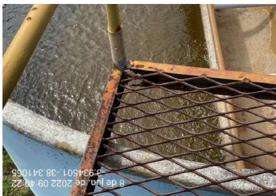
Foto 15 - ETA Riviera: Manutenção precária dos passadiços da ETA.
