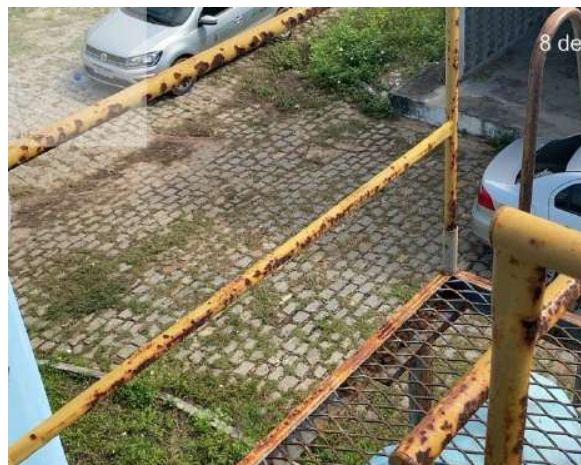
Foto 14 - ETA Riviera: Manutenção precária dos passadiços da ETA.
