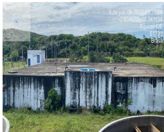
Foto 18 - SAA Riviera: Reservatórios (RAP-02 e 05) sem identificação.
