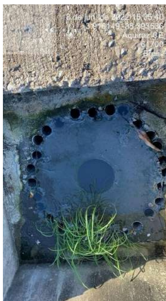
Foto 28 - SES Riviera: Rosetas do reator anaeróbio obstruídas.
