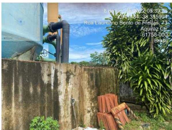
Foto 7 - Paredes da estrutura da ETA em péssimo estado de conservação.
