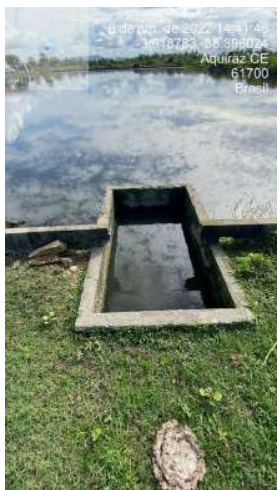
Foto 41 - ETE Sede: Obstrução das saídas da lagoa anaeróbia.
