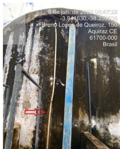
Foto 12 - RAP de Tapera: Mangueira de nível sem condições de visualização.
