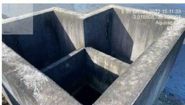
Foto 43 - Não funcionamento das caixas divisoras da lagoa anaeróbia da ETE Sede.
