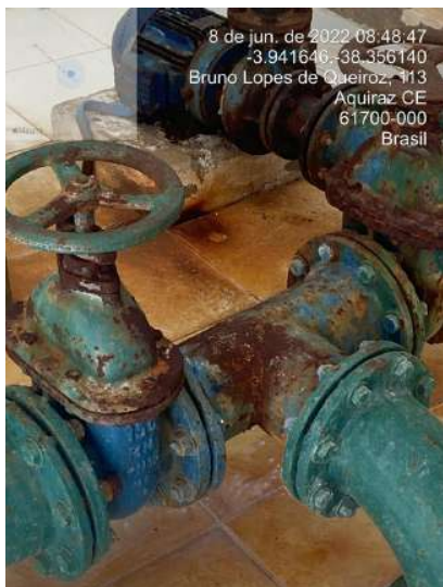
Foto 13 - ETA Tapera: Estação elevatória do REL da ETA em péssimo estado de conservação.
