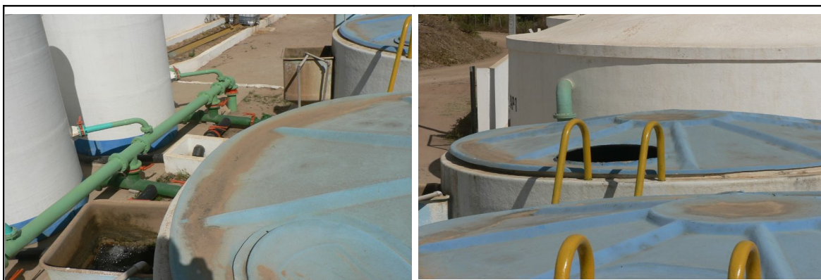
Foto 01 – Ausência de tampa na saída do tratamento.
