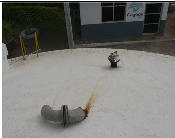
Foto 08 – RAP-02: Tubulação de ventilação inadequada.
