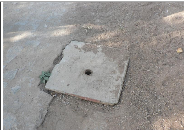
Foto 14 – Registro de descarga localizada na rua Manoel Veras.
