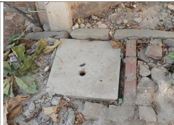
Foto 13 – Registro de descarga localizada na rua Pedro Alencar.
