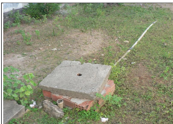
Foto 15 – Registro de descarga localizada na Escola Agrícola Plácido Aderaldo Castelo.
