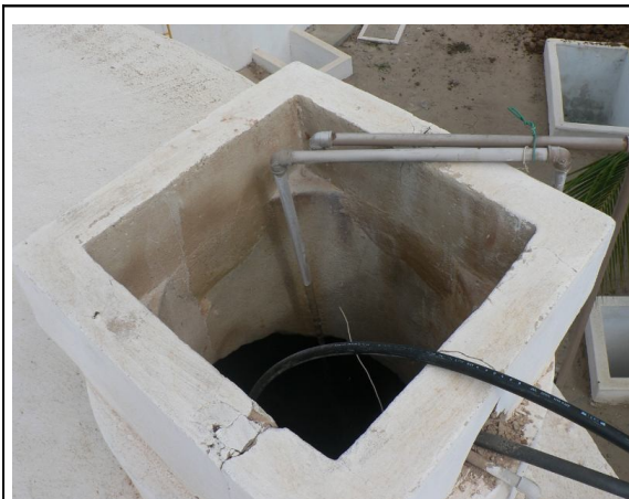
Foto 07 – RAP-01: abertura de inspeção sem tampa.
