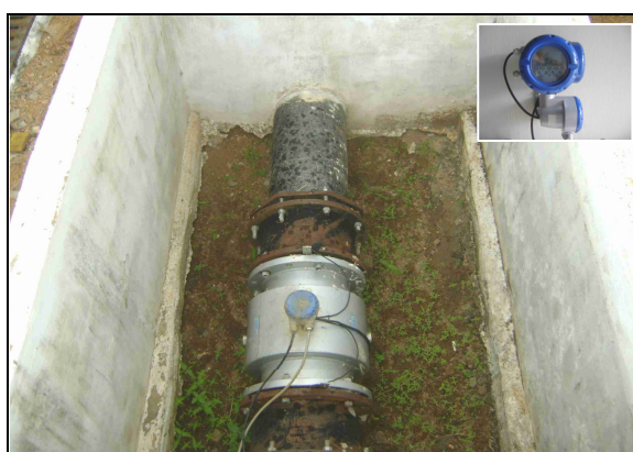
Foto 40 – Macromedidor de água tratada, localizado na saída da EELF-01.
