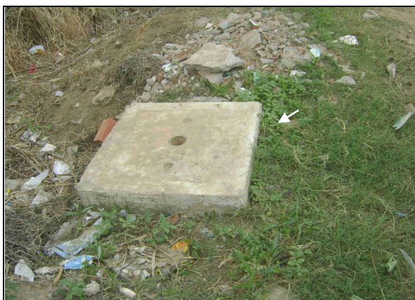
Foto 59 – Registro de descarga localizado na Rua Cícero Justino.
