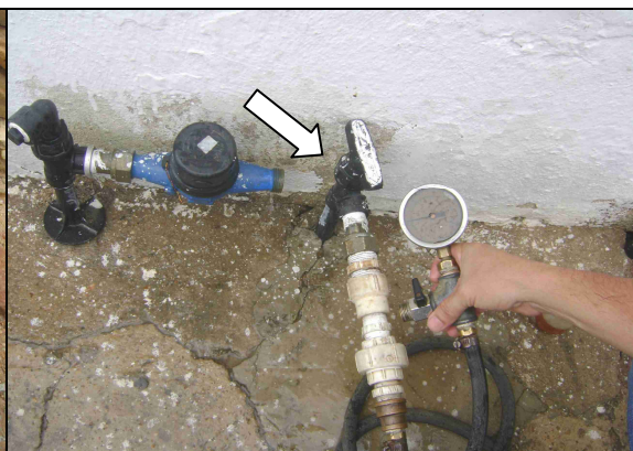
Foto 64 – Medição de pressão na Rua da Liberdade nº 423, Centro, antes do hidrômetro.
