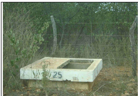
Foto 34 – Caixa de proteção de ventosa sem tampa.
