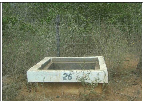
Foto 35 – Caixa de proteção de ventosa sem tampa.
