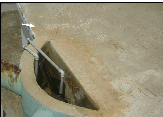
Foto 50 – RAP-01: Ausência de tampa na caixa de chegada de água tratada.
