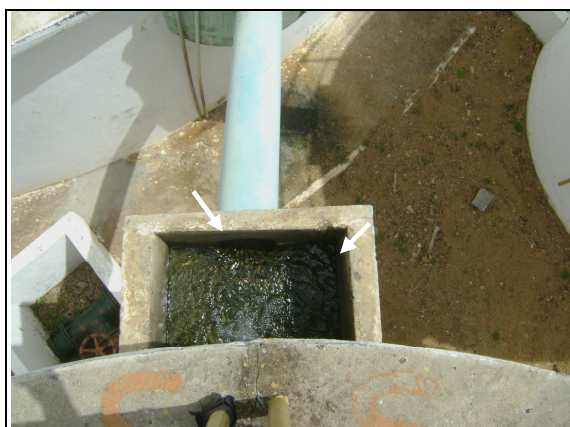
Foto 11 – Filtro 02: Ausência de tampa de proteção na caixa de saída da água tratada.
