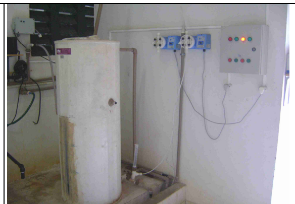
Foto 27 – Dosador de flúor.
