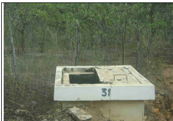
Foto 36 – Caixa de proteção de ventosa sem tampa.
