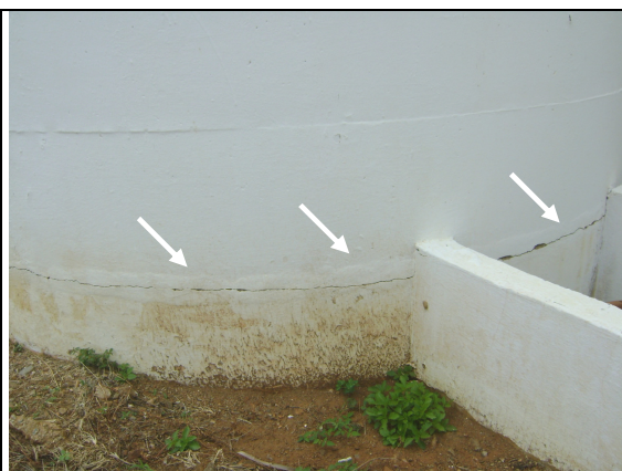
Foto 8 – Filtro 01: Base apresentando rachaduras.
