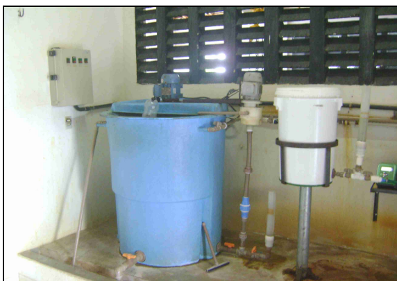
Foto 28 – Tanques de mistura de produtos químicos.
