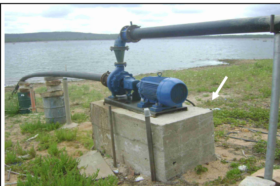
Foto 4 – Bomba reserva localizada na margem do Açude Barra Velha.
