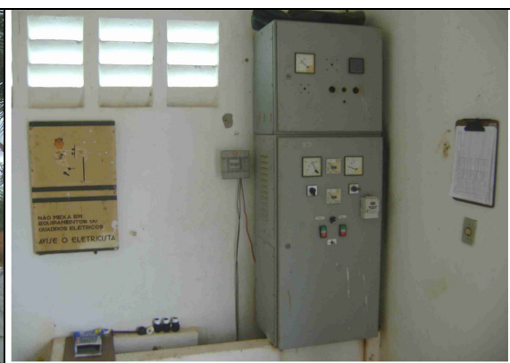
Foto 42 – EECS-01: Quadro de comando.
