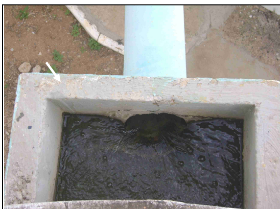
Foto 17 – Filtro 04: Ausência de tampa de proteção na caixa de saída da água tratada.
