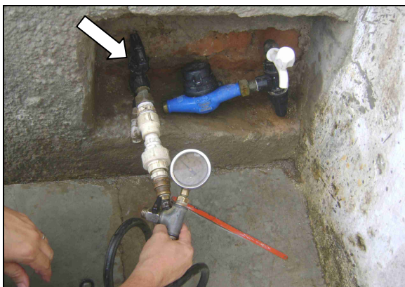
Foto 65 – Medição de pressão na Rua Marechal Humberto, nº 315, Liberdade, antes do hidrômetro.
