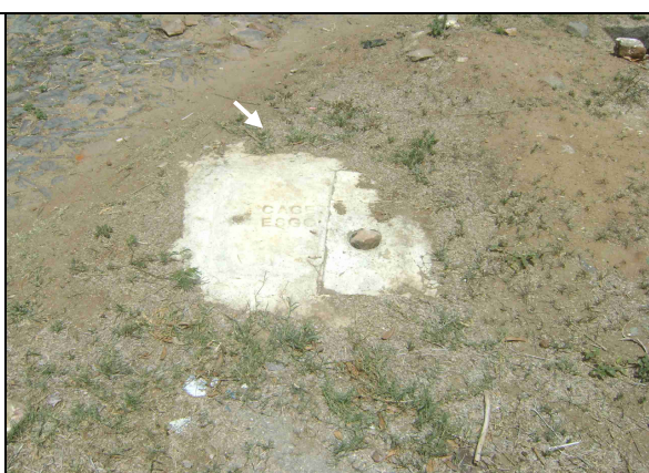
Foto 62 – Registro de descarga localizado na Rua 1 – Conjunto Novo.
