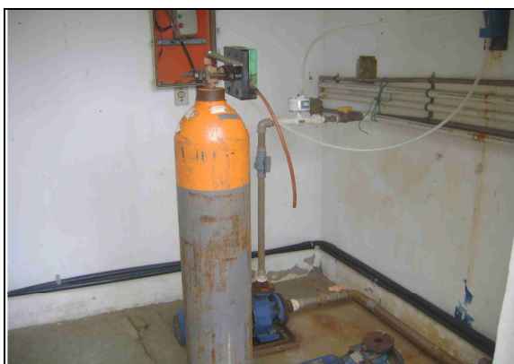
Foto 30 – Dosador de cloro gasoso.
