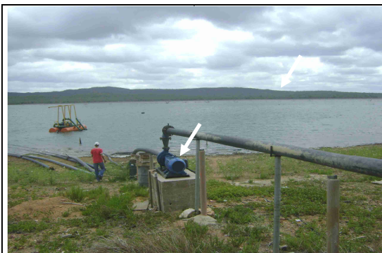
Foto 3 – Bomba reserva localizada na margem do Açude Barra Velha
