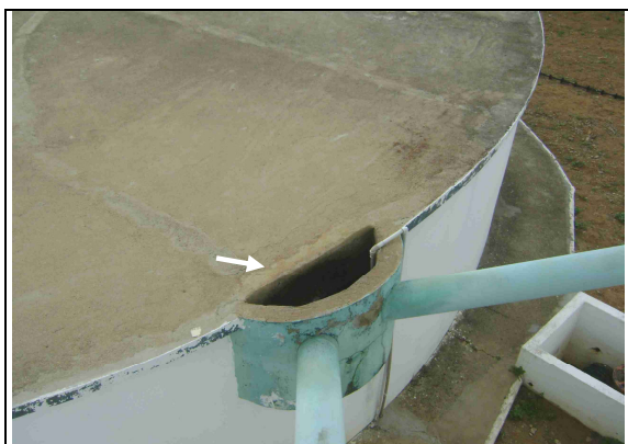
Foto 53 – RAP-02: Ausência de tampa na caixa de chegada de água tratada.
