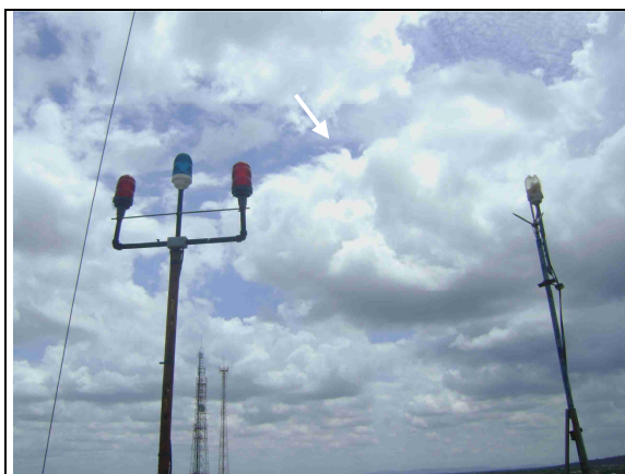
Foto 56 – REL-01: Existência de sinalizador noturno e de pára-raio.
