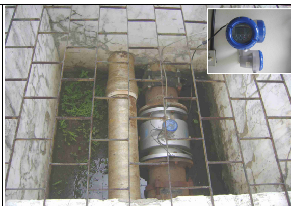
Foto 39 – Macromedidor de água tratada, localizado na saída da EEAT-01.
