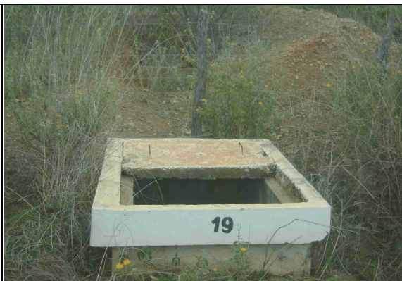
Foto 33 – Caixa de proteção de ventosa sem tampa.
