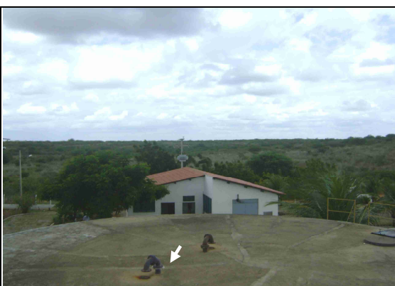
Foto 52 – RAP-02: Tubulação de ventilação com tela de proteção.
