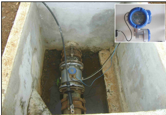
Foto 32 – Macromedidor de água tratada, localizado na entrada da ETA.
