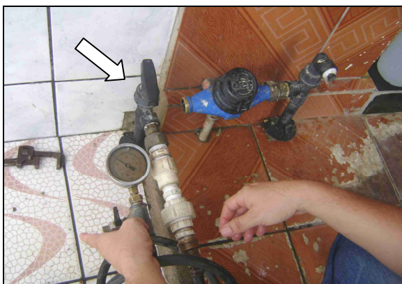
Foto 67 – Medição de pressão na Rua C, nº 52, COHAB, antes do hidrômetro.
