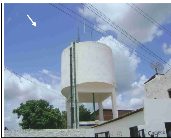
Foto 54 – REL-01: Ausência de identificação e guarda-corpo na laje superior.
