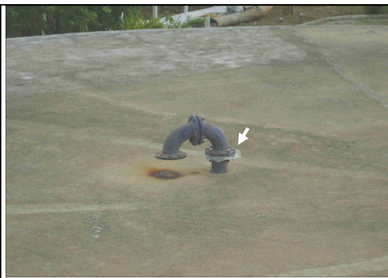
Foto 48 – RAP-01: Tubulação de ventilação com tela de proteção.
