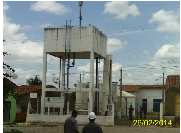
Foto 38 - REL-01: escada de acesso, pintura deteriorada, ausência de identificação e ausência de guarda corpo na laje de cobertura.
