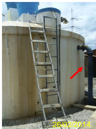
Foto 32 - RAP-01: escada de acesso sem fixação e tubo extravasor.
