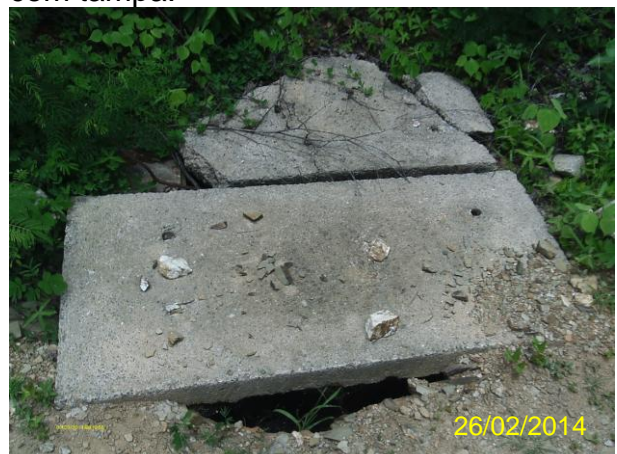
Foto 28 - AAB-01: ventosa com tampa danificada.
