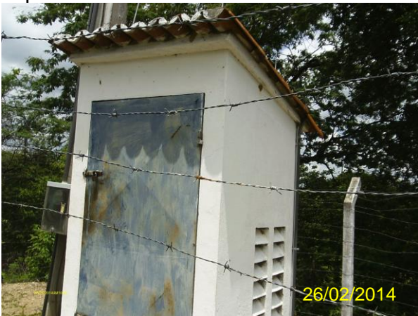
Foto 3 - Captação superficial: casa de abrigo do quadro de comando da EECS-01 sem identificação.
