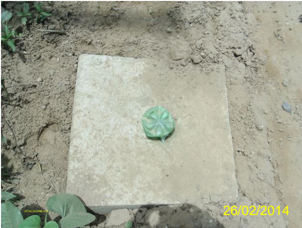
Foto 53 - Registro de descarga: Rua da Caixa D'água.
