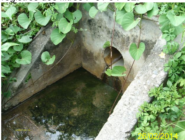
Foto 14 - ETA filtração: disposição das águas de lavagem em lagoa próxima a ETA.
