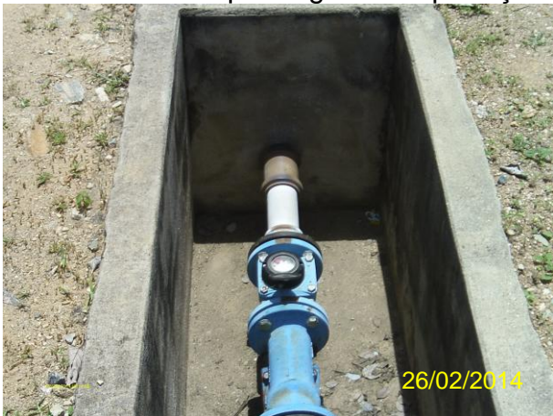
Foto 43 – Medidor proporcional instalado sem tampa ou grade de proteção.
