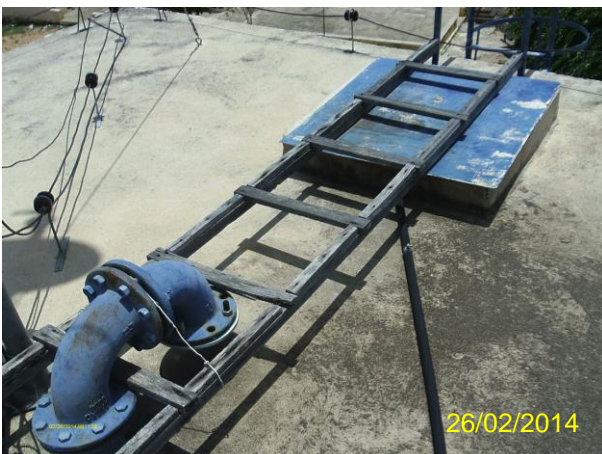
Foto 39 - REL-01: tampa de inspeção sem fixação, tubulação de ventilação sem tela de proteção.
