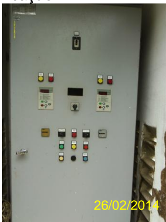
Foto 5 - Captação superficial: quadro de comando da EECS-01.
