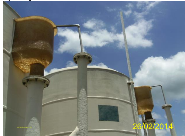
Foto 9 - ETA filtração: ausência de tampa na calha de saída de água do F-01 e F-02.
