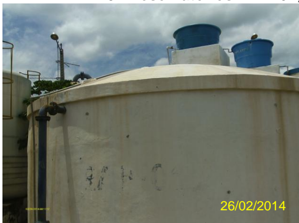
Foto 31 - RAP-01: pintura deteriorada e identificação apagada.
