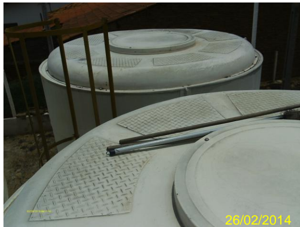
Foto 13 - ETA filtração: tampas dos filtros F-01 e F-02.
