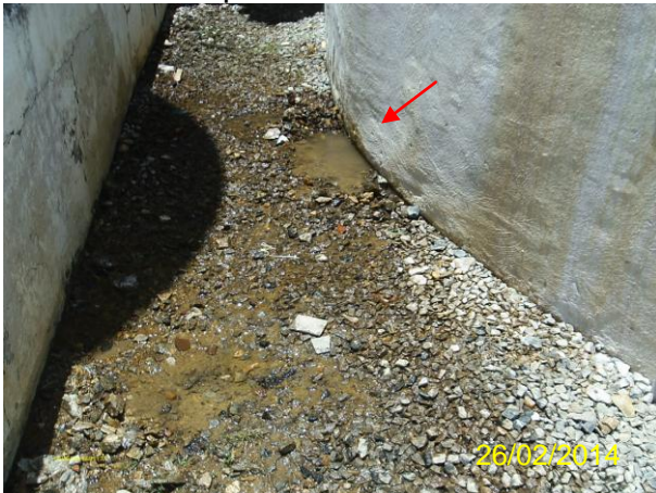
Foto 37 - RAP-01: vazamento na parede do reservatório.
