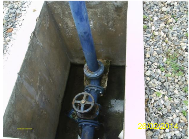
Foto 42 – Registro instalado sem tampa ou caixa de proteção.
