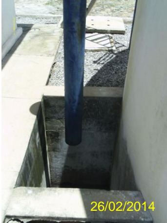
Foto 35 - RAP-01: caixa para descarga de fundo sem tampa.
