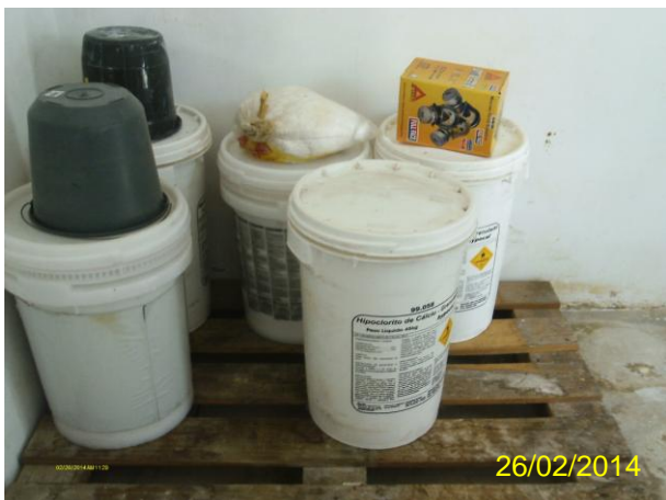
Foto 16 - ETA casa de química: produtos químicos armazenados sobre estrados.
