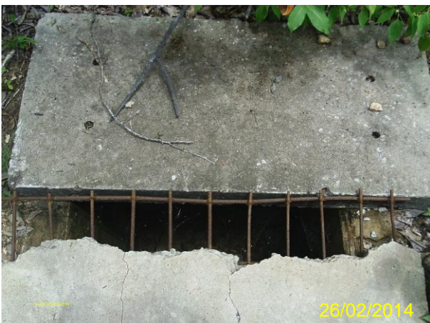
Foto 27 - AAB-01: registro de descarga com tampa danificada.
