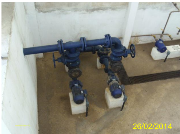
Foto 29 - EEAT-01: conjunto moto bomba com reserva.
