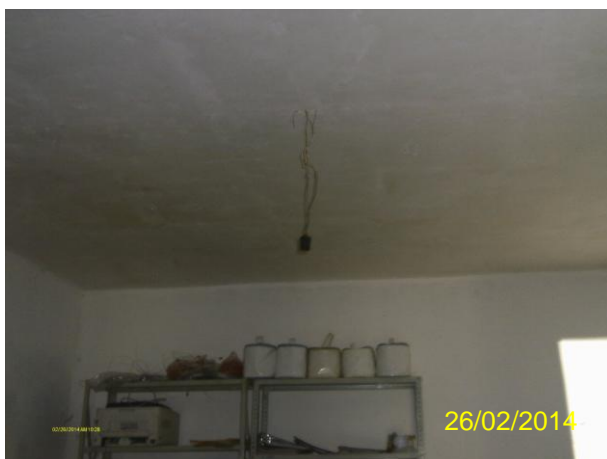
Foto 61 - Almojarifado: ausência de iluminação.
