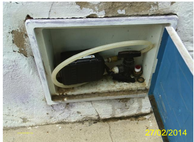
Foto 46 - Aparelho de medição contínua de pressão datalogger instalado no endereço Rua da Caixa D'água, 191.
