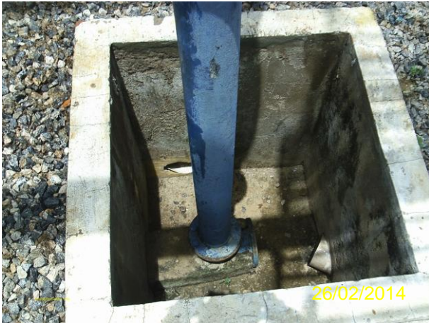
Foto 41 – REL-01: tubulação de descarga de fundo sem tampa ou grade de proteção.
