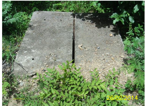
Foto 26 - AAB-01: registro de descarga com tampa.
