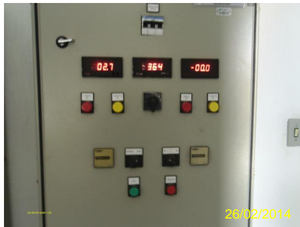
Foto 30 - EEAT-01: quadro de comando.
