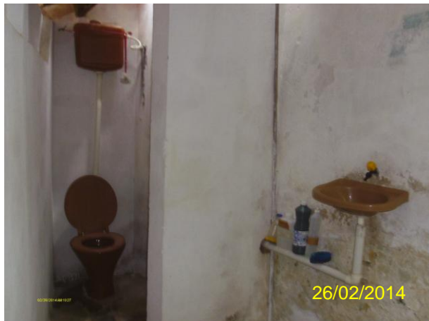
Foto 59 - Escritório: instalações sanitárias improvisadas, sem iluminação e porta.
