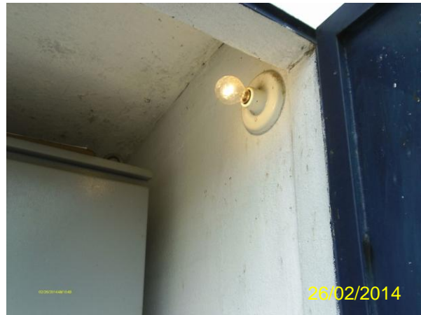
Foto 4 - Captação superficial: iluminação interna na casa de abrigo do quadro de comando da EECS-01.
