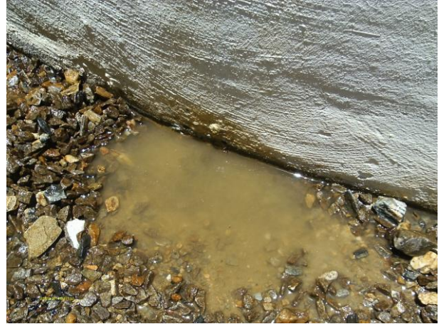
Foto 36 - RAP-01: vazamento na parede do reservatório.
