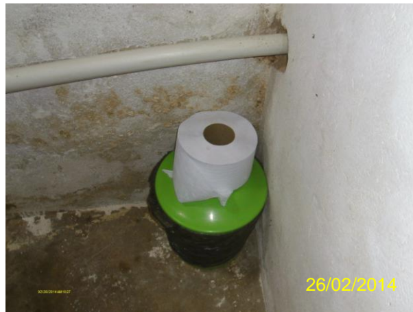
Foto 60 - Escritório: instalações sanitárias improvisadas, ausência de porta papel.
