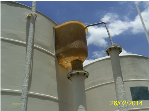
Foto 8 - ETA filtração: F-01 e F-02 sem identificação.
