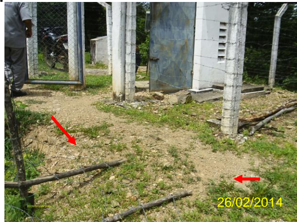
Foto 2 - Captação superficial: cerca de delimitação da área de captação danificada.
