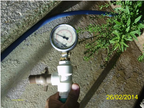
Foto 49 - Medição instantânea de pressão na rede de distribuição: Rua da Caixa D'água, 19.
