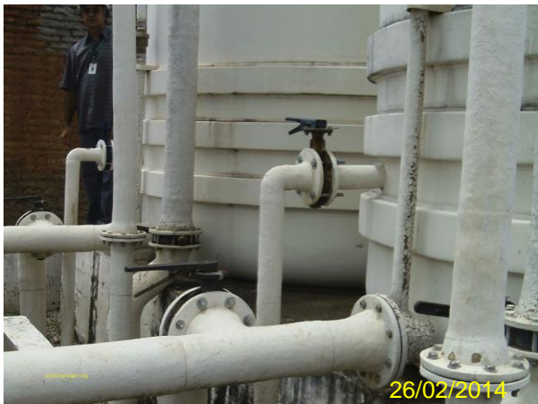
Foto 12 - ETA filtração: tubulações e registros dos filtros F-01 e F-02.
