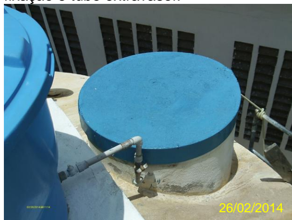
Foto 34 - RAP-01: tampa de inspeção.
