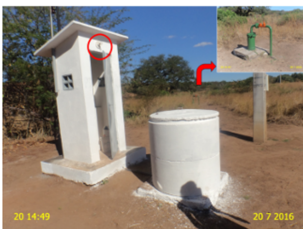
Foto 12 – PT-01 (Felizardo): ausência de identificação e a lâmpada não acende.
