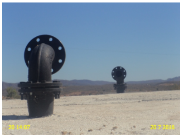
Foto 6 – RAP-01: ausência de tela de proteção nas tubulações de ventilação.
