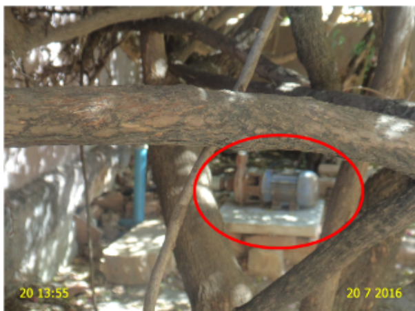
Foto 1 – Booster: ausência de identificação.
