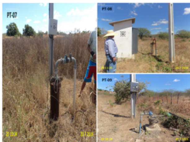
Foto 10 – PT-07/PT-08/PT-09: ausência de identificação.
