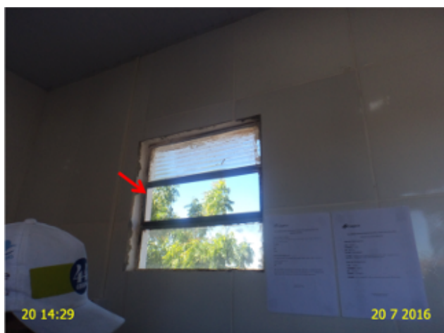
Foto 20 – Laboratório (Sede): o vidro da janela está danificado.
