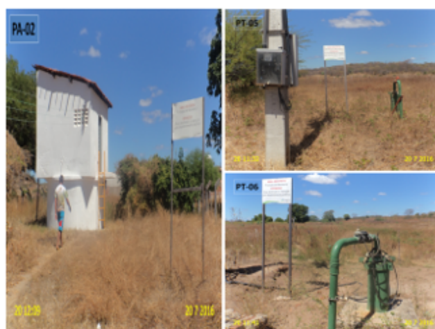
Foto 9 – PA-02/PT-05/PT-06: ausência de identificação.
