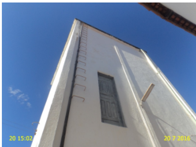
Foto 16 – REL-01 (Felizardo): escada de acesso inadequada.
