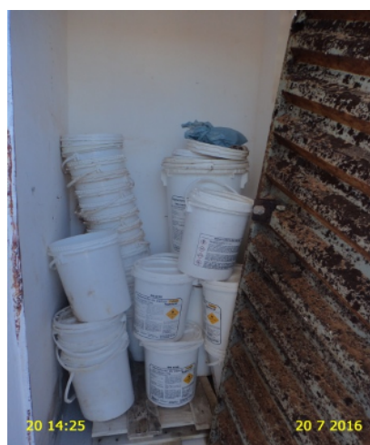
Foto 15 – Casa de química (Sede): portão sem fixação e com corrosão.
