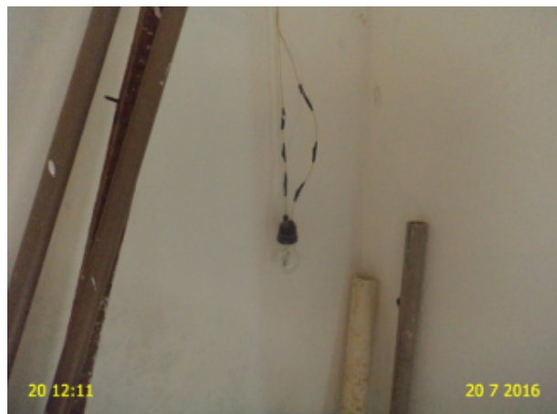
Foto 3 – PA-02: instalação elétrica inadequada e a lâmpada não está acendendo.
