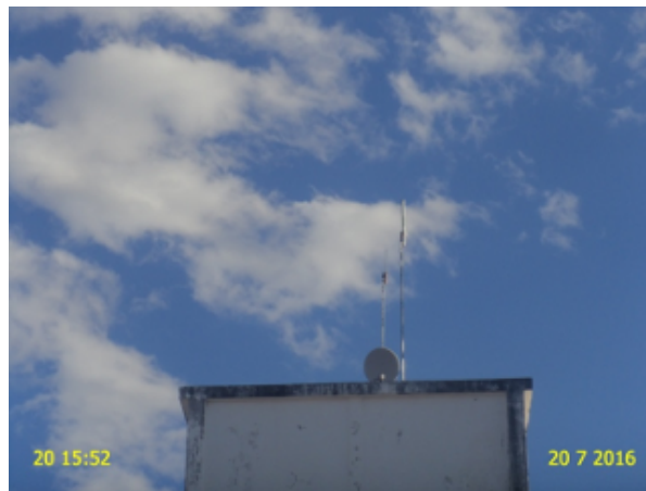
Foto 4 – REL-01: ausência de para-raios e sinalizador noturno.
