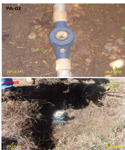
Foto 14 – AAT - PA-02/PT-09: macromedidor danificado e macromedidor sem caixa de inspeção.
