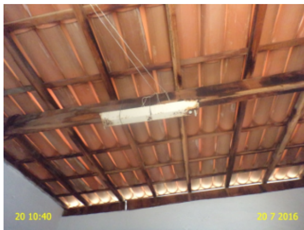
Foto 2 – PA-01: ausência de iluminação.
