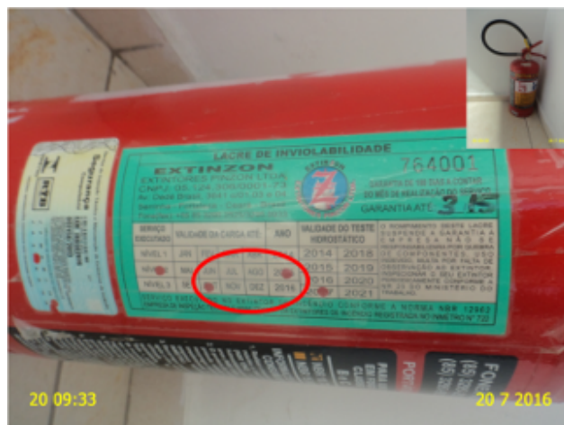
Foto 17 – Loja de atendimento: extintor com carga vencida em out/15.
