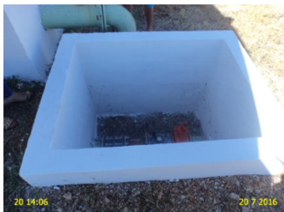
Foto 7 – RAP-01: caixa de inspeção sem tampa ou grade de proteção.
