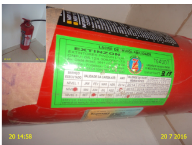
Foto 18 – Ponto de apoio (Felizardo): extintor com carga vencida desde out/15.
