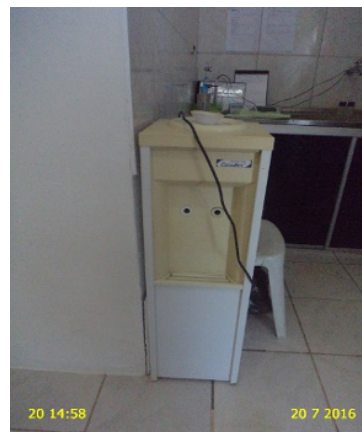
Foto 26 – Local de apoio (Felizardo): aparelho de bebedouro com defeito.
