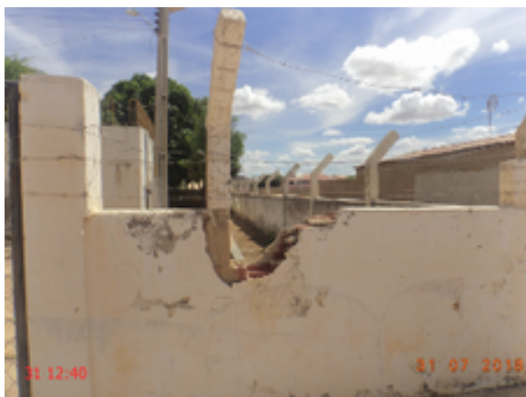
Foto 13 – RAP-01 e REL-01: a cerca e o muro de delimitação da área dos reservatórios está deteriorada.
