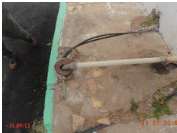
Foto 8 - PT-01 sem identificação, não existe laje de proteção.
