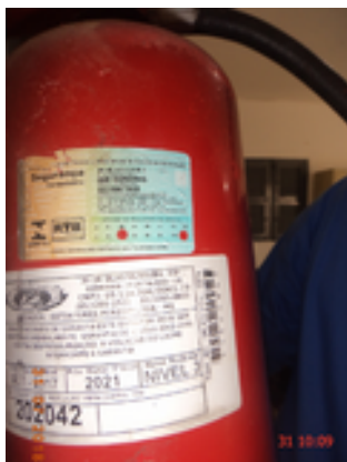
Foto 9 – Almoarifado: O extintor está com a data da recarga vencida.
