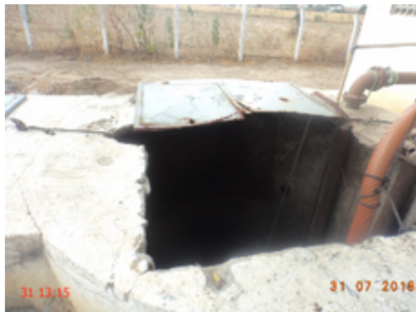
Foto 17- EEE-1: O poço de sucção está com a tampa deteriorada e em processo de corrosão.
