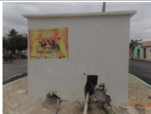
Foto 14 – Casa de abrigo: PT-01, PT-02 e PT-03 está com a estrutura deteriorada.
