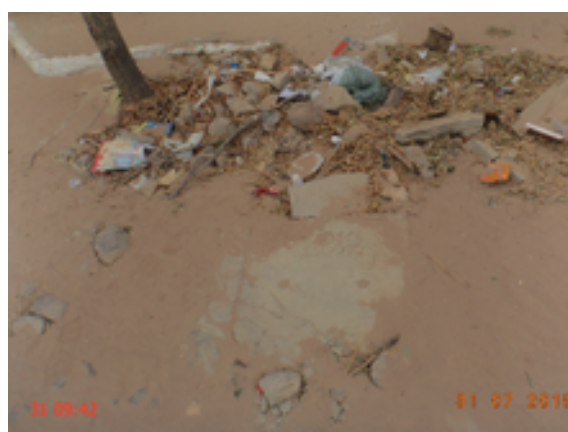
Foto 6 – PT-06: sem identificação, a tampa de proteção está deteriorada, com presença de lixo no local e sem cerca ou muro de delimitação de proteção
