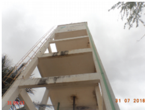
Foto 12 – REL-01: apresenta sinais de infiltração e está com a pintura deteriorada.
