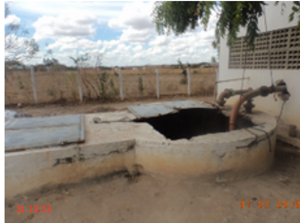
Foto 18 – EEE-1: A tampa da caixa de passagem está em processo de corrosão.
