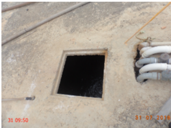
Foto 1 - Reservatório: O reservatório RAP-01 não é dotado de tampa de inspeção.
