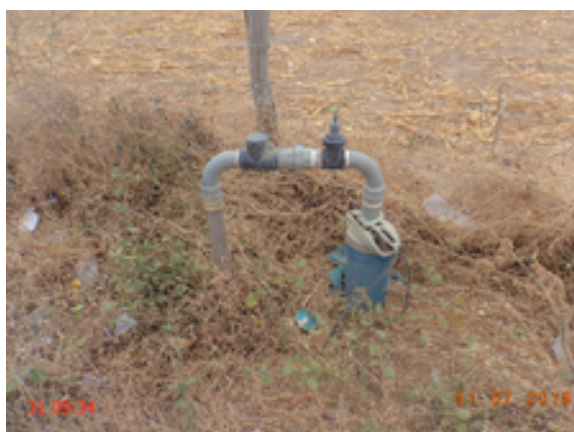
Foto 5 – PT-05: sem identificação, não existe laje de proteção e cerca ou muro de delimitação de proteção e presença de vegetação excessiva.
