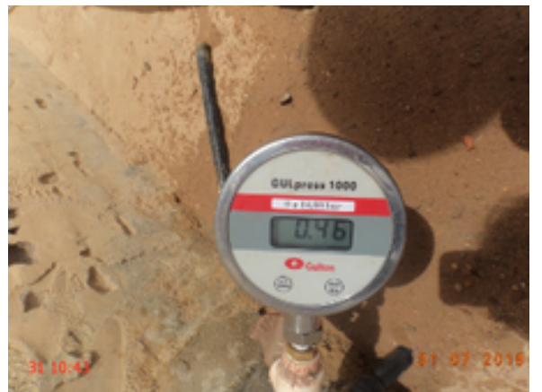
Foto 23 – RDA: medição instantânea de pressão no endereço Rua João Libânio, 549.
