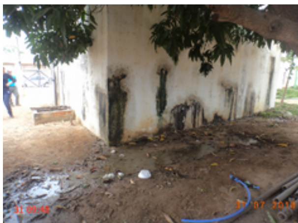
Foto 15 – RAP-01: apresentou vazamento no período da inspeção.
