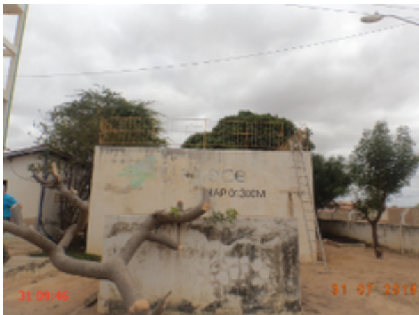
Foto 11 – RAP 01: está com a identificação pouca visível e com a pintura deteriorada.
