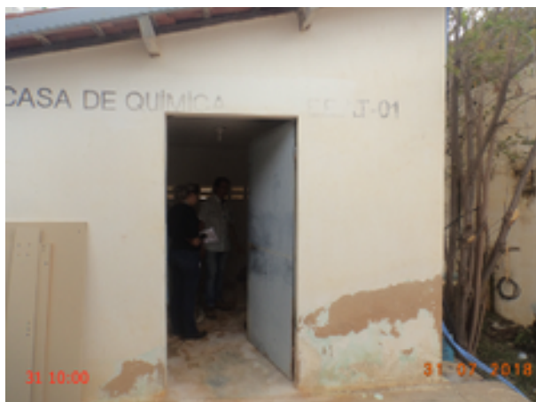
Foto 20 – EEAT-01: Identificação com pouca visibilidade de a pintura deteriorada.
