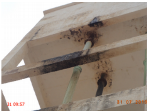
Foto 16 – REL-01: apresentou vazamento no período da inspeção.
