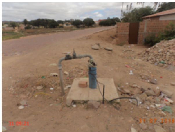
Foto 3 – PT-03: sem identificação, não existe laje de proteção e sem cerca ou muro de delimitação de proteção, há presença de lixo no local.
