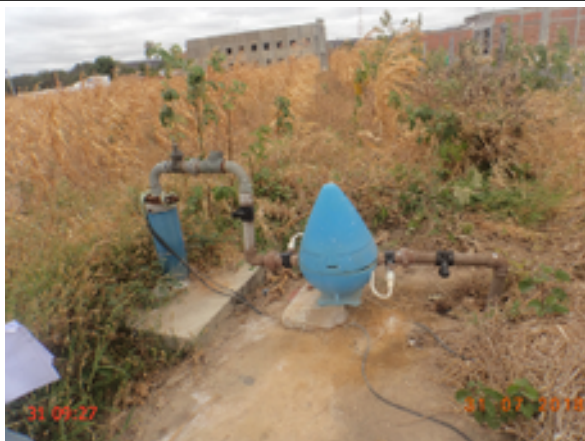
Foto 7 – Captação: PT-07 sem identificação, não existe laje de proteção e cerca ou muro de delimitação de proteção e presença de vegetação excessiva.
