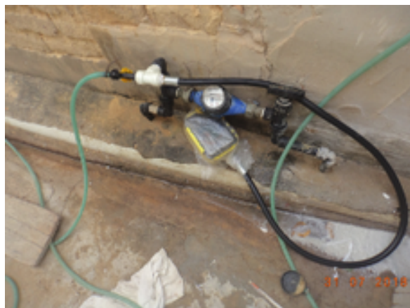
Foto 26 – RDA: medição contínua de pressão no endereço Avenida São Pedro, 489.
