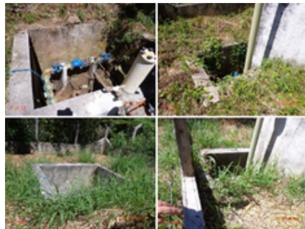
Foto 31 – AAT (DQP-05, DQP-06 e DQP-07) (Lambedouro): caixas de inspeção sem tampa ou grade de proteção.
