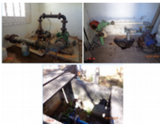
Foto 7 – EERD-03, EERD-04 e EERD-05: ausência de bomba reserva.
