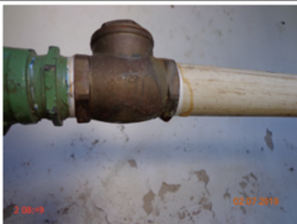
Foto 24 – EERD-04 (Sede): vazamento na tubulação.
