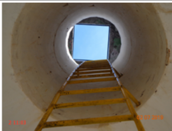
Foto 5 – REL-09 (Lambedouro): ausência de tampa de inspeção.
