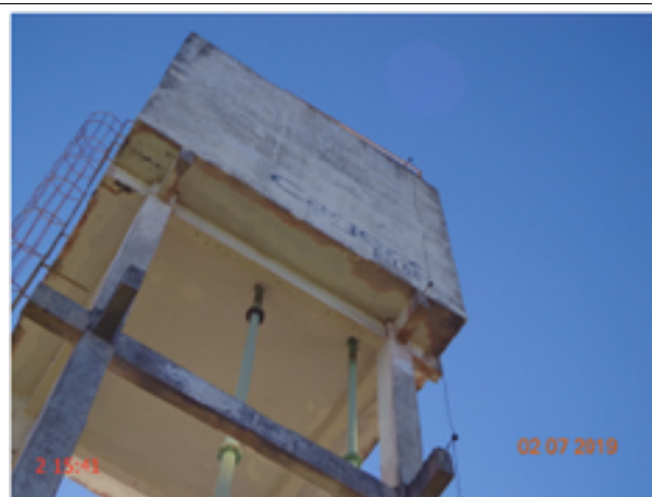
Foto 13 – REL-06 (Inharin): pintura deteriorada e ausência de identificação.
