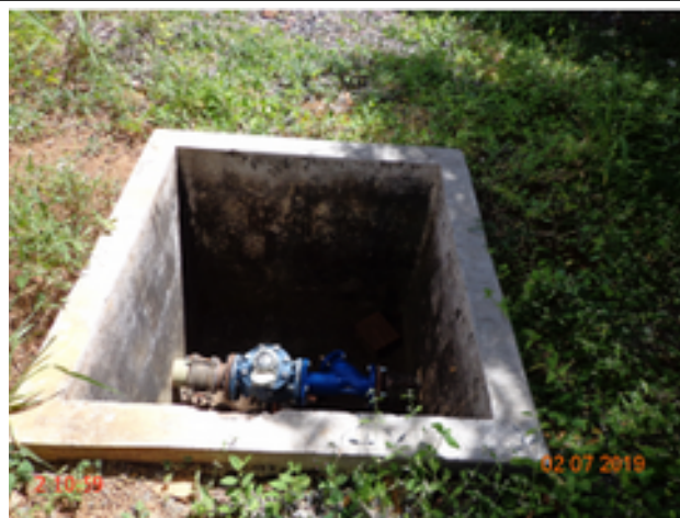
Foto 27 – REL-09 (Lambedouro): ausência de tampa ou grade de proteção.
