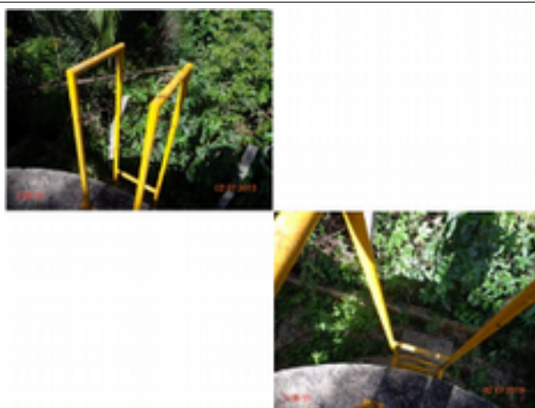
Foto 17 – RAP-20 (Sede): escada em processo de corrosão.
