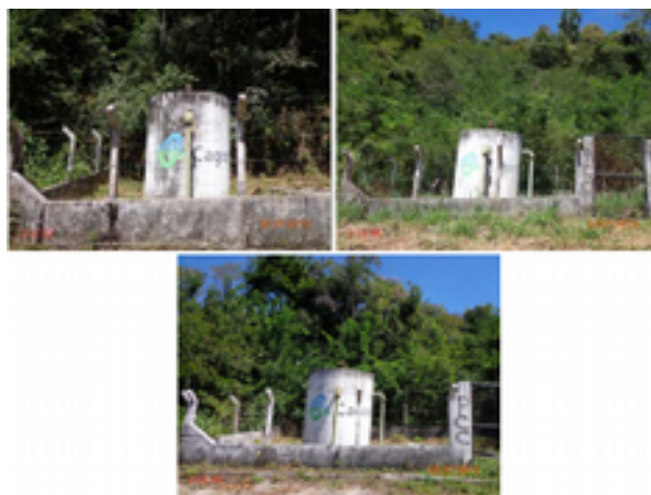
Foto 29 – AAT (DQP-05, DQP-06 e DQP-07) (Lambedouro): ausência de identificação.
