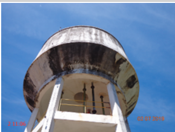
Foto 12 – REL-09 (Lambedouro): ausência de identificação, pintura deteriorada.
