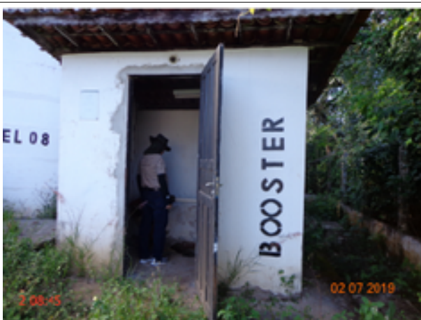
Foto 10 – EERD-04 (Sede): ausência de identificação e área de acesso tomada pela vegetação.
