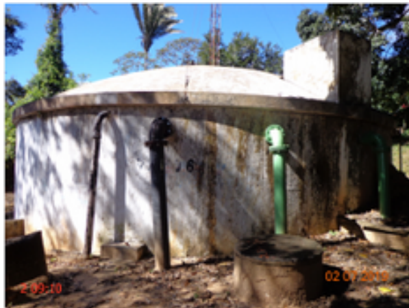
Foto 21 – RAP-06 (Sede): pintura deteriorada e identificação apagada.
