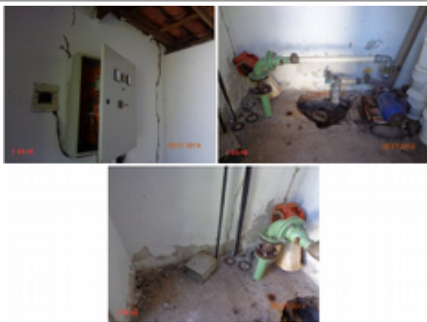
Foto 22 – EERD-04 (Sede): presença de cupins, piso, pintura e reboco deteriorados.
