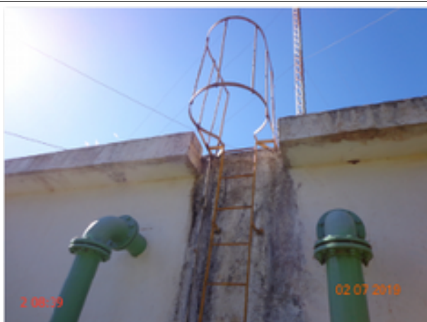
Foto 16 – RAP-05 (Sede): escada e guarda-corpos em processo de corrosão.
