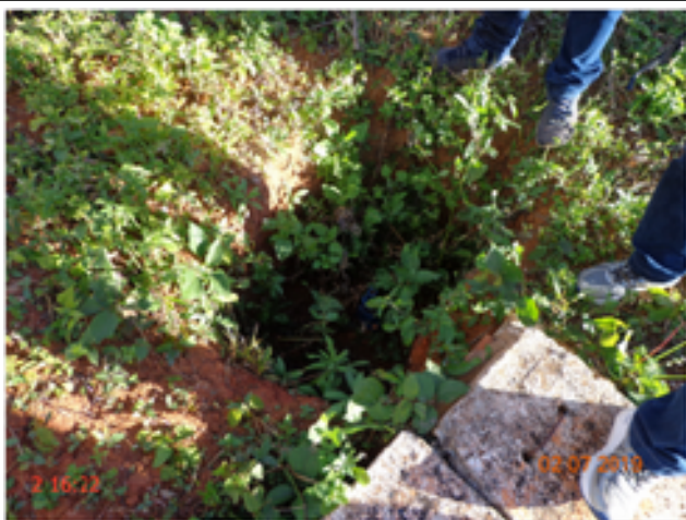
Foto 26 – REL-05 (REL-32) (Quatiguaba): registro sem caixa.
