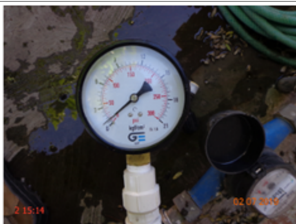
Foto 3 – RDA (Queimadas): pressão instantânea fora da faixa de 10 a 50 mca na R. SDO 04, SMS 12.
