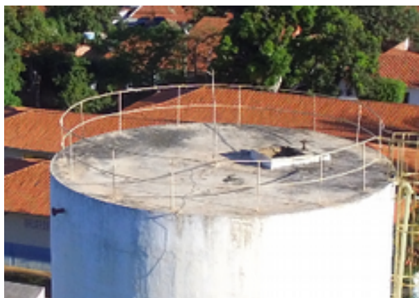
Foto 4 – REL-05 (REL-32) (Quatiguaba): tubulação de ventilação sem curvatura, ausência de sinalização noturna e de tampa de inspeção.
