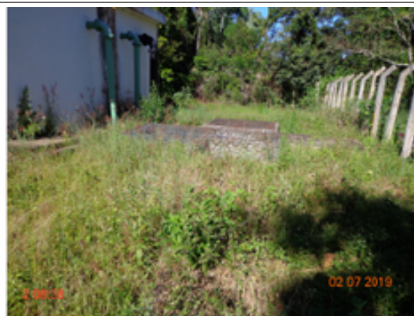
Foto 11 – RAP-05 e RAP-20 (Sede): área de acesso tomada pela vegetação.
