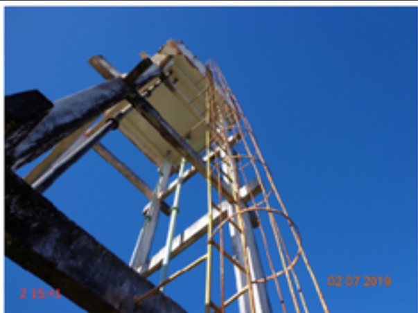
Foto 18 – REL-06 (Inharin): escada e guarda-corpos em processo de corrosão.
