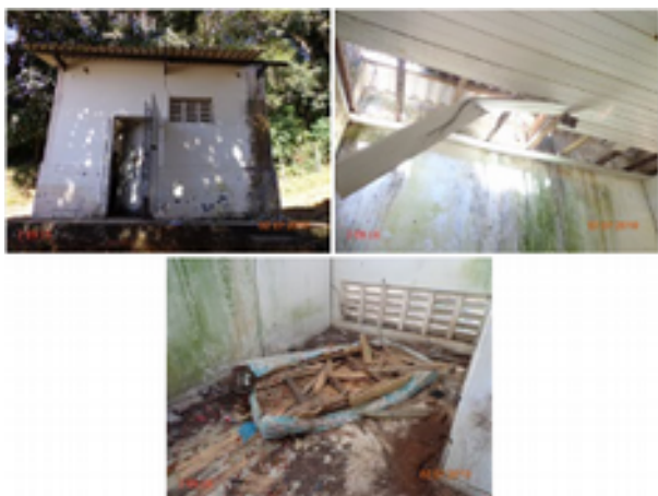
Foto 14 – EERD-05 Igreja do Céu (Sede): ausência de identificação e iluminação, teto danificado e sujeira.
