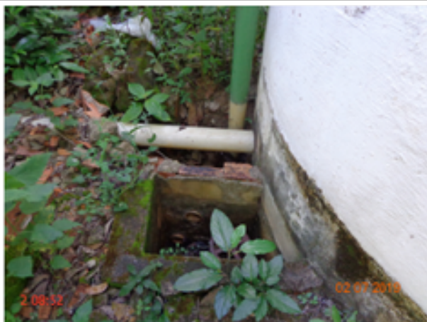
Foto 28 – RAP-20 (Sede): ausência de tampa ou grade de proteção.
