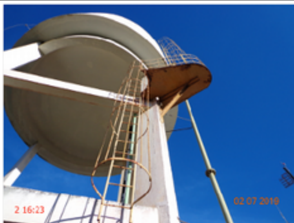
Foto 19 – REL-05 (REL-32) (Quatiguaba): escada e guarda-corpos em processo de corrosão.
