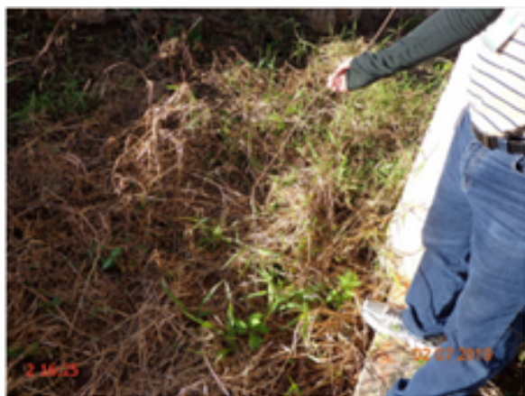
Foto 20 – REL-05 (REL-32) (Quatiguaba): para-raios sem aterramento.
