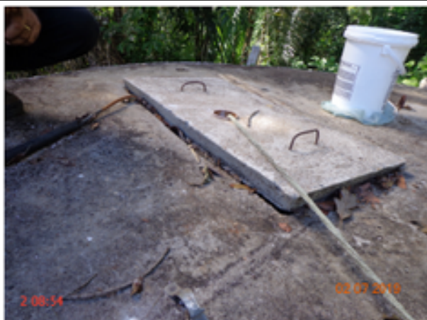
Foto 8 – RAP-20 (Sede): tampa sem vedação e tubulação de ventilação localizada na tampa sem a curvatura
