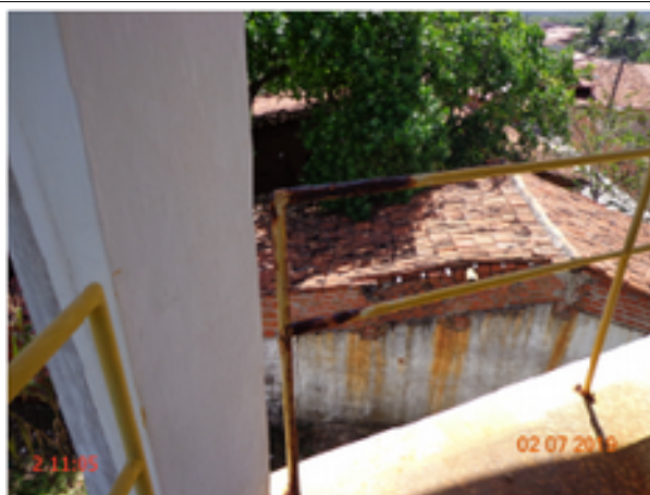
Foto 25 – REL-09 (Lambedouro): guarda-corpos em processo de corrosão.
