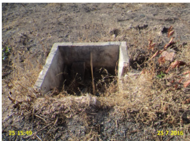
Foto 6 - RDA: registro de descarga sem tampa localizado na Rua SDO 03.
