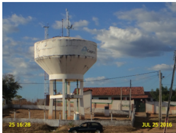
Foto 9 - REL-02: pintura deteriorada.
