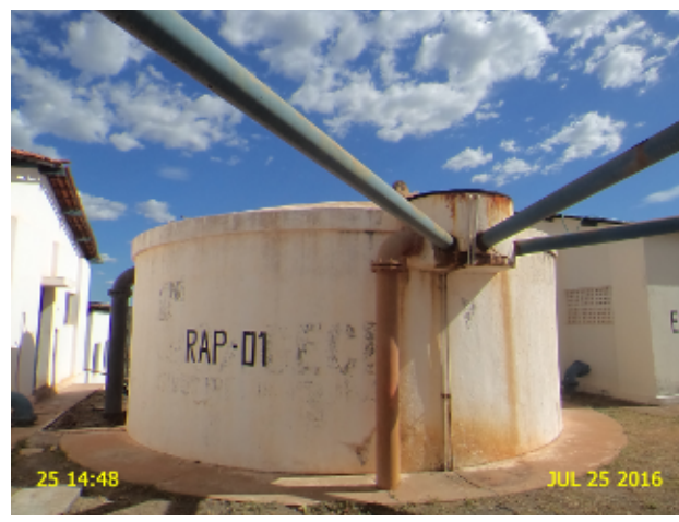
Foto 7 - RAP-01: pintura deteriorada.
