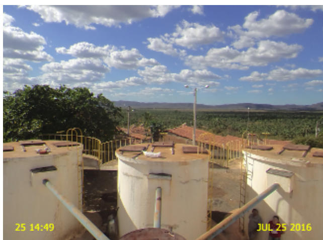
Foto 4 - As tampas dos filtros F-01, F-02 e F-03 estão em processo de corrosão.
