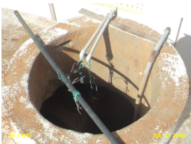
Foto 3 - RAP-01: sem tampa de inspeção.
