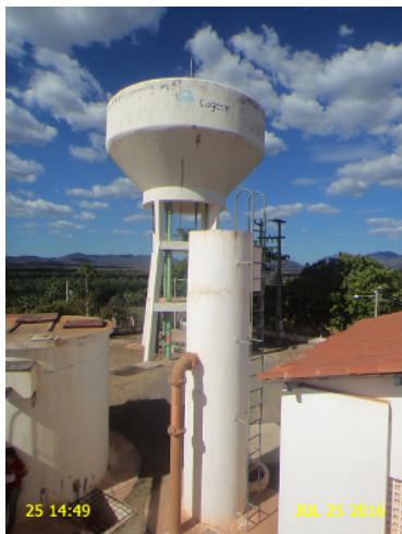
Foto 8 - REL-01: pintura deteriorada.
