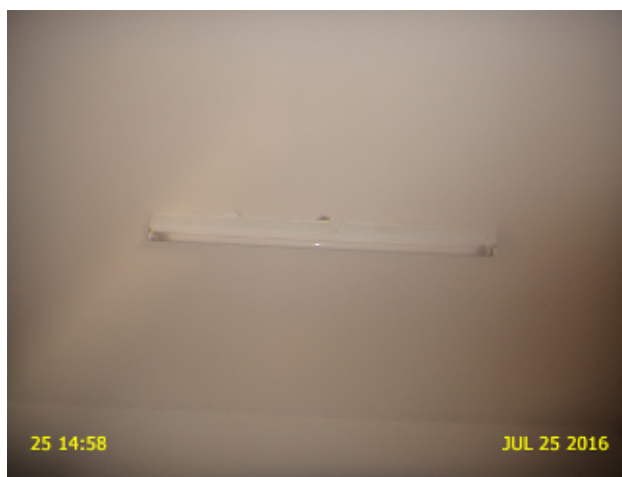
Foto 5 - EEAT-02: iluminação da casa de abrigo do QC com defeito.
