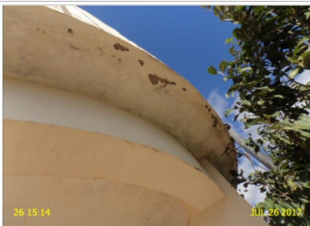
Foto 13 – REL-01(Palestina do Cariri): reboco deteriorado.
