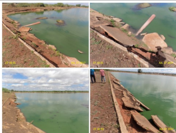
Foto 10 – ETE (Sede): taludes deteriorados.
