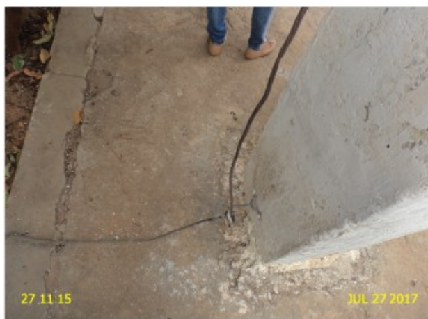
Foto 11 – REL-02 (Sede): ausência de tubo de proteção no cabo de aterramento do para raio.
