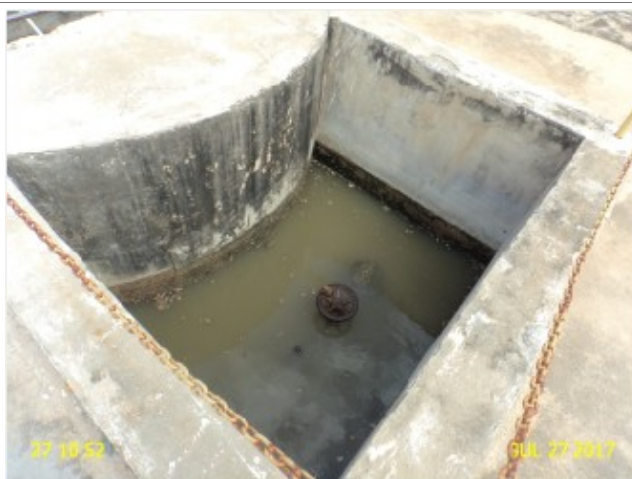
Foto 19 – EEE-01 (Sede): caixa de registros alagada.
