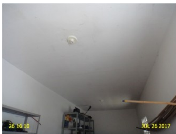
Foto 8 – Almoxarifado (Sede): ausência de lâmpadas.
