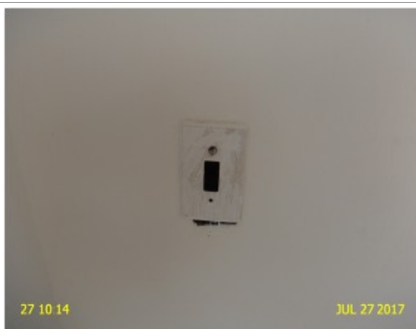
Foto 9 – ETA (Sede): ausência de interruptor para iluminação da casa de química.
