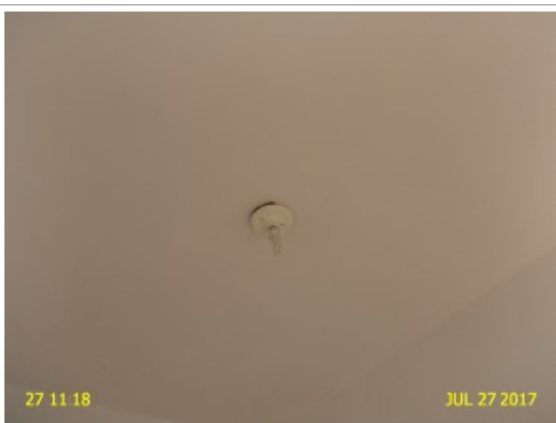
Foto 6 – PT-03 (Sede): ausência de iluminação.
