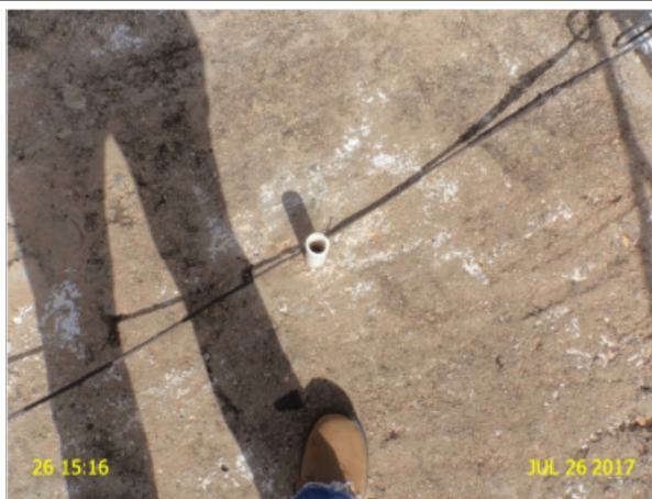
Foto 15 – REL-01(Palestina do Cariri): tubulação de ventilação sem tela de proteção.
