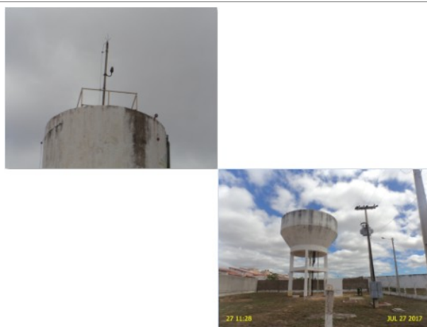
Foto 12 – REL-02 e REL-03 (Sede): pintura deteriorada.
