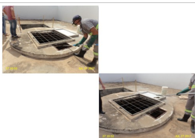
Foto 4 – EEE-01 (Sede): ausência de gradeamento. Operador retirando os sobrenadantes de forma manual.
