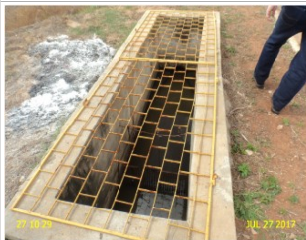
Foto 18 – ETE (Sede): caixa de areia submersa.
