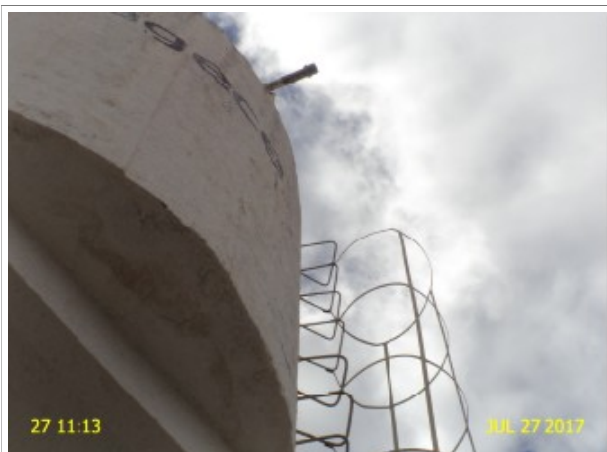
Foto 14 – REL-02 (Sede): guarda corpo somente até o penúltimo degrau.
