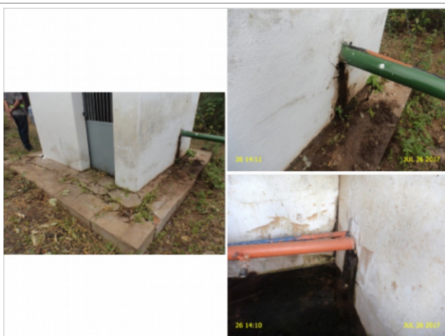
Foto 17 – PT-01(Palestina do Cariri): sinais de vazamento.
