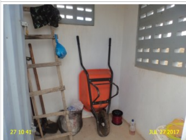
Foto 5 – ETE (Sede): casa do operador sem água para higiene e limpeza do operador.
