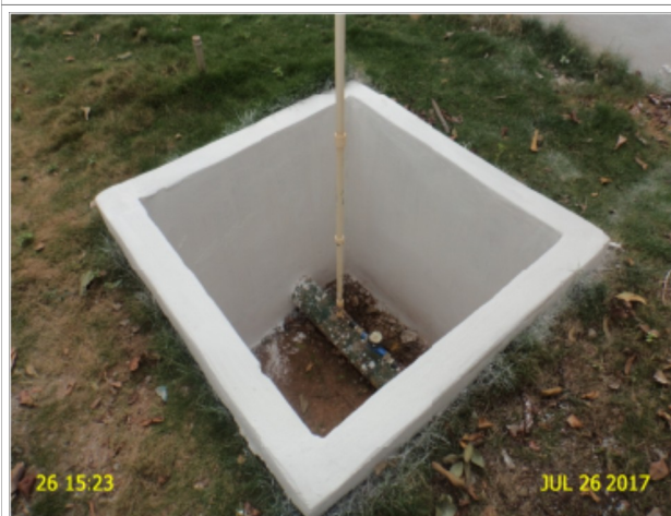
Foto 16 – ETA(Palestina do Cariri): caixa de inspeção sem tampa ou grade de proteção.
