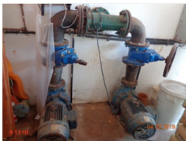
Foto 29 – EELF-01 (Sede): ausência de identificação.
