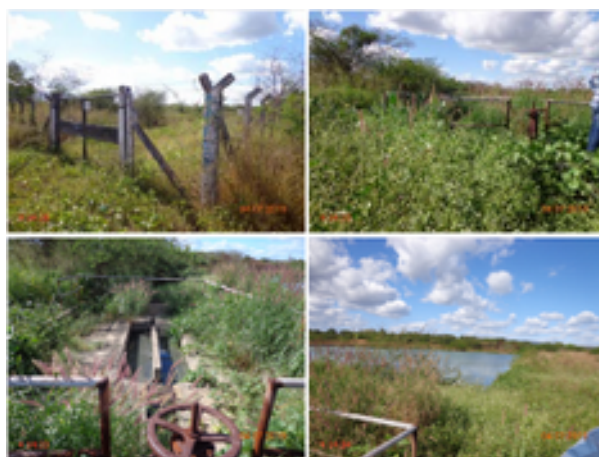
Foto 10 – ETE (Sede): sem acesso, tomada pela vegetação, condições inadequadas de conservação e limpeza.
