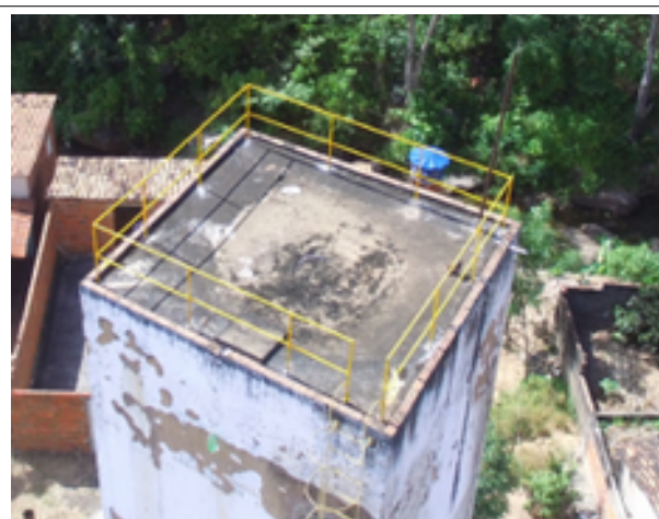
Foto 2 – REL-01 (Lapa): ausência de sinalização noturna.
