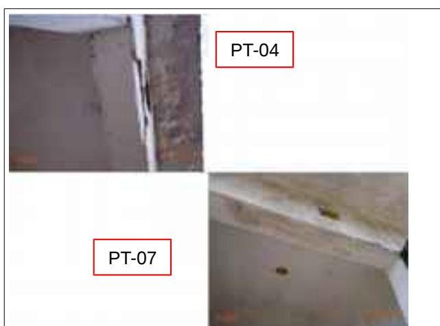
Foto 1 – PT-04 e PT-07 (Lapa): ausência de iluminação.
