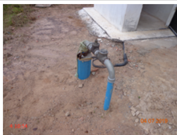
Foto 4 – PT-07 (Lapa): ausência de laje de proteção.
