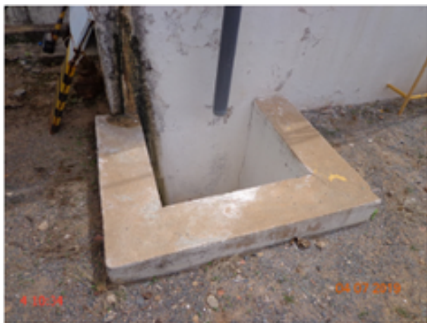
Foto 15 – RAP-01 (Lapa): caixa sem grade de proteção.
