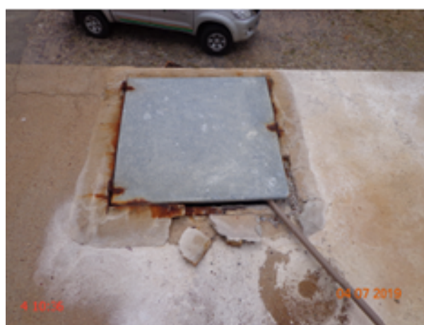
Foto 24 – RAP-01 (Lapa): tampa de inspeção sem vedação adequada
