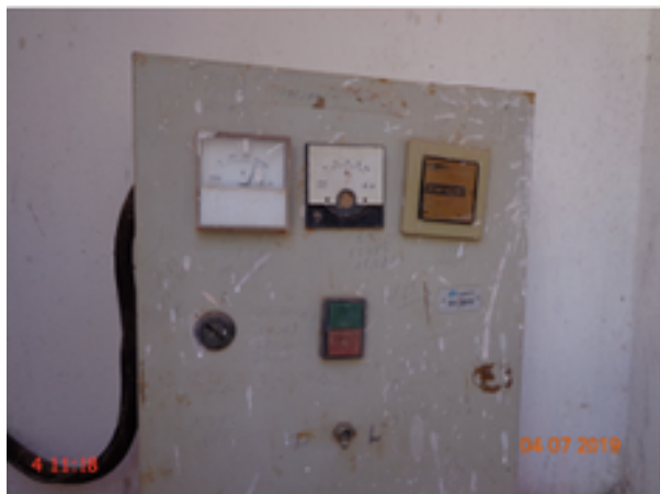
Foto 31 – PT-03 (Lapa): amperímetro quebrado.
