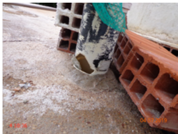
Foto 9 – RAP-01 (Lapa): tubulação de ventilação danificada.
