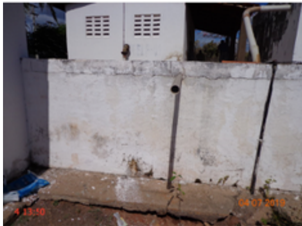
Foto 13 – RAP-03 (Sede): tubulação de ventilação sem tela de proteção.
