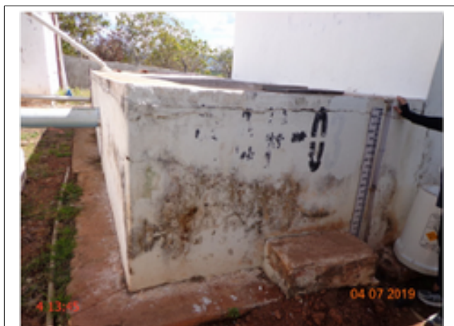
Foto 36 – RAP-03 (Sede): identificação apagada e pintura deteriorada.
