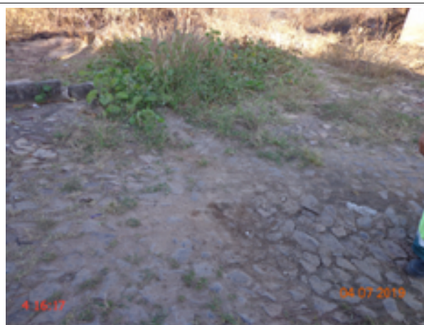
Foto 18 – RDA (Sede): registro de descarga soterrado na Av. Raimundo da Cunha Brito.
