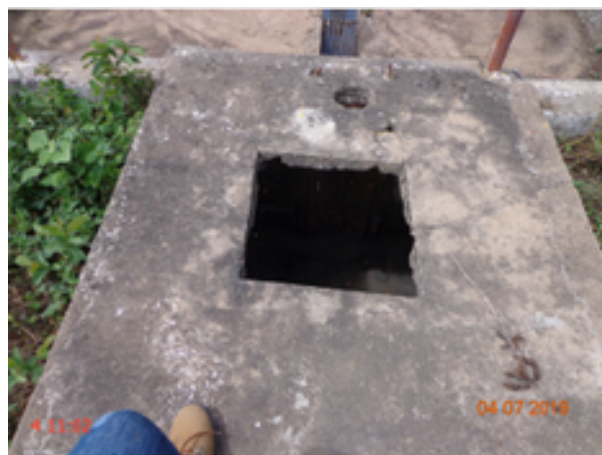
Foto 8 – ETE (Lapa): caixa de passagem sem tampa.
