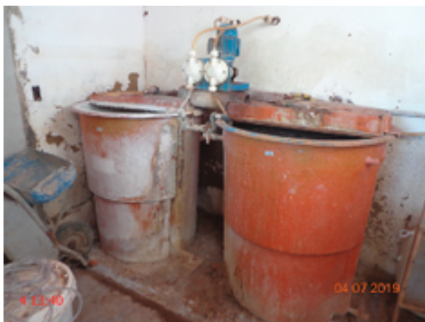
Foto 33 ETA (Sede): a casa de abrigo dos tanques de dosagem apresenta paredes com reboco deteriorado.
