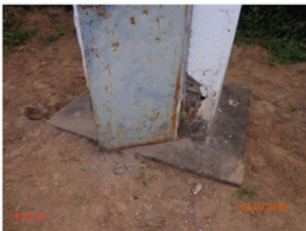
Foto 5 – PT-04 (Lapa): casa de abrigo deteriorada.
