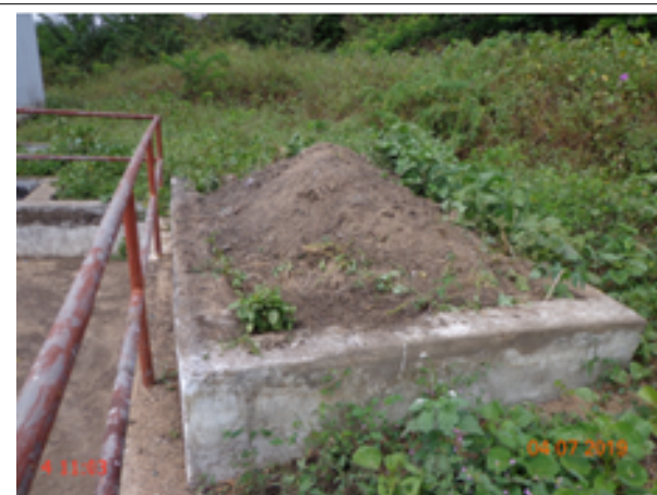
Foto 12 – ETE (Lapa): leito de secagem necessitando de limpeza.
