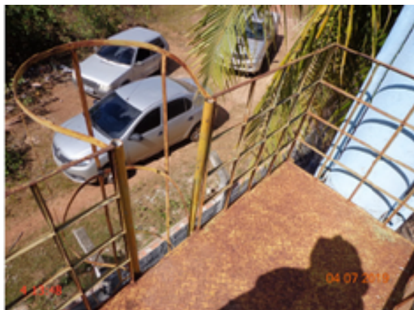
Foto 7 – F-01 (Sede): guarda-corpos em processo de corrosão.
