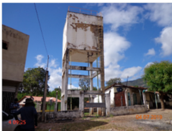
Foto 22 – REL-01 (Lapa): ausência de identificação, pintura e reboco deteriorados.
