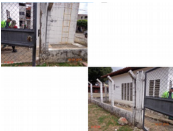
Foto 21 – RAP-01 (Lapa): cerca e muro de proteção danificados.
