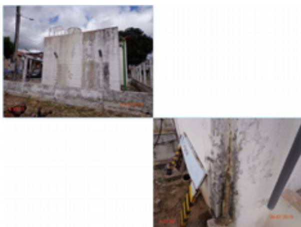
Foto 23 – RAP-01 (Lapa): pintura deteriorada e sinais de vazamento.
