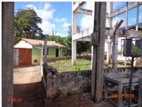
Foto 20 – REL-01 (Lapa): cerca de proteção danificada.
