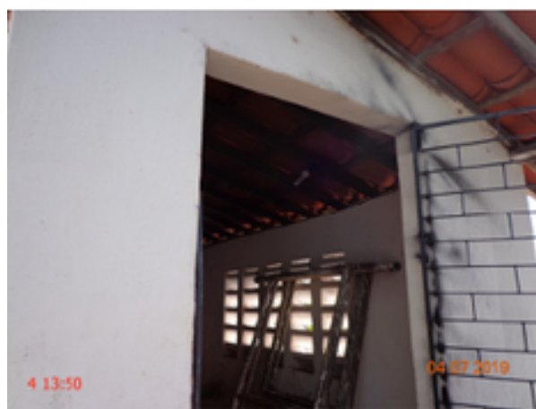
Foto 30 – EEAT-01 (Sede): ausência de identificação.
