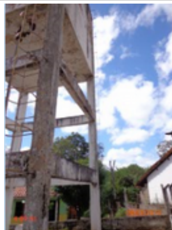
Foto 16 – REL-01 (Lapa): aterramento do para-raios sem proteção.
