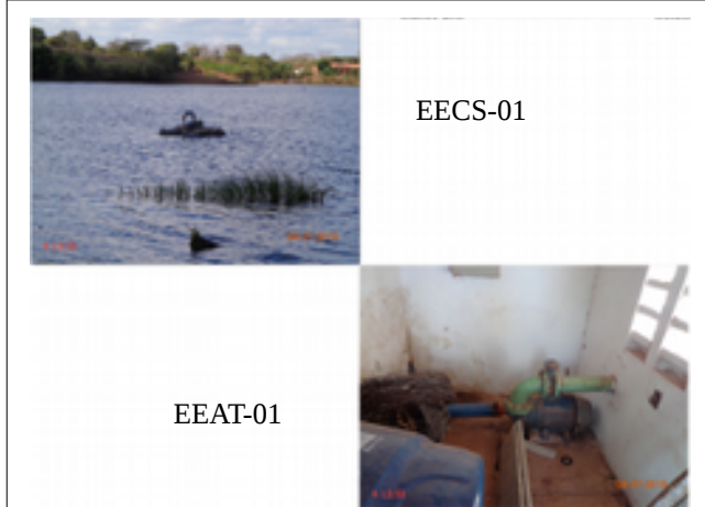
Foto 3 – EECS-01 e EEAT-01 (Sede): ausência de bomba reserva.
