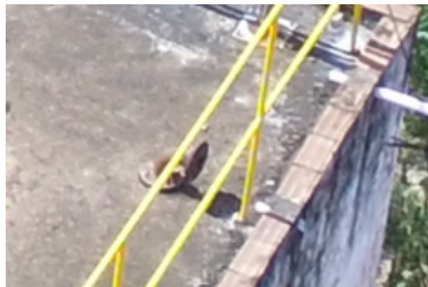
Foto 14 – REL-01 (Lapa): tubulação de ventilação sem tela de proteção.
