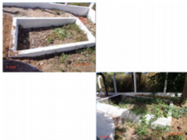
Foto 32 – EEE-01 e EEE-02 (Sede): leitos de secagem necessitando de limpeza.
