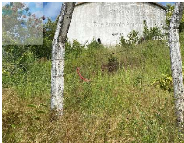
Foto 1 - RAP-02 (Sede): com cerca danificada.
