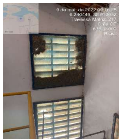
Foto 4 - ETA (Sede): casa de química em péssimo estado de conservação.
