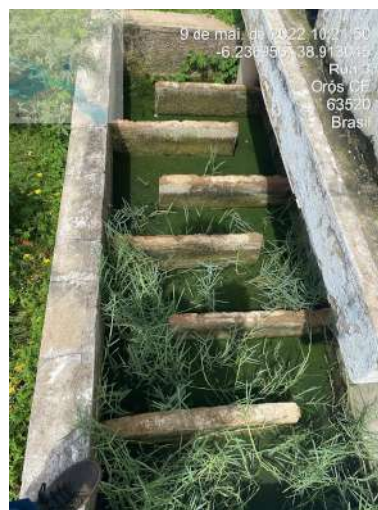
Foto 22 - ETE (Sede): estado precário.
