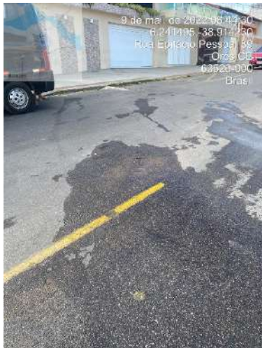
Foto 13 - RDA (Sede): vazamento na Rua Epitácio Pessoa, nº 8.
