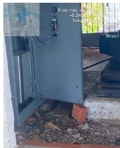
Foto 8 - ETA (Sede): Quadro de comando em péssimo estado de conservação.
