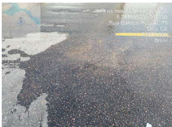
Foto 19 - RDA (Sede): vazamento na Rua da Epitácio Pessoa, nº 79.
