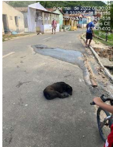
Foto 16 - RDA (Sede): vazamento na Rua Francisco do Monte, nº 354.
