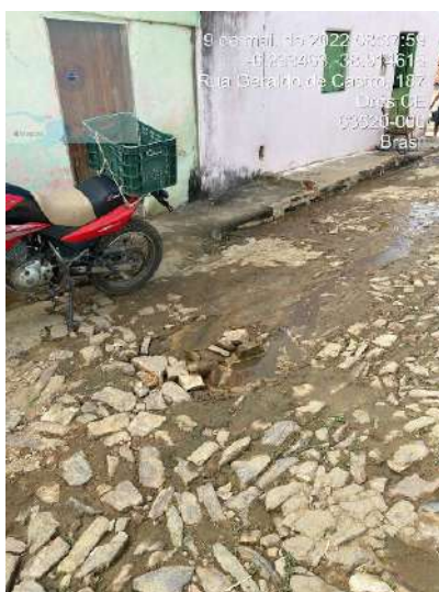
Foto 11 - RDA (Sede): vazamento na Rua Geraldo de Castro, nº 187.
