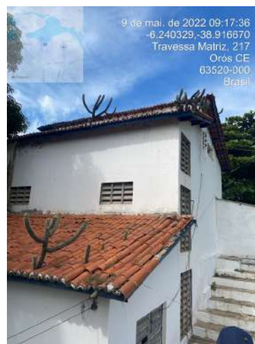
Foto 6 - ETA (Sede): casa de química em péssimo estado de conservação.
