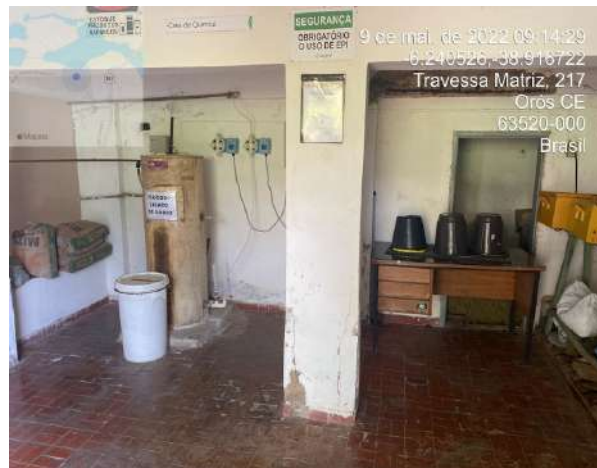
Foto 2 - ETA (Sede): casa de química em péssimo estado de conservação.
