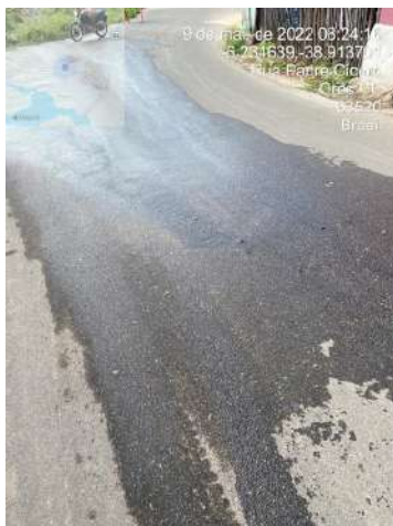
Foto 17 - RDA (Sede): vazamento na Rua Padre Cícero.
