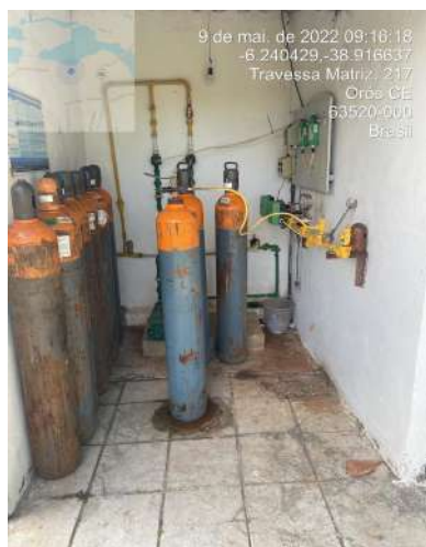
Foto 5 - ETA (Sede): casa de química em péssimo estado de conservação.
