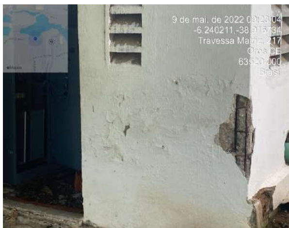
Foto 7 - ETA (Sede): casa de química em péssimo estado de conservação.
