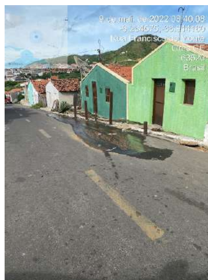
Foto 12 - RDA (Sede): vazamento na Rua Francisco do Monte.
