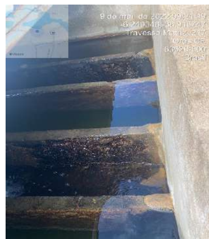
Foto 10 - Filtro da ETA (Sede): Calha com estrutura comprometida.
