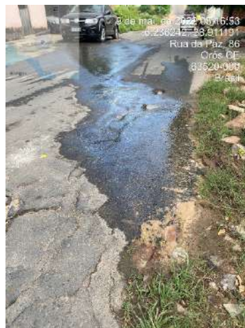
Foto 18 - RDA (Sede): vazamento na Rua da Paz, 86.
