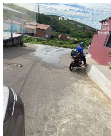
Foto 20 - RDA (Sede): vazamento na Rua Francisco do Monte.
