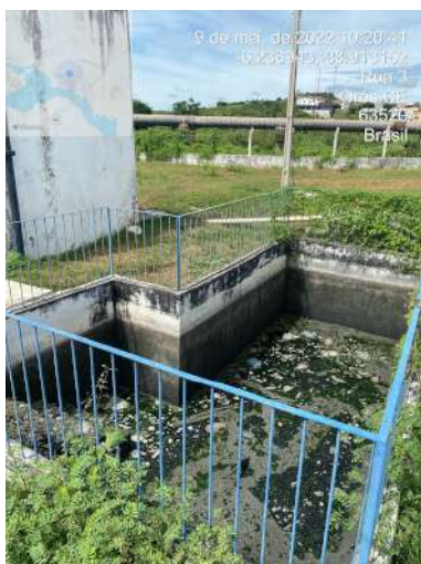
Foto 21 - ETE (Sede): estado precário.
