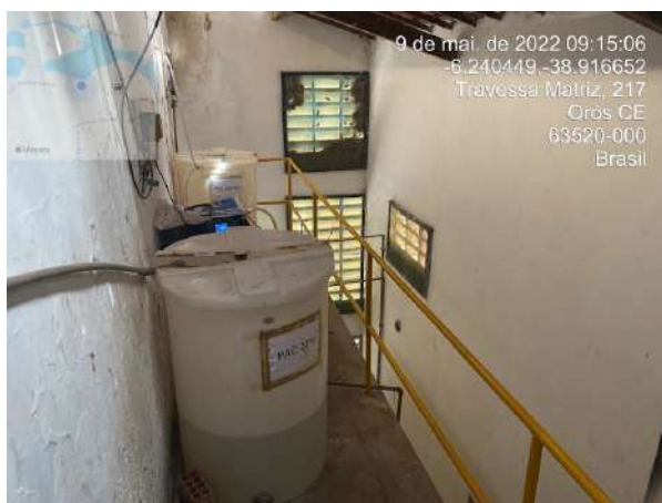
Foto 3 - ETA (Sede): casa de química em péssimo estado de conservação.
