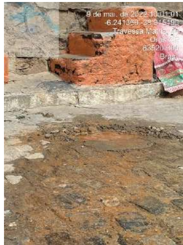
Foto 14 - RDA (Sede): vazamento na Travessa Matriz, nº 46.
