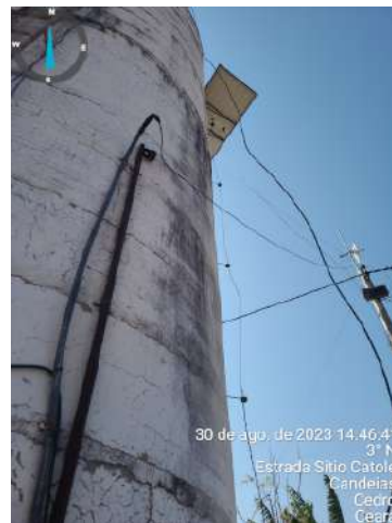
Foto 17 - REL-02 (Sede): pintura desgastada, instalações elétricas e para-raios inadequados e escada em processo de corrosão.
