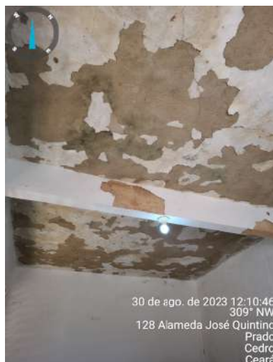
Foto 10 - EEAT-01 (Sede): reboco/pintura do teto deteriorado.
