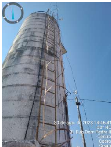
Foto 16 - REL-02 (Sede): pintura desgastada, instalações elétricas e para-raios inadequados e escada em processo de corrosão.
