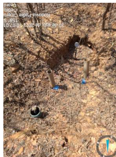
Foto 25 - REL-05 (Várzea da Conceição): medidores de pressão e registro sem caixa de proteção.
