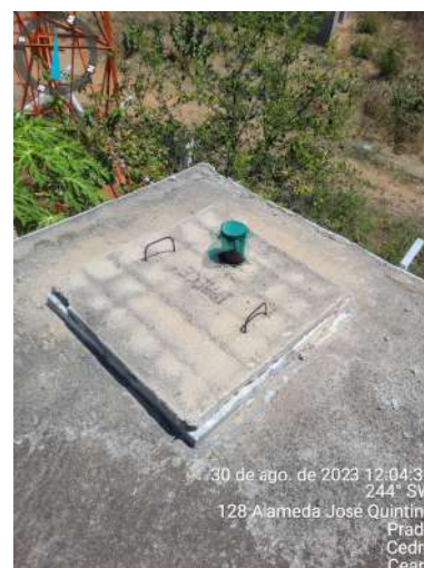
Foto 9 - RAP-01 (Sede): tubulação do respiro incorreta.
