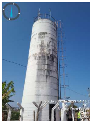
Foto 4 - REL-02 (Sede): não possui identificação.
