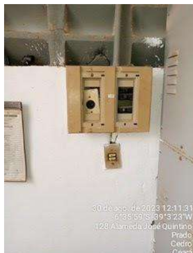
Foto 12 - EEAT-01 (Sede): quadro elétrico danificado.
