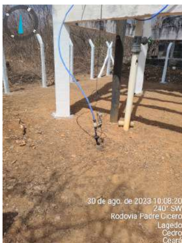
Foto 26 - REL-05 (Várzea da Conceição): medidor de pressão e tubulação inadequados.
