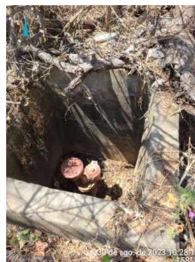
Foto 31 - RAP-02 / REL-03 e REL-04 (Várzea da Conceição): ventosa com caixa sem tampa.
