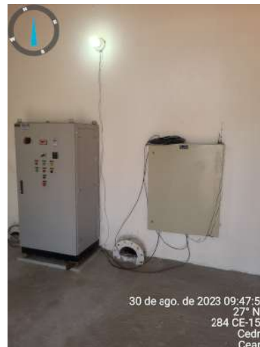
Foto 23 - EEAT-04 (Várzea da Conceição): instalações elétricas inadequadas.
