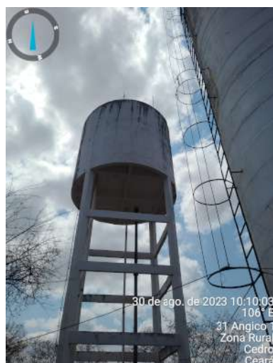
Foto 5 - REL-05 (Várzea da Conceição): não possui identificação e ausência de guarda-corpo na cobertura.
