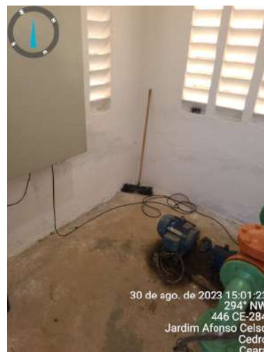
Foto 19 - EERD-01 (Sede): bomba com vazamento.
