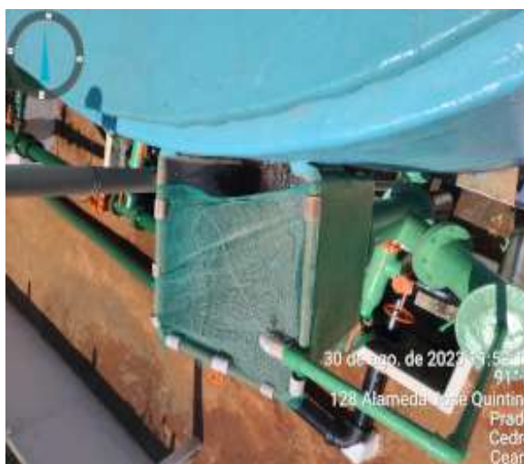
Foto 3 - ETA (Sede): os 3 filtros não possuem vedação na saída da tubulação.
