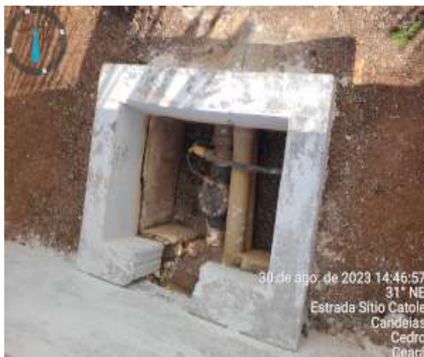
Foto 18 - REL-02 (Sede): caixa sem tampa .
