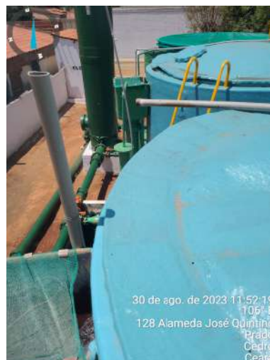
Foto 2 - ETA (Sede): filtro F-03 sem tampa e todos os 3 filtros não possuem vedação na saída da tubulação.
