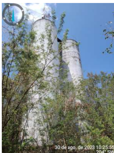
Foto 30 - RAP-02 / REL-03 e REL-04 (Várzea da Conceição): infraestruturas desativadas e sem infraestrutura de proteção e isolamento.
