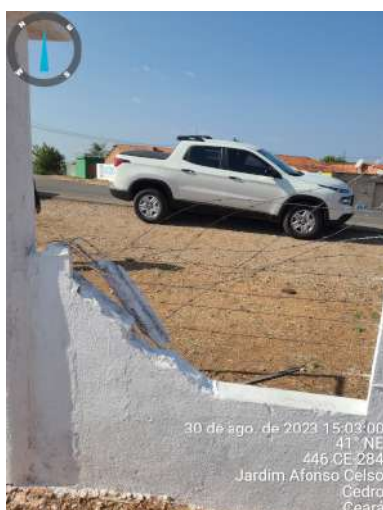
Foto 20 - EERD-01 (Sede): cerca danificada.
