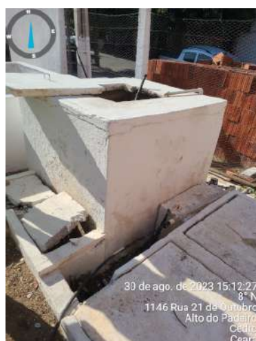
Foto 32 - ETE-01: caixa com tampas deterioradas.
