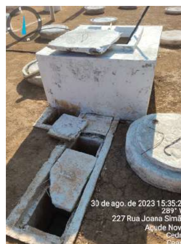
Foto 33 - ETE-05: caixas com tampas deterioradas.
