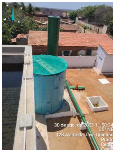
Foto 1 - ETA (Sede): filtro F-03 sem tampa.
