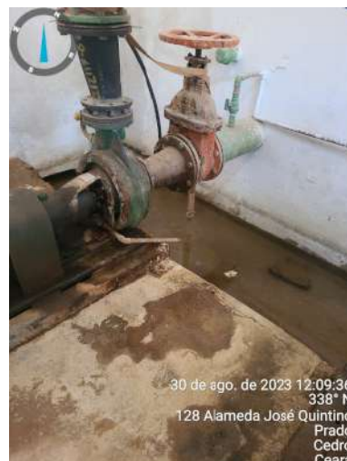
Foto 11 - EEAT-01 (Sede): área de drenagem empoçada.
