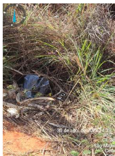
Foto 15 - Adutora (sede): dispositivo na adutora próximo a TAUs não possui caixa de proteção
