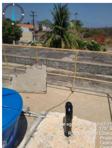
Foto 8 - RAP-01 (Sede): tampas sem vedação e instalações elétricas inadequadas
