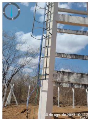
Foto 27 - REL-05 (Várzea da Conceição): fiações elétricas presos às escadas.
