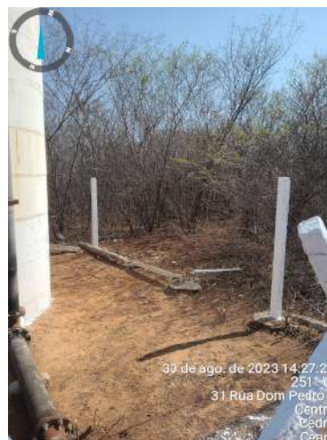
Foto 13 - TAU-02 e 03 (Sede): infraestrutura desativada e com cerca de proteção e isolamento em estado precário de conservação.
