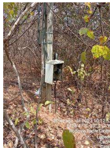
Foto 29 - REL-05 (Várzea da Conceição): caixa do medidor de energia elétrica sem tampa.
