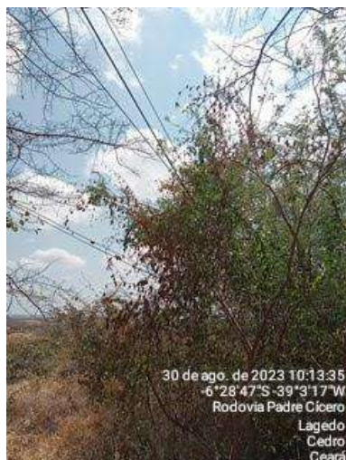
Foto 28 - REL-05 (Várzea da Conceição): cabos de alimentação elétrica com galhos sobre os mesmos.
