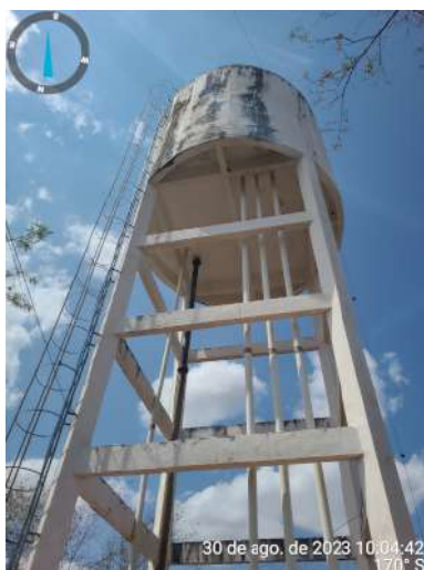
Foto 24 - REL-05 (Várzea da Conceição): pintura desgastada, fiações elétricas e cabo do para-raios inadequados.
