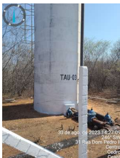
Foto 14 - TAU-02 e 03 (Sede): infraestrutura desativada e com cerca de proteção e isolamento em estado precário de conservação.
