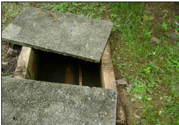
Foto 21 – Estação pitométrica localizada na chegada da ETA.
