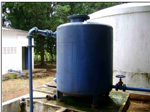
Foto 11 – ETA: filtro desativado.
