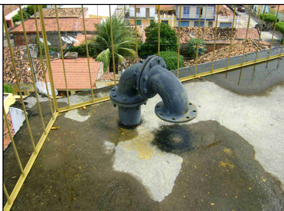
Foto 37 – REL-01: sem tela de proteção de tubulação de ventilação e com guarda-corpo na laje superior.
