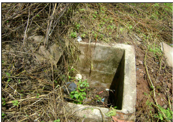
Foto 24 – Caixa de proteção da ventosa, localizada entre a ETA e o REL-01.
