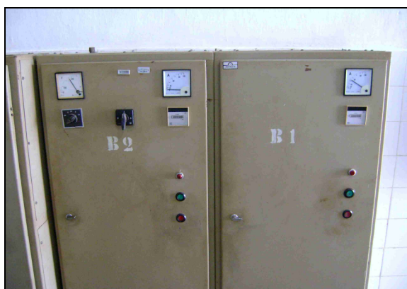
Foto 30 – Quadro de comando da EEAT-01.
