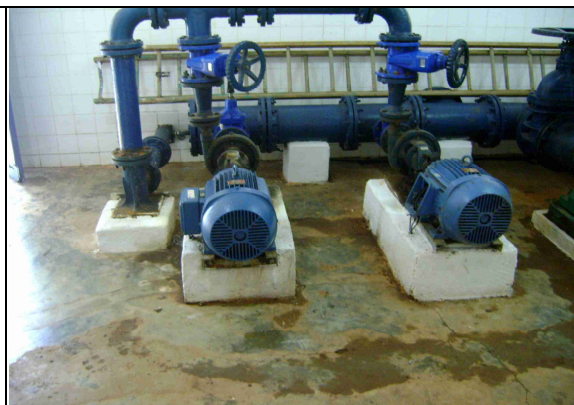
Foto 27 – Conjunto moto-bomba da EELF-01.
