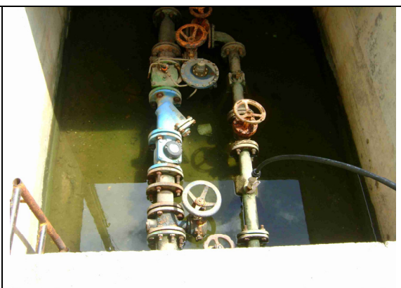
Foto 25 – Macromedidor localizado na chegada do REL-02.
