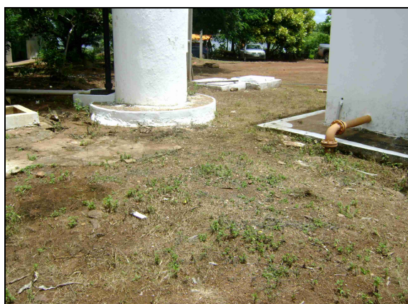
Foto 8 – ETA: ausência de calçamento entre as unidades de reservação e tratamento.
