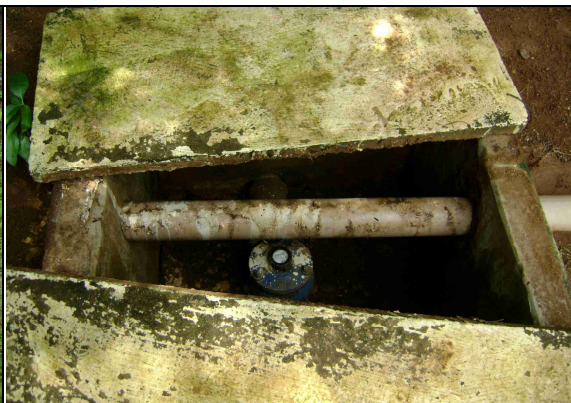
Foto 23 – Macromedidor localizado na saída da EEAT-01.
