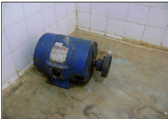
Foto 26 – Bomba reserva da EECS-01.
