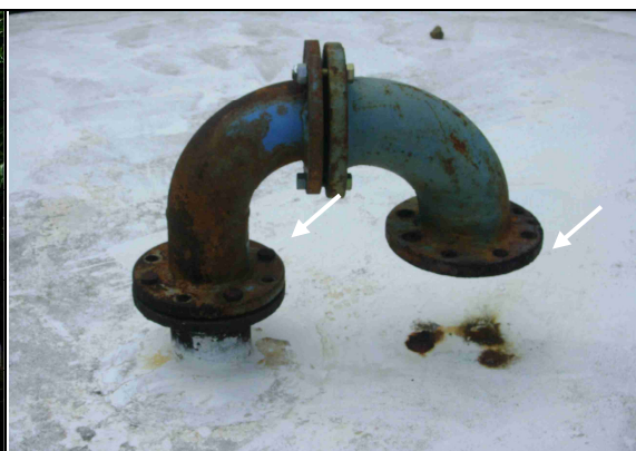
Foto 32 – RAP-01: Tubulação de ventilação sem tela de proteção.
