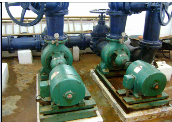
Foto 29 – Conjunto moto-bomba da EEAT-01.
