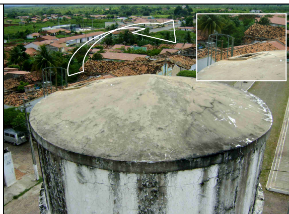
Foto 34 – REL-01: sem tampa de inspeção e guarda-corpo na laje superior.
