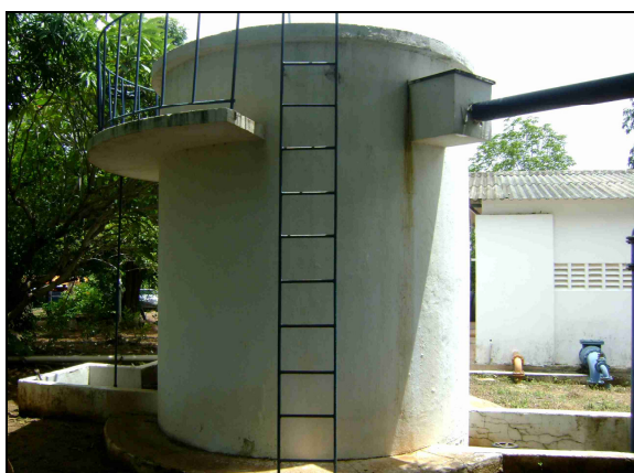
Foto 9 – ETA: filtro sem identificação.
