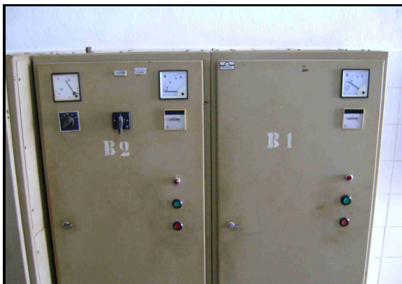
Foto 28 – Quadros de comando das EEAT-02 e EEAT-03.
