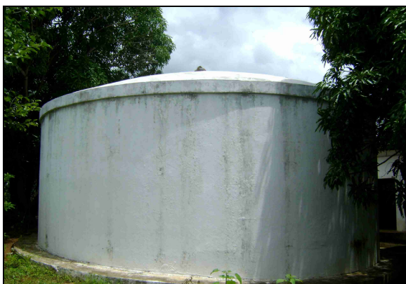
Foto 31 – RAP-01: necessitando de identificação.
