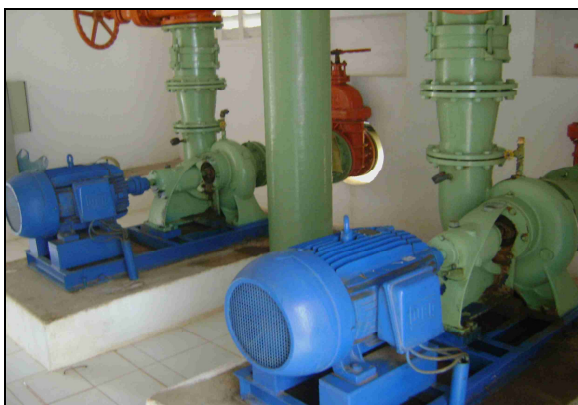
Foto 38 – EELF-01: Conjuntos moto-bomba.
