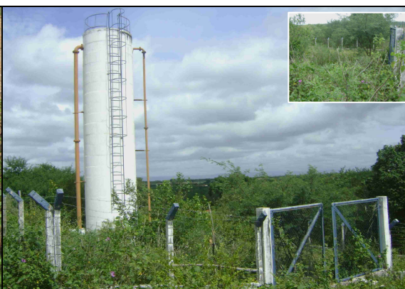
Foto 34 – Torre de equilíbrio 01: Sem identificação e área tomada pela vegetação
