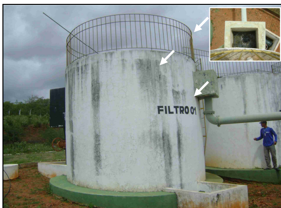
Foto 5 – Filtro 01: Pintura deteriorada, ausência de tampa de proteção na caixa de saída da água tratada, existência de identificação e guarda-corpo.
