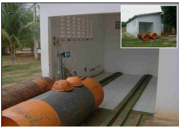
Foto 29 – Cilindro de cloro em área descoberta e com incidência direta da luz solar.
