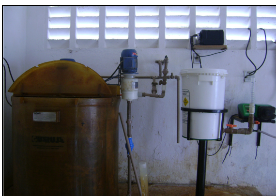
Foto 27 – Tanques de mistura de produtos químicos.
