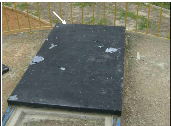
Foto 16 – Filtro 06: Tampa de inspeção adequada.
