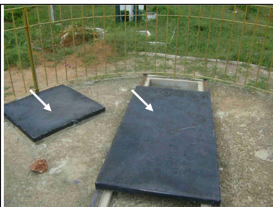
Foto 6 – Filtro 01: Tampas de inspeção adequadas.
