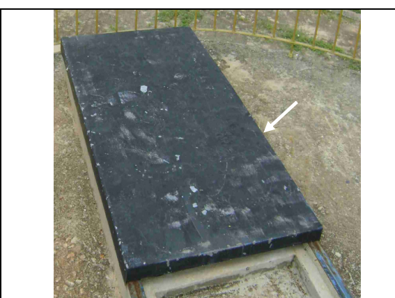
Foto 12 – Filtro 04: Tampa de inspeção adequada.
