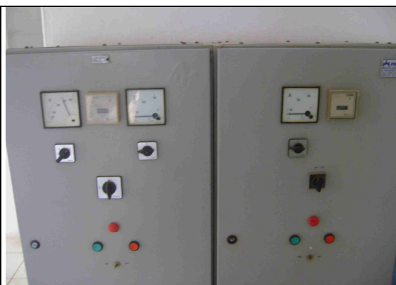
Foto 39 – EELF-01: Quadro de comando.
