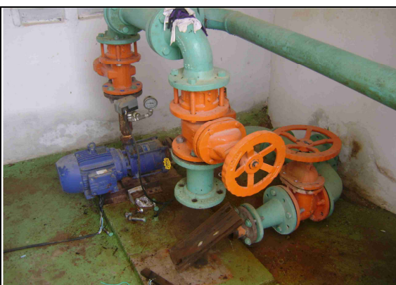
Foto 41 – EERD-01: Conjunto moto-bomba sem bomba reserva.
