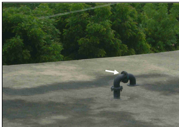
Foto 48 – RAP-02 Tubulação de ventilação com tela de proteção.
