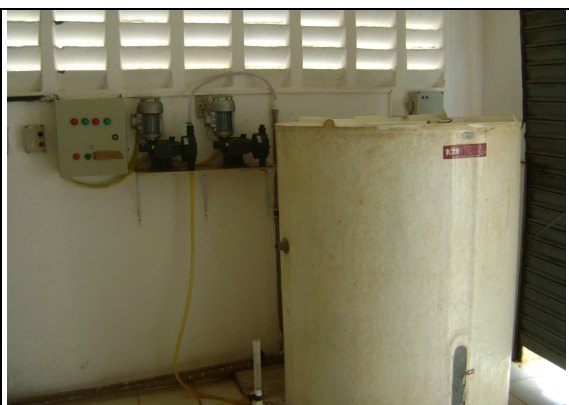
Foto 26 – Dosador de flúor.
