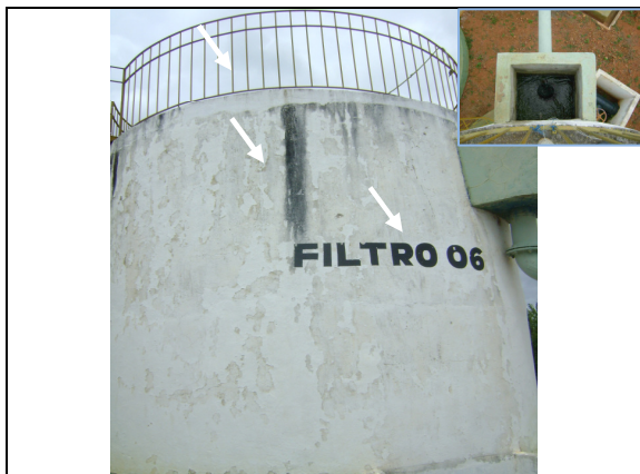
Foto 15 – Filtro 06: Pintura deteriorada, ausência de tampa de proteção na caixa de saída da água tratada, existência de identificação e guarda-corpo.
