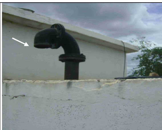
Foto 50 – RSE-01: Ausência de tela de proteção na tubulação de ventilação.
