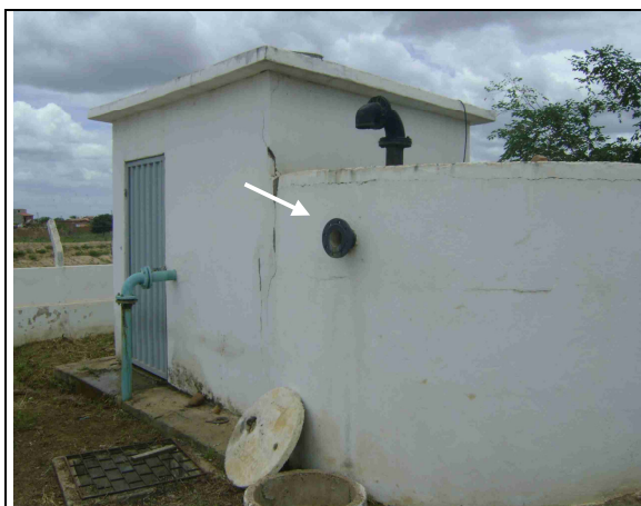
Foto 49 – RSE-01: Ausência de identificação e de tela de proteção no extravasor.
