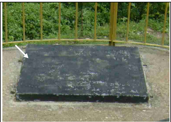
Foto 14 – Filtro 05: Tampa de inspeção adequada.
