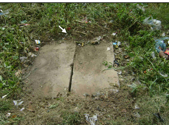
Foto 60 – Registro de descarga localizada na Rua Dr. José Maria Leitão.
