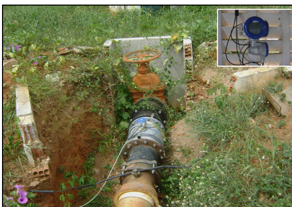
Foto 31 – Macromedidor de água bruta, localizado na entrada da ETA, sem caixa de proteção.
