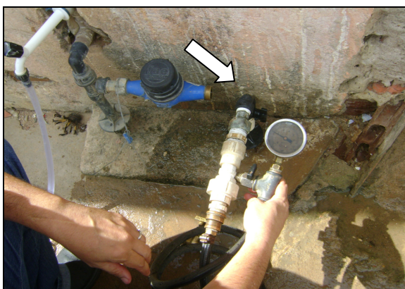
Foto 61 – Medição de pressão na Rua São Domingos, nº 142, Bairro Açude Oriente II, antes do hidrômetro.
