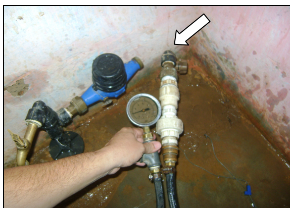
Foto 67 – Medição de pressão na Rua Dr. José Maria Leitão, nº 1.670, (Saída para Tauá), antes do hidrômetro.
