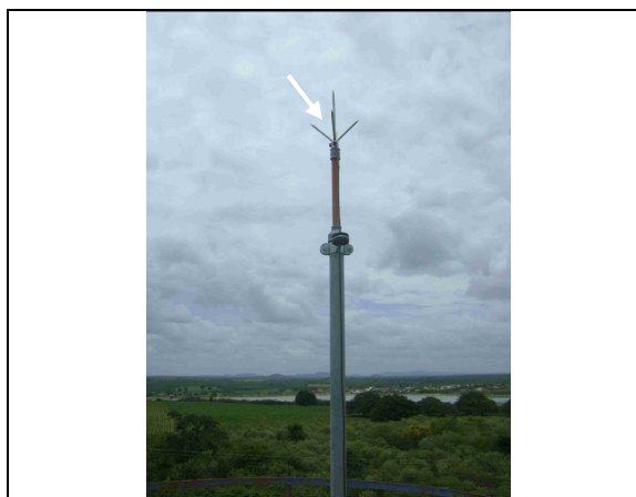
Foto 54 – REL-01: Existência de pára-raio.
