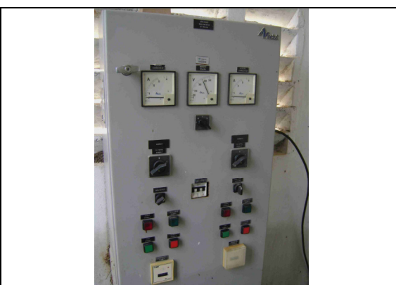
Foto 43 – EERD-01: Quadro de comando.
