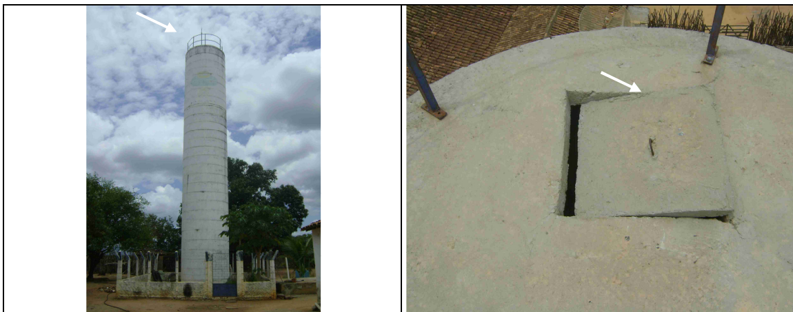
Foto 52 – REL-01: Ausência de identificação e existência de guarda-corpo na laje superior.
