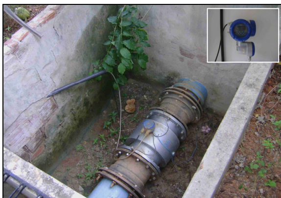
Foto 35 – Macromedidor de água tratada, localizado na saída da ETA.
