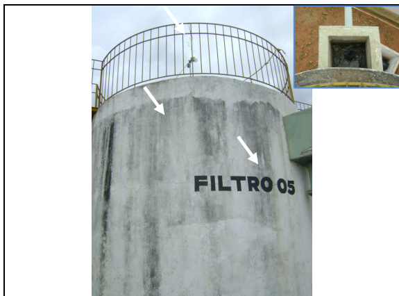
Foto 13 – Filtro 05: Pintura deteriorada, ausência de tampa de proteção na caixa de saída da água tratada, existência de identificação e guarda-corpo.
