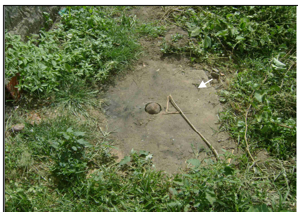
Foto 59 – Registro de descarga localizada na Estrada para Crateús (Delegacia).
