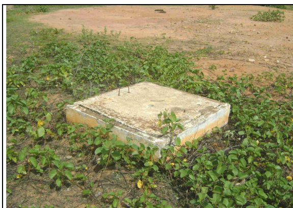
Foto 33 – Caixa de proteção de ventosa.
