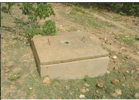
Foto 32 – Caixa de proteção de ventosa.
