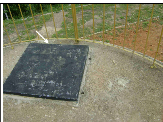
Foto 10 – Filtro 03: Tampa de inspeção adequada.
