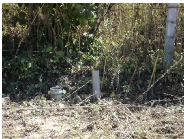
Foto 38 – Rede de distribuição: registro de
