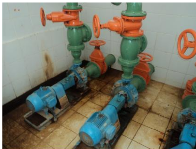
Foto 20 – EEAT: conjunto moto-bomba.
