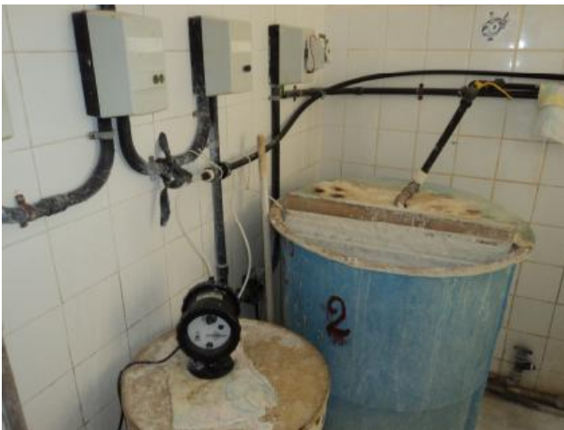
Foto 12 – Casa de química: tanques dosadores.
