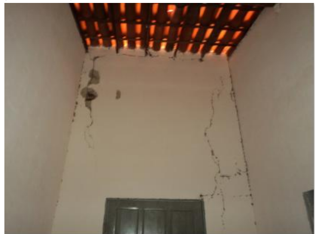
Foto 13 – Casa de química: paredes com rachaduras.
