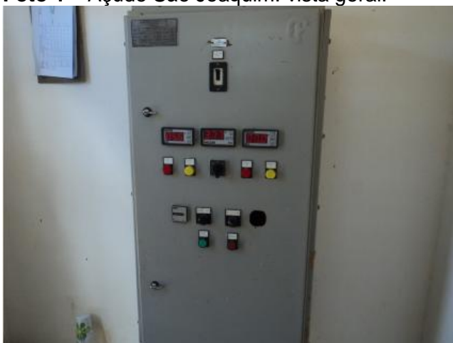
Foto 3 – Açude São Joaquim: quadro de comando.
