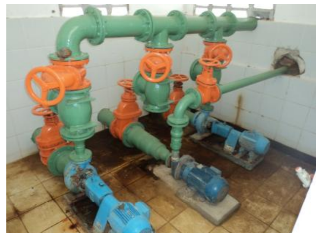
Foto 21 – EELF: conjunto moto-bomba.
