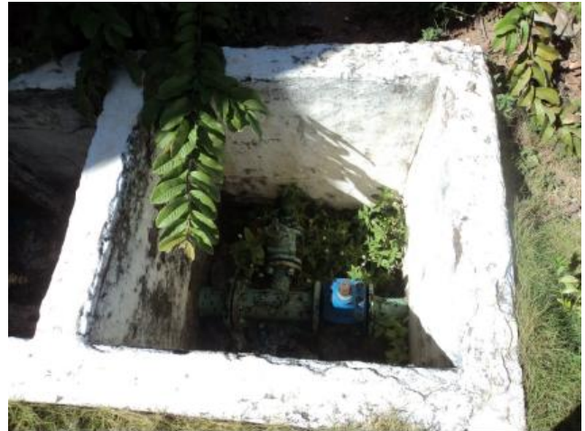
Foto 29 – REL-01: registro sem grade de proteção e coberto por vegetação.
