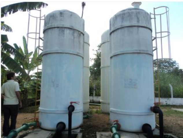
Foto 8 – Filtros: identificação apagada.
