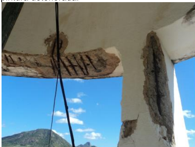
Foto 26 – REL-01: armações expostas.
