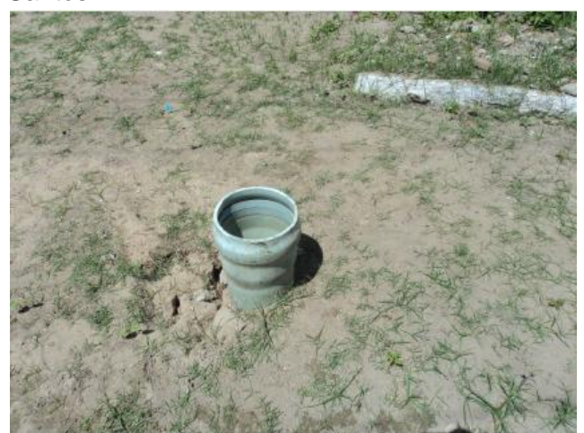
Foto 39 – Rede de distribuição: registro de
