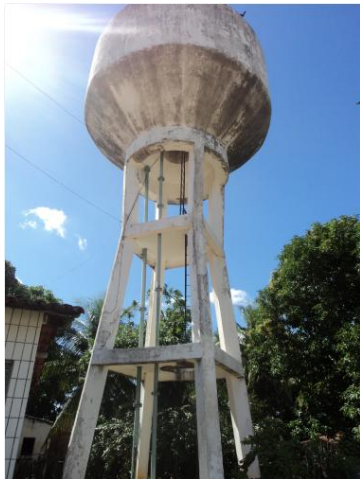
Foto 24 – REL-01: ausência de identificação e pintura deteriorada.
