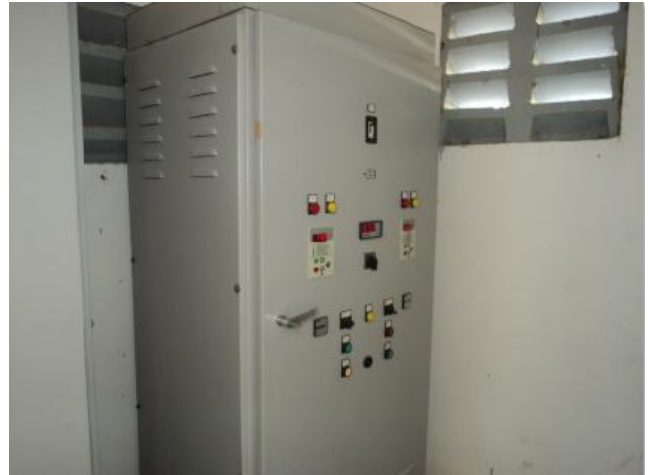
Foto 23 – EE: quadro de comando.
