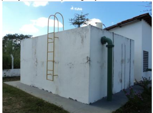
Foto 31 – RAP-01: ausência de identificação.
