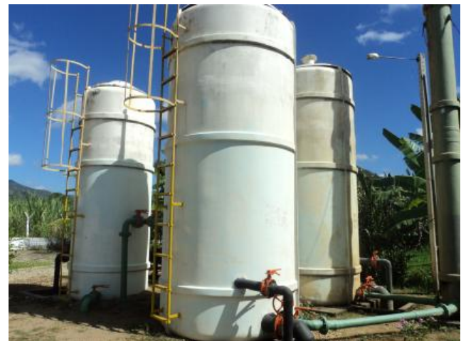
Foto 7 – Filtros: escada de acesso.
