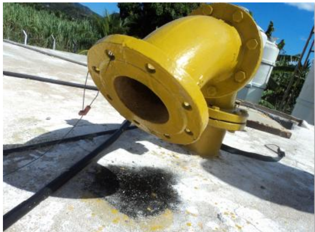
Foto 33 – RAP-01: sem tela de proteção.
