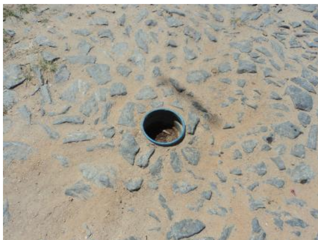
Foto 36 – Rede de distribuição: registro de descarga sem caixa na Rua Raimundo Marques.
