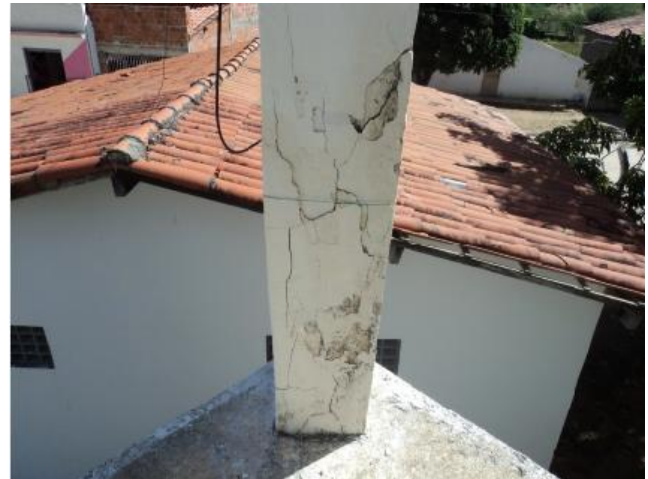
Foto 25 – REL-01: estrutura deteriorada.
