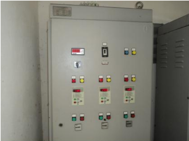
Foto 22 – EE: quadro de comando.
