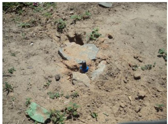
Foto 37 – Rede de distribuição: registro de descarga sem caixa na Rua Ant. Quinto dos Santos
