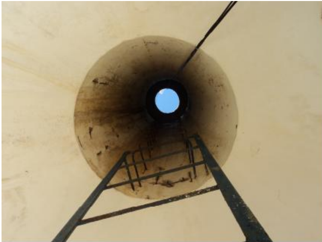
Foto 28 – REL-01: sem tampa de inspeção.
