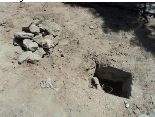
Foto 42 – Rede de distribuição: registro de descarga sem caixa na Rua Porfírio Alves Sales.
