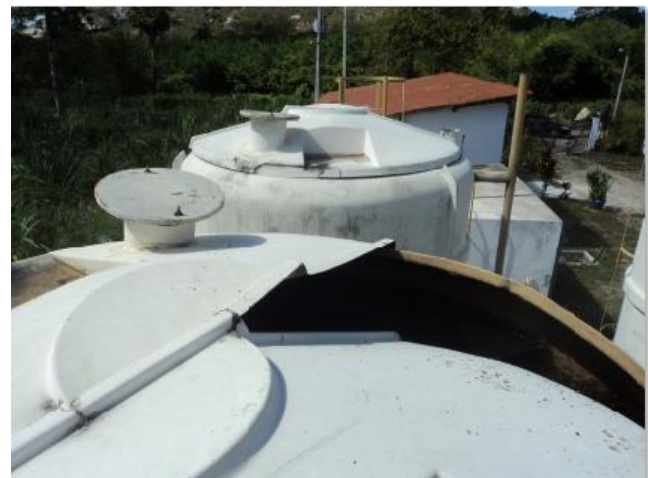
Foto 9 – Filtros 1 e 2: vista superior-tampa do Filtro 1 aberta.
