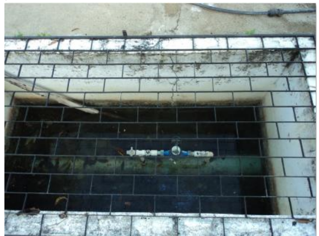
Foto 19 – ETA: medidor proporcional com vazamento- caixa de proteção com acúmulo de água
