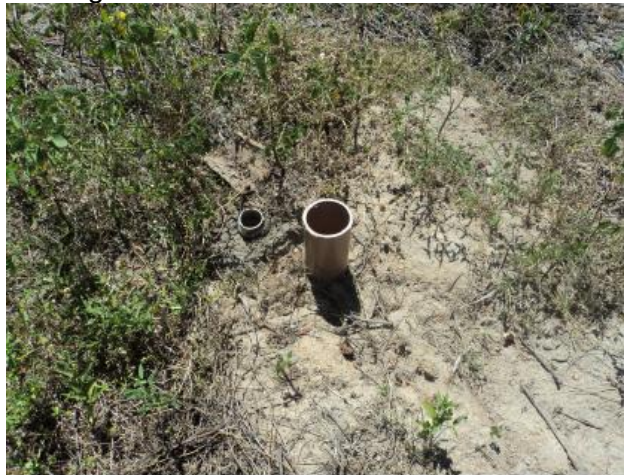
Foto 41 – Rede de distribuição: registro de descarga sem caixa na Rua Maria Felix.
