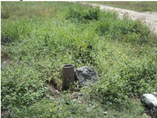
Foto 40 – Rede de distribuição: registro de descarga sem caixa na Rua Sansão Moura.
