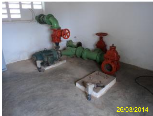
Foto 43 – EEAT-04: conjunto moto-bomba sem reserva.
