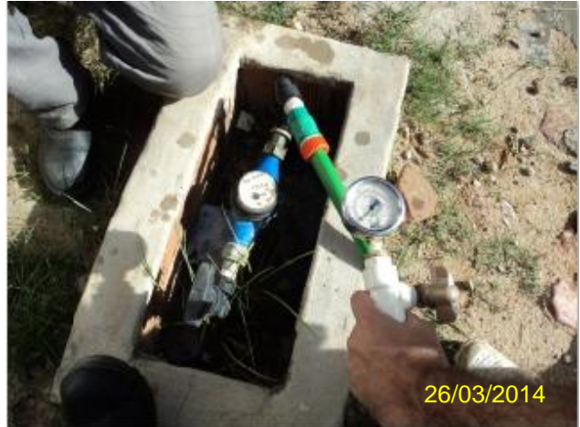
Foto 89 – RDA: medição instantânea de pressão na R. Lampião, nº 131 – Bairro Pedreira.
