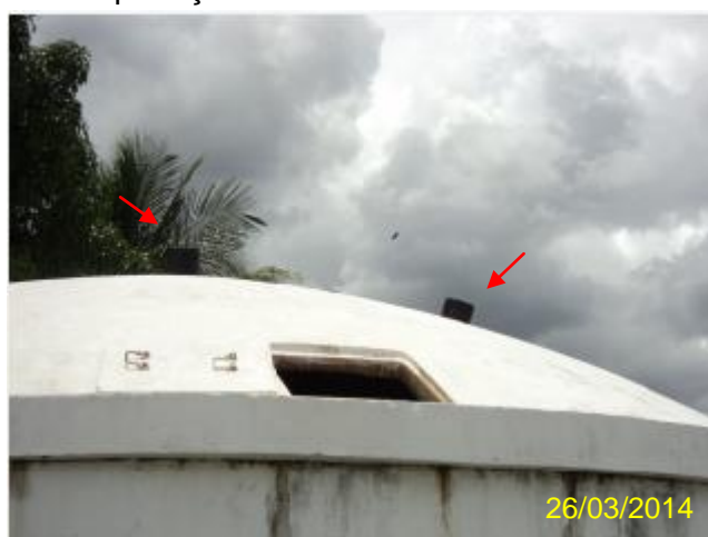
Foto 60 – RAP-03: tampa de inspeção aberta e tubulações de ventilação.
