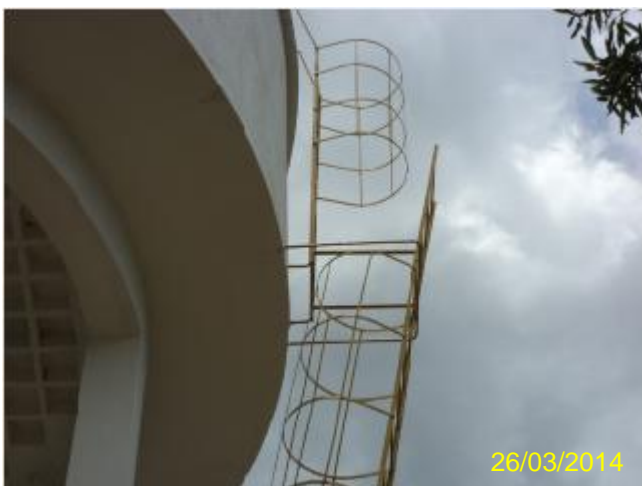
Foto 71 – REL-01: ausência de plataforma para acessar o terceiro nível de escada.
