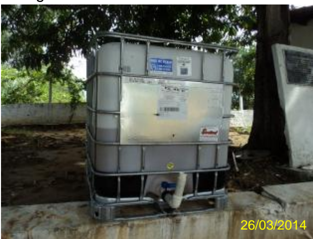
Foto 16 – Casa de química: armazenamento de produtos químicos.
