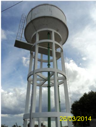
Foto 77 – REL-03: ausência de identificação.
