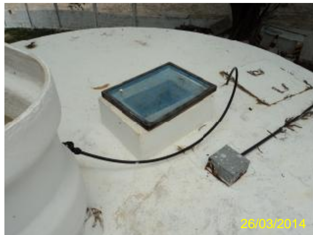
Foto 52 – CPA-01: tampa de inspeção inadequada.
