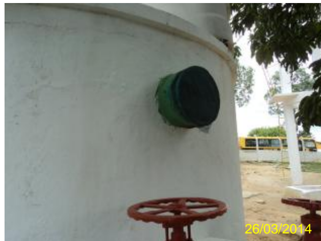
Foto 58 – RAP-03: tubulação de ventilação com tela de proteção.
