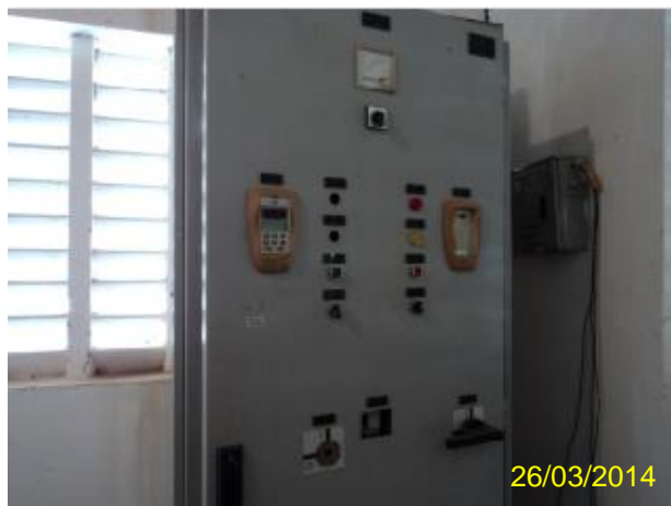
Foto 32 – EEAB-01: quadro de comando.
