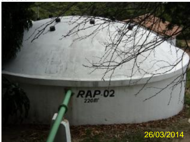
Foto 55 – RAP-02: identificação, ausência de escada de acesso e medidor de nível.
