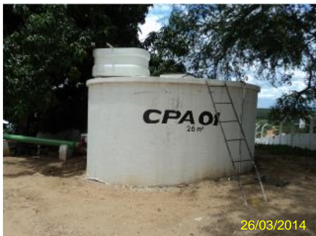
Foto 51 – CPA-01: identificação e escada de acesso.
