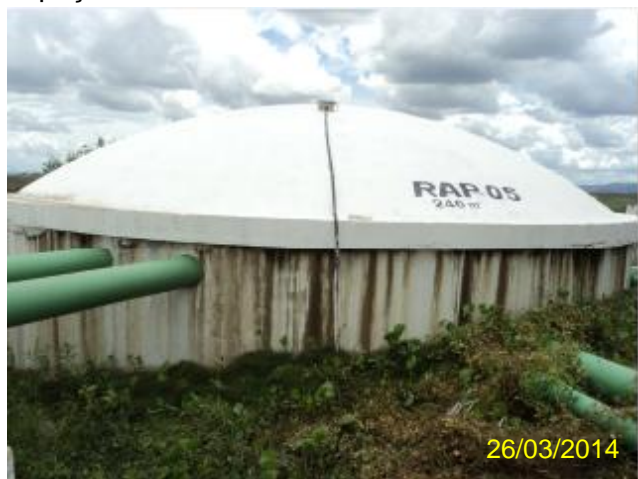
Foto 65 – RAP-05: identificação, pintura deteriorada .
