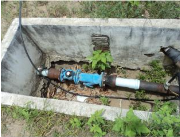
Foto 28 – AAT: macromedidor sem tampa ou grade.
