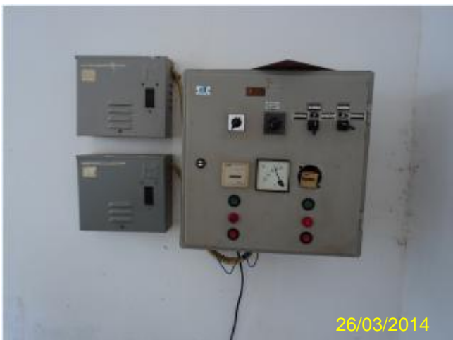
Foto 48 – EEAT-05: quadro de comando
