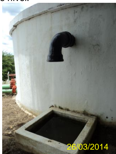
Foto 61 – RAP-03: tubo extravasor.
