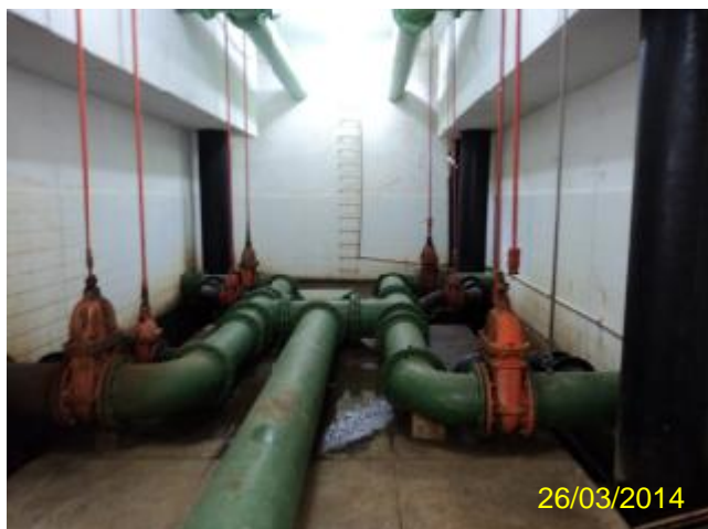
Foto 11 – Filtração: tubulações registros.
