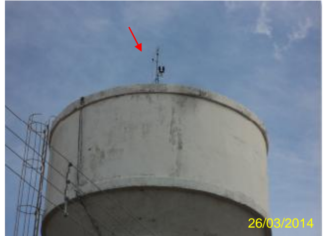
Foto 80 – REL-03: para-raios, sinalização noturna e ausência de guarda-corpo na laje de cobertura.
