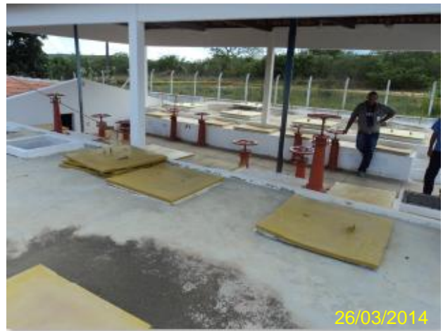
Foto 6 – Filtração: vista geral.
