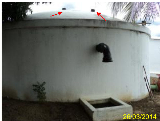
Foto 64 – RAP-04: tubo extravasador e tubulações de ventilação.
