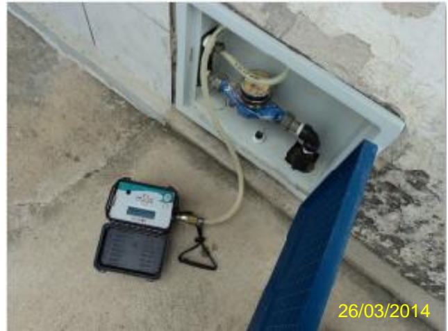
Foto 93 – RDA: medição contínua de pressão na R. do Lampião, nº 57 – Pedreira.
