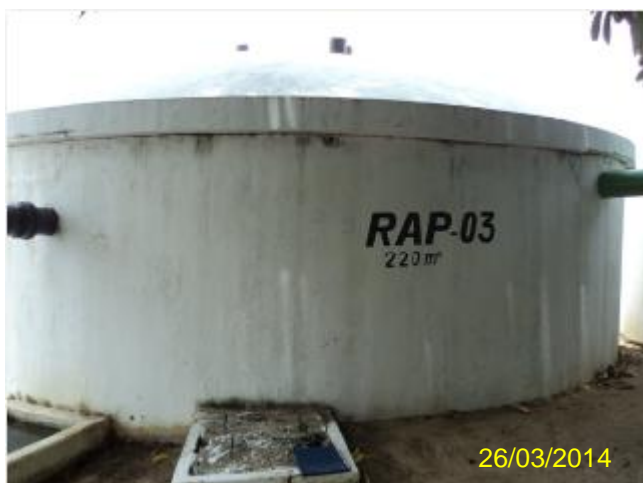
Foto 59 – RAP-03: identificação e ausência de medidor de nível.
