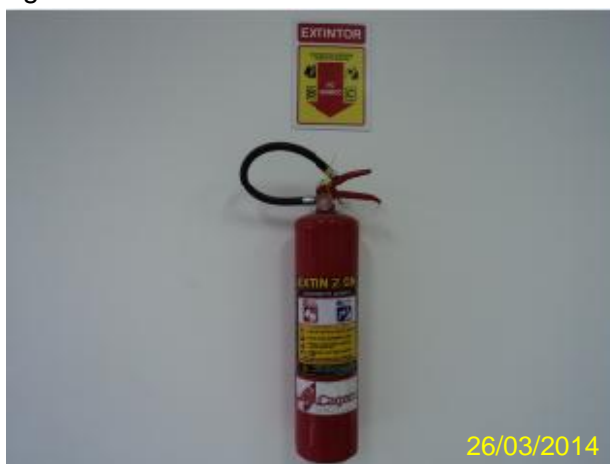
Foto 109 – Loja de atendimento: extintor de incêndio dentro do prazo de validade.
