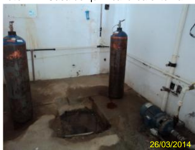
Foto 14 – Casa de química: sistema de dosagem de cloro.
