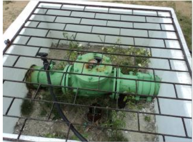
Foto 29 – AAT: válvula de retenção.
