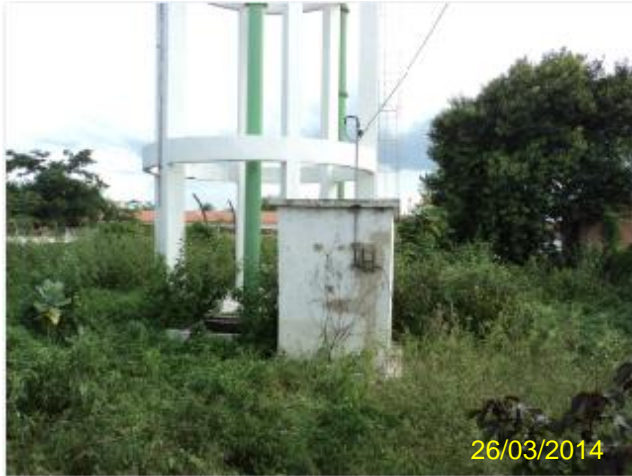
Foto 79 – REL-03: área tomada pela vegetação.
