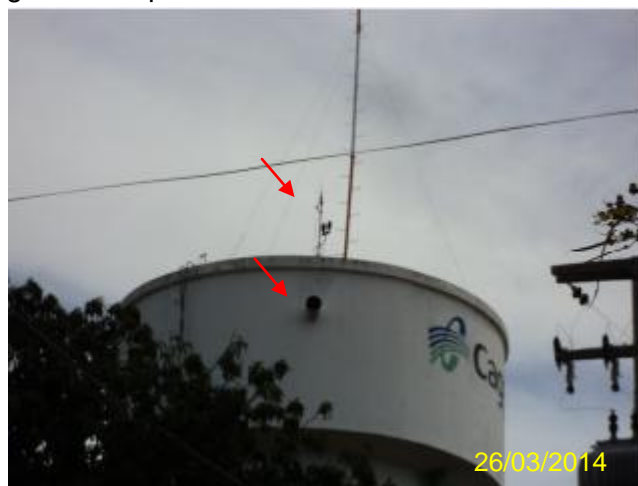
Foto 72 – REL-01: sinalização noturna, para-raios, tubo extravasor e ausência de guarda corpo na laje de cobertura.
