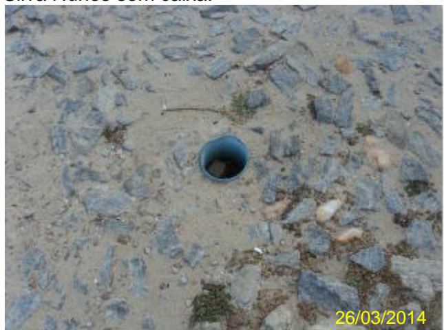
Foto 97 – RDA: registro de descarga na R. Amanco Campelo (2) sem caixa.
