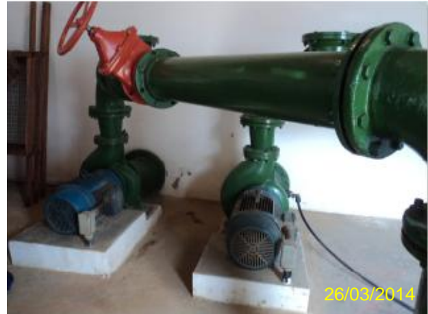
Foto 31 – EEAT-0B: conjunto moto-bomba com reserva.
