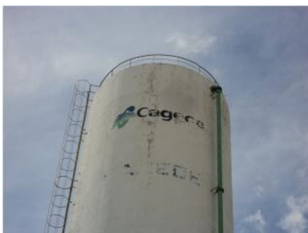
Foto 85 – REL-04: guarda-corpo na laje de cobertura, ausência de para-raios e sinalização noturna.
