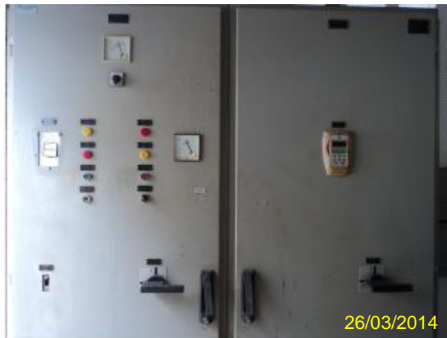
Foto 41 – EEAT-03: quadro de comando.
