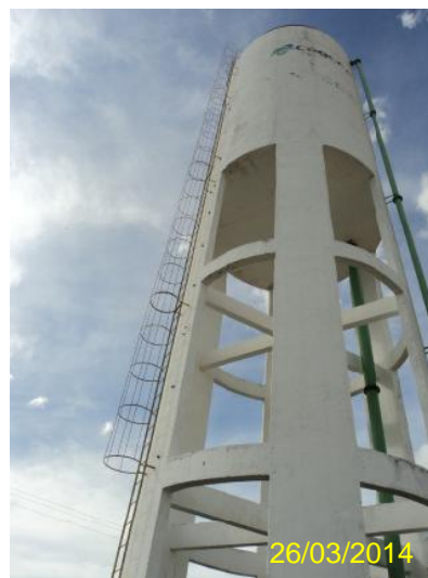
Foto 82 – REL-04: escada com guarda-corpo e sem apoio para subida.
