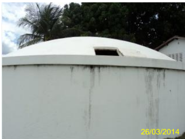
Foto 63 – RAP-04: ausência de tampa de inspeção.
