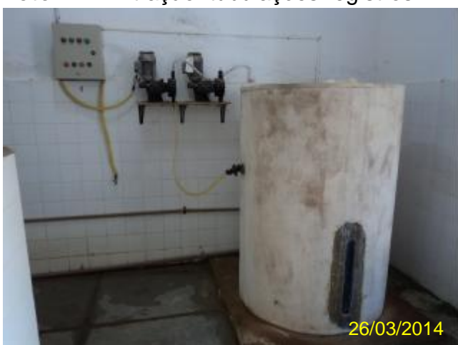
Foto 13 – Casa de química: sistema de fluoretação inoperante.
