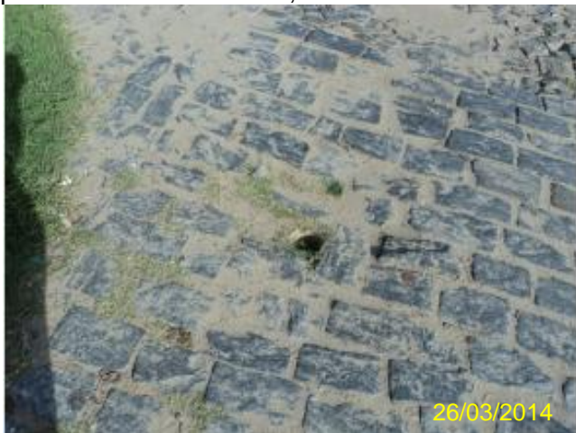
Foto 94 – RDA: registro de descarga na R. Antonio Martins Bandeira sem caixa.
