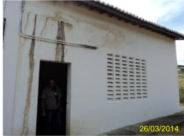
Foto 33 – EEAT-01: ausência de identificação e pintura deteriorada.
