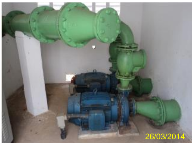
Foto 40 – EEAT-03: conjunto moto-bomba com reserva.
