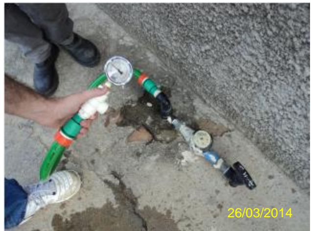
Foto 87 – RDA: medição instantânea de pressão na R. Antônio Cardoso, nº 14 – Bairro Santa Inês.
