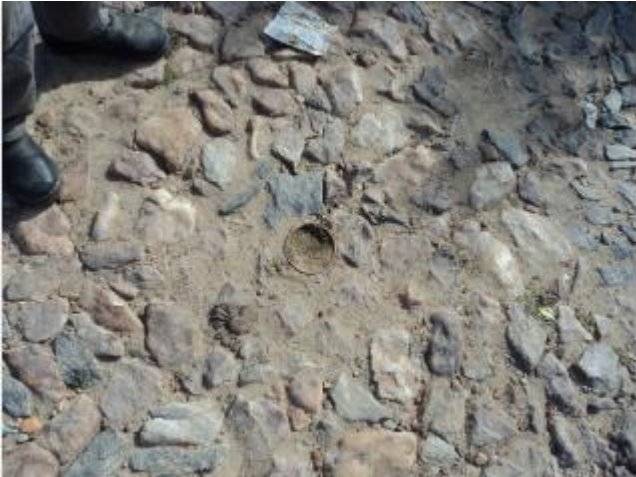
Foto 98 – RDA: registro de descarga na R. do Lampião sem caixa.
