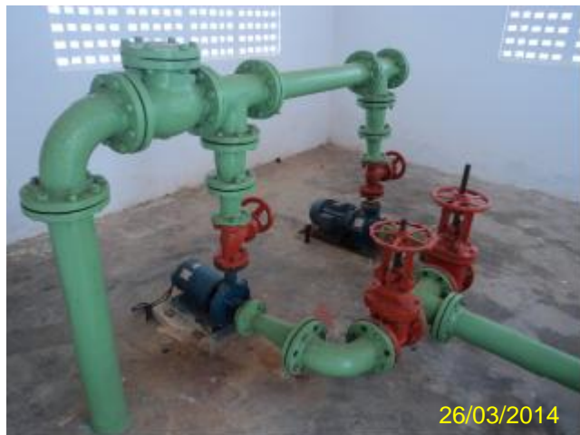
Foto 47 – EEAT-05: conjunto moto-bomba com reserva.
