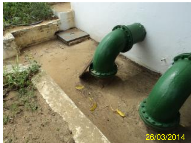
Foto 50 – PR-01: tampa de inspeção.
