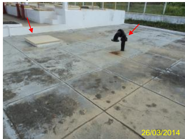
Foto 54 – RAP-01: tampa de inspeção e tubulação de ventilação sem tela de proteção.
