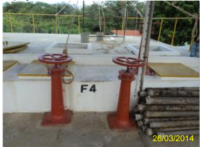
Foto 10 – F4: identificação e tampas de inspeção. Filtro inoperante devido a troca do leito filtrante.
