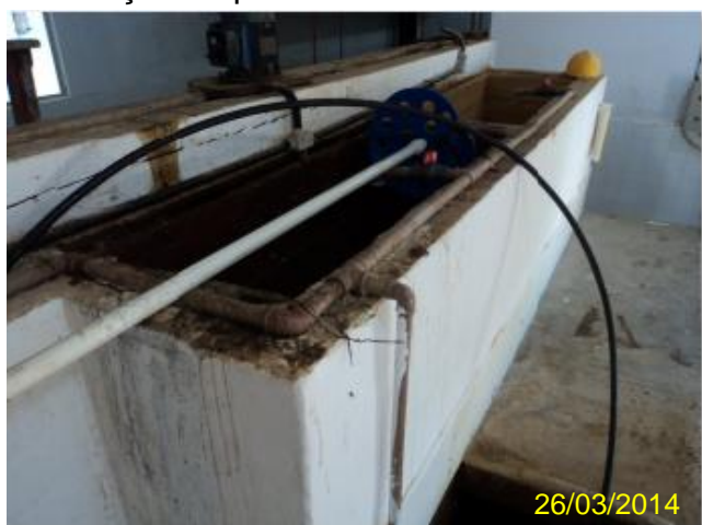
Foto 15 – Casa de química: tanques de dosagem.
