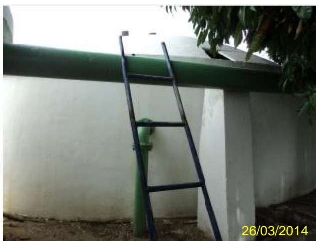
Foto 68 – Reservatórios: escada móvel de acesso aos RAPs..
