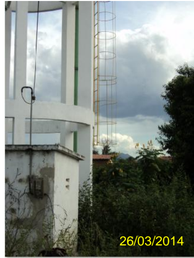
Foto 78 – REL-03: escada de acesso com guarda-corpo e sem apoio para subida.
