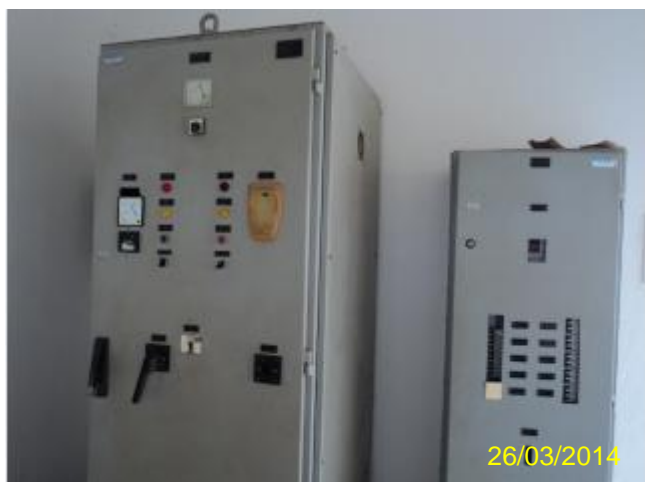
Foto 44 – EEAT-04: quadro de comando.
