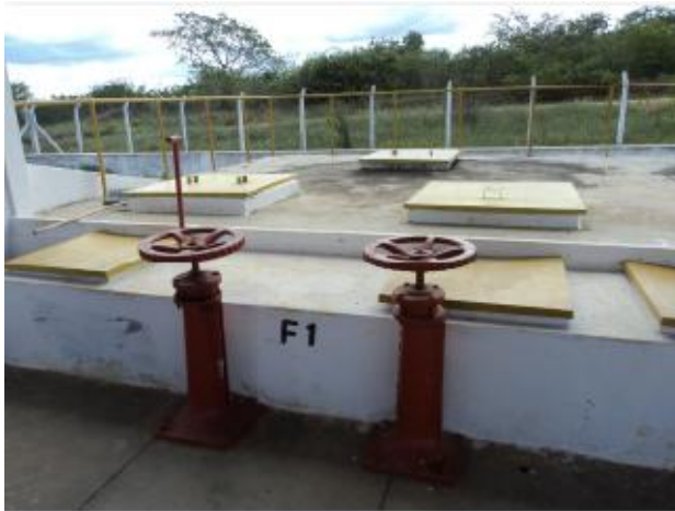
Foto 7 – F1: identificação e tampas de inspeção.
