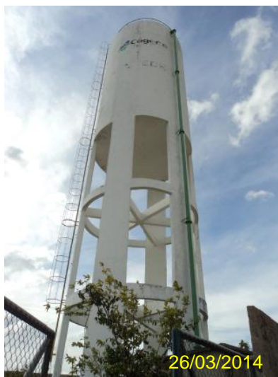
Foto 81 – REL-04: identificação apagada.
