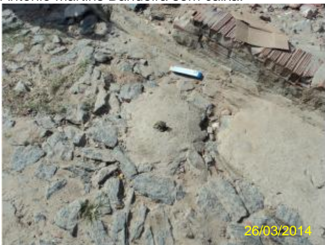
Foto 96 – RDA: registro de descarga na R. Amanco Campelo (1) sem caixa.
