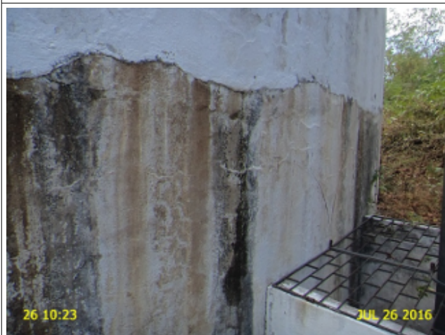
Foto 11 - RAP-02 (Coreaú): sinais de vazamento.
