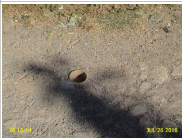
Foto 28 - RDA (Ubaúna): registro de descarga sem caixa: Rua Jacira Vaz de Aguiar.
