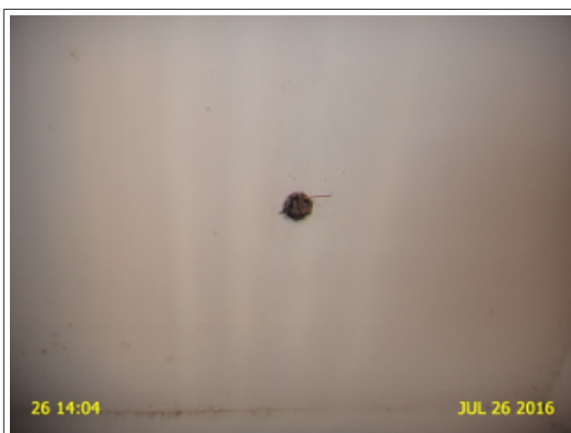
Foto 3 – EEAT-02: sem iluminação.
