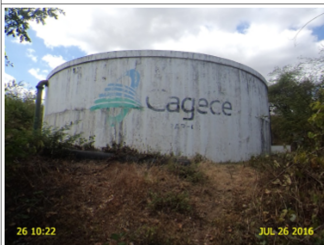
Foto 17 - RAP-02 (Coreaú): pintura deteriorada e identificação com pouca visibilidade.
