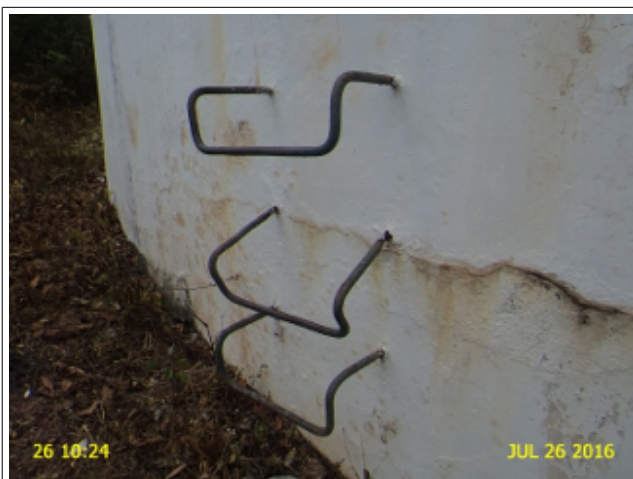
Foto 19 - RAP-02 (Coreaú): escada danificada.
