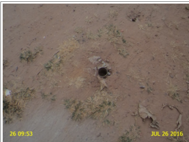
Foto 25 - RDA (Coreaú): registro de descarga na Vila São Francisco sem caixa.
