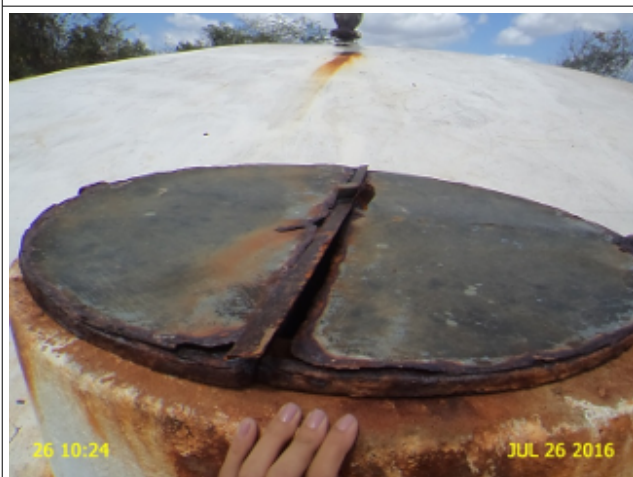
Foto 21 - RAP-02 (Coreaú): tampa de inspeção em processo de corrosão.
