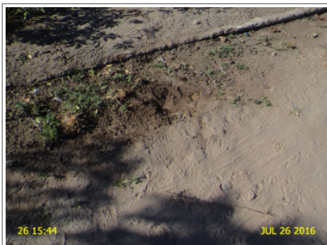
Foto 31 – RDA (Ubaúna): registro de descarga soterrado: Rua do Matadouro.
