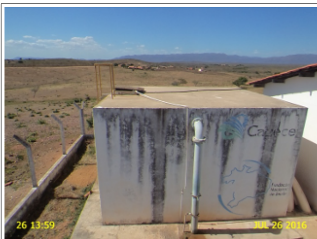
Foto 1 - RAP-02 (Ubaúna): sem identificação, sem tubulação de ventilação e pintura deteriorada.
