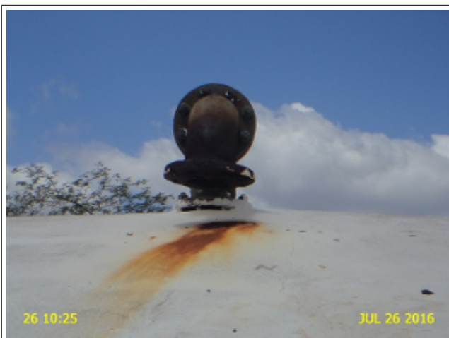
Foto 13 - RAP-02 (Coreaú): tubulação de ventilação sem tela de proteção.
