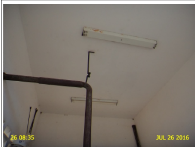
Foto 5 - EEE: casa de abrigo do grupo gerador de energia sem iluminação.
