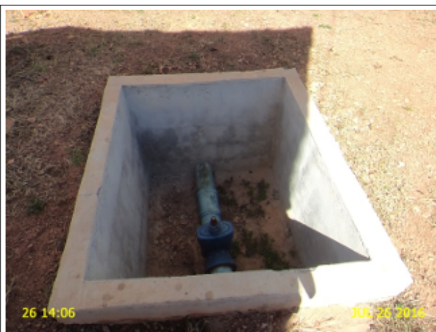
Foto 14 – caixa de inspeção sem tampa na área do REL-01 (Ubaúna).
