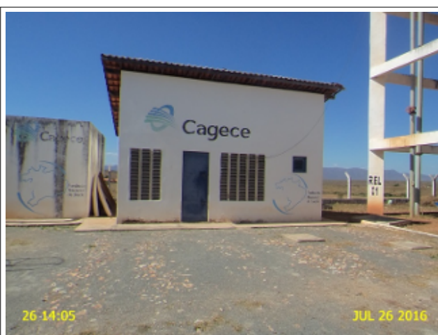
Foto 4 - EEE: bomba submersa não instalada.
