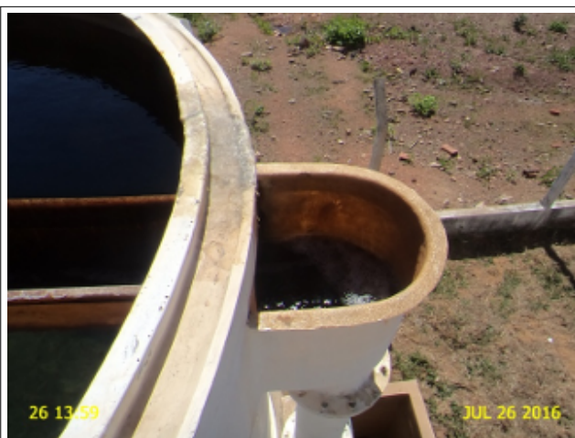
Foto 20 - F-01 sem tampa na calha de saída de água.
