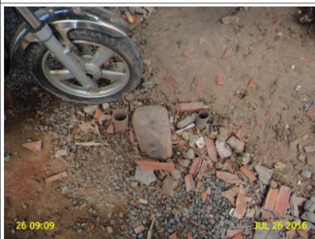
Foto 22 - RDA (Coreaú): registro de descarga sem caixa na Rua São Miguel.
