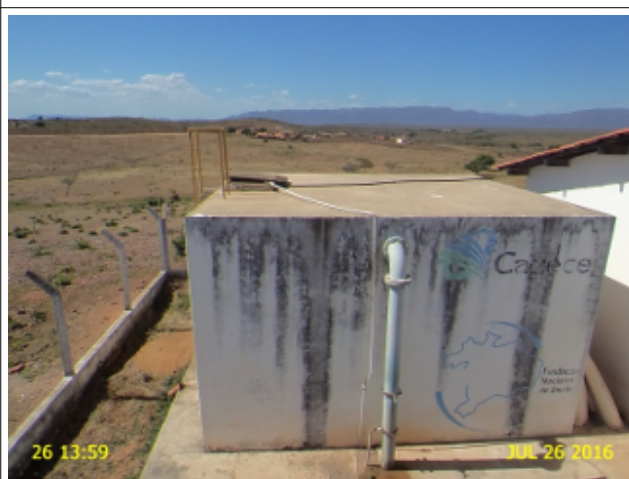
Foto 18 - RAP-02 (Ubaúna): sem identificação, sem tubulação de ventilação, tampa não está devidamente fechada e pintura deteriorada.
