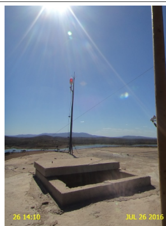
Foto 2 – REL-01 (Ubaúna): não existe tubulação de ventilação e não existe guarda-corpos na laje de cobertura.
