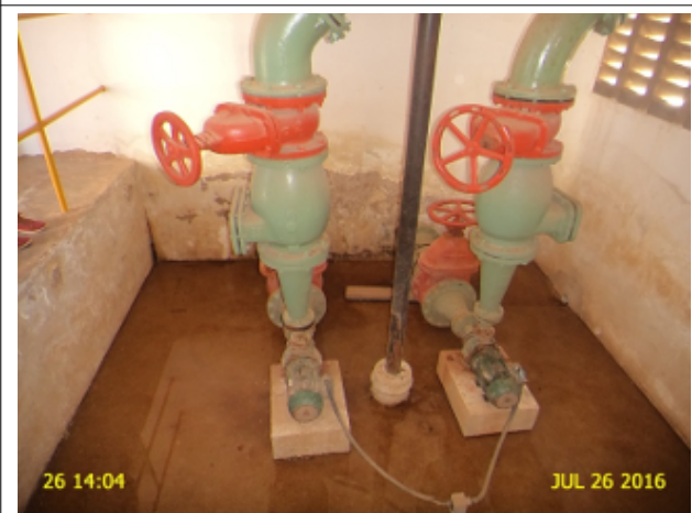
Foto 10 - acúmulo de água na área da EEAT-02 proveniente de vazamento do RAP-02.
