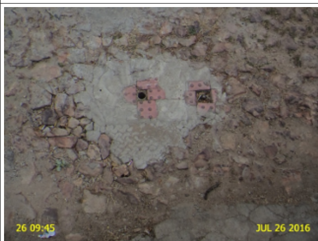
Foto 24 - RDA (Coreaú): registro de descarga na Rua 24 de Maio.
