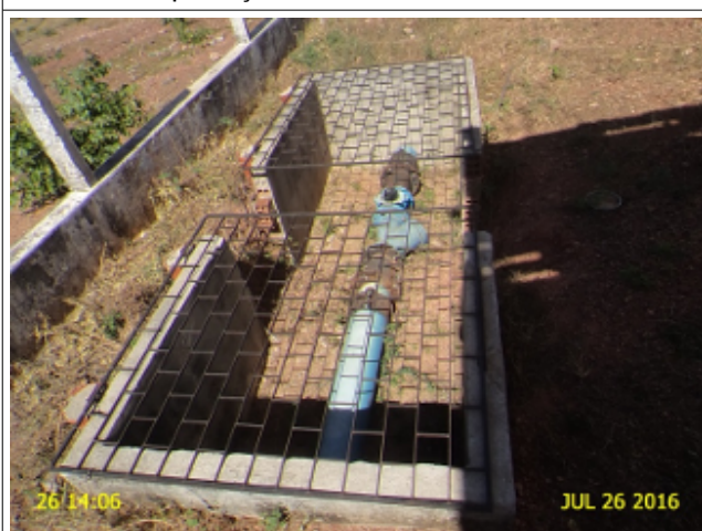
Foto 15 – caixa de inspeção danificada na área do REL-01 (Ubaúna).
