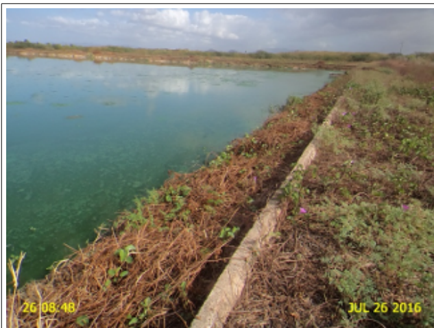
Foto 7 - ETE: acúmulo de vegetação nas paredes da lagoa facultativa.
