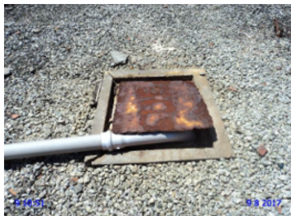
Foto 7 - RAP-13: tampa de inspeção em processo de corrosão e sem vedação adequada.
