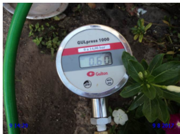
Foto 25 - Medição instantânea de pressão na RDA no endereço localizado em Limoeiro dos Pompeus, Sussuanha - Guaraciaba do Norte.
