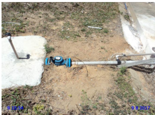
Foto 21 - RAP-13: medidor proporcional do poço PT-01 está instalado sem caixa.
