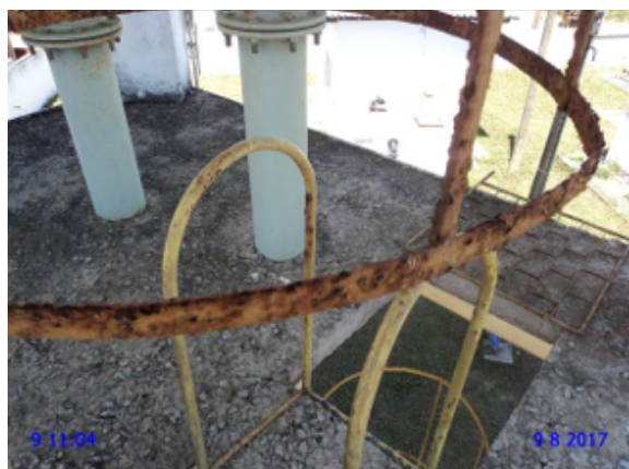
Foto 11 - REL-26: escada de acesso em processo de corrosão.
