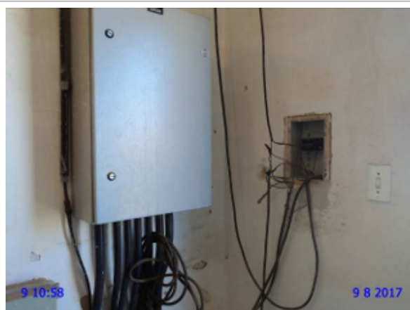
Foto 14 - Casa de controle: instalações elétricas inadequadas.
