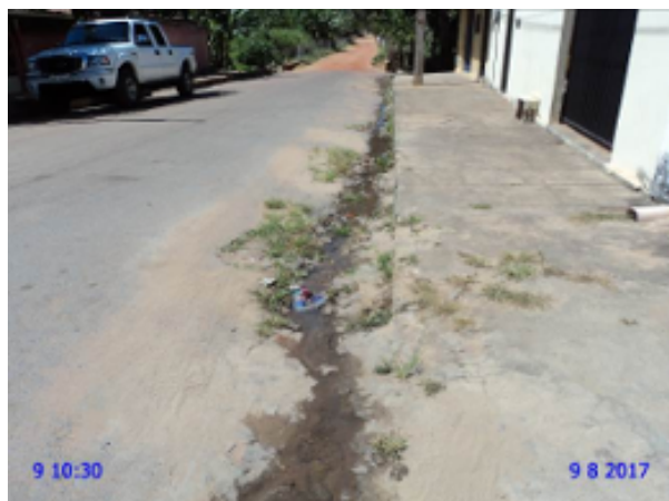
Foto 23 - Lançamento de esgoto a céu aberto: Rua Cel. Clínio Memória.
