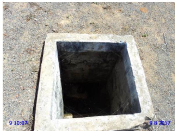
Foto 4 - ETE: caixa de inspeção sem tampa ou grade de proteção (2)
