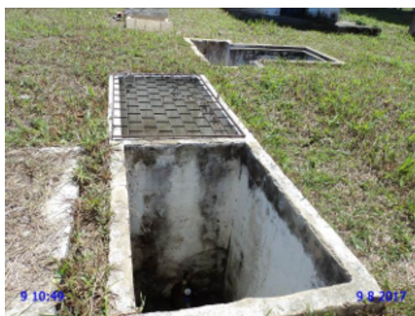
Foto 18 - REL-26: Caixa de inspeção sem tampa ou grade de proteção.
