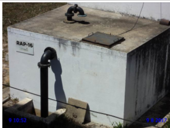
Foto 12 - RAP-16: pintura deteriorada.
