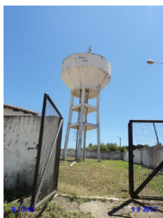
Foto 13 - REL-26: pintura deteriorada.
