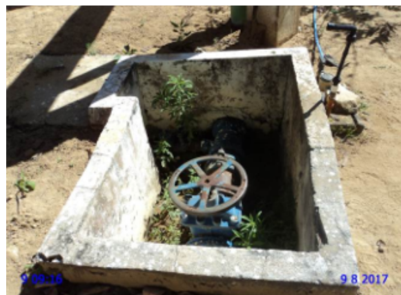
Foto 19 - REL-27: Caixa de inspeção sem tampa ou grade de proteção (1).
