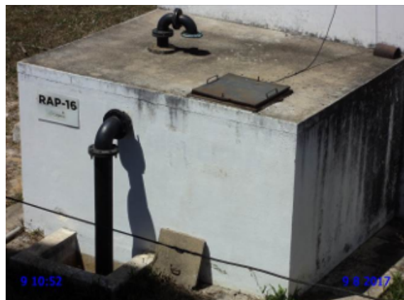
Foto 9 - RAP-16: pintura deteriorado e tampa de inspeção em processo de corrosão.
