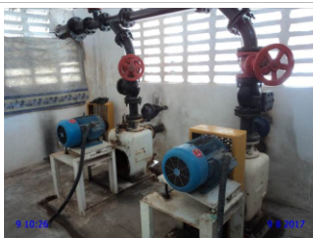
Foto 2 - EEE-01: sem uma das bombas instalada.
