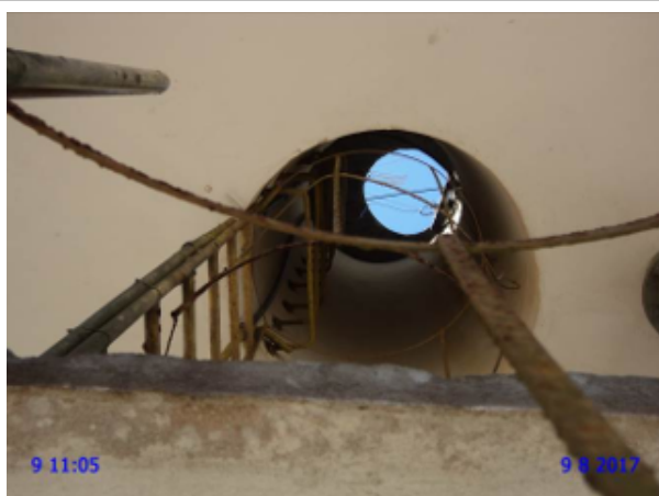
Foto 1 - REL-26: Caixa de inspeção sem tampa ou grade de proteção.
