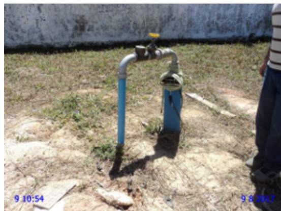
Foto 16 - PT-01: sem identificação e sem laje de proteção.
