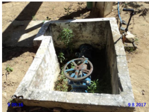
Foto 20 - REL-27: Caixa de inspeção sem tampa ou grade de proteção (2).
