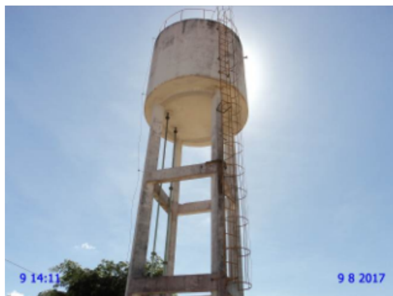
Foto 10 - REL-25: pintura deteriorada, identificação sem visibilidade e escada de acesso em processo de corrosão.
