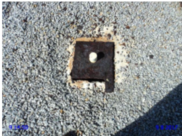
Foto 8 - RAP-12: tampa de inspeção emp recesso de corrosão.
