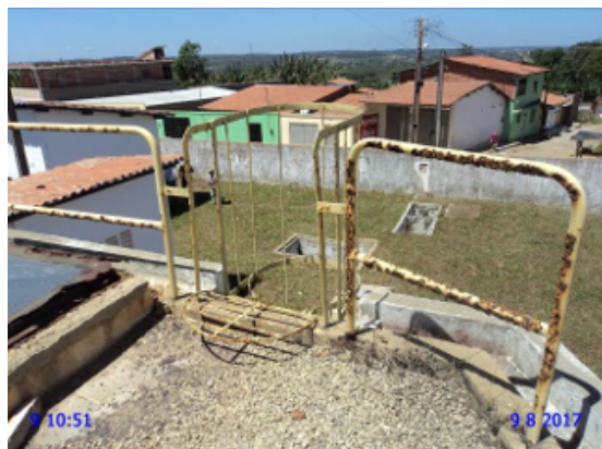
Foto 15 - RAP-13: guarda corpo em processo de corrosão.
