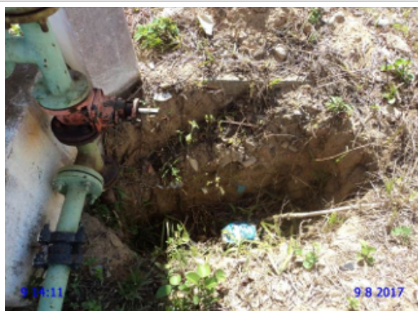
Foto 17 - REL-25 (Sussuanha): buraco sem caixa e tampa e/ou grade de proteção.
