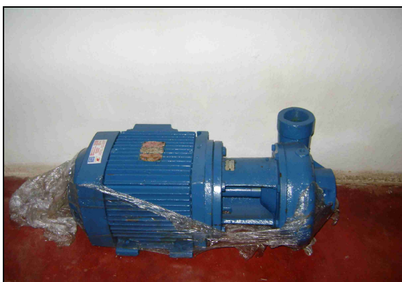
Foto 28 – Bomba reserva da EECS-01.
