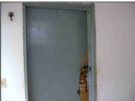
Foto 18 – Laboratório da ETA: Porta de entrada danificada
