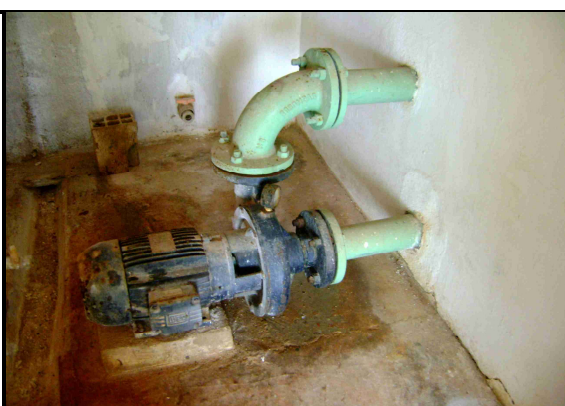
Foto 33 – Conjunto moto-bomba da EELF-01.
