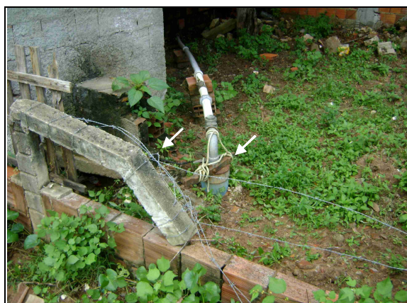
Foto 5 – PT-02: Cerca de proteção danificada.
