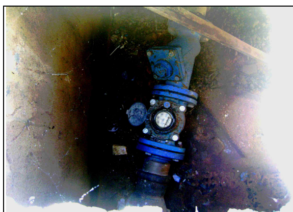
Foto 27 – Adutora de água tratada do Jaburu: Macromedidor localizado na chegada do REL-01.
