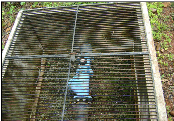
Foto 25 – Macromedidor localizado na saída da EEAT-01.
