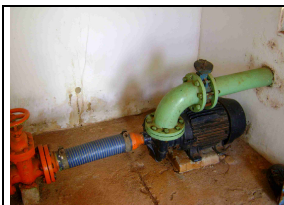
Foto 32 – Conjunto moto-bomba da EEAT-01. Foto 33 – Conjunto moto-bomba da EELF-01.
