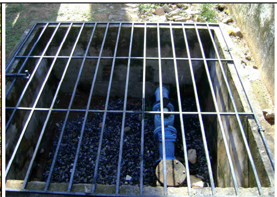
Foto 26 – Macromedidor localizado na chegada do REL-01.
