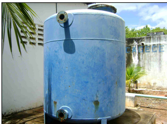
Foto 13 – ETA: filtro desativado.
