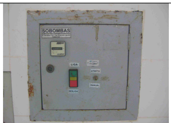
Foto 29 – Quadro de comando da EECS-01.
