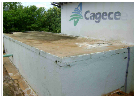
Foto 42 – RAP-03: Sem tubulação de ventilação.
