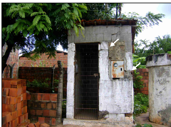
Foto 3 – PT-02: Casa do quadro de comando apresentando rachaduras.
