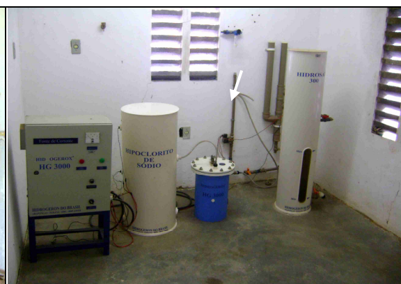
Foto 24 – Fabrica de hipoclorito de sódio, instalada na EEAT-02.
