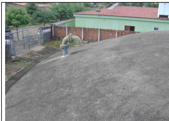
Foto 39 – RAP-01: Tubulação de ventilação sem tela de proteção.
