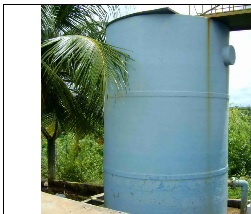
Foto 11 – ETA: filtro sem identificação.
