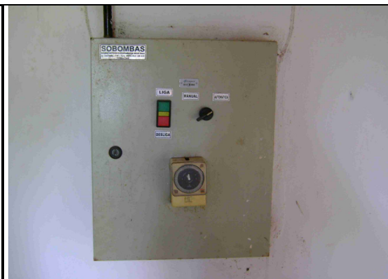
Foto 31 – Quadro de comando da EEAT-01.
