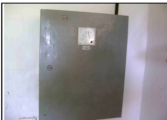
Foto 34 – Quadro de comando da EELF-01. Foto 35 – Conjunto moto-bomba da EEAT-02.
