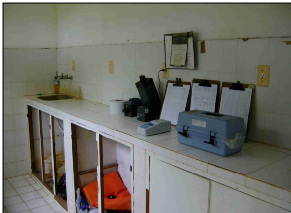
Foto 15 – Laboratório da ETA: Armário da bancada sem portas.
