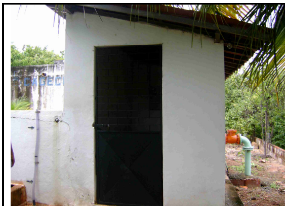
Foto 30 – Quadros de comando das EEAT-02 e EEAT-03. Foto 31 – EEAT-01: Sem identificação.
