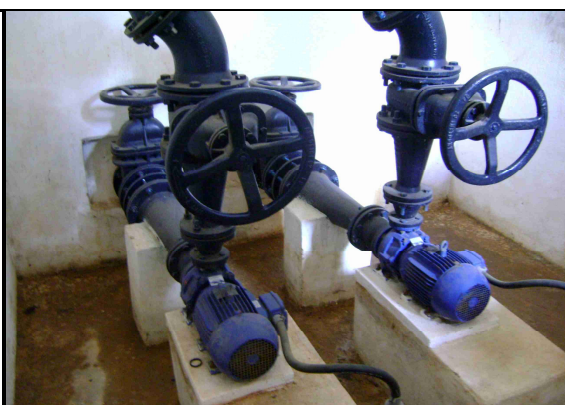
Foto 35 – Conjunto moto-bomba da EEAT-02.
