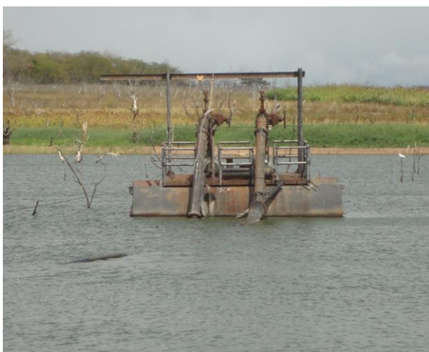
Foto 5 – Flutuante da captação superficial.
