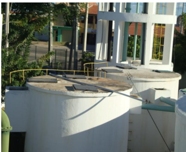
Foto 15 – Vista superior dos filtros de fluxo ascendente 1 e 2 com tampas adequadas, escada de acesso e lajem com guarda-corpo.
