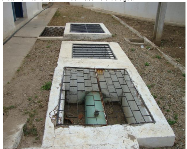
Foto 47 – Caixas de inspeções da estação pitométrica de água tratada no interior da ETA.
