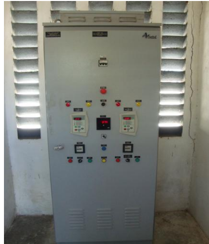
Foto 120 – Quadro de comando das bombas da EEE-08.
