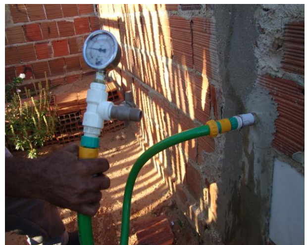
Foto 88 – Medição de pressão na Rua Maria Luíza Barro, nº 480.
