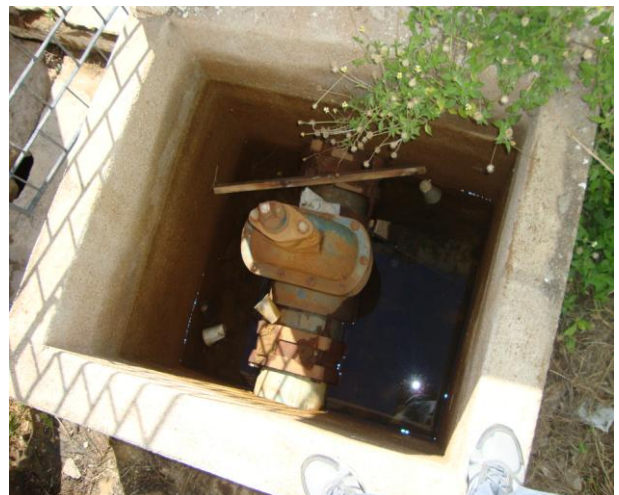
Foto 82 – REL-02 desativado: caixa do registro sem tampa ou grade de proteção.
