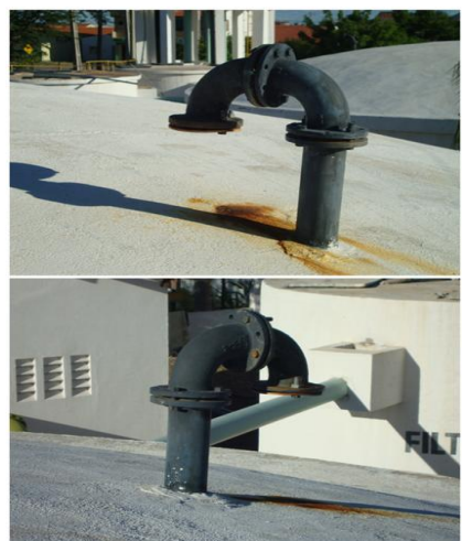
Foto 69 – RAP-03: tubulação de ventilação com vedação.
