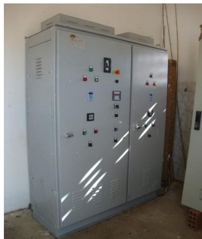
Foto 8 – Quadro de comando da captação superficial novos aguardando instalação.
