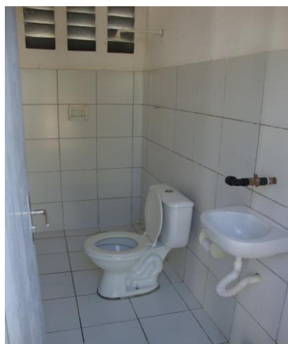
Foto 110 – Instalação sanitária para o operador.
