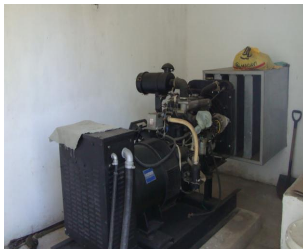
Foto 118 – Grupo gerador de energia da EEE-08.
