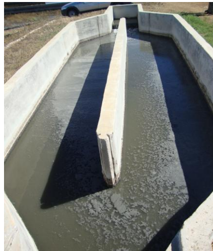
Foto 132 – ETE: vista da caixa de areia.
