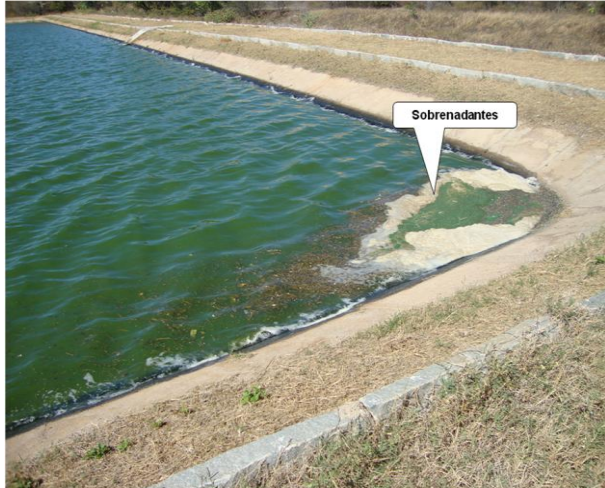
Foto 135 – ETE: vista da lagoa facultativa com sobrenadantes.
