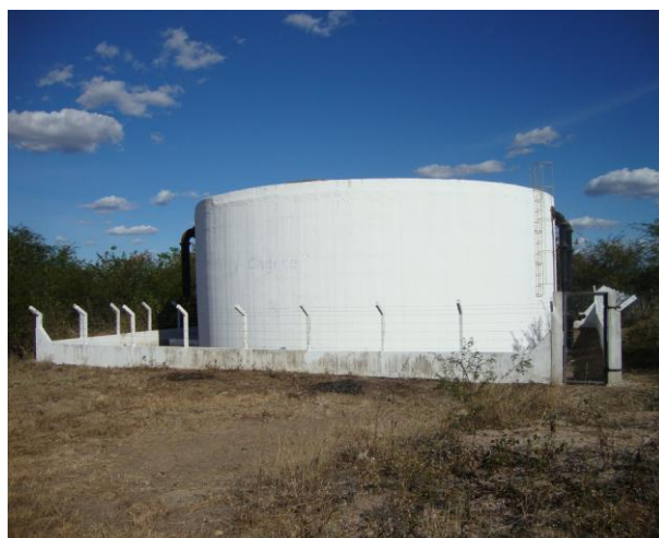
Foto 58 – Vista do RAP-01 de água bruta.
