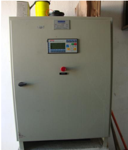
Foto 119 – Quadro de comando do gerador da EEE-01.
