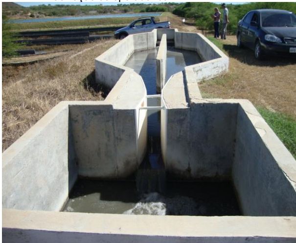
Foto 131 – ETE: vista do tratamento preliminar.
