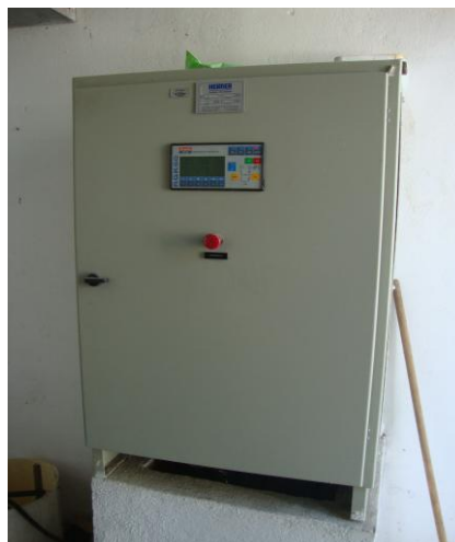
Foto 108 – Quadro de comando do gerador da EEE-01.
