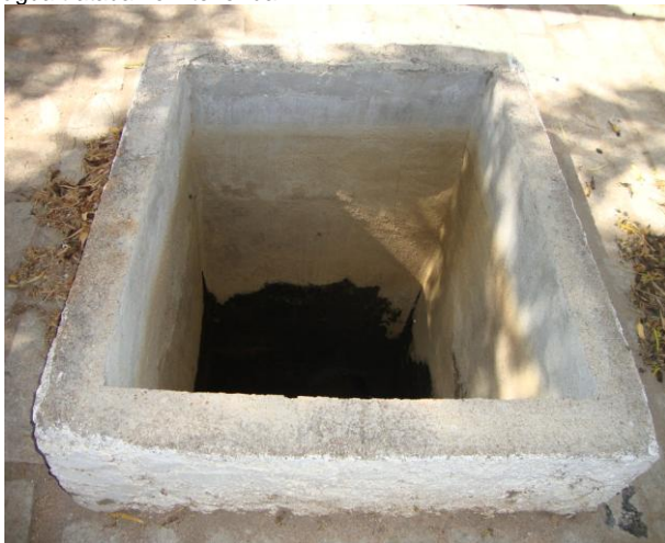
Foto 50 – Caixa de inspeção de descarga está sem tampa ou grade de proteção, localizada na calçada externa da ETA.
