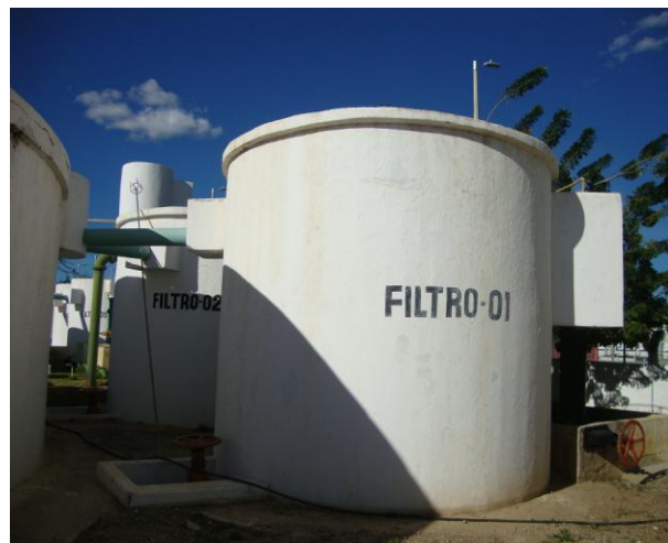
Foto 14 – Vista frontal dos filtros de fluxo ascendente 1 e 2.
