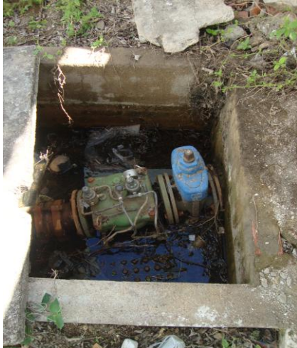
Foto 83 – REL-02 desativado: caixa do registro sem tampa ou grade de proteção.
