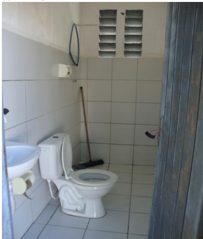
Foto 121 – Instalação sanitária para o operador.
