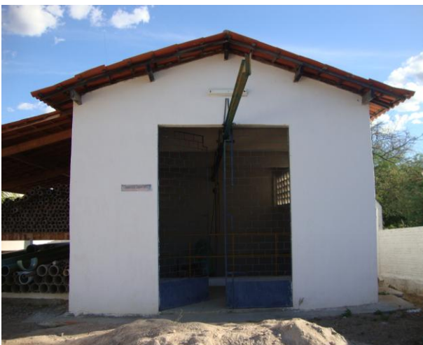
Foto 51 – Vista externa da casa de abrigo da EEAT-01 e do quadro de comando.
