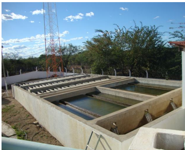
Foto 13 – Vista superior do floco-decantador.
