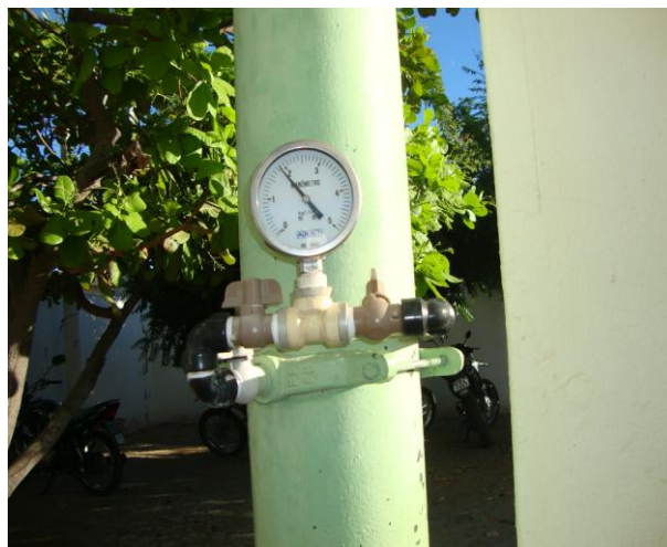
Foto 74 – REL-01: manômetro para medição de nível.
