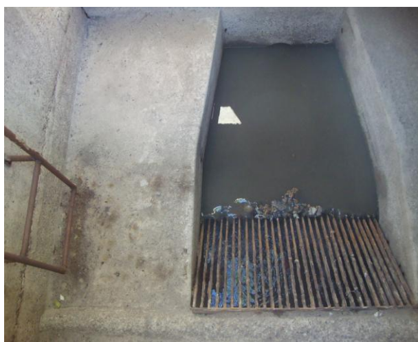
Foto 105 – EEE-01: tratamento preliminar.
