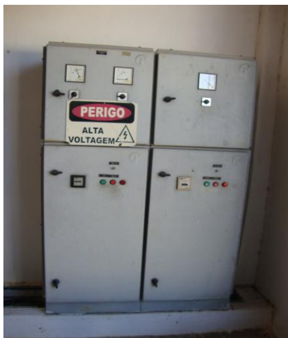
Foto 53 – Quadro de comando da EEAT-01.
