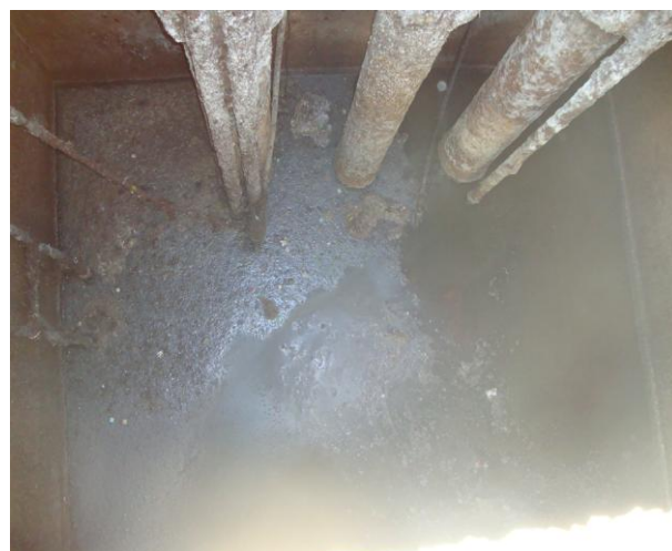
Foto 116 – Acúmulo de sólidos no poço de sucção da EEE-08.
