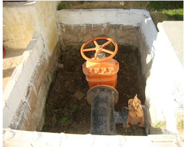
Foto 78 – REL-01: caixa do registro sem tampa ou grade de proteção.
