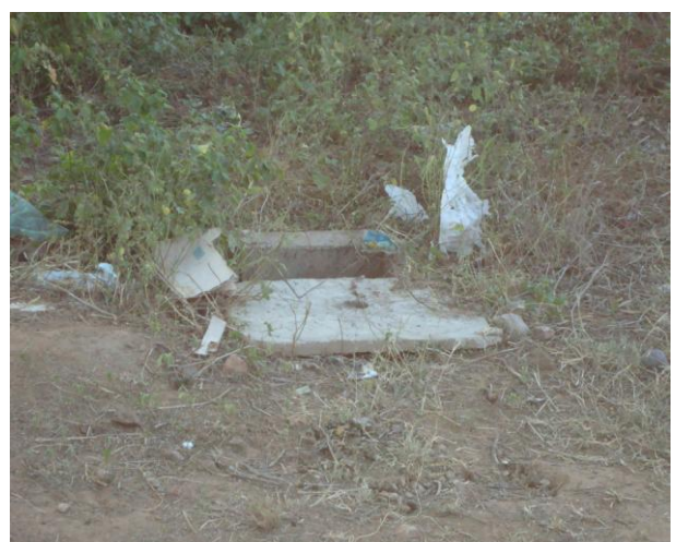
Foto 94 – Registro de descarga na BR-020 - Tauazinho.
