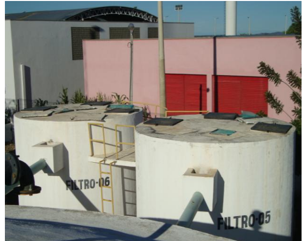
Foto 20 – Vista superior dos filtros de fluxo ascendente 5 e 6 com tampas adequadas, escada de acesso e lajem com guarda-corpo.
