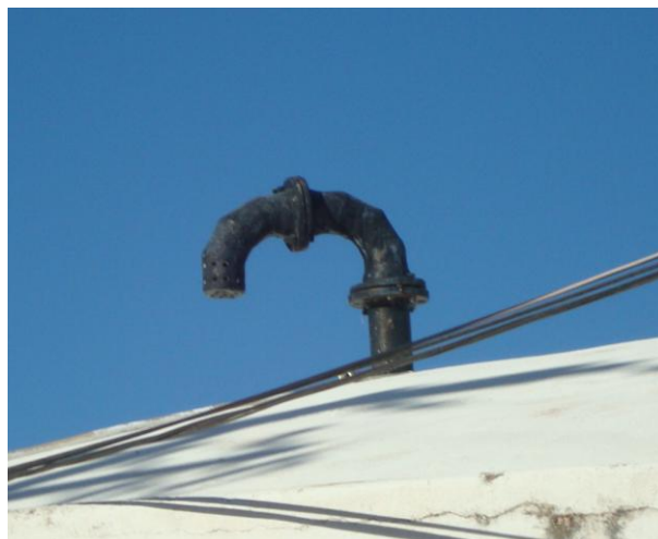
Foto 62 – RAP-02: tubulação de ventilação com vedação.
