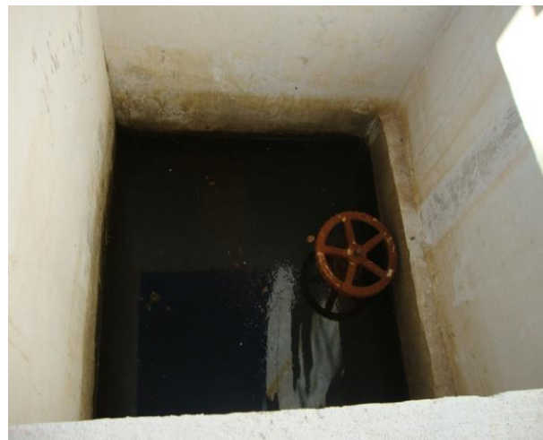
Foto 70 – RAP-03: registro de descarga com acúmulo de água.
