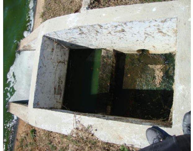
Foto 136 – ETE: poço de saída da lagoa facultativa.
