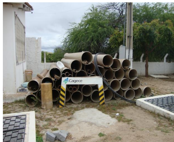
Foto 40 – Tubulação armazenada ao ar livre, na área da ETA.
