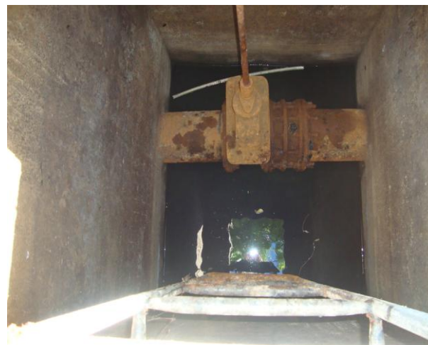
Foto 104 – Poço de recepção da EEE-01.
