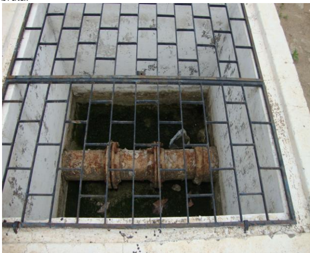
Foto 46 – Caixa de inspeção da estação pitométrica de água bruta no interior da ETA.
