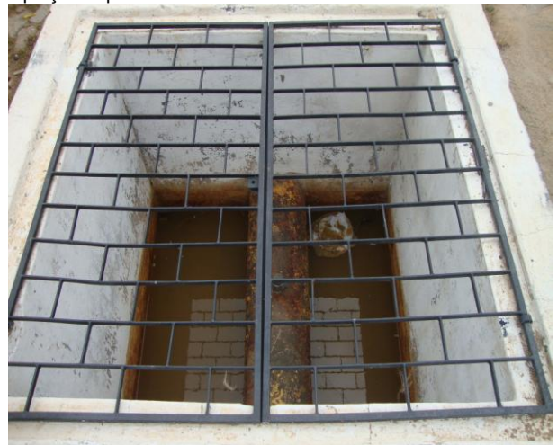
Foto 45 – Caixa de inspeção da estação pitométrica de água bruta no interior da ETA com acúmulo de água.
