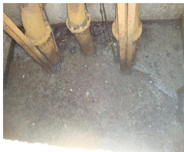
Foto 106 – Acúmulo de sólidos no poço de sucção da EEE-01.
