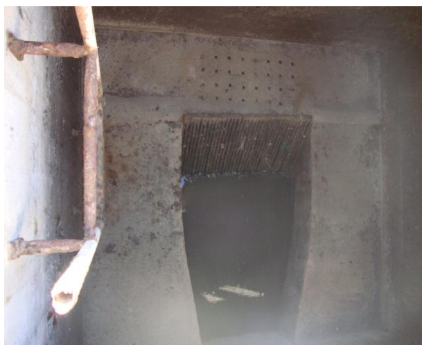
Foto 115 – EEE-08: tratamento preliminar.
