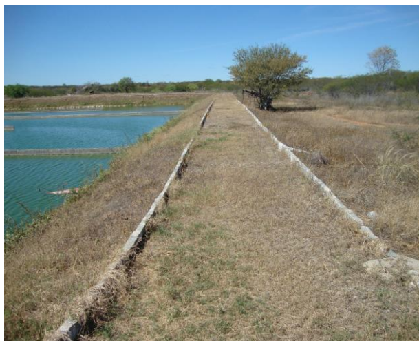
Foto 141 – ETE: guias da lagoa de maturação M1.
