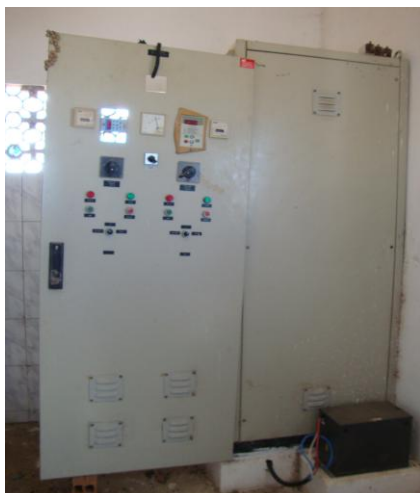
Foto 7 – Quadro de comando da captação superficial.
