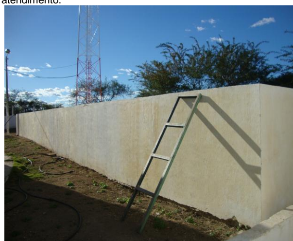
Foto 12 – Vista frontal do floco-decantador com escada de acesso.
