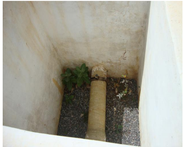
Foto 43 – Estação pitométrica de água bruta na saída da captação superficial.
