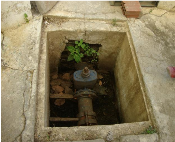
Foto 77 – REL-01: caixa do registro sem tampa ou grade de proteção.
