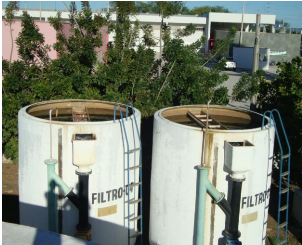
Foto 19 – Vista superior dos filtros de fluxo ascendente 3 e 4 sem tampas, com escada de acesso.
