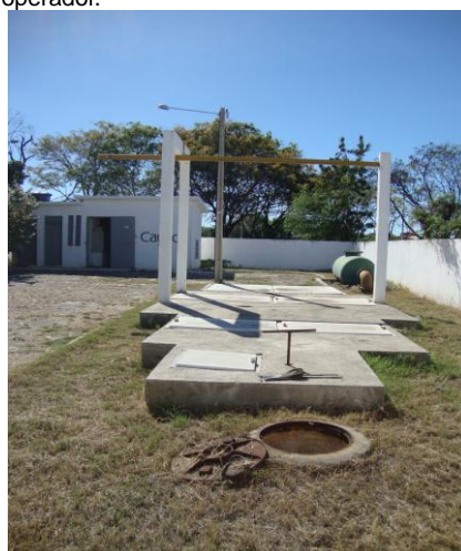
Foto 112 – Vista interna da EEE-08.
