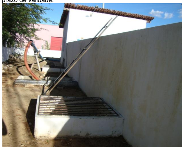
Foto 11 – Vista frontal do floco-decantador com escada de acesso.
