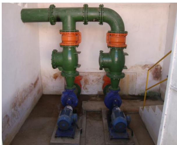
Foto 55 – Conjunto motor-bomba da EEAT-02.
