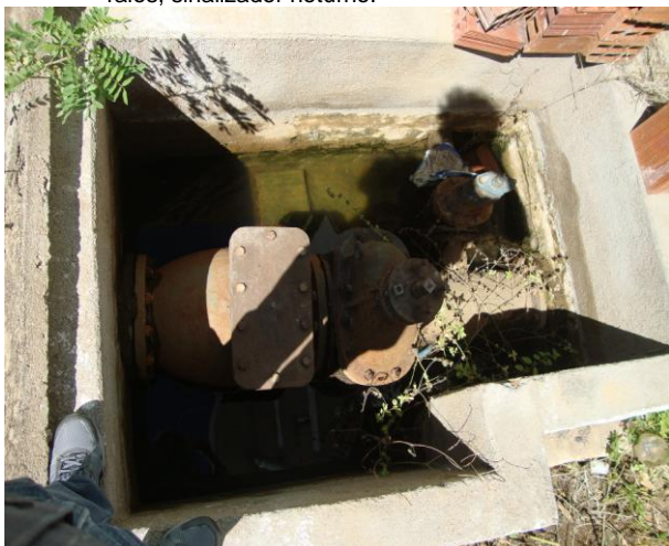
Foto 81 – REL-02 desativado: caixa do registro sem tampa ou grade de proteção.
