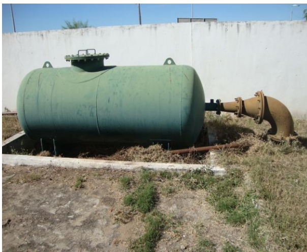
Foto 122 – Dispositivo de recalque da EEE-08.
