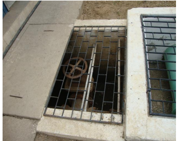
Foto 49 – Caixa de inspeção com registro de água tratada no interior da ETA.
