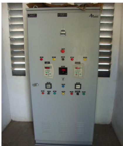
Foto 109 – Quadro de comando das bombas da EEE-01.
