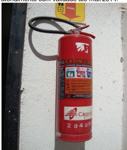
Foto 157 – Extintor de incêndio do almoxarifado com validade até mar/2014.
