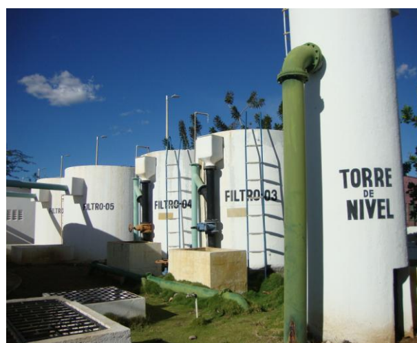
Foto 18 – Vista frontal da torre de nível e dos filtros de fluxo ascendente 1 ao 6.
