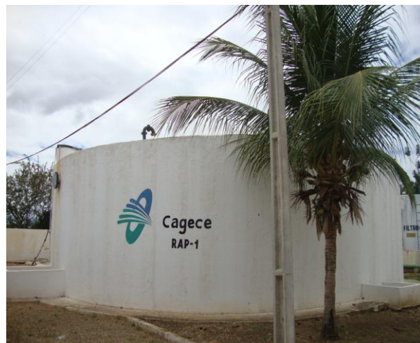
Foto 66 – Vista do RAP-03 com identificação errada.
