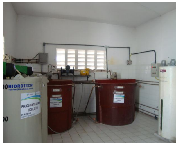
Foto 26 – Tanques de dosagem de produtos químicos.
