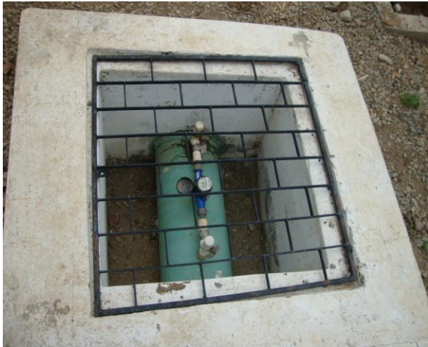
Foto 48 – Caixa de inspeção com medidor proporcional de água tratada no interior da ETA.
