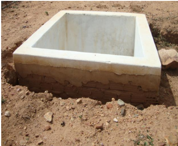
Foto 42 – Caixa de inspeção da estação pitométrica de água bruta na saída da captação superficial.
