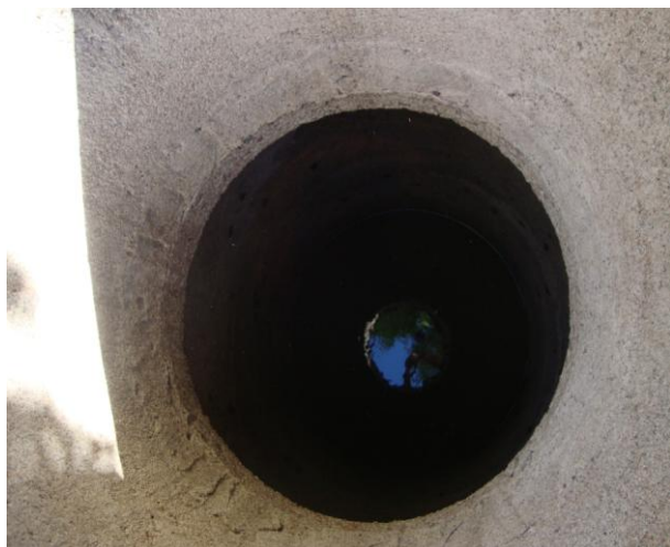
Foto 103 – EEE-01: poço de visita de chegada na EEE-01.
