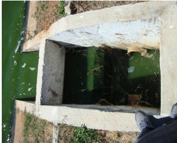
Foto 137 – ETE: poço de saída da lagoa facultativa.
