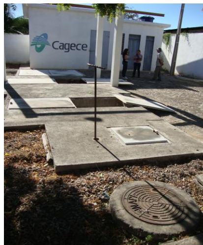
Foto 102 – Vista interna da EEE-01.
