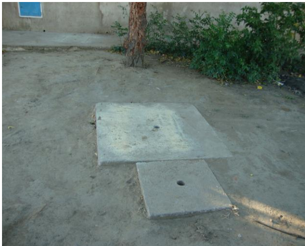
Foto 91 – Registro de descarga na Rua Francisco de Assis Santana.
