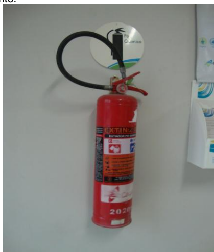
Foto 155 – Extintor de incêndio da loja de atendimento com validade até mar/2014.
