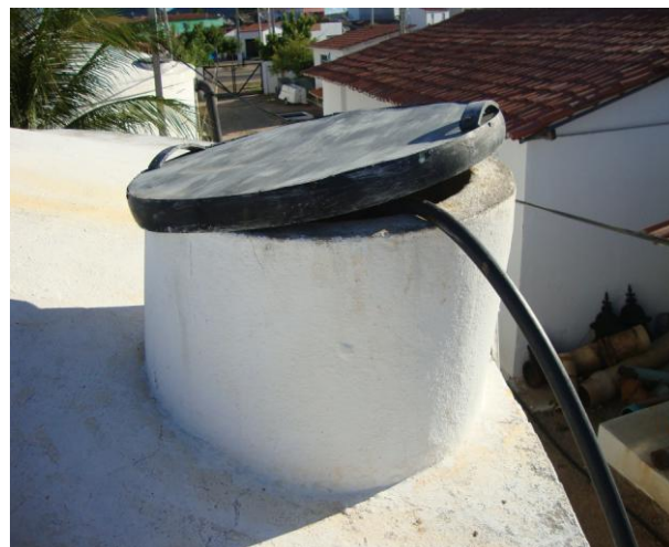
Foto 68 – RAP-03: com tampa vedada inadequadamente.
