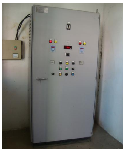
Foto 56 – Quadro de comando da EEAT-01.
