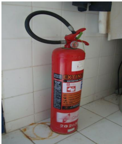
Foto 31 – Extintor de incêndio da casa de química dentro do prazo de validade.
