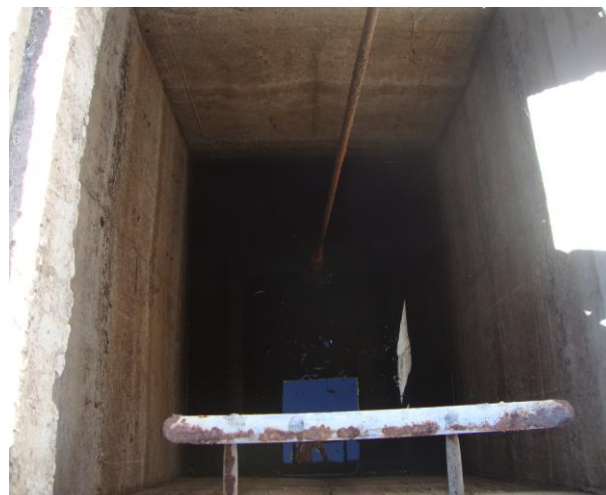
Foto 114 – Poço de recepção da EEE-08.
