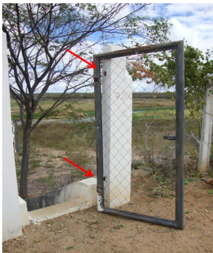
Foto 3 – Portão de acesso ao Açude Trici com defeito.
