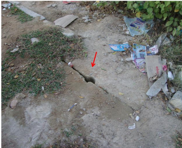
Foto 95 – Registro de descarga na Rua Emiliano Ferreira Ferro.
