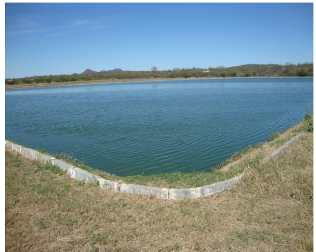
Foto 134 – ETE: vista da lagoa facultativa.
