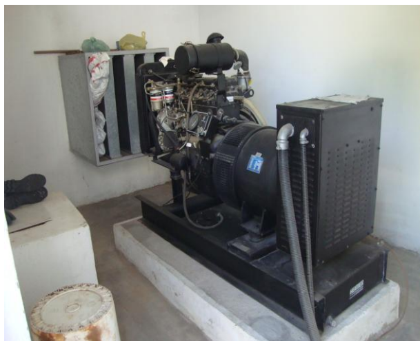
Foto 107 – Grupo gerador de energia da EEE-01.
