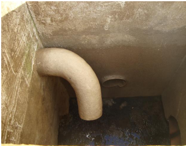
Foto 21 – Descarga do Filtro 03 com acúmulo de material filtrante.
