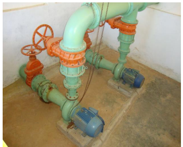
Foto 52 – Conjunto motor-bomba da EEAT-01.
