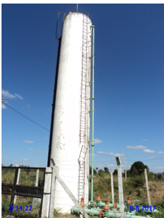
Foto 30 - AAT: ONE WAY 14 - sem identificação, pintura deteriorada, escada danificada, guarda-corpos danificado e ausência de identificação.
