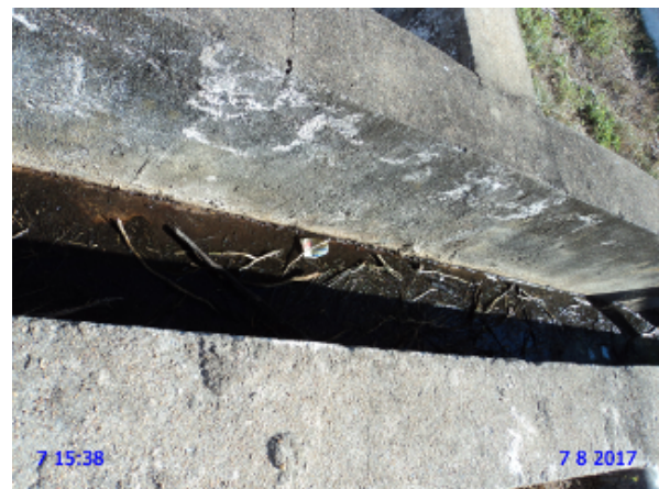
Foto 29 - ETE: vazamento no registro do reator UASB-02 (sem vedação).
