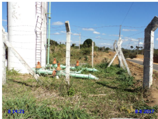
Foto 31 - AAT: Cerca de delimitação da área do ONE WAY 14 danificada.
