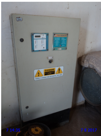
Foto 22 - EEE-01: Quadro de comando do grupo gerador de energia elétrica com defeito.
