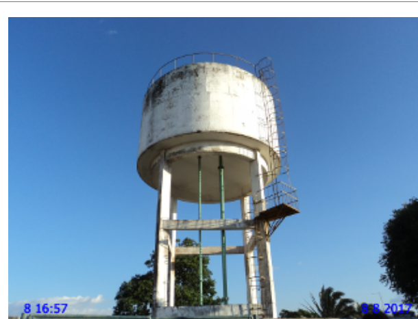
Foto 5 - REL-21: pintura deteriorada e guarda-corpos em processo de corrosão.
