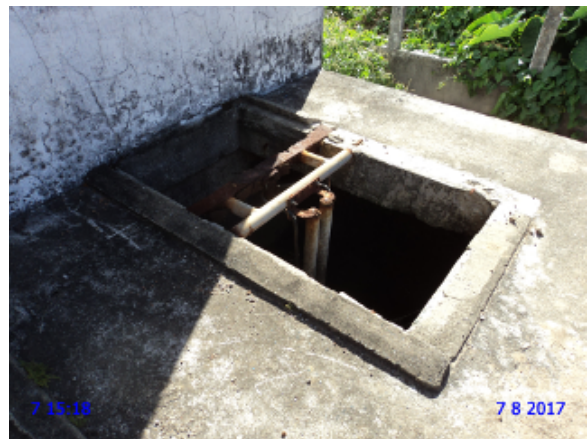
Foto 21 - EEE-03: poço de sucção sem tampa.
