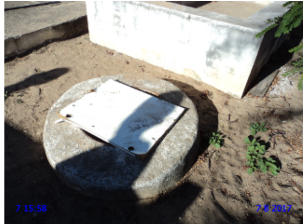
Foto 19 - EEE-04: poço de visita com tampa sem vedação adequada.
