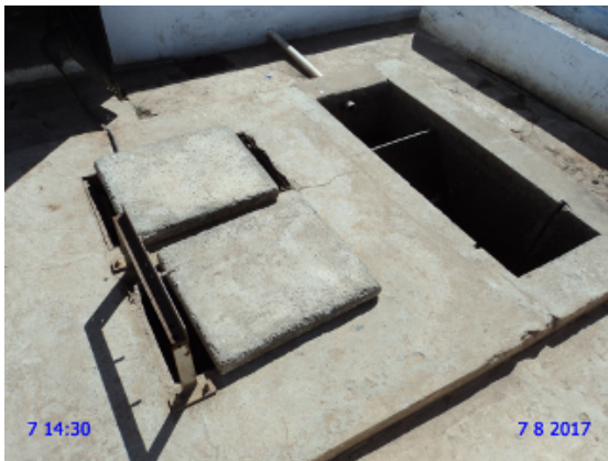
Foto 20 - EEE-01: A Tampa do poço de sucção não está fechada adequadamente.
