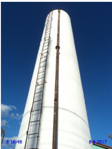
Foto 32 - AAT: ONE WAY 15 - a escada está em processo de corrosão.
