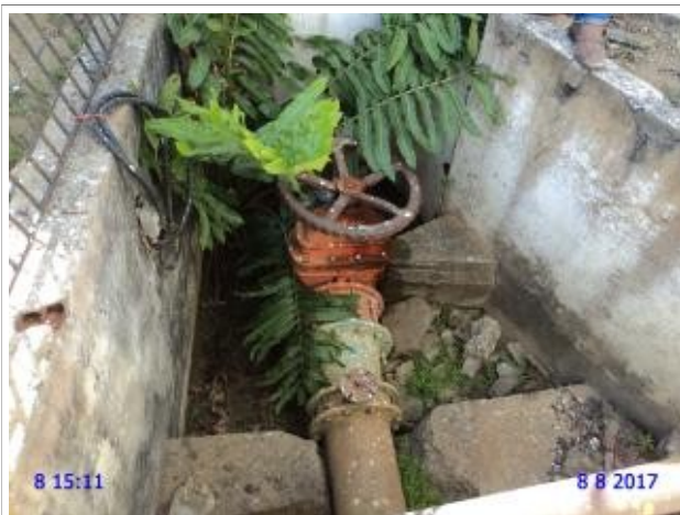
Foto 2 - REL-18: vazamento no registro da entrada.
