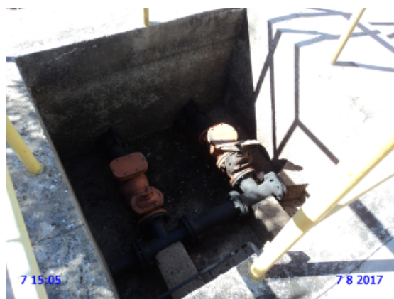
Foto 16 - EEE-02: vazamento no registro.
