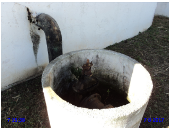
Foto 28 - Reator UASB-02: vazamento no registro.
