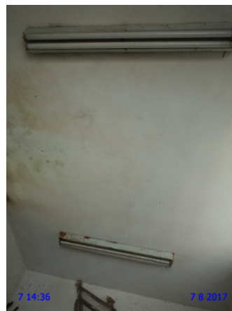
Foto 9 - EEE-01: As lâmpadas da casa de abrigo do grupo gerador de energia não acendem.
