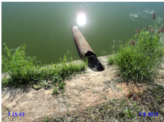
Foto 6 - ETE: manilha danificada na entrada do esgoto na lagoa facultativa.
