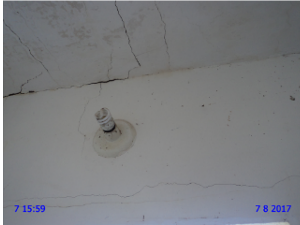
Foto 12 - EEE-04: A lâmpada da casa de abrigo do quadro de comando das bombas não acende.
