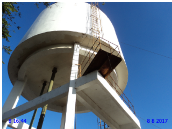
Foto 7 - REL-20: instalação do para-raios danificada e escada de acesso/passarelas em processo de corrosão.
