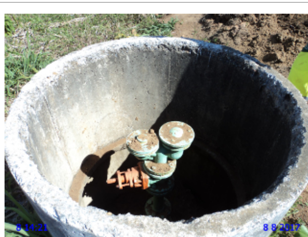
Foto 3 – AAT: caixa da ventosa sem tampa
