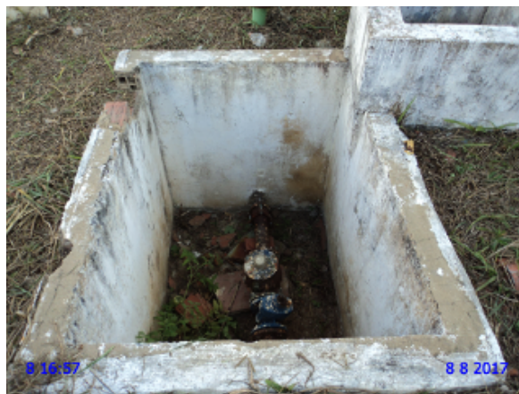
Foto 35 - REL-21: caixa do medidor proporcional sem tampa ou grade de proteção.
