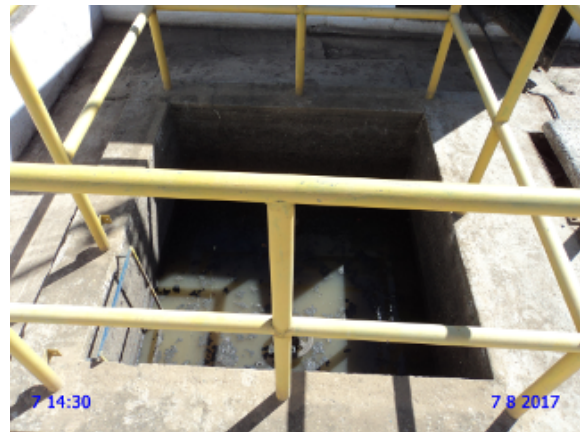
Foto 15 EEE-01: vazamento no registro da adutora de recalque.
