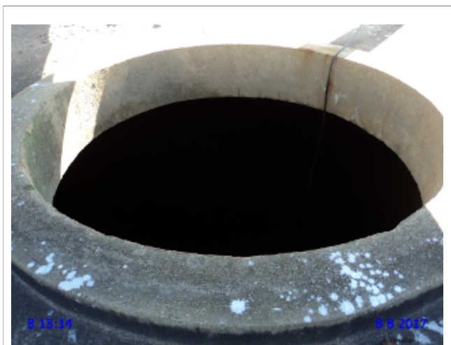
Foto 1 - REL-18: ausência de tampa de inspeção.
