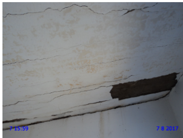
Foto 14 - EEE-04: teto da casa de abrigo do quadro de comando com rachaduras e armaduras expostas.
