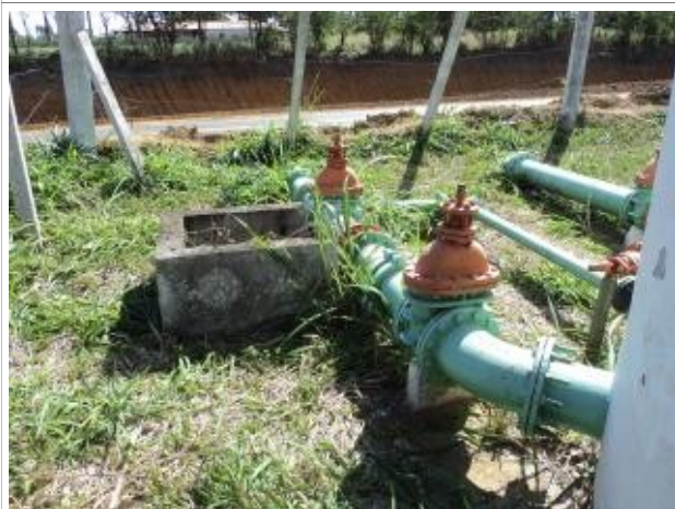
Foto 4 - One-Way 14: caixa do registro sem tampa.
