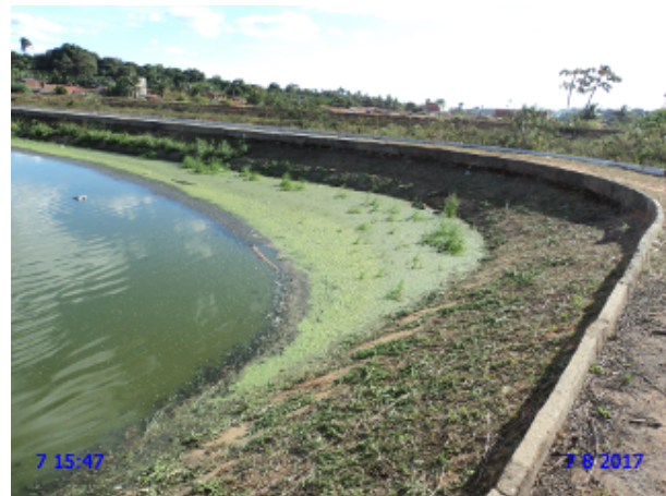
Foto 27 - ETE: acumulo de sobrenadante na lagoa de maturação.
