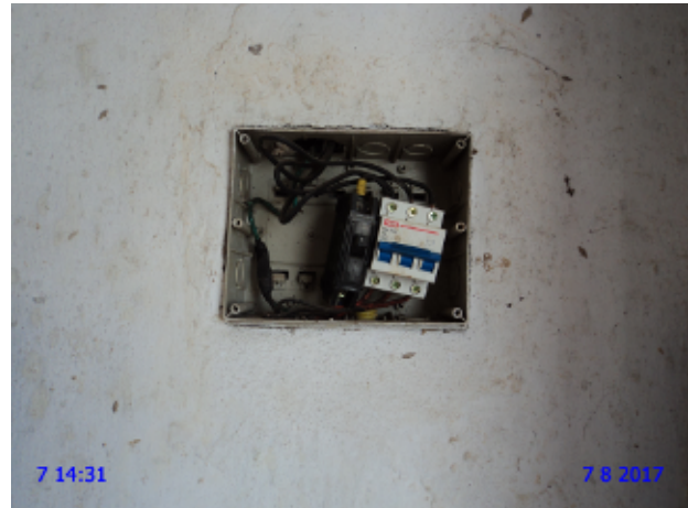
Foto 13 - EEE-01: quadro do disjuntor sem tampa.
