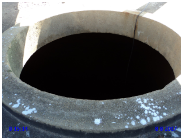
Foto 33 - REL-18: ausência de tampa de inspeção.
