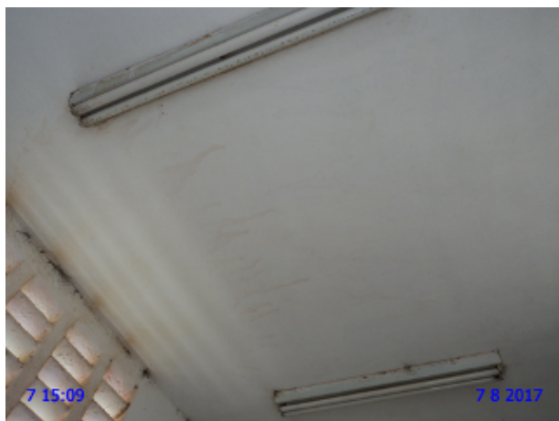
Foto 10 - EEE-02: As lâmpadas da casa de abrigo do grupo gerador de energia elétrica não acendem.
