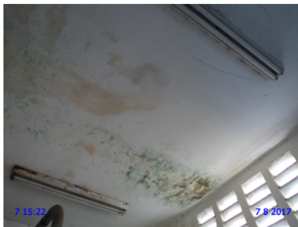
Foto 11 - EEE-03: As lâmpadas da casa de abrigo do grupo gerador de energia elétrica não acendem.
