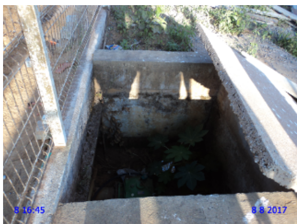
Foto 34 - REL-20: caixa de inspeção com tampa retirada.
