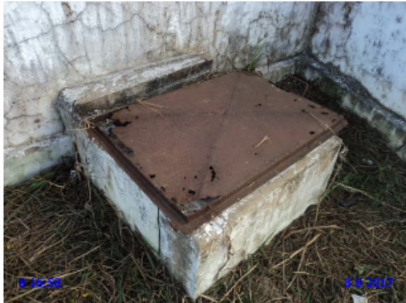
Foto 36 - REL-21: caixa de inspeção com tampa em processo de corrosão.
