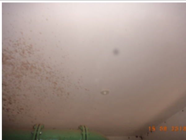
Foto 12 – Elevatória: Não existe iluminação nas elevatórias EEAT-01 e EELF-01.
