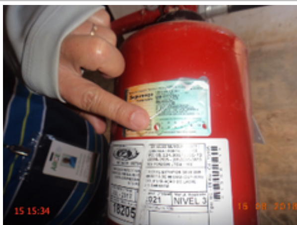
Foto 26 – Elevatórias: O extintor de incêndio das elevatórias EEAT-01 e EELF-01 e casa de química está com a recarga vencida.
