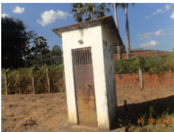
Foto 13 – Captação: A casa de abrigo do poço PT-17 está com a pintura deteriorada.
