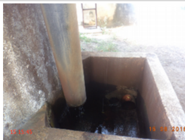
Foto 20 – Filtração: Ocorre vazamento no registro do Filtro F-03.
