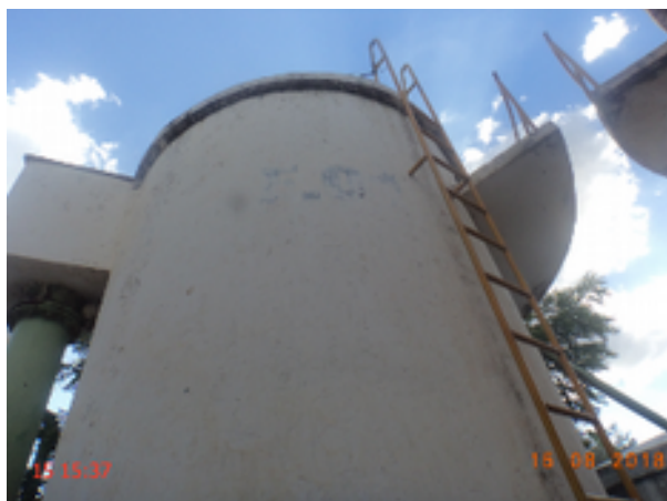
Foto 17 – Filtração: O filtro F-01 está com a pintura deteriorada e com a identificação pouco visível.
