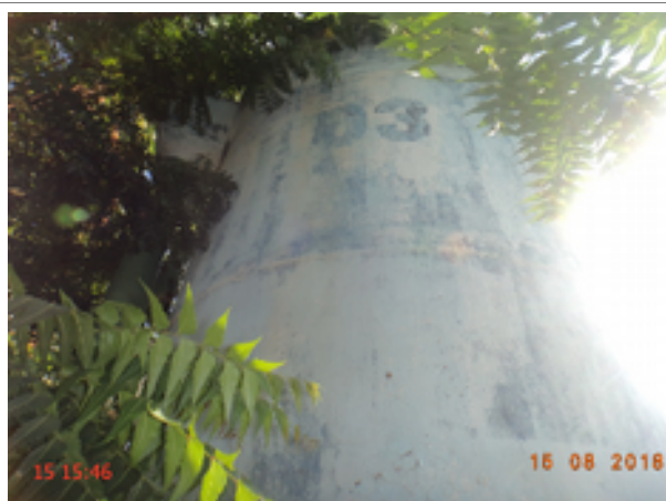
Foto 19 – Filtração: O filtro F-03 está com a pintura deteriorada e com a identificação pouco visível.
