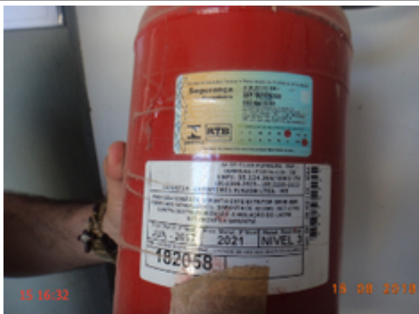
Foto 11 – Comercial: O extintor de incêndio do escritório e almoxarifado da CAGECE está com a recarga vencida.
