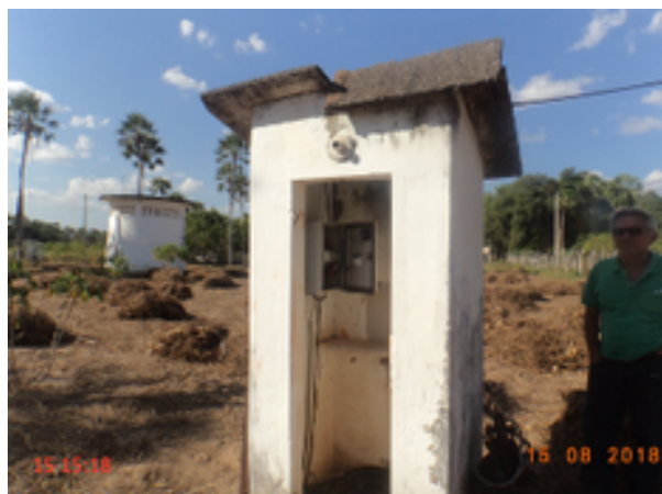
Foto 4 – Captação: A casa de abrigo do poço PT-18 está com a pintura deteriorada, sem iluminação e sem porta instalada.
