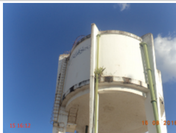
Foto 22 – Reservatório: O reservatório REL-01 está com a pintura deteriorada.
