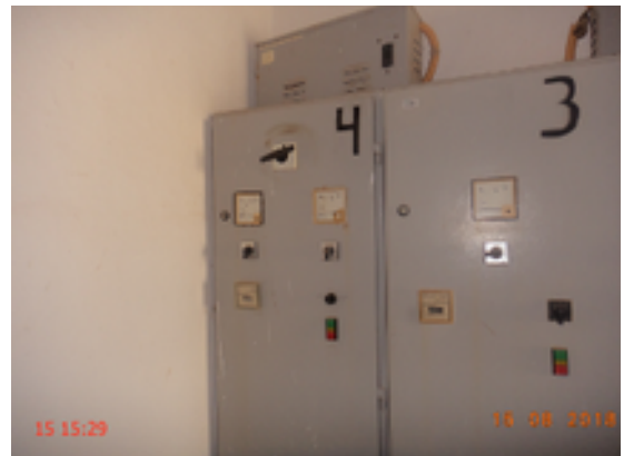
Foto 10 – Elevatória: O quadro de comando 4 da elevatória EELF -01 está com defeito na botoeira.
