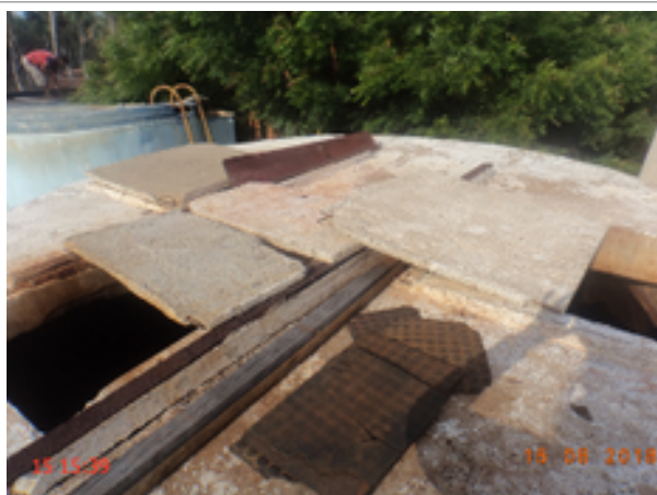
Foto 16 – Filtração: O filtro F-02 está com a tampa de inspeção aberta.
