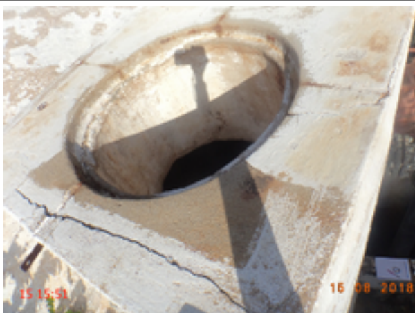
Foto 3 – Reservatório: A laje do reservatório RAP-01 está sem tampa de inspeção.
