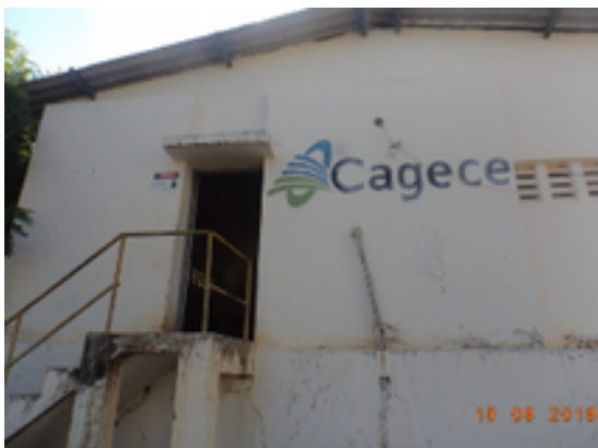
Foto 9 – Elevatórias: A casa de abrigo das elevatórias EEAT-01 e EELF-01 estão com a pintura deteriorada.
