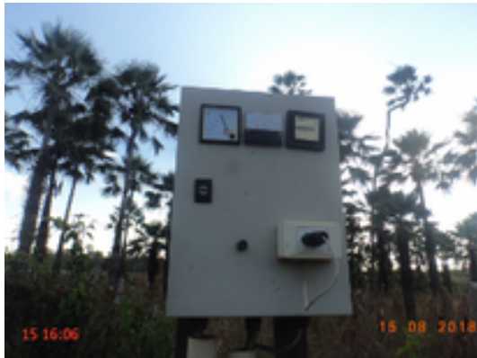
Foto 7 – Captação: Não existe casa de abrigo para o quadro de comando do poço PT-16, nem postes de iluminação no local.
