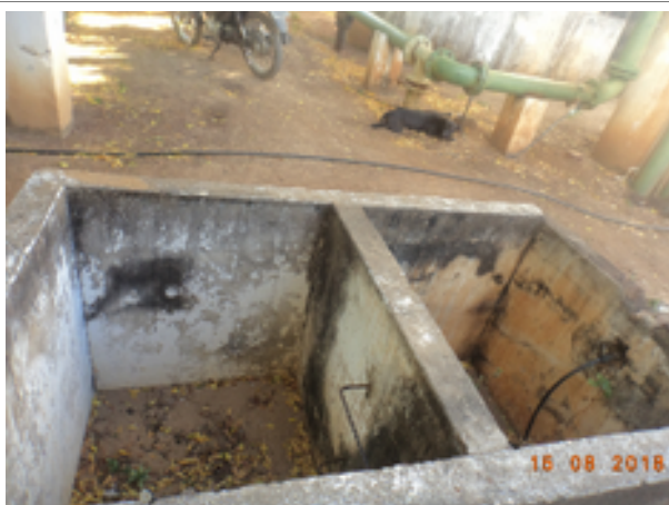
Foto 25 – ETA: Existem caixas de passagem sem tampa ou grade de proteção na área da ETA .
