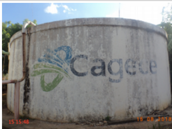
Foto 21 – Reservatório: O reservatório RAP 01 está com a pintura deteriorada.
