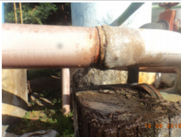
Foto 24 – Filtração: Ocorre vazamento na conexão entre os filtros F-03 e F-04.
