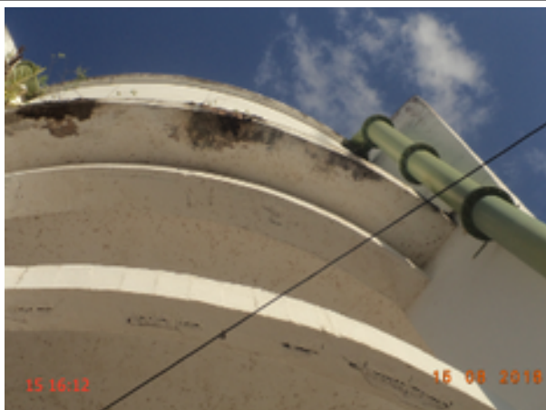
Foto 23 – Reservatório: O reservatório REL-01 está com a pintura deteriorada e apresenta sinais de infiltração e armadura exposta.
