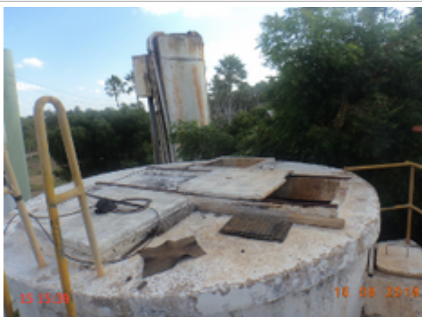
Foto 15 – Filtração: O filtro F-01 está com a tampa de inspeção aberta.
