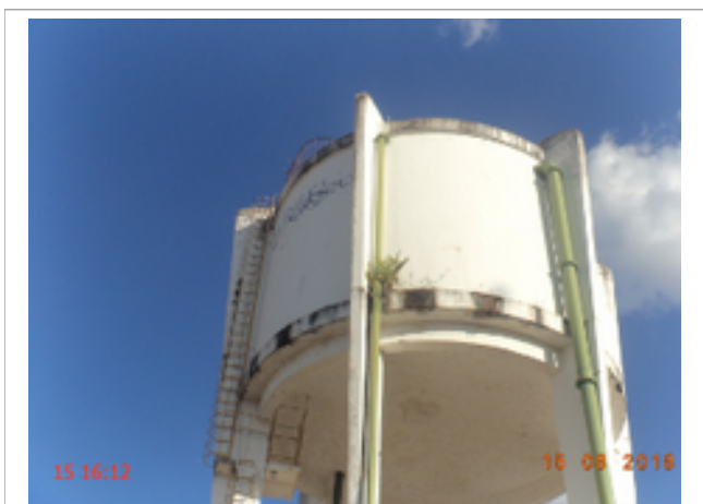
Foto 28 – Reservatório: REL-01 o guarda-corpo não cobre toda a área do reservatório.
