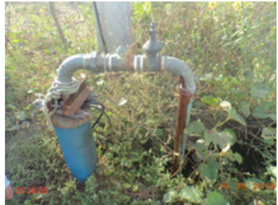
Foto 6 – Captação: Não existe laje de proteção no poço PT-19 .
