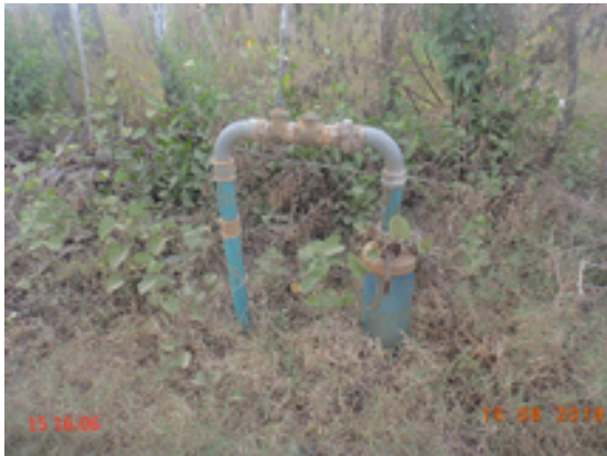
Foto 5 – Captação: Não existe laje de proteção no poço PT-16.
