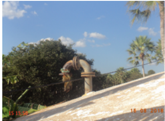
Foto 8 – Reservatório: O reservatório RAP 01 está com a tela de proteção da tubulação de ventilação rasgada.
