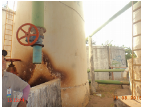
Foto 18 – Filtração: O filtro F-02 está com a pintura deteriorada e com a identificação pouco visível.
