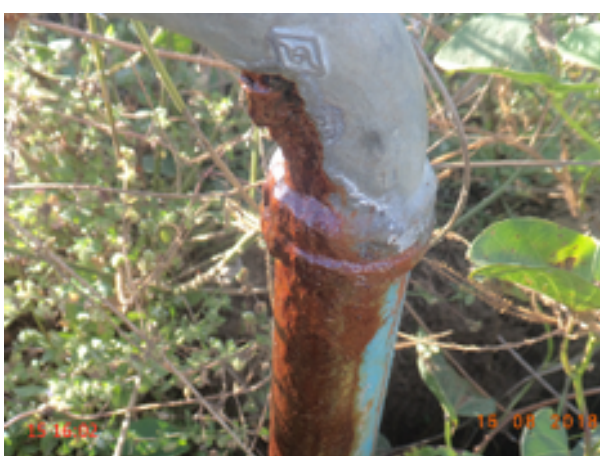
Foto 14 – Captação: Existe um vazamento na curva do poço PT-19.
