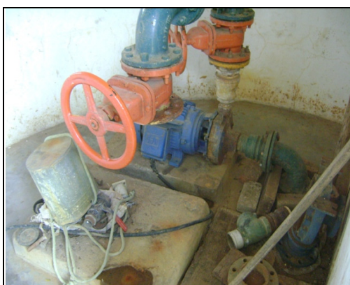
Foto 04 – Conjunto motor-bomba do PA-02 sem bomba reserva
