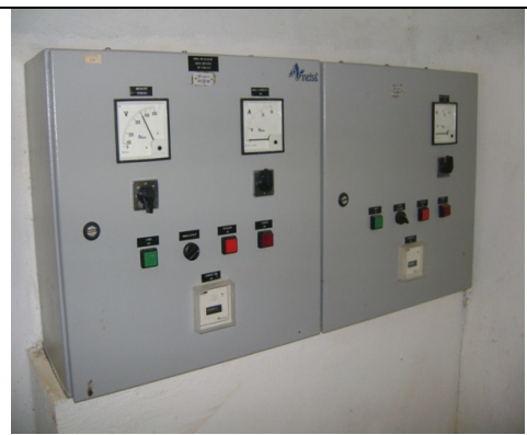
Foto 19 - Quadros elétricos da EEAT-01
