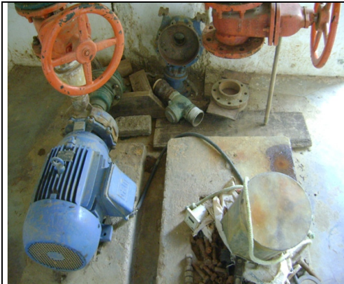
Foto 15 – EEAB-01 sem bomba reserva
