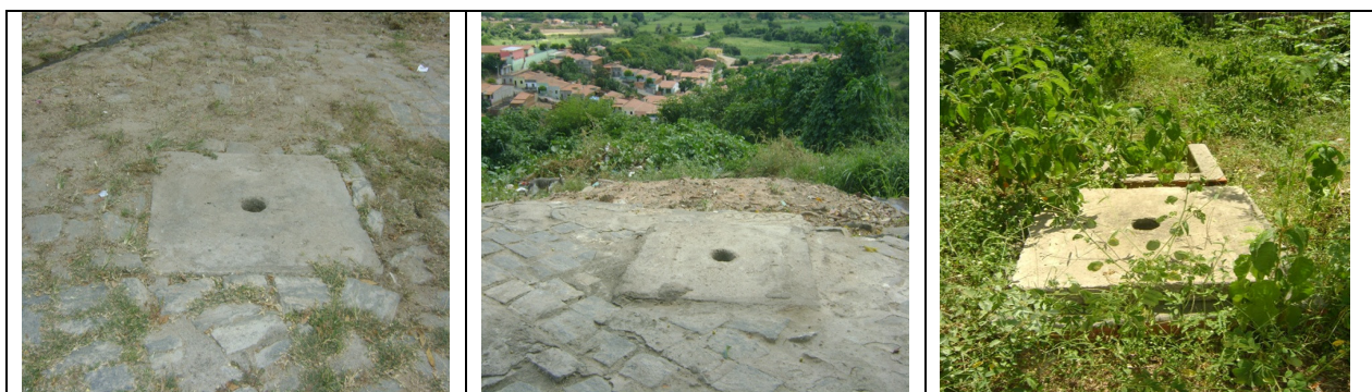
Fotos 28, 29 e 30 – Registros de descarga nas Ruas Pedro Mariano, N.Sra. das Angústias e José Cândido de Araujo
