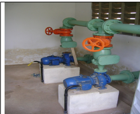
Foto 18 – EEAT-01 conjuntos moto-bombas
