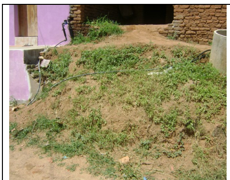
Foto 33 – Ramal de ligação exposto em via pública
