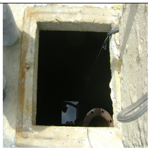
Foto 25 – REL-01 com abertura de inspeção sem tampa
