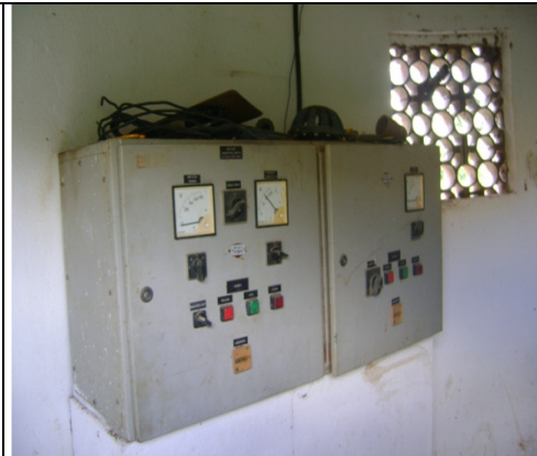
Foto 16 – Quadros elétricos da EEAB-01
