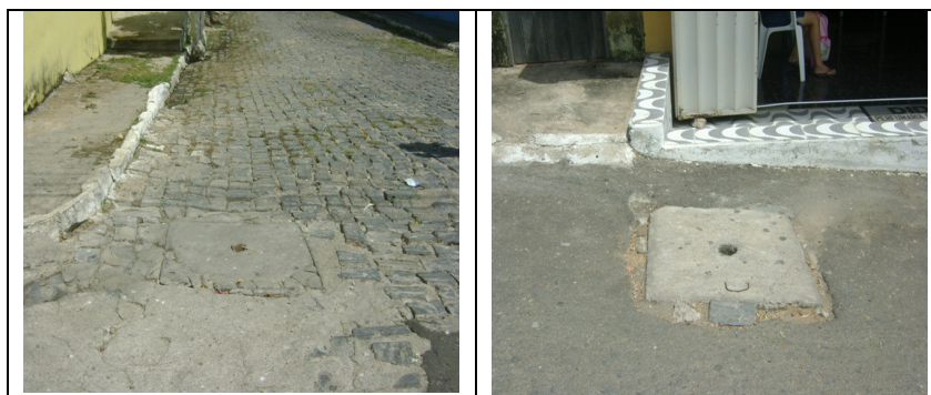
Fotos 31 e 32 – Registros de manobra nas Ruas Oscar Cândido e Antonio Gonçalves Valença
