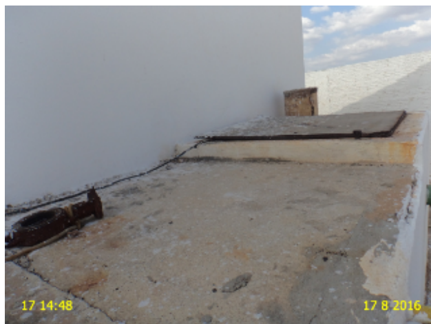
Foto 6 – RSE-01: ausência de tubulação de ventilação.
