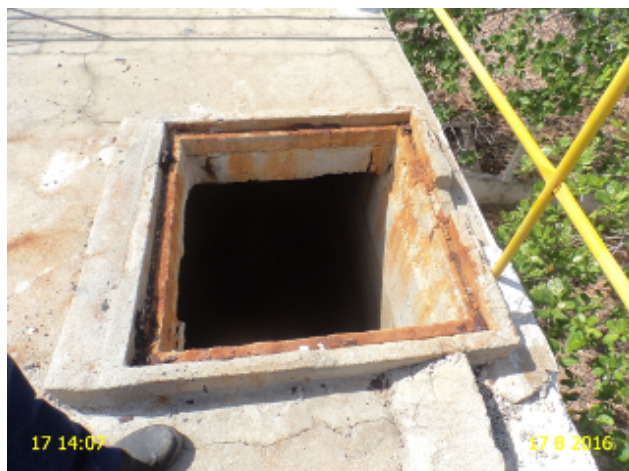
Foto 2 – RAP-03: ausência de tampa de inspeção.
