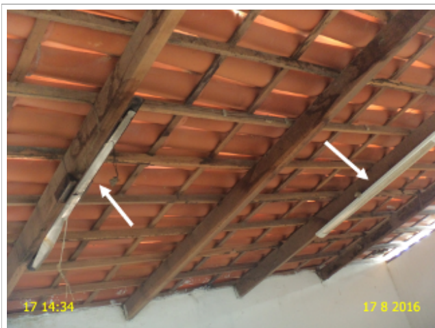
Foto 8 – EEAT-03: ausência de iluminação.
