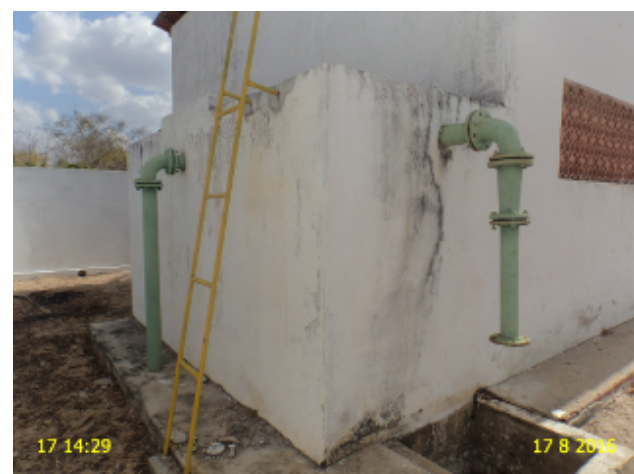
Foto 13 – RAP-05: ausência de identificação.
