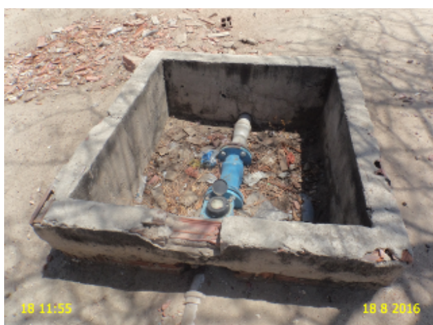
Foto 14 – AAT: caixa do macromedidor sem tampa ou grade de proteção na localidade de Bico da Arara.
