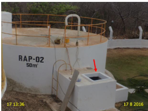
Foto 1 – RAP-02: ausência de tampa de inspeção.
