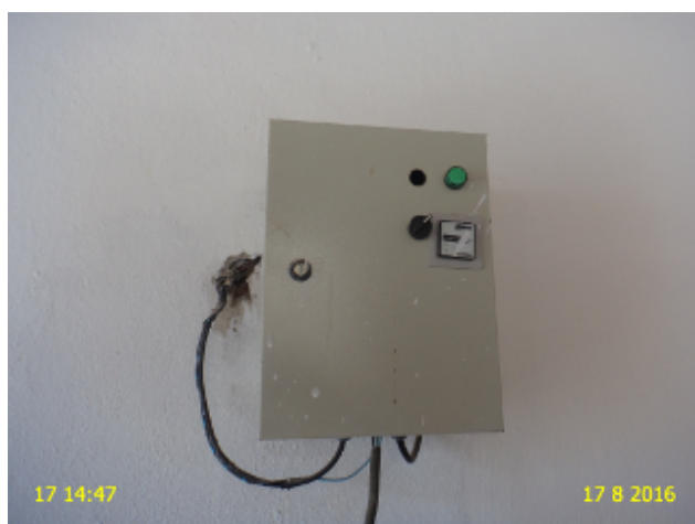
Foto 4 – EEAT-02: quadro de comando sem amperímetro e voltímetro.
