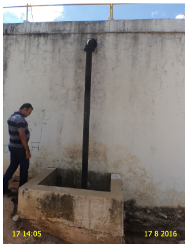
Foto 3 – RAP-03: ausência de medidor de nível.
