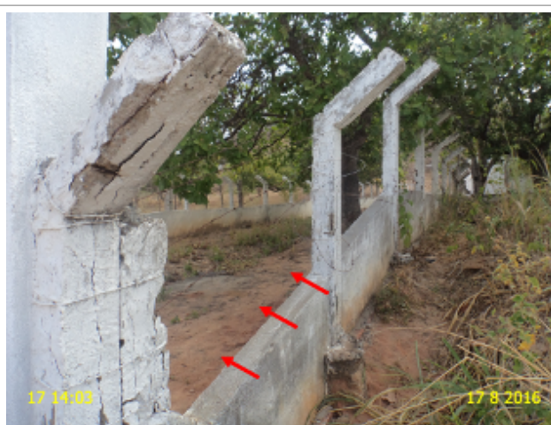
Foto 9 – RAP-03: cerca danificada.
