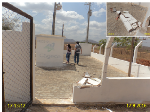
Foto 11 – EECS-01: mureta da casa de abrigo do quadro de comando danificada.
