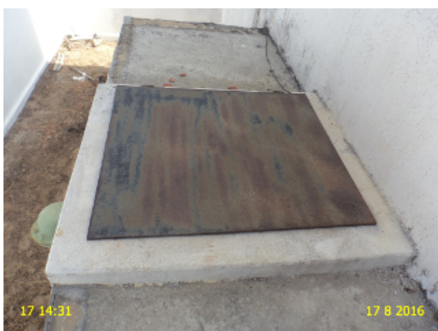
Foto 7 – RAP-05: ausência de tubulação de ventilação.
