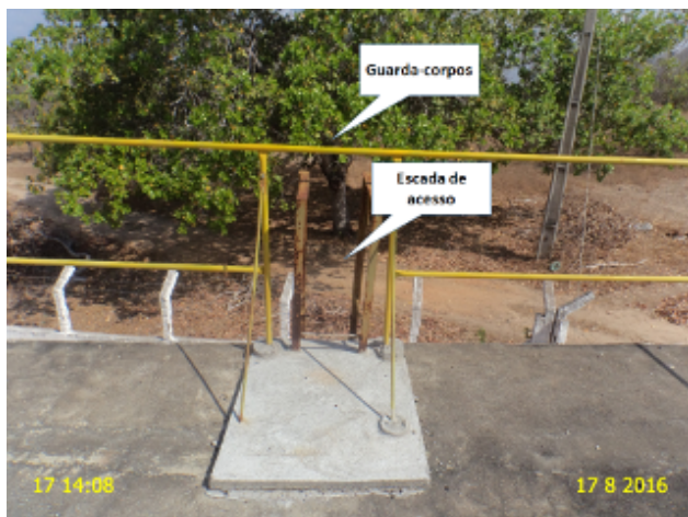
Foto 10 – RAP-03: guarda-corpos inadequado.
