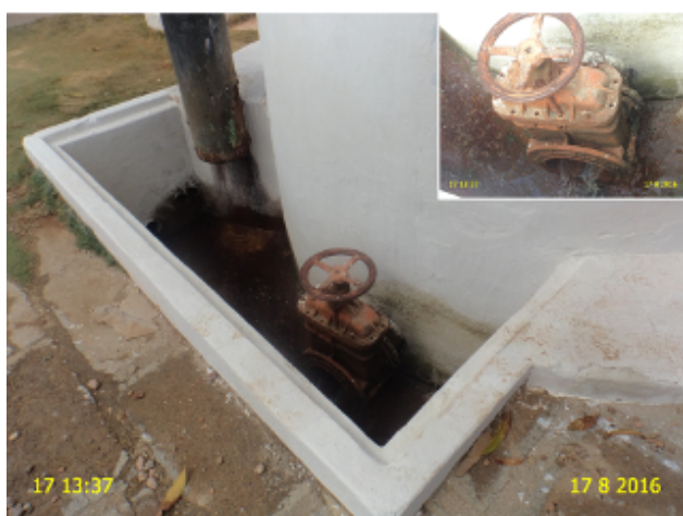
Foto 12 – F-01: com vazamento.
