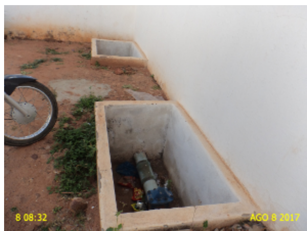
Foto 11 – ETA: caixas de inspeções sem tampa ou grade de proteção.
