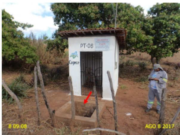
Foto 4 – PT-06: caixa do macromedidor sem tampa ou grade de proteção.
