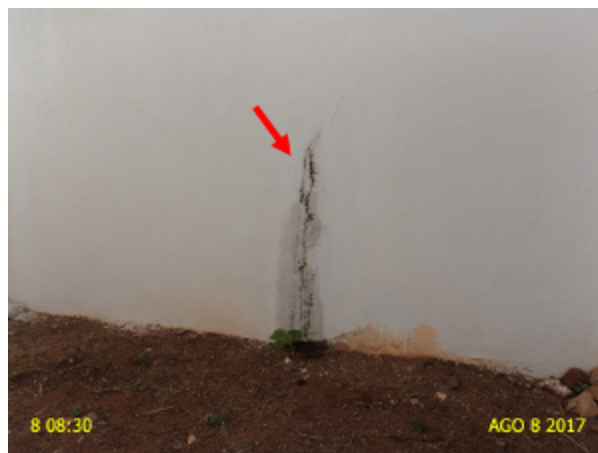
Foto 7 – RAP-01: infiltrações na parede.
