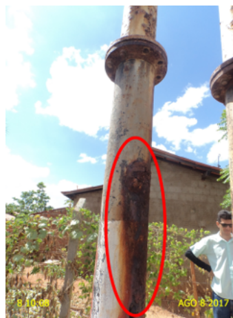
Foto 5 – REL-01: tubulação de descarga deteriorada.
