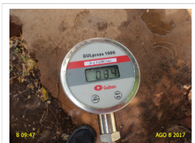
Foto 2 – RDA: medição de pressão instantâneas na Rua Gonçalo Soares Torres, 115.
