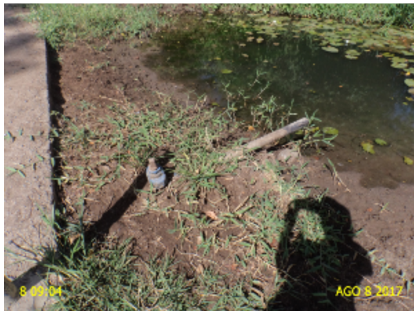
Foto 9 – RDA: registro de descarga sem caixa de inspeção na Rua Lurdes Mourão (passagem molhada).
