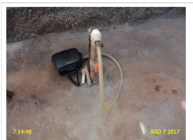
Foto 1 – RDA: aparelho datalogger instalado no endereço localizado na Rua Borete Morão nº 123.
