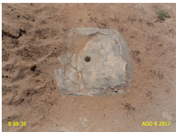
Foto 10 – RDA: registro de descarga danificada na Av. Tso Vicente de Paula (saída para Nova Russas).
