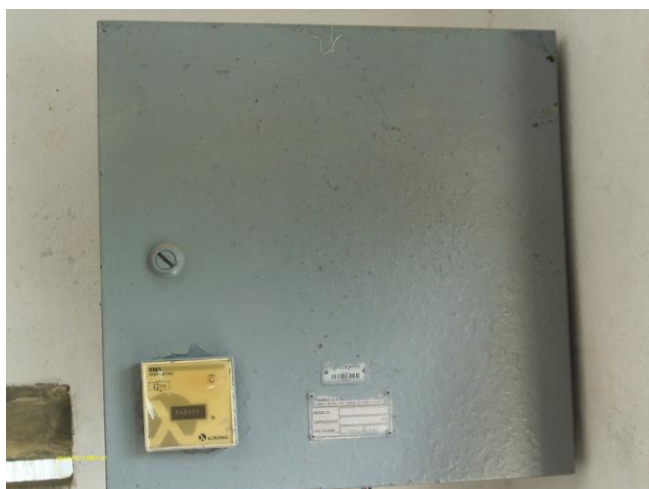
Foto 07 – Quadro de comando do poço PT-03.
