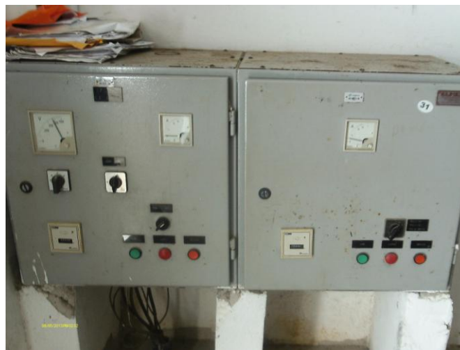
Foto 51 – Quadro de comando da bomba de recirculação.
