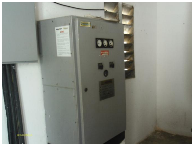
Foto 55 – Quadro de comando do gerador.
