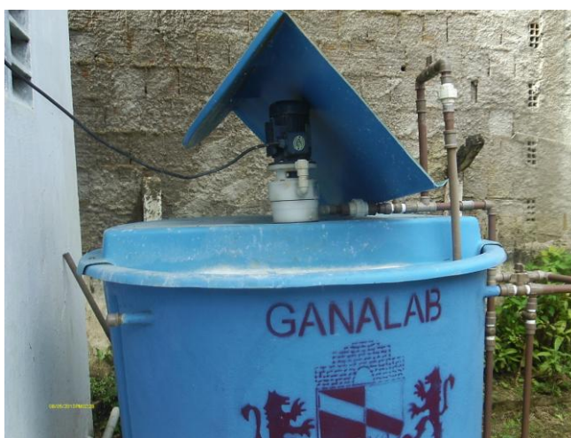
Foto 58 – Dosador de cloro.
