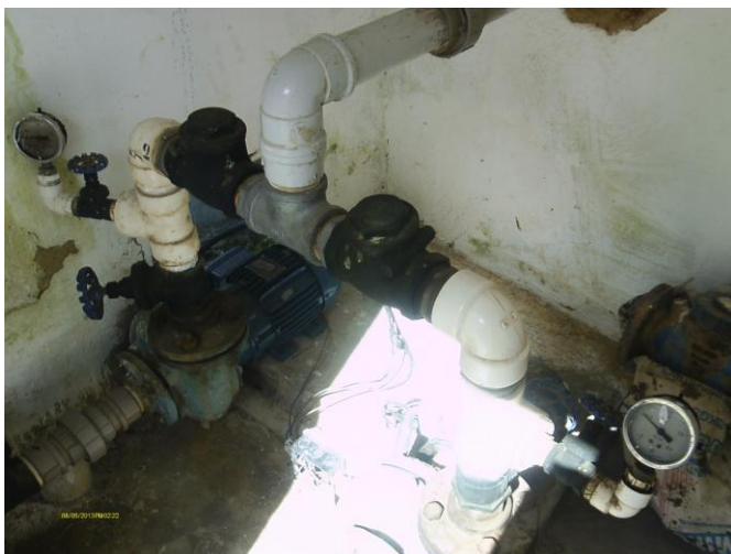
Foto 50 – Bomba para recirculação do lodo.
