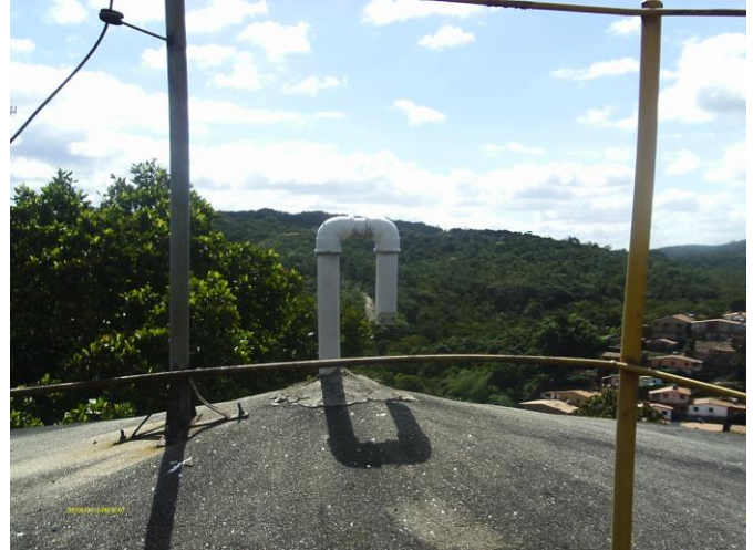
Foto 23 – Tubulação de ventilação sem tela de proteção.
