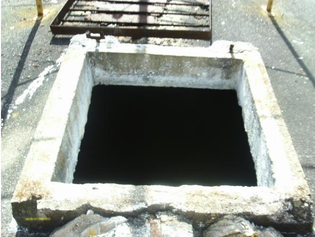
Foto 22 – REL-01: sem tampa de inspeção.
