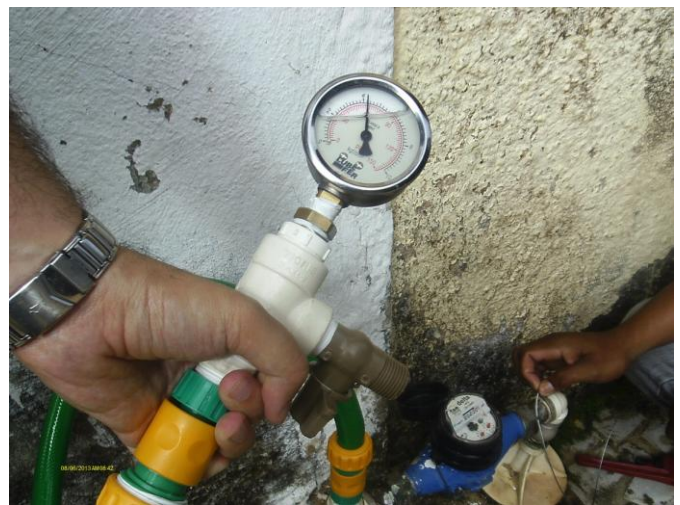
Foto 27 – Medição de pressão na Rua Coronel Linhares, 213 - Centro
