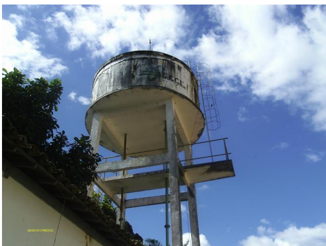
Foto 20 – Vista do REL-01: pintura deteriorada e rachaduras.
