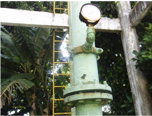
Foto 24 – REL-01: medidor de nível.
