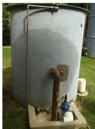
Foto 59 – Tanque de contato.
