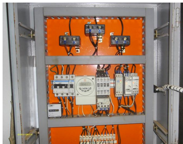
Foto 10 – Quadro de comando Booster.
