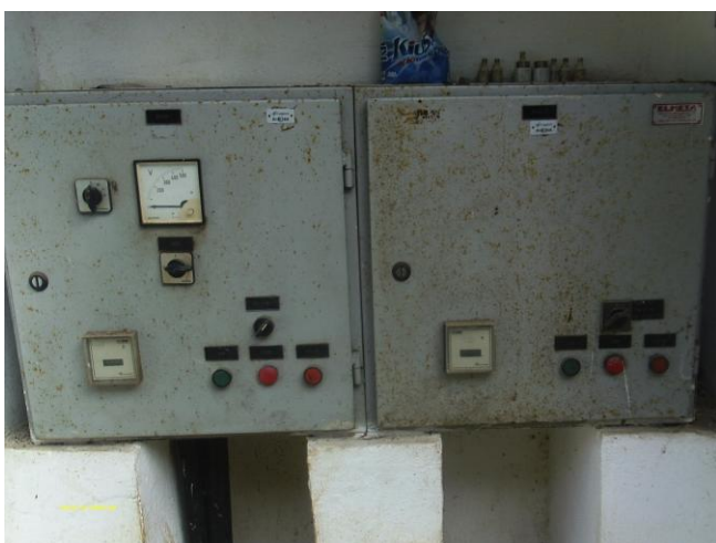
Foto 42 – EEE-01: quadro de comando.
