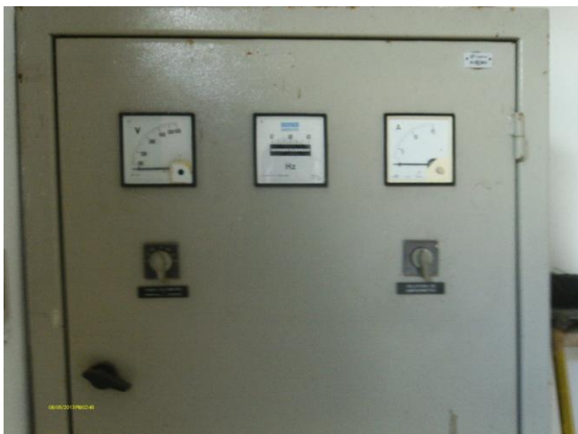
Foto 44 – Quadro de comando do gerador.
