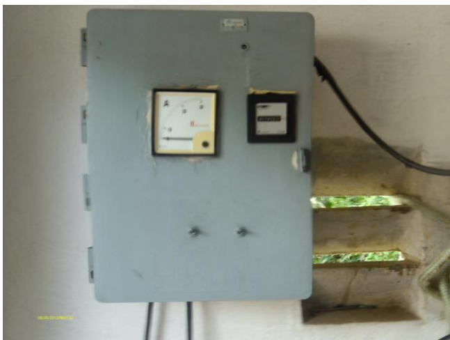
Foto 03 – Quadro de comando do poço PT-01.
