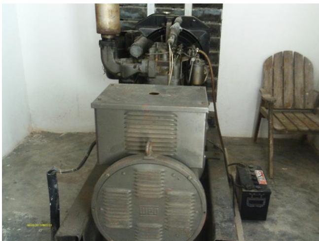
Foto 54 – Gerador com defeito.
