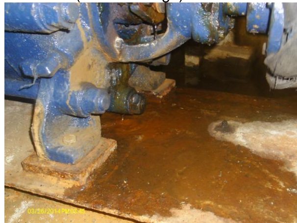
Foto 13 - EEAT-03: vazamento na gaxeta.
