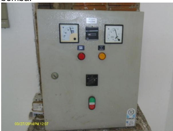
Foto 20 - EERD-02: Quadro de comando.
