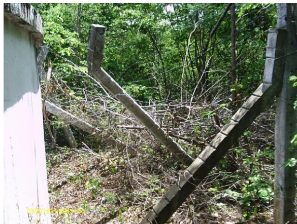
Foto 27 - RAP-08: cerca danificada.
