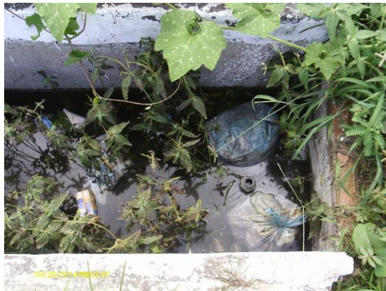
Foto 5 - AAT: Estação Pitométrica implantada sem tampa ou grade de proteção.
