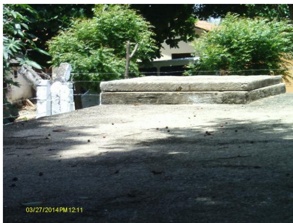
Foto 35 - RSE: tampa de inspeção.
