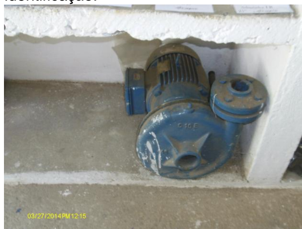
Foto 19 - EERD-02: bomba reserva.
