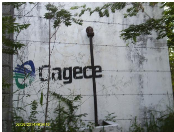
Foto 23 - RAP-07: ausência de identificação do reservatório e pintura deteriorada.
