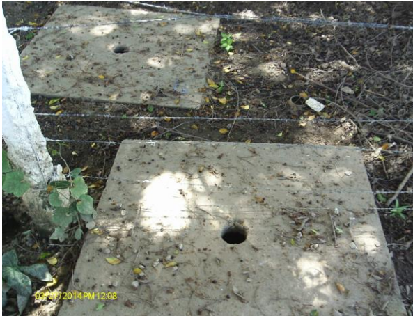
Foto 10 – AAT: Bypass na área da EERD-02 (Booster Antônio Diogo).
