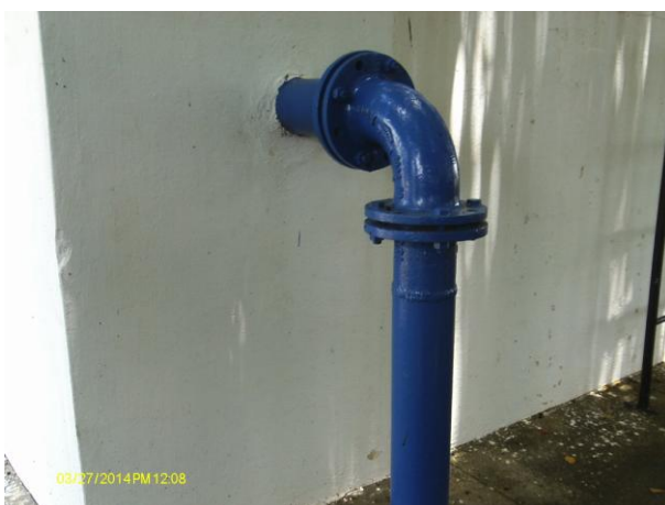
Foto 32 - RSE: tubulação de entrada de água.
