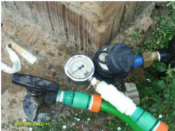
Foto 42 - Medição instantânea de pressão na rede de distribuição: Rua Santa Isabel, SMS 54 - Colônia.
