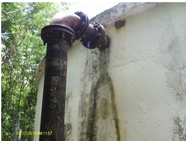
Foto 30 - RAP-08: tubo extravasor.
