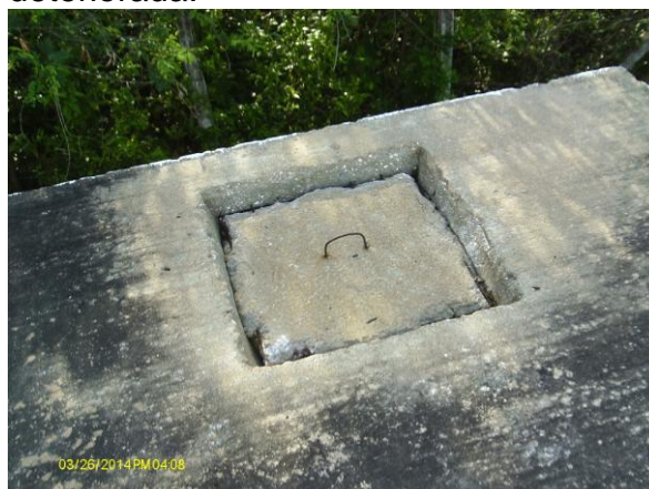
Foto 25 - RAP-07: tampa de inspeção rebaixada.
