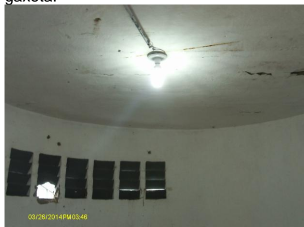
Foto 15 - EEAT-03: parede danificada e iluminação interna.
