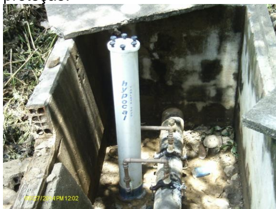
Foto 7 - AAT: Recloração próximo ao RAP-08 (caixa danificada).
