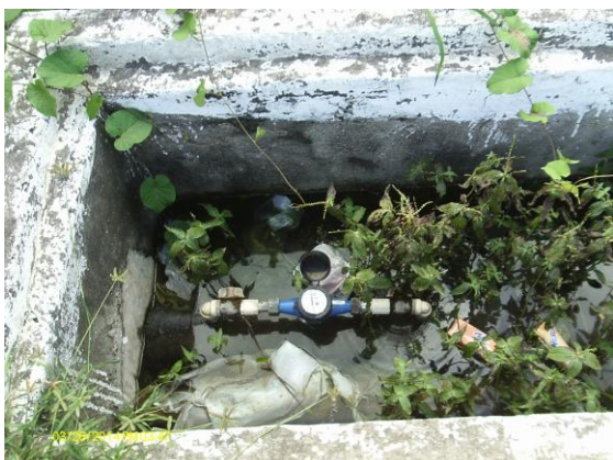
Foto 6 - AAT: medidor proporcional instalado sem tampa ou grade de proteção.
