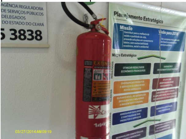
Foto 56 -Comercial/escritório/almojarifado: extintor de incêndio dentro do prazo de validade da recarga.
