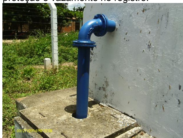
Foto 33 - RSE: tubo extravasor.
