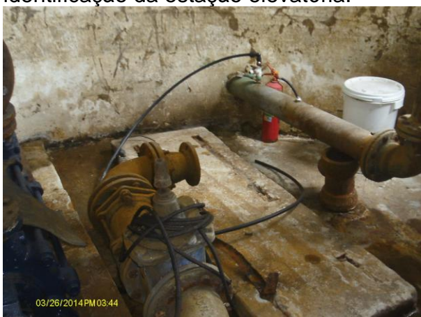
Foto 14 - EEAT-03: ausência de bomba reserva.
