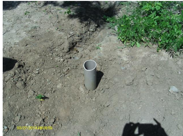
Foto 47 - Registro de descarga na rede de distribuição sem caixa: Rua SDO 20.
