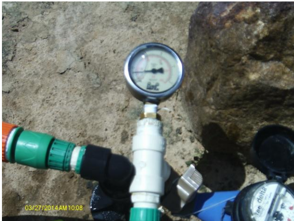
Foto 40 - Medição instantânea de pressão na rede de distribuição: Rua Francisco Severino, SMS 13 - Conj. Habitacional.
