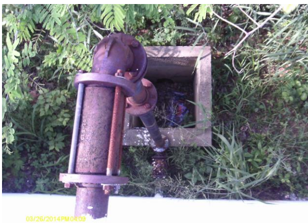
Foto 24 - RAP-07: tubo extravasor em processo de corrosão e caixa de descarga de fundo sem tampa ou grade de proteção.
