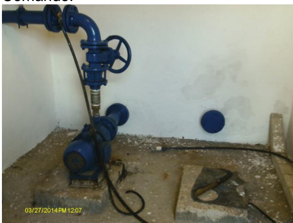
Foto 18 - EERD-02: conjunto moto-bomba.
