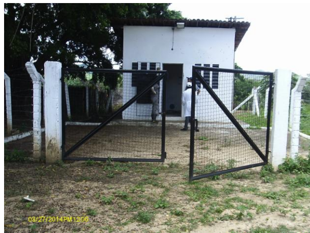
Foto 17 - EERD-02: ausência de identificação.
