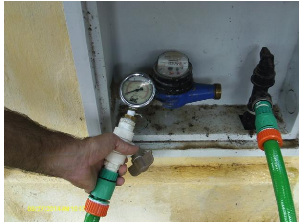
Foto 41 - Medição instantânea de pressão na rede de distribuição: Rua Joaquim Gabriel, 01 - Conj. Habitacional.
