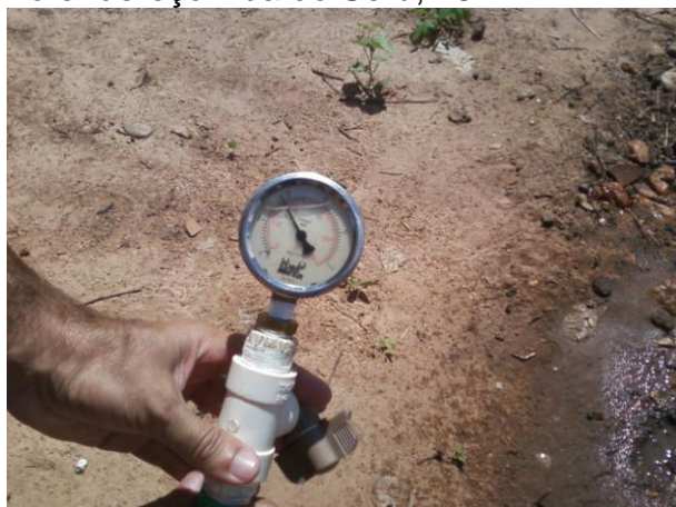
Foto 38 - Medição instantânea de pressão na rede de distribuição: Rua Pe Severino, SMS 9.
