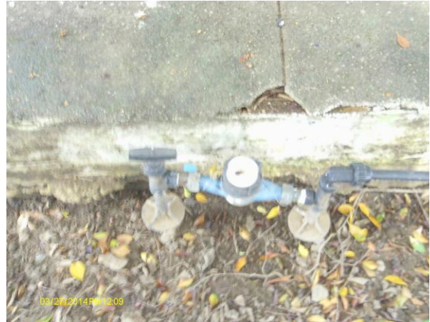
Foto 11 - AAT: medidor proporcional instalado na saída do RSE.
