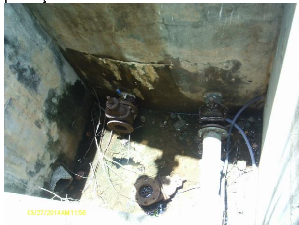
Foto 31 - RAP-08: caixa do registro e descarga de fundo sem tampa ou grade proteção e vazamento no registro.
