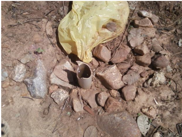
Foto 46 - Registro de descarga na rede de distribuição sem caixa localizado na Rua Pe Severiano.
