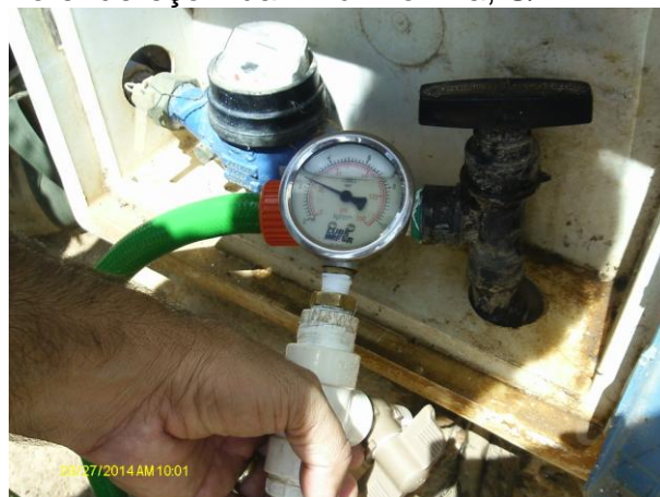
Foto 39 - Medição instantânea de pressão na rede de distribuição: Rua SDO 20, S/N.
