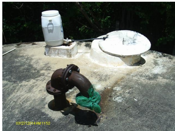
Foto 29 - RAP-08: tampa de inspeção, tanque para recloração (hypocal) e tubulação de ventilação com tela de proteção.
