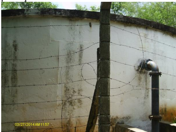
Foto 26 - RAP-08: ausência de identificação e pintura deteriorada.
