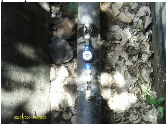
Foto 8 - AAT: medidor proporcional instalado próximo ao RAP-08 sem tampa ou grade de proteção
