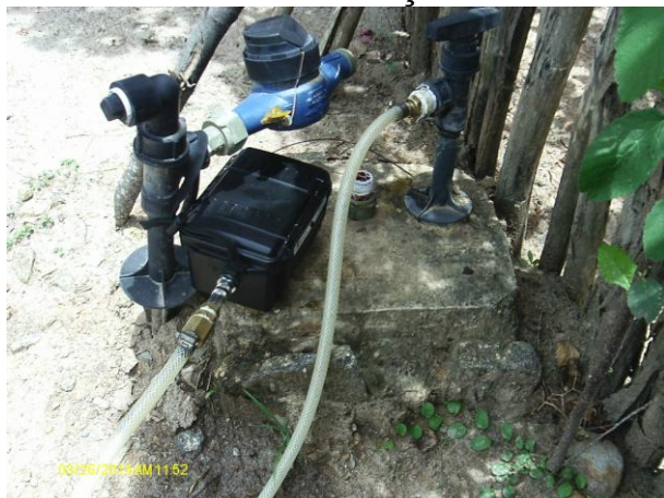
Foto 36 - Equipamento de medição contínua de pressão datalogger instalado no endereço Rua do Seru, 15.
