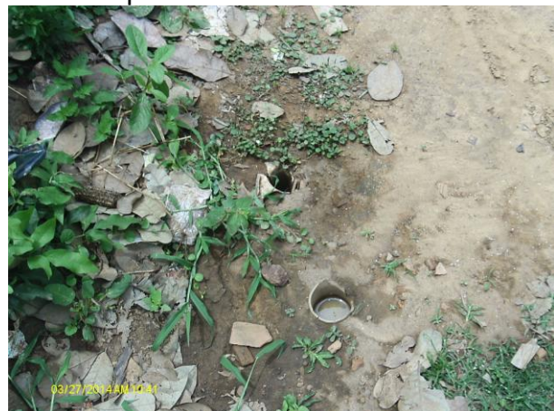
Foto 51 - Registro de descarga na rede de distribuição localizado na Rua Luis Soares.
