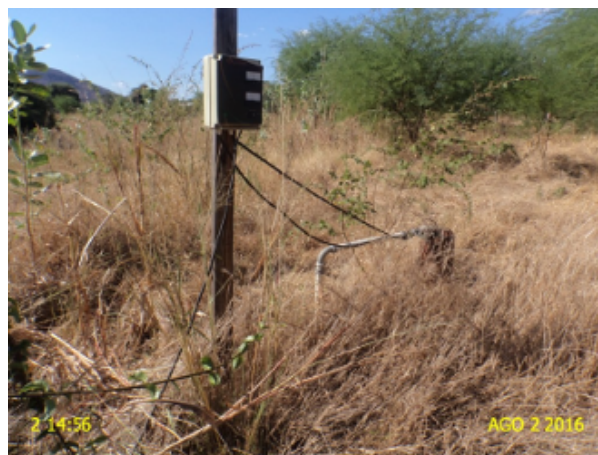
Foto 6 – PT-03: ausência de identificação.
