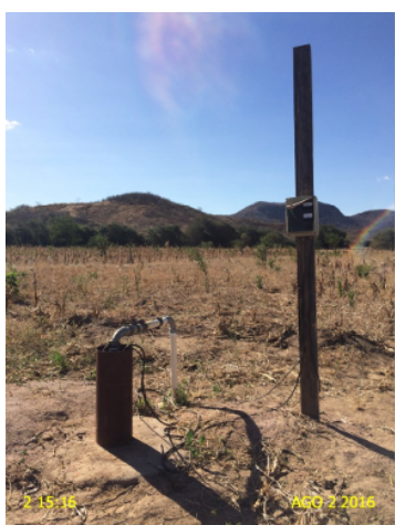
Foto 9 – PT-07: ausência de identificação.
