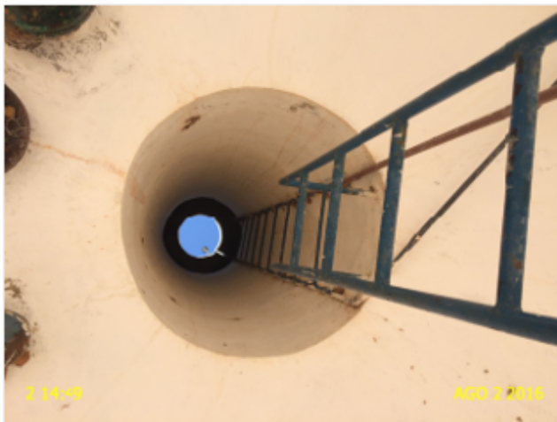
Foto 2 – REL-01: ausência de tampa de inspeção.
