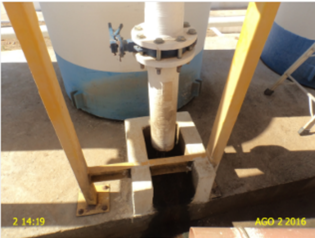
Foto 13 – F-02: registro com vazamento.
