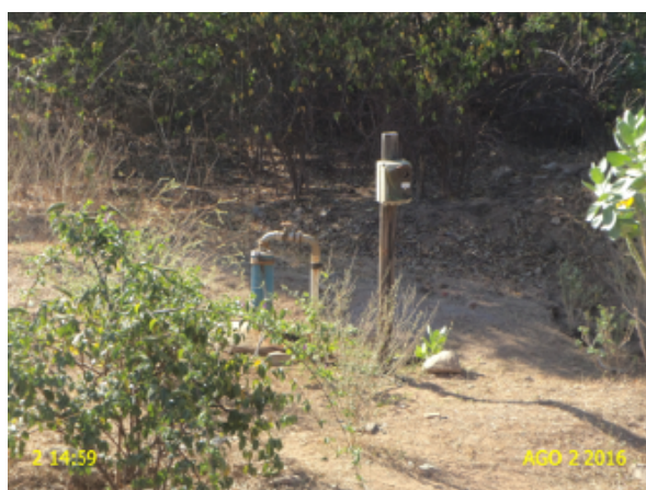
Foto 7 – PT-05: ausência de identificação.
