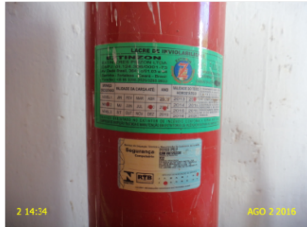
Foto 12 – Elevatórias: data de validade da carga vencida desde agosto/2014.
