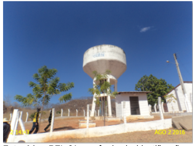
Foto 14 – REL-01: ausência de identificação e pintura deteriorada.
