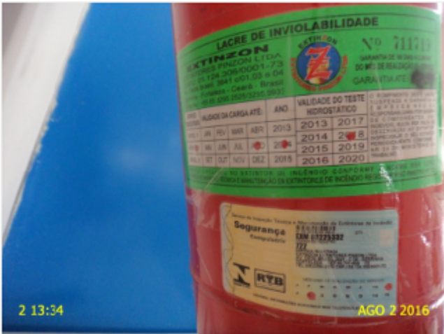
Foto 11 – Loja de atendimento: data de validade da carga vencida desde agosto/2014.
