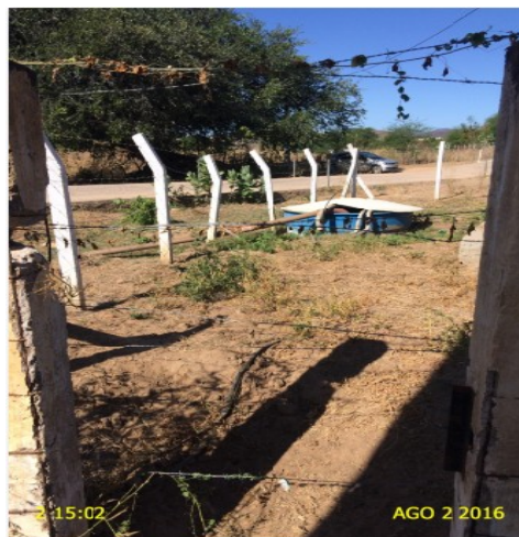
Foto 4 – RSE: cerca danificada.
