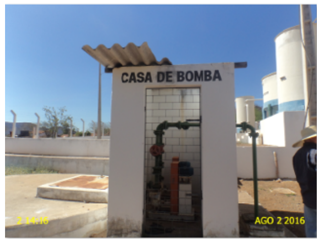
Foto 16 – EEAR-01 (desativada): casa de bomba com telhado deteriorado.
