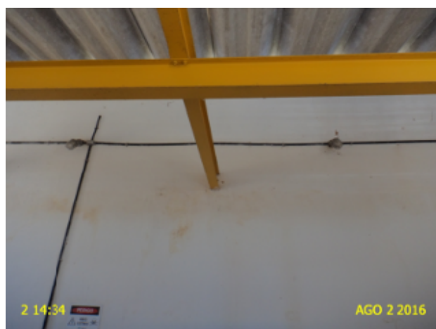
Foto 10 – Elevatórias: lâmpadas sem funcionar.
