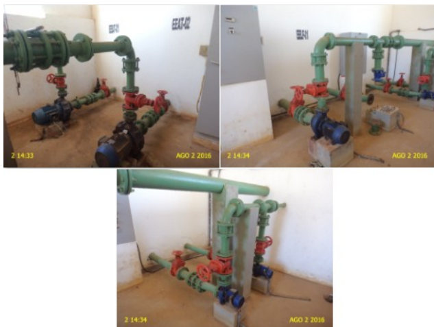
Foto 17 – Gerencial: elevatórias identificadas diferente do Croqui.
