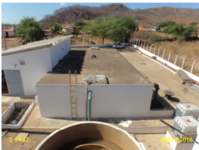
Foto 3 – RAP-01: tampas em processo de corrosão.
