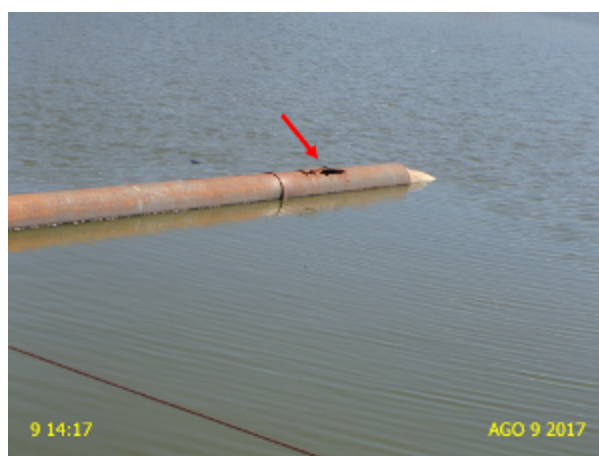
Foto 4 – ETE - Maratoan: tubulação de chegada com corrosão.
