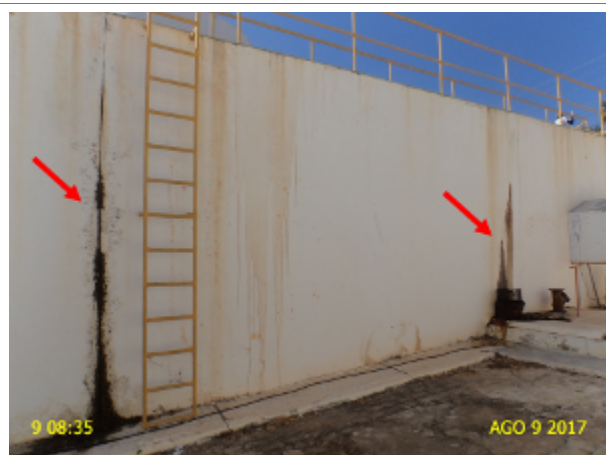
Foto 5 – ETA (Decantador): ausência de identificação e com infiltrações na parede.
