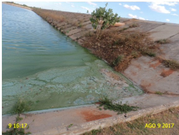
Foto 27 – ETE (Revoltosos): presença de vegetação nos taludes da lagoa de maturação.
