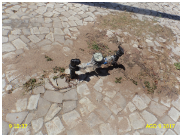
Foto 42 – RDA: Falta d'água no ponto de medição da Rua Gentil Falcão – Ginásio Poliesportivo.
