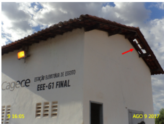
Foto 17 – EEE-G1 Final: telhado danificado.
