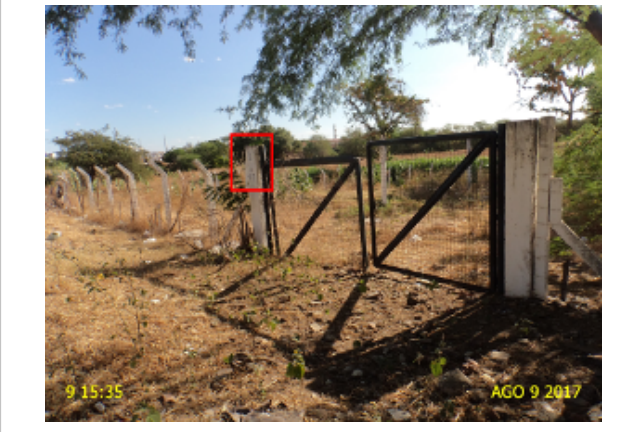
Foto 12 – ETE-07: identificação pouco visível, portão danificado e vegetação excessiva na área interna.
