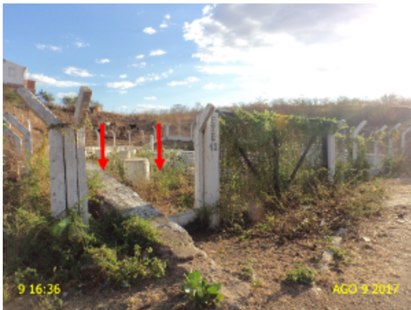
Foto 15 – ETE-12: cerca danificada e vegetação excessiva na área interna.
