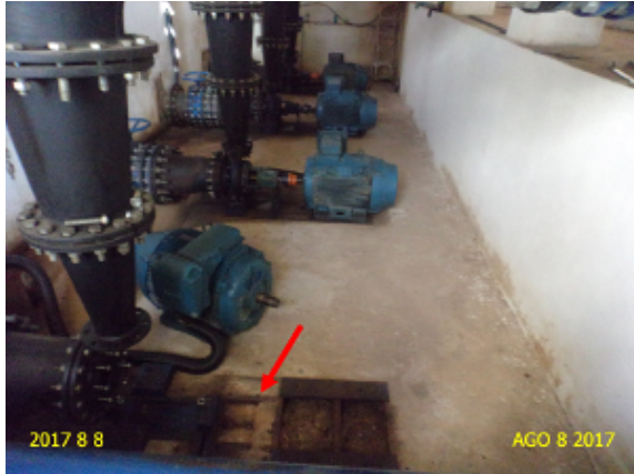
Foto 1 – EEAB-04 (Sacramento): ausência de bomba reserva.
