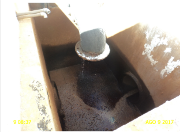
Foto 7 – ETA (Filtros): vazamento no registro de saída.
