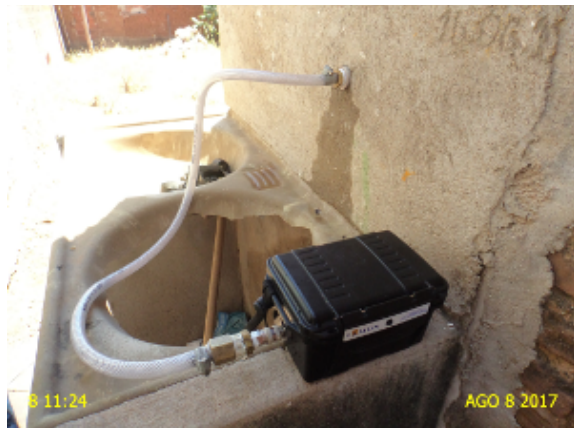
Foto 40 – RDA: aparelho datalogger instalado no endereço localizado na Rua Alexandre Bonfim, nº 397.
