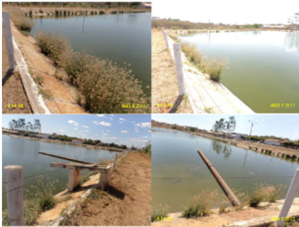
Foto 25 – ETE (Maratoan): presença de vegetação nos taludes da lagoa facultativa.
