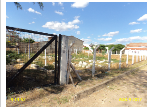
Foto 31 – ETE-09: portão danificado e vegetação excessiva na área interna.
