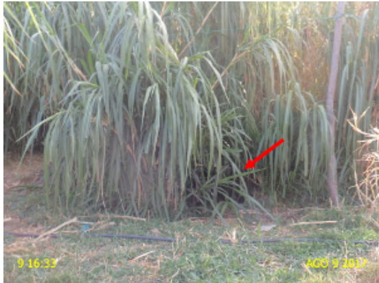
Foto 39 – ETE-13: local de descarga do efluente com aspecto inadequado e encoberto por vegetação.
