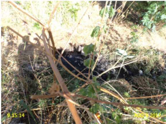
Foto 35 – ETE-03: local de descarga do efluente com aspecto inadequado e encoberto por vegetação.
