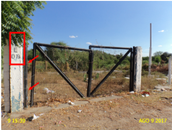
Foto 13 – ETE-08: identificação pouco visível e portão danificado.
