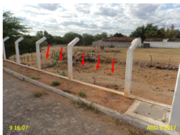
Foto 6 – EEE-G1 Final: cerca danificada.
