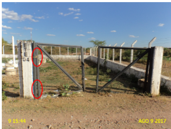
Foto 29 – ETE-04: portão de acesso danificado.
