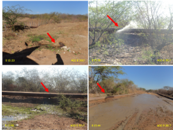
Foto 19 – AAB (Belmonte): vazamento na adutora.
