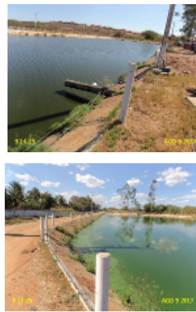
Foto 26 – ETE (Maratoan): presença de vegetação nos taludes das lagoas de maturação LM1 e LM2.
