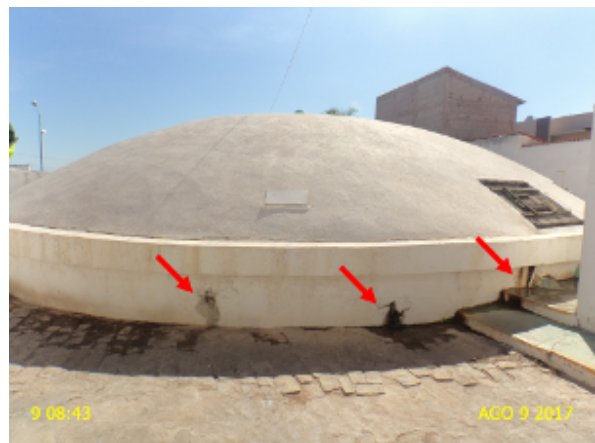
Foto 22 – RSE-01: infiltrações na parede e ausência de identificação.
