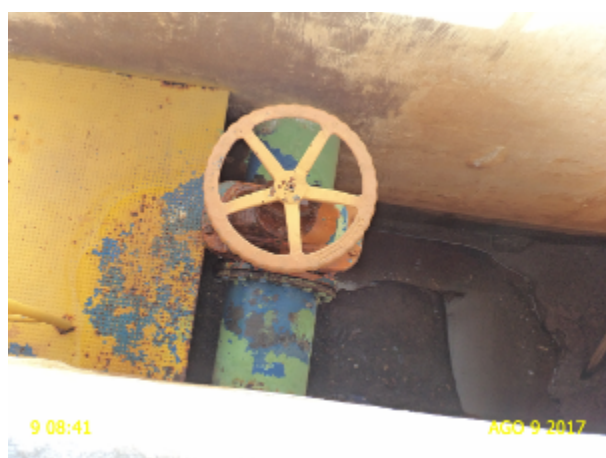
Foto 3 – RSE-02: vazamento no registro.
