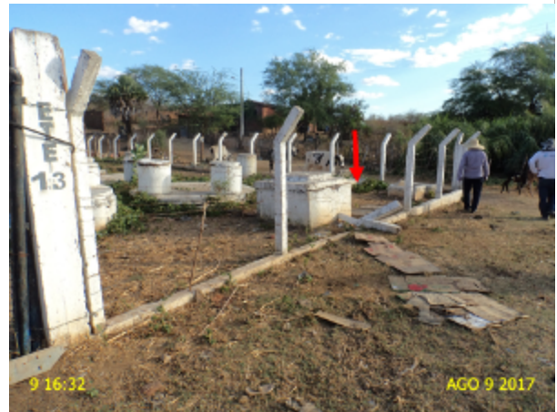
Foto 16 – ETE-13: cerca danificada.
