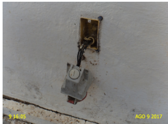
Foto 18 – EEE-G1 Final: tomada do gerador danificada.
