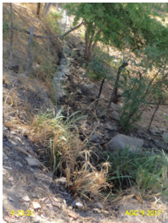
Foto 37 – ETE-06: local de descarga do efluente com aspecto inadequado e encoberto por vegetação.
