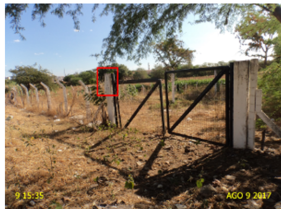
Foto 30 – ETE-07: identificação pouco visível, portão danificado e vegetação excessiva na área interna.
