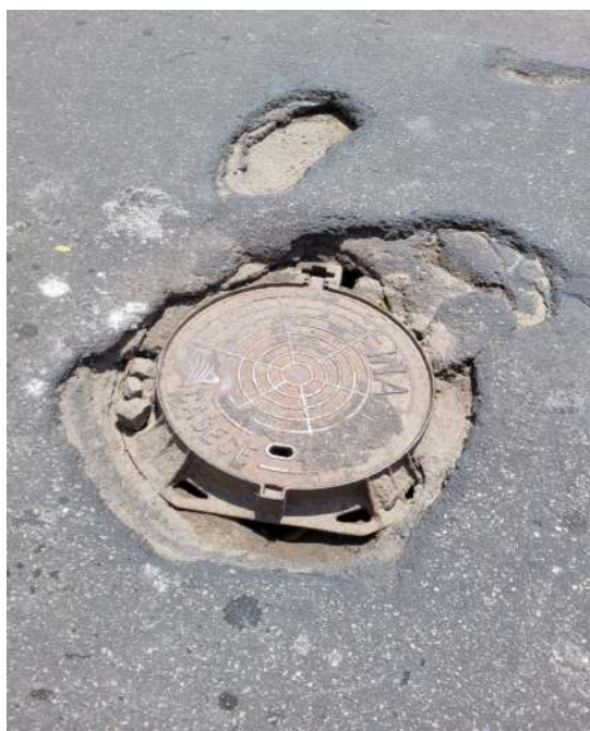
Foto 7 - Poço de visita com vedação inadequada.
