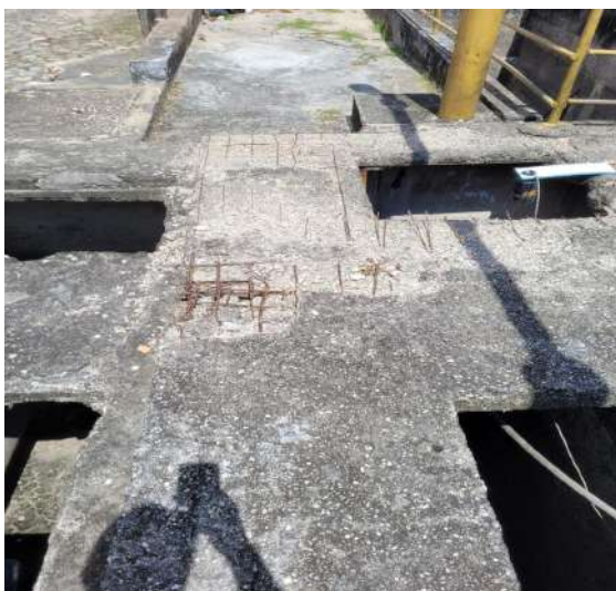
Foto 5 - EEE: Laje do poço de sucção com aço exposto da estrutura e ausência de tampas.
