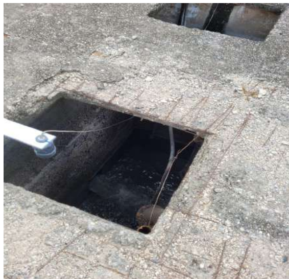
Foto 4 - EEE: Laje do poço de sucção com aço exposto da estrutura e ausência de tampas.
