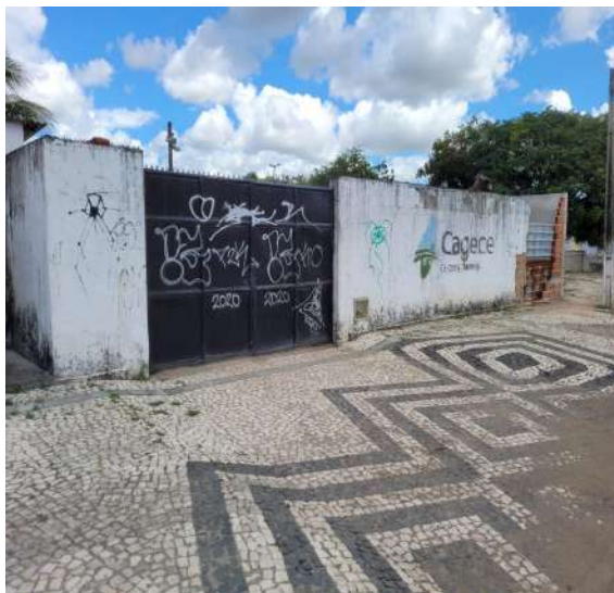
Foto 3 - EEE: Fachada com pintura desgastada e muro sem vedação completa.
