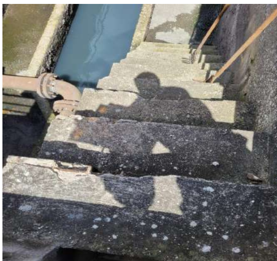
Foto 6 - EEE: Escada com degraus deteriorados e ausência de guarda-corpo.
