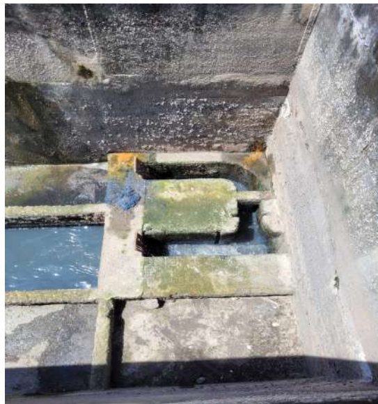
Foto 11 - EEE: Ausência de comportas de controle de fluxo para caixa de areia.
