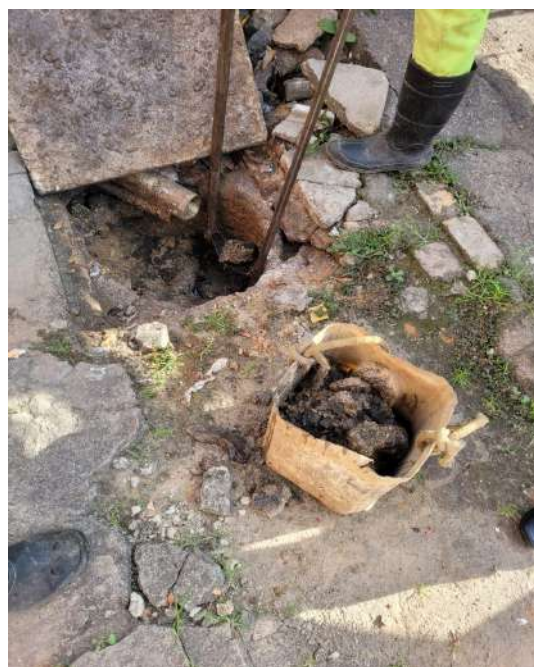
Foto 8 - Caixa de ligação em mau estado de conservação.
