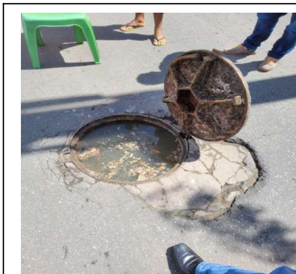
Foto 1 - Poço de visita na Av. Edson Magalhães obstruído .
