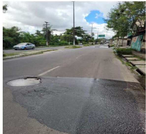
Foto 2 - Extravasamentos de poços de visita na Av. Edson Magalhães.
