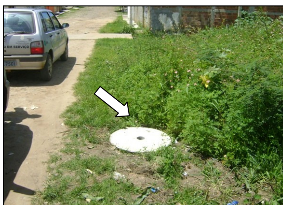
Foto 29 – Registro de descarga, localizado na Rua Irineu Pinto da Silveira, Castelo.
