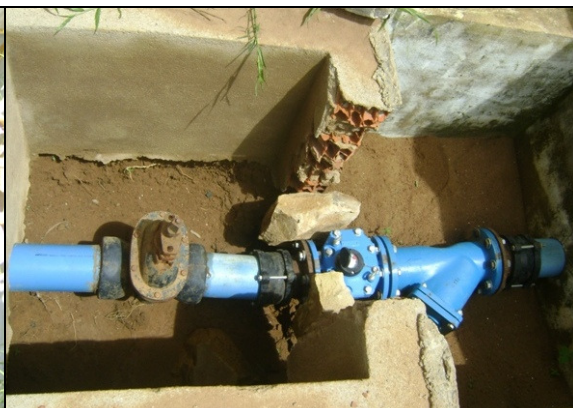
Foto 20 – Macromedidor de água tratada, sem tampa de proteção, na entrada da REL (Fórum).
