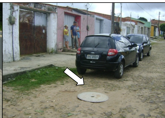
Foto 26 – Registro de descarga localizado na Rua Francisco Sabino da Costa, Centro.
