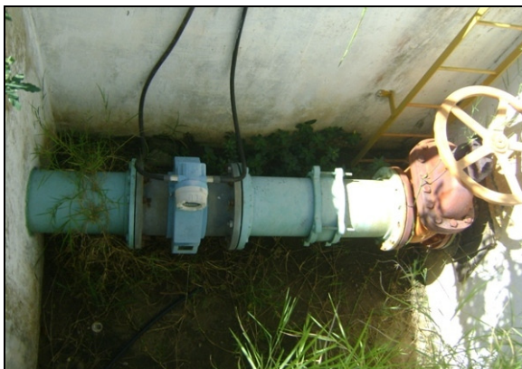
Foto 19 – Macromedidor de água tratada na saída da EEAT-05.
