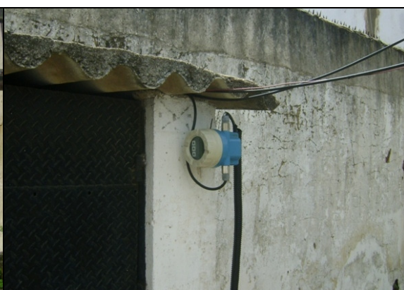
Foto 22 – Leitor do macromedidor de água tratada na entrada da REL (Centro).
