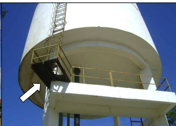
Foto 17 – Oxidação na base da escada do REL (Cruzeiro).
