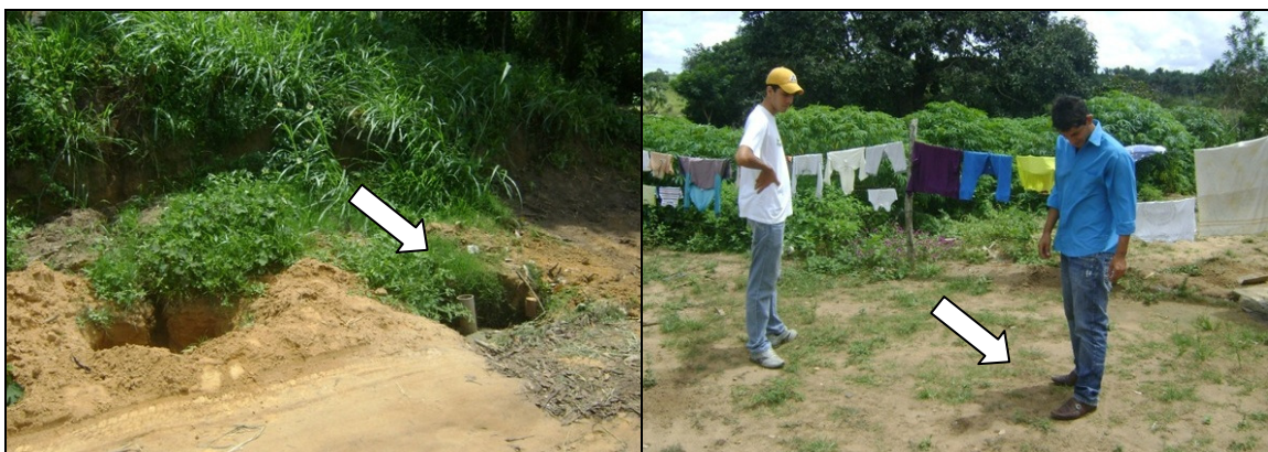
Foto 27 – Registro de descarga, sem caixa de proteção, localizado estrada do Sítio Lagoa.
