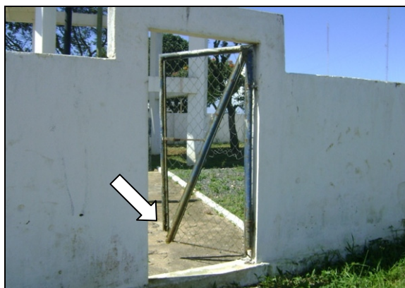
Foto 18 – Portão de acesso do REL (Cruzeiro) danificado.
