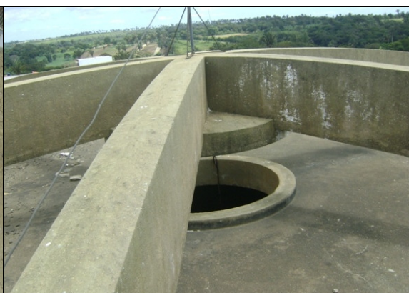
Foto 15 – Ventilação do REL (Centro).
