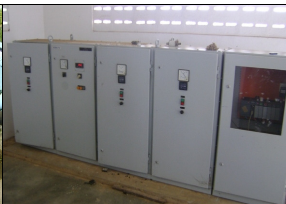
Foto 2 – Quadro de comando da EEAT-05.
