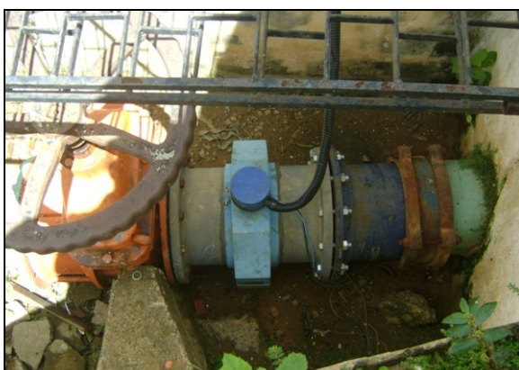
Foto 21 – Macromedidor de água tratada na entrada da REL (Centro).
