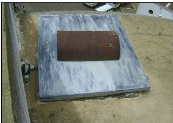
Foto 14 – Tampa de inspeção do REL (Centro).
