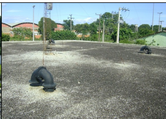
Foto 8 – Ventilações sem tela de proteção do RAP-09.
