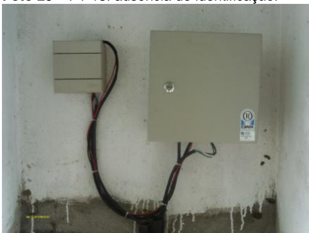
Foto 25 – PT-13: quadro de comando sem horímetro.
