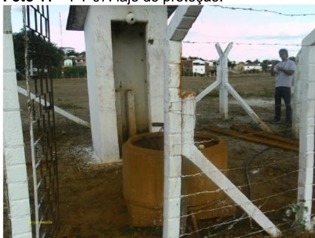
Foto 13 – PT-08: portão de entrada sem fixação e ausência de iluminação externa.
