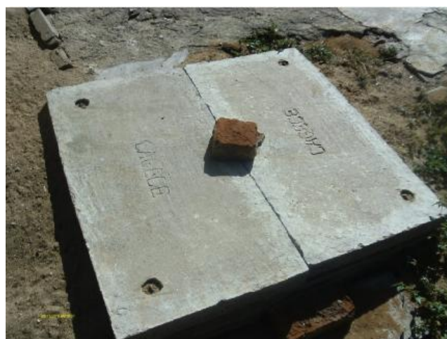
Foto 96 – Rede de distribuição: registro de descarga na Rua Alípio Oliveira (1).
