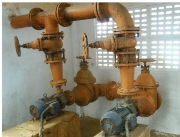
Foto 58 – EEAB-01: conjunto moto-bomba.
