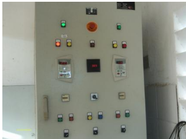
Foto 64 – EEAB-02: quadro de comando.
