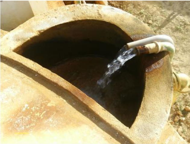
Foto 86 – RAP-01: caixa de recepção sem tampa.
