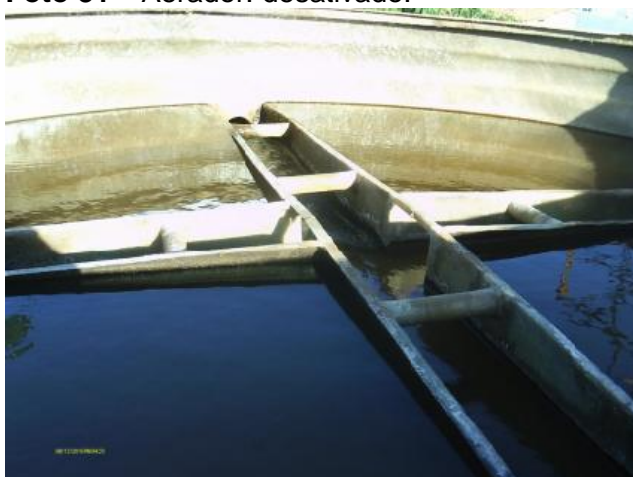
Foto 33 – Decantador: vista superior.
