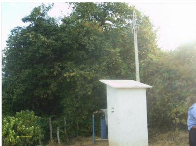
Foto 23 – PT-13: ausência de identificação.
