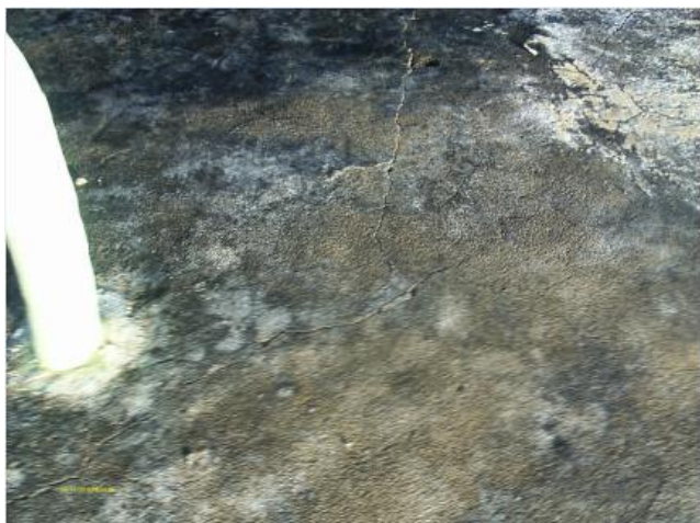
Foto 92 – RAP-03: estrutura rachada.
