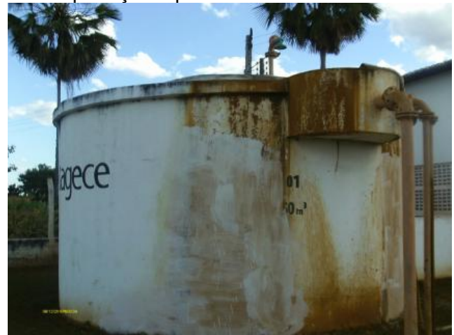
Foto 77 – RAP-01: ausência de identificação e pintura deteriorada.
