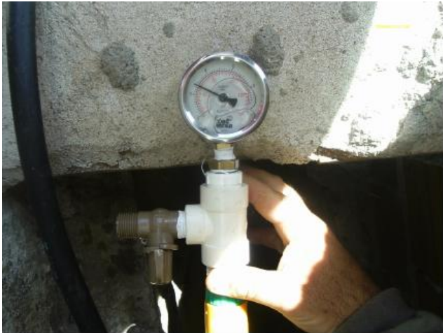
Foto 103 – Medição instantânea de pressão na Trav. Cônego Bessa.
