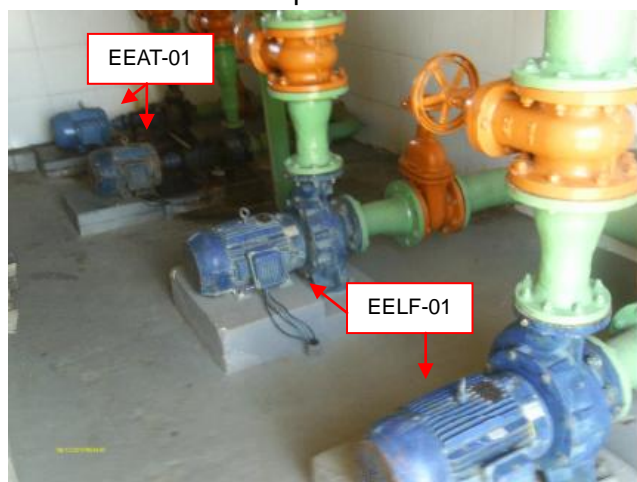
Foto 66 – EEAT-01 e EELF-01: conjunto moto-bomba.
