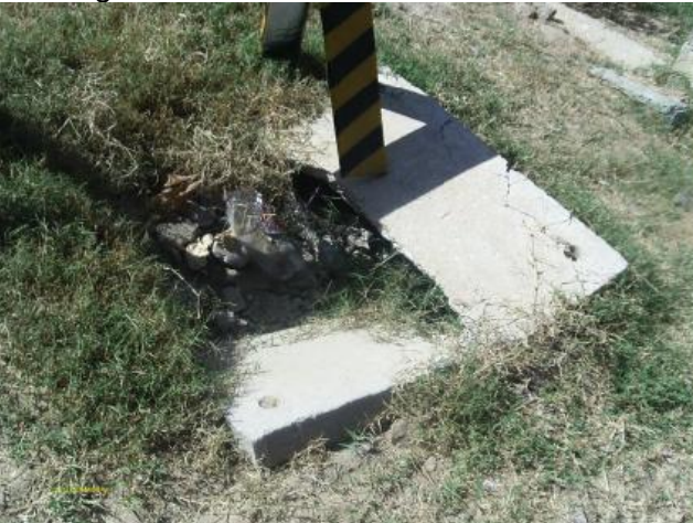
Foto 101 – Rede de distribuição: registro de descarga com tampa inadequada na Trav. Pedro Holanda.
