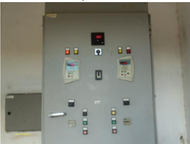
Foto 61 – EEAB-01: quadro de comando.
