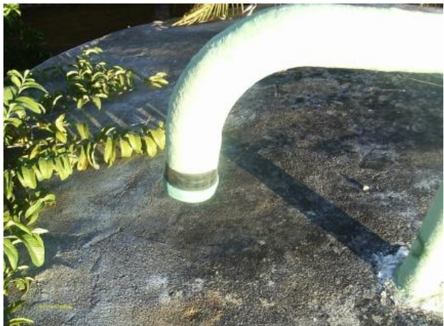
Foto 91 – RAP-03: tubulação de ventilação com tela de proteção.
