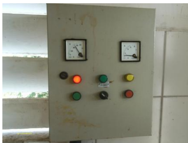
Foto 22 – PT-12: quadro de comando sem horímetro.
