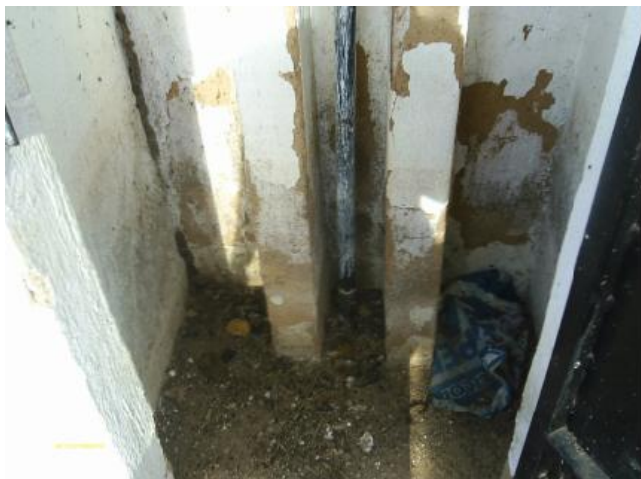
Foto 5 – PT-03: estrutura da casa de abrigo do QC deteriorada.
