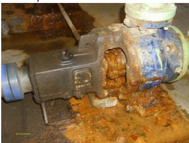
Foto 67 – EEAT-01: vazamento no conjunto moto-bomba.
