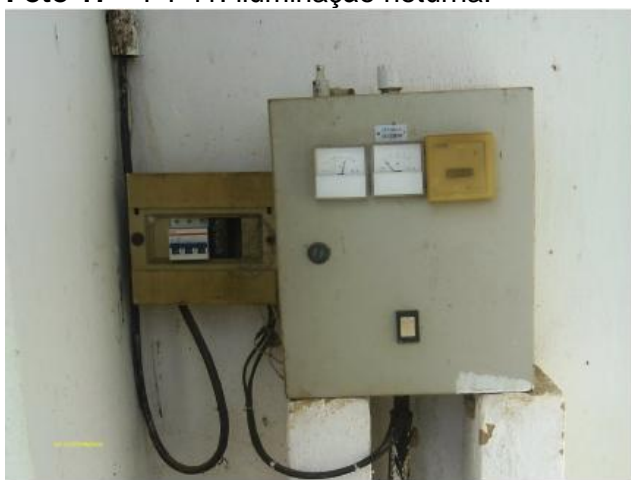
Foto 19 – PT-11: quadro de comando localizado na casa de abrigo do PT-04 (desativado).
