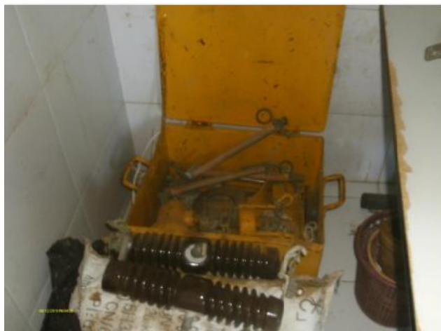
Foto 47 – Casa de química: kit de emergência.
