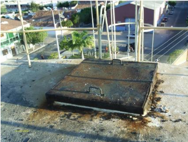
Foto 74 – REL-01: tampa de inspeção em processo de corrosão.
