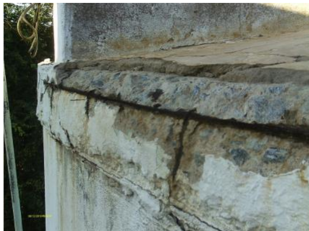
Foto 93 – RAP-03: armadura exposta.
