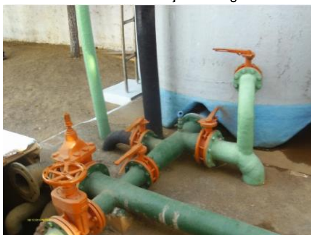
Foto 43 – Filtro-04: tubulações e registros.
