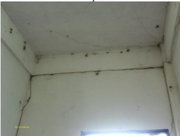
Foto 60 – EEAB-01: presença de cupim.
