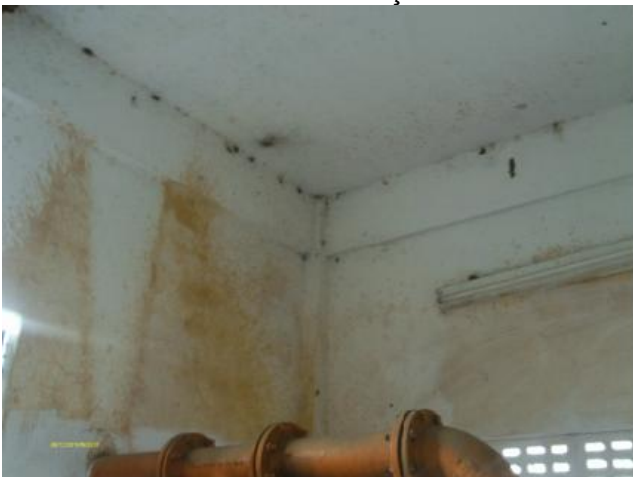
Foto 59 – EEAB-01: pintura deteriorada.
