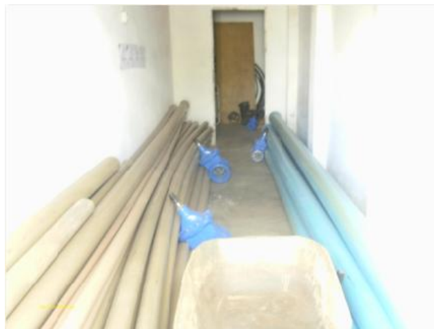
Foto 115 – Almojarifado: armazenamento de materiais.
