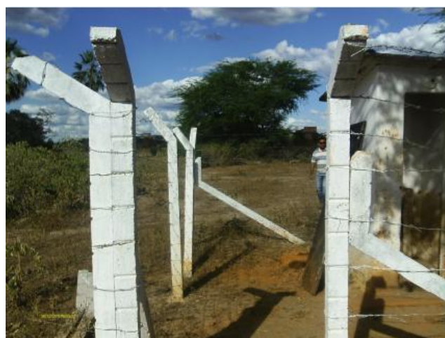
Foto 10 – PT-07: ausência de portão de entrada e iluminação noturna.
