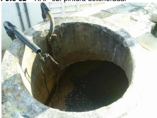
Foto 84 – RAP-02: ausência de tampa de inspeção.
