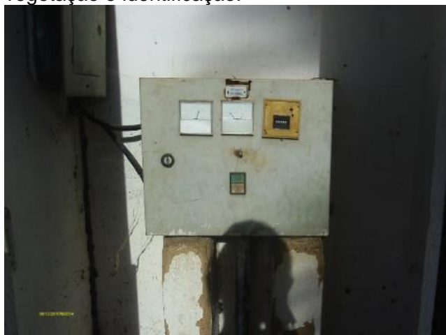
Foto 4 – PT-03: quadro de comando.
