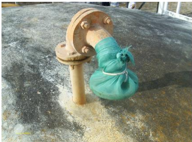
Foto 80 – RAP-01: tubulação de ventilação com tela de proteção.
