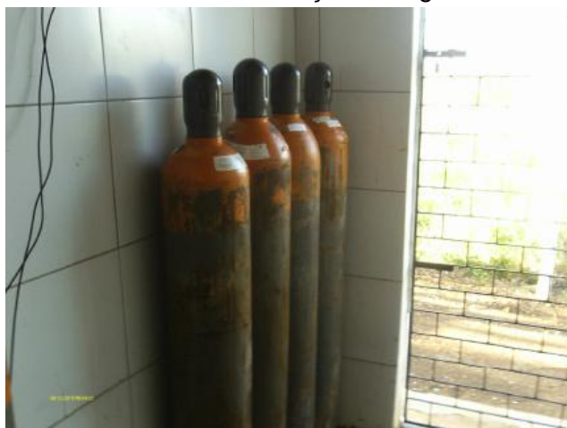
Foto 45 – Casa de química: área de dosagem de cloro gasoso.
