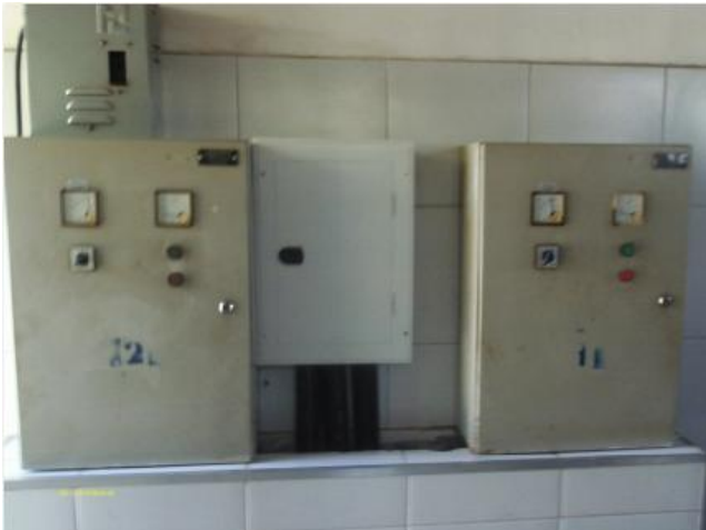
Foto 69 – EELF-01: quadro de comando.
