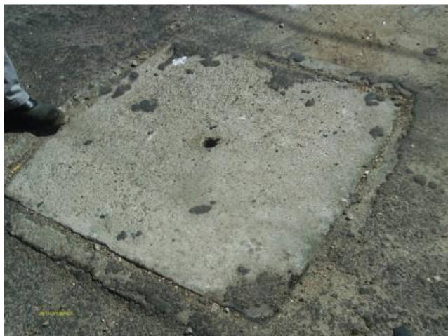
Foto 54 – AAT: Ventosa na Rua João Quincó.
