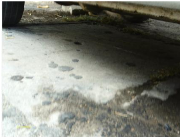
Foto 55 – AAT: Registro de descarga na Rua João Quincó.
