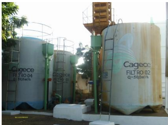
Foto 34 – Filtração: identificação e escadas de acesso dos filtros 04, 03 e 02.
