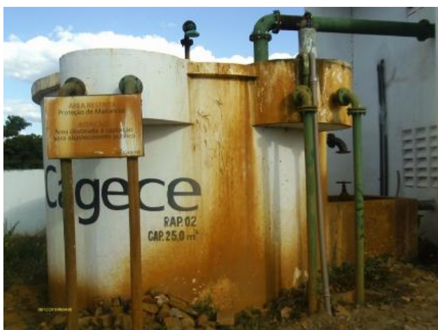
Foto 82 – RAP-02: pintura deteriorada.
