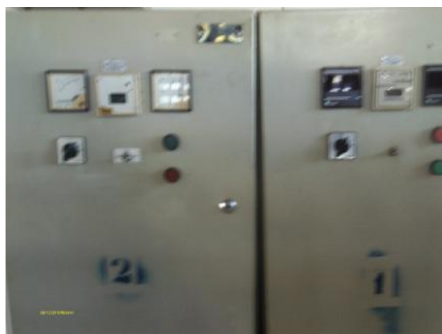
Foto 68 – EEAT-01: quadro de comando.
