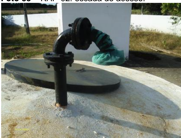
Foto 85 – RAP-02: tubulação de ventilação com tela de proteção.
