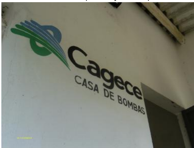
Foto 62 – EEAB-02: ausência de identificação.
