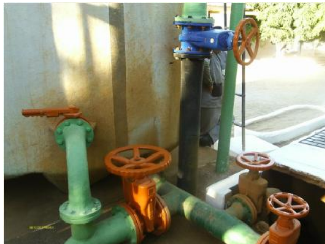
Foto 41 – Filtro-02: tubulações e registros.
