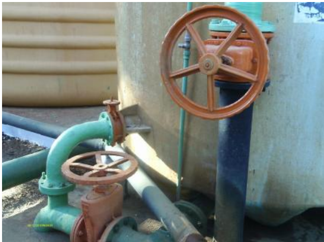
Foto 40 – Filtro-01: tubulações e registros.
