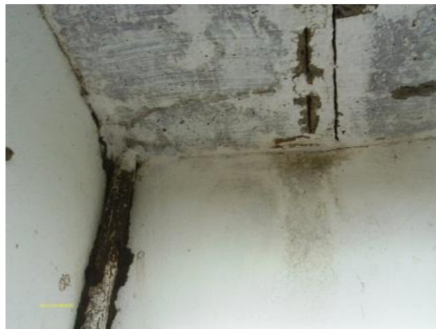
Foto 6 – PT-03: estrutura da casa de abrigo do QC deteriorada.
