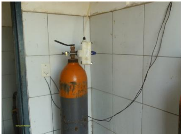
Foto 46 – Casa de química: dosagem de cloro.
