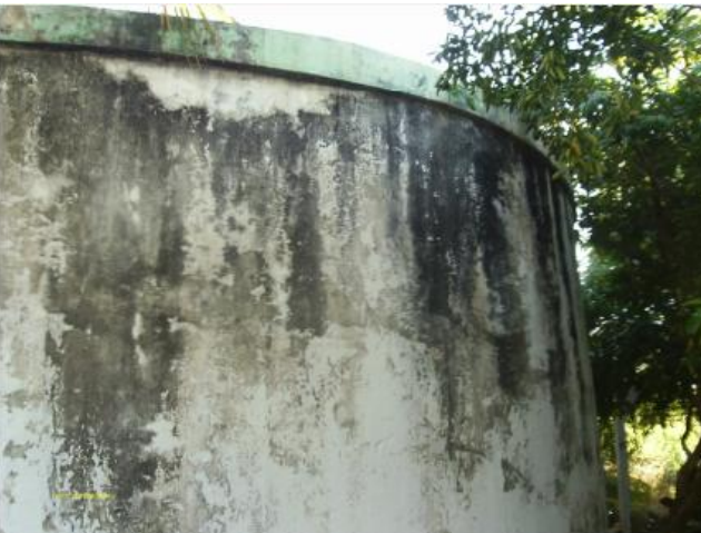
Foto 88 – RAP-03: pintura deteriorada.
