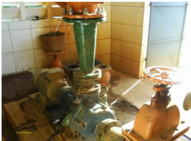
Foto 63 – EEAB-02: conjunto moto-bomba.
