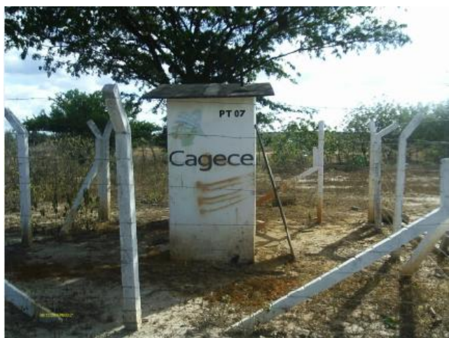
Foto 9 – PT-07: vista geral-pintura deteriorada e identificação.
