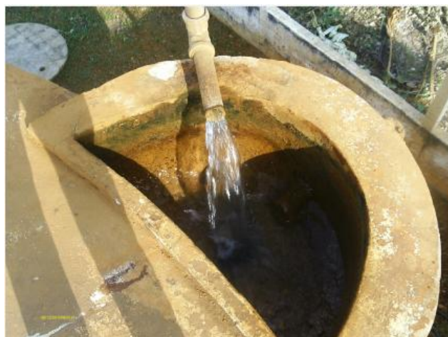
Foto 81 – RAP-01: caixa de recepção sem tampa.
