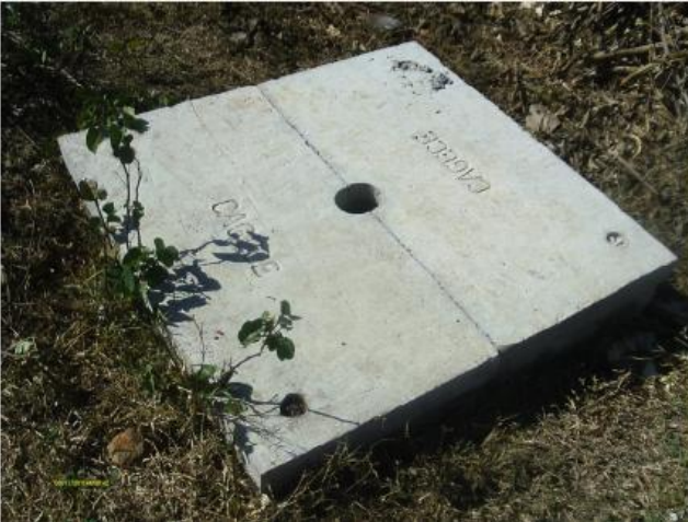
Foto 99 – Rede de distribuição: registro de descarga na Rua José Ferreira
