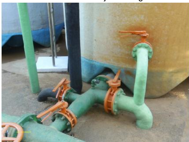
Foto 42 – Filtro-03: tubulações e registros.
