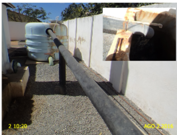
Foto 13 – Pré-filtro: registro com vazamento.
