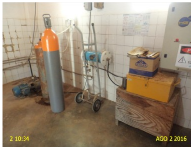
Foto 16 – ETA: KIT de emergência armazenado na área do cloro gasoso.
