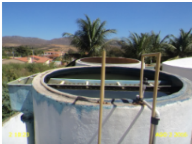
Foto 2 – F-02: ausência de tampa.
