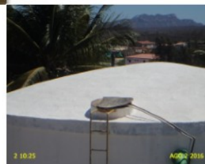
Foto 11 – RAP-01 e RAP-02: tampas inadequadas.
