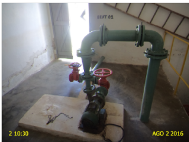
Foto 3 – EEAT-02: ausência de bomba reserva
