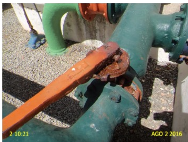
Foto 14 – F-01: vazamento no registro.
