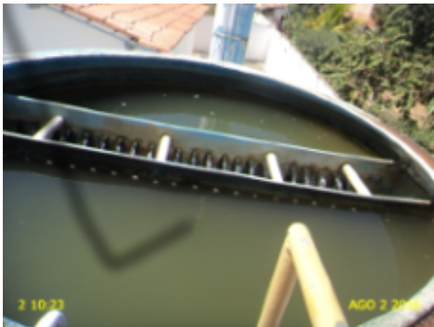
Foto 1 – F-01: ausência de tampa.
