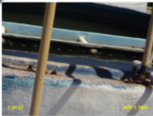
Foto 12 – Filtros F-01 e F-02: escadas em processo de corrosão na base de fixação.
