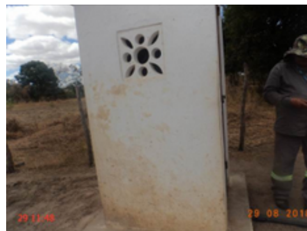
Foto 19 – Captação subterrânea: Casa de abrigo do quadro de comando do PT-09 está com a pintura deteriorada.
