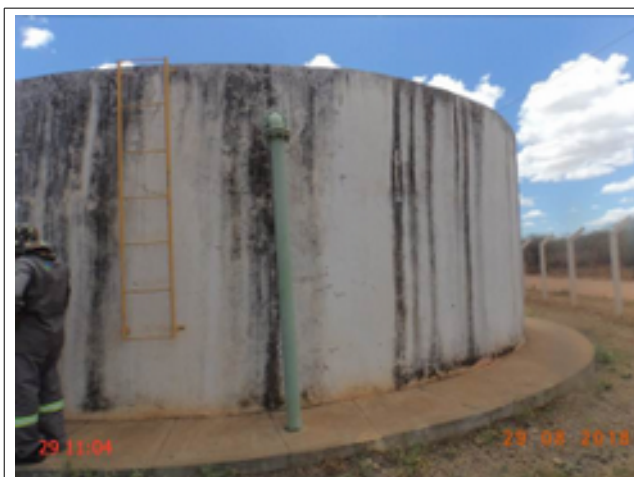
Foto 1 - Reservatório: O RAP-01 está com a pintura deteriorada, está sem identificação, não é dotado de medidor de nível e a escada está sem o apoio para acessar a laje de cobertura.
