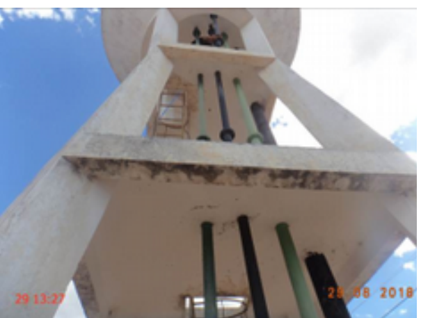
Foto 14 - Reservatórios: O reservatório REL-01 está com a pintura e a estrutura deterioradas e apresenta sinais de infiltração.
