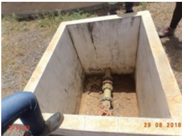
Foto 16 – Reservatórios: A caixa do macromedidor na área do reservatório RAP-01 está sem tampa ou grade de proteção.
