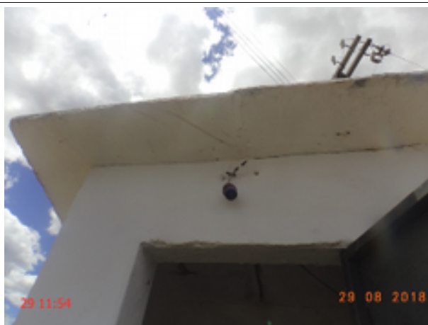
Foto 5 - Captação subterrânea: Poço PT-10 sem iluminação para trabalhos noturnos (ausência de lâmpada).
