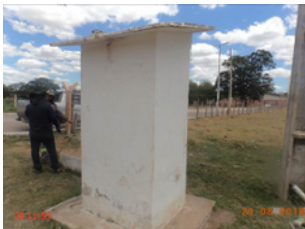
Foto 18 - Captação subterrânea: Casa de abrigo do quadro de comando do PT-05 com a pintura deteriorada.
