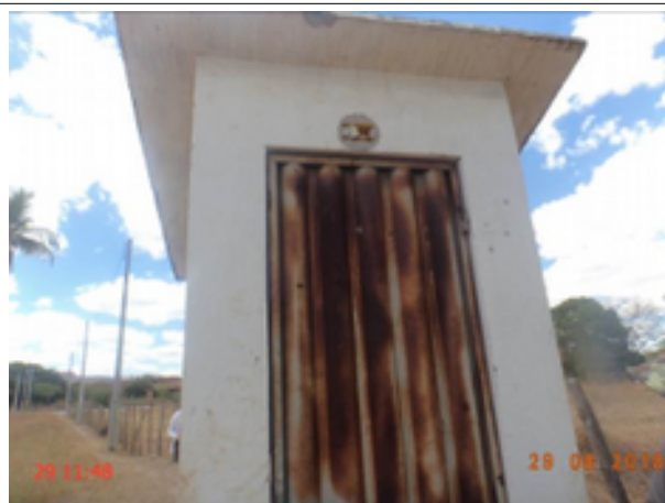
Foto 4 - Captação subterrânea: O poço PT-09 não é dotado de iluminação para trabalhos noturnos (ausência de lâmpada, está sem identificação e a porta está em processo de corrosão).
