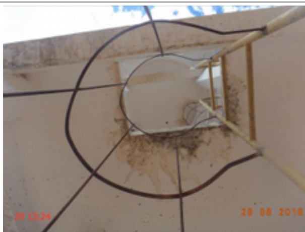
Foto 8 – Reservatório: O guarda-corpo do reservatório REL-01 está em processo de corrosão.
