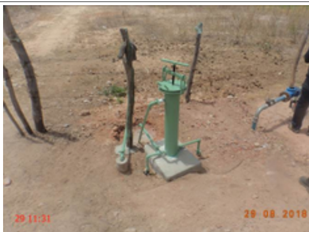
Foto 10 - Captação subterrânea: PT-10 sem identificação.
