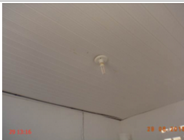
Foto 11 - Reservatório: A casa de química da área do reservatório REL-01 está sem iluminação.
