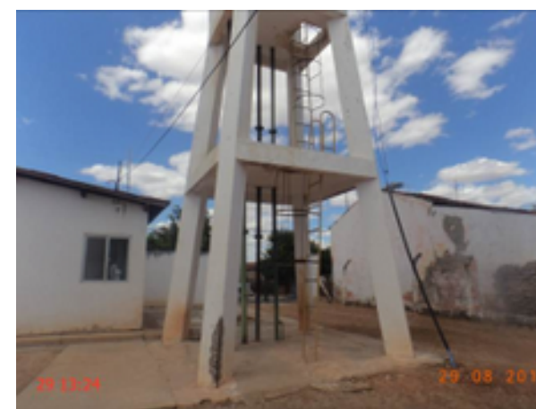
Foto 15 - Reservatório: O REL-01 apresenta armadura exposta em sua estrutura.
