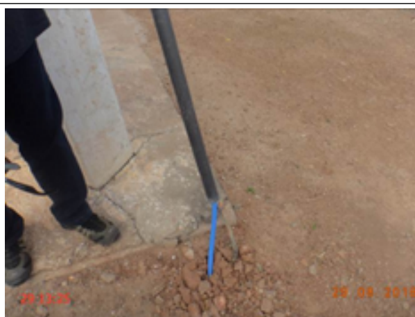
Foto 13 - Reservatório: O isolamento do para-raio do reservatório REL-01 está sendo utilizado para a passagem da mangueira de cloro.
