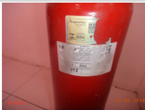
Foto 9 - Comercial: O extintor da loja de atendimento está com a recarga vencida.
