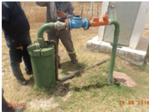
Foto 17 - Captação subterrânea: Poço PT-07 sem laje de proteção.
