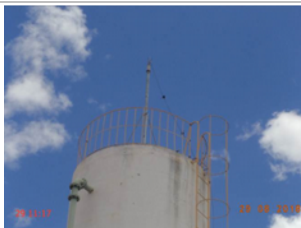
Foto 7 – AAT: O para-raio do TAU está com os fixadores desconectados da estrutura.
