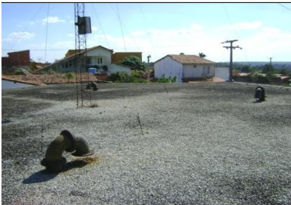
Foto 12 – RAP-09 – tubulação de ventilação.
