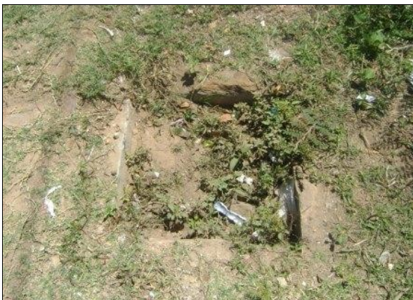
Foto 31 – Caixa de registro de descarga sem tampa e soterrada na Rua Irineu Pinto da Silveira próximo ao riacho.
