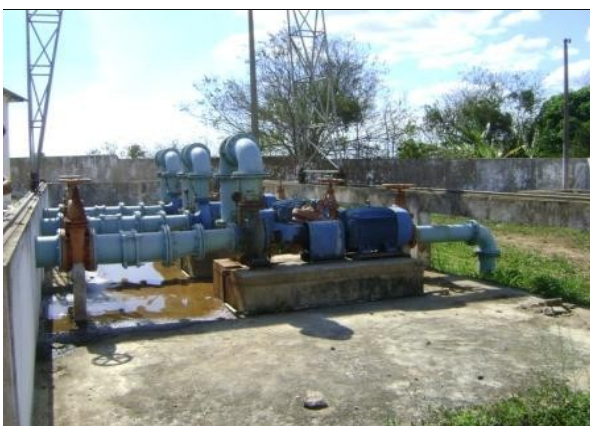
Foto 01 – EEAT-05 – conjuntos motores-bomba.
