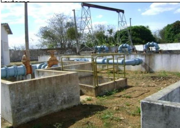
Foto 18 – RAP-09 – caixa de passagem alta.
