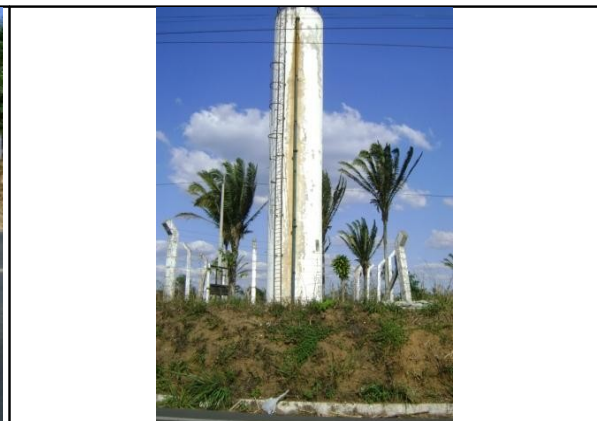
Foto 29 – TAU na adutora de água tratada.
