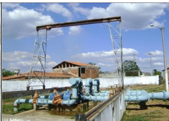
Foto 02 – EEAT-05 – barrilete e ponte.
