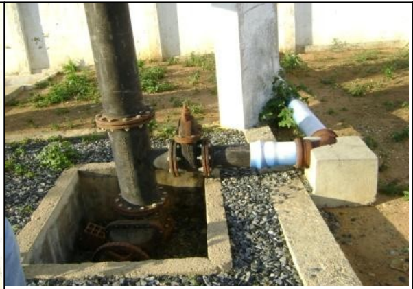
Foto 21 – REL-Forum – caixa da tubulação de distribuição.
