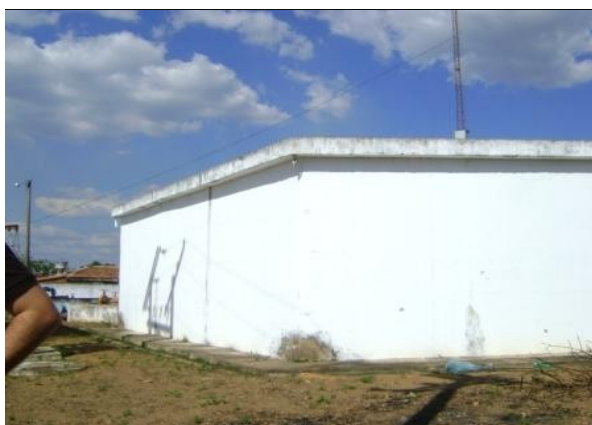
Foto 04 – RAP-09 – sem identificação.
