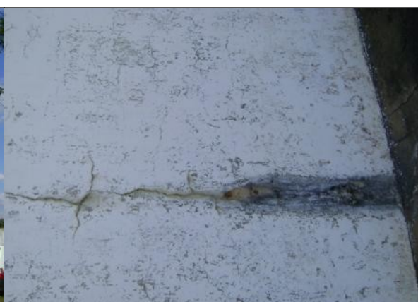
Foto 09 – RAP-09 – sinais de vazamento.
