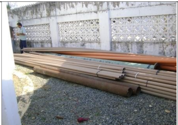
Foto 23 – REL-Centro – material estocado.
