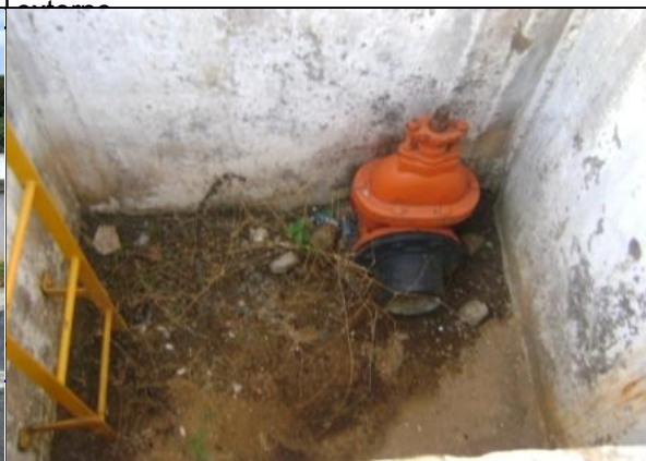
Foto 19 – RAP-10 (Corrente) – caixa de passagem alta.
