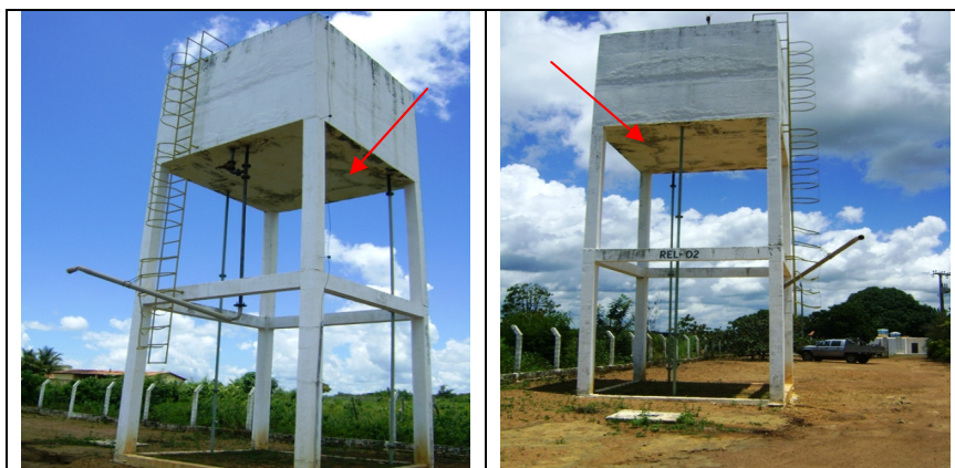
Fotos 35 e 36 – Sinais de vazamento no REL-02
