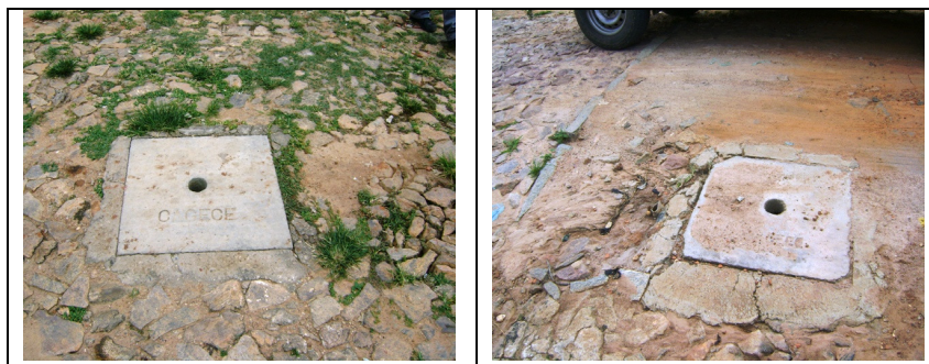
Fotos 45 e 46 – Registros de descarga nas Ruas Leocádia Soares e Leocádia Regina
