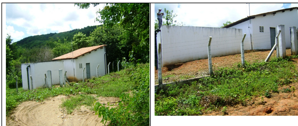
Fotos 22 e 23 – Vistas das casas de proteção da EEAB-02 e EEAB-03: sem identificação.
