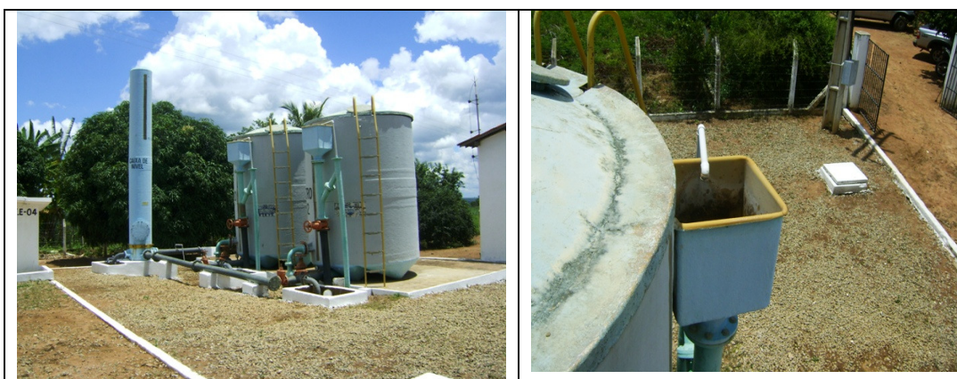
Fotos 7 e 8 – Vistas da torre de equilíbrio, dos filtros e da calha de saída de água filtrada
