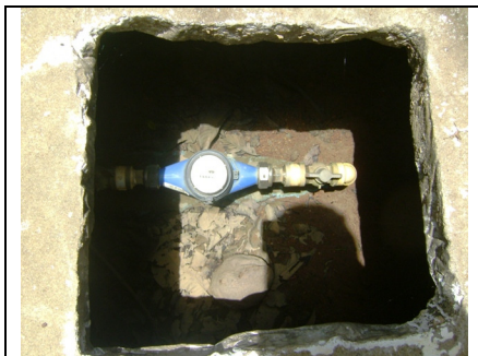
Foto 38 – Medidor proporcional na ETA
