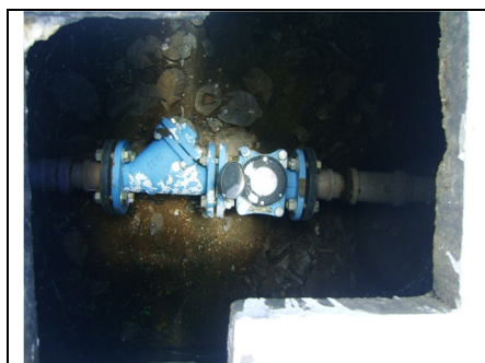
Foto 37 – Macromedidor na saída do RAP-03
