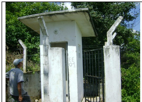
Foto 21 – Casa de proteção do Quadro de comando da EECS-01; sem identificação.
