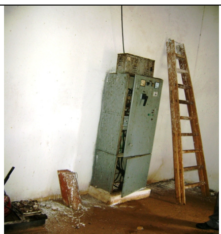
Foto 25 – Quadro de comando da EEAB-02
