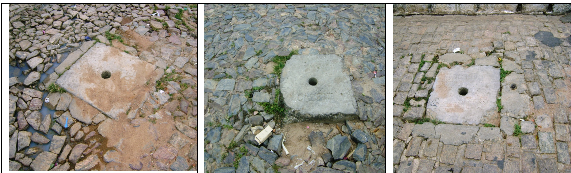
Fotos 39 a 41 – Registros de descarga nas Ruas Jose Pio Oliveira, Manoel Romão Lucena e Dep. Furtado Leite
