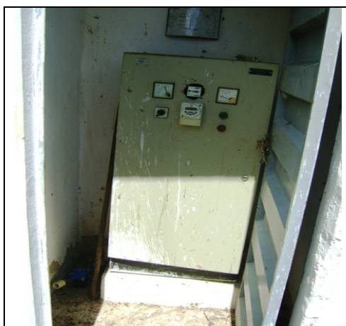
Foto 24 – Quadro de comando da EECS-01
