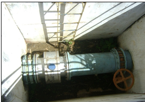
Foto 66 – Macromedidor de água tratada na saída da ETA.
