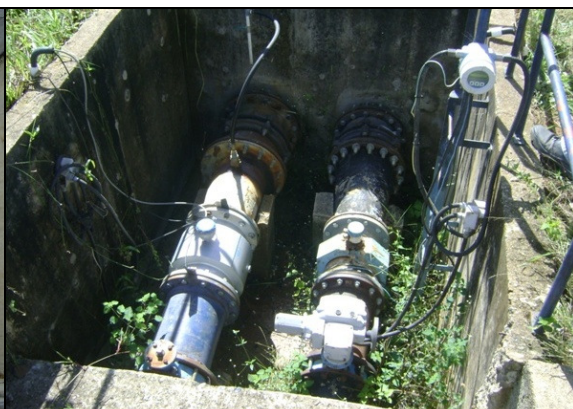
Foto 67 – Macromedidor de água tratada na saída do RAP (Caruataí).
