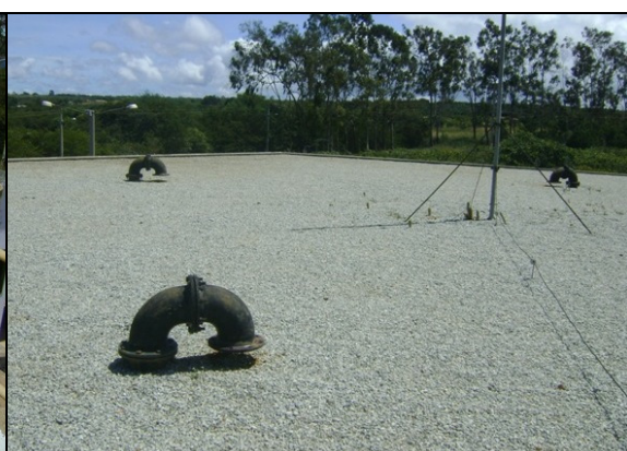
Foto 50 – Ventilações do RAP-01, sem tela de proteção.
