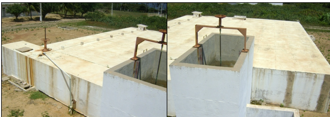
Fotos 10 e 11 – Vistas do tanque de contato.
