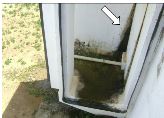
Foto 6 – Infiltração na parede do decantador.
