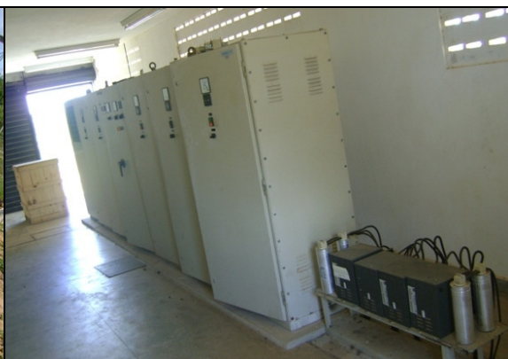
Foto 38 – Quadro de comando da EEAT-02.
