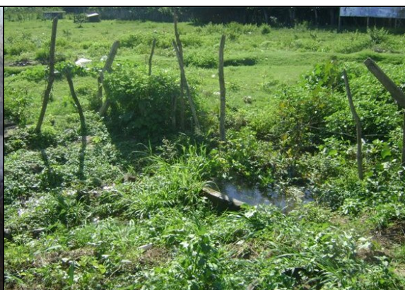
Foto 69 – Vazamento no tubo de pitot da adutora de água tratada, na bifurcação para Tianguá.
