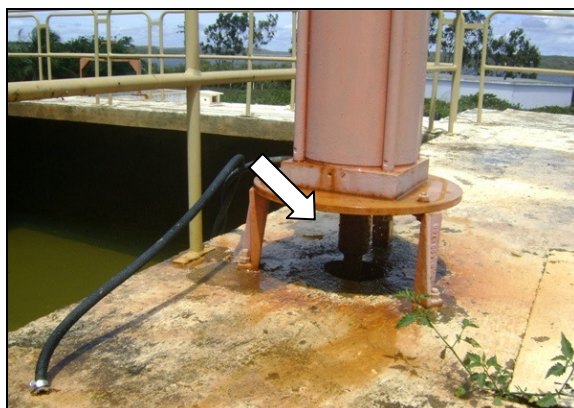
Foto 9 – Problema de vedação no acionador da comporta do Filtro 04.
