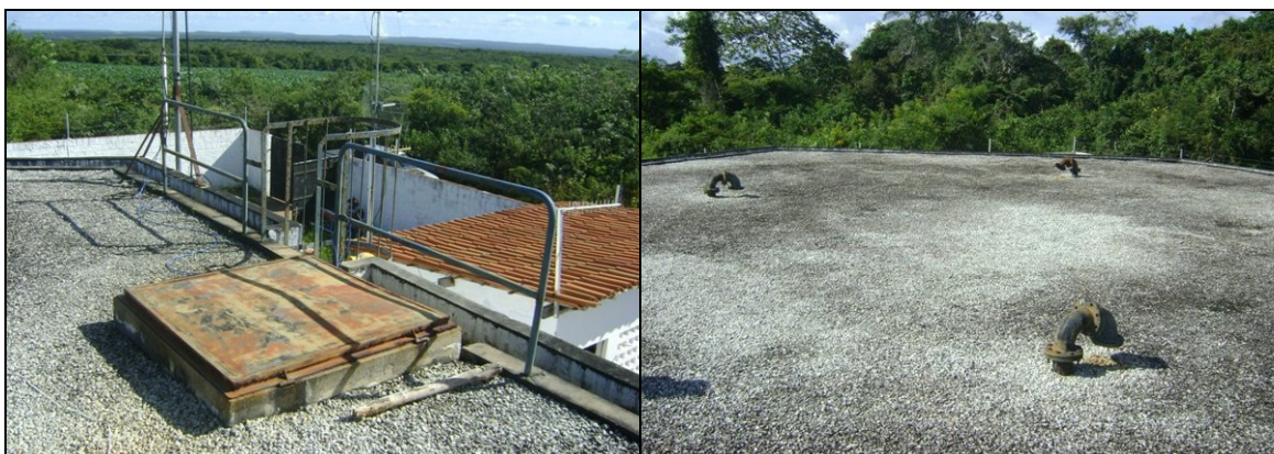
Foto 55 – Tampa de inspeção e escada do RAP (Cedro).
