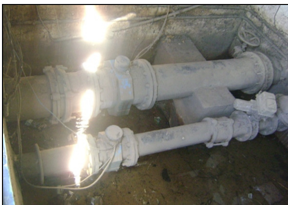
Foto 68 – Macromedidor de água tratada na bifurcação para Tianguá.
