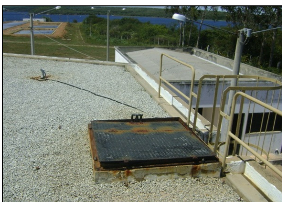
Foto 49 – Tampa de inspeção e escada de acesso do RAP-01.
