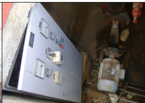
Foto 45 – Quadro de comando da EEAT-04.
