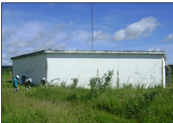
Foto 51 – Vista do RAP (Caruataí).
