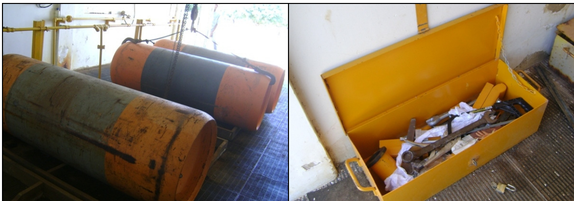
Foto 17 – Cilindros e dosador de Cloro gasoso.
