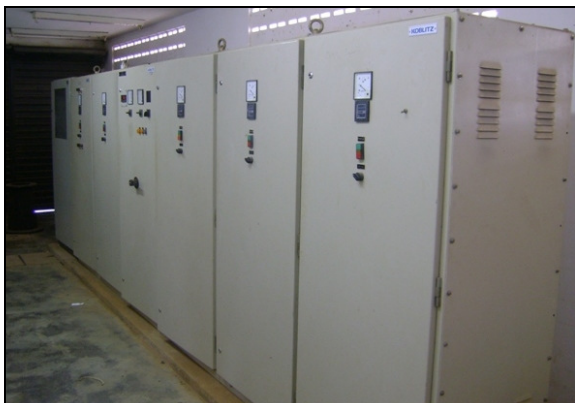
Foto 42 – Quadro de comando da EEAT-03.
