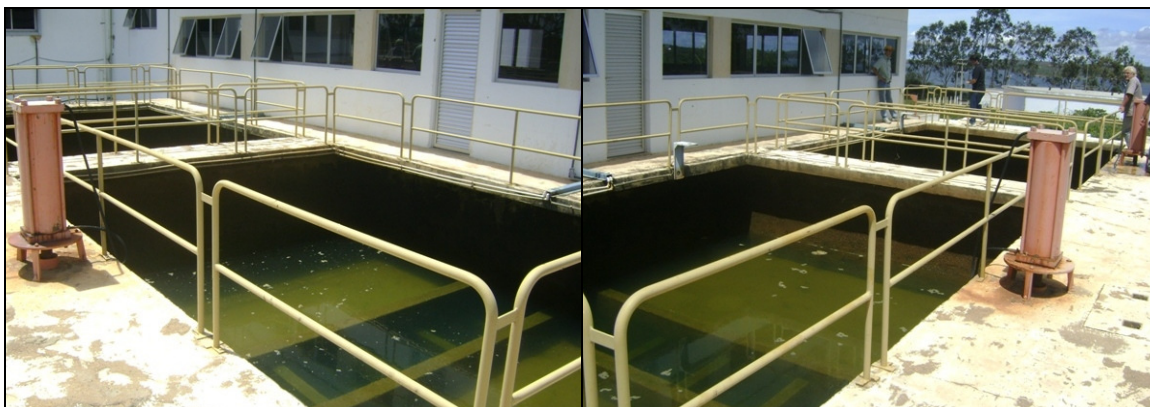
Fotos 7 e 8 – Vistas dos Filtros 01 a 04.
