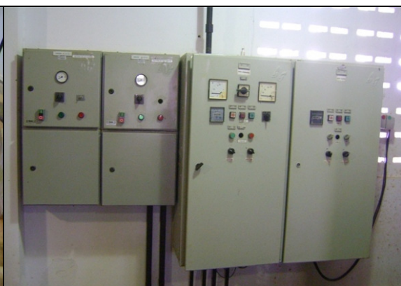
Foto 34 – Quadro de comando da EELD-01.
