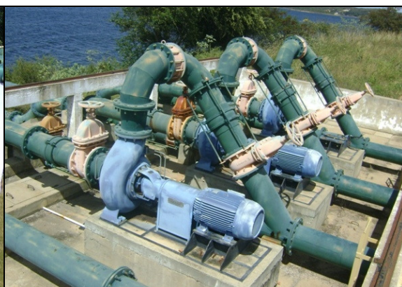
Foto 29 – Bomba reserva da EEAB-01.
