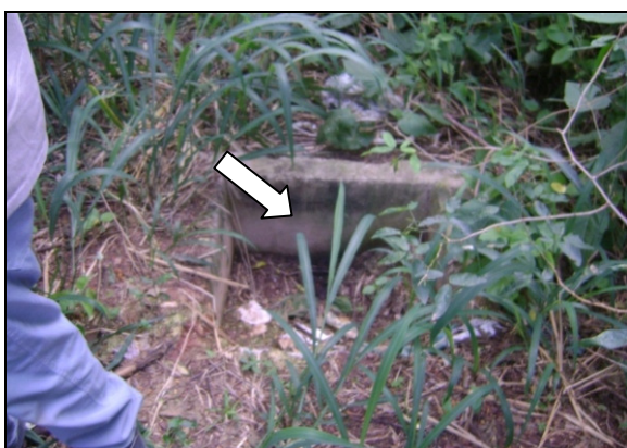
Foto 71 – Registro de descarga sem tampa de proteção, localizado BR-222, saída para o Piauí.
