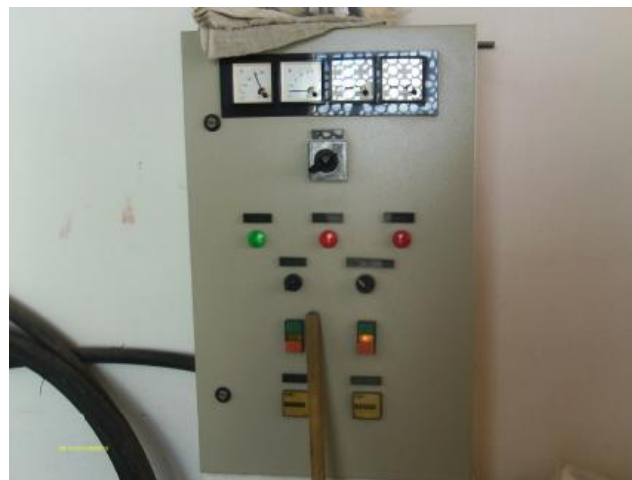
Foto 86 – Quadro de comando do soprador.
