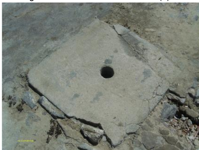
Foto 56 – Rede de distribuição: registro de descarga na Rua Dom Luiz
