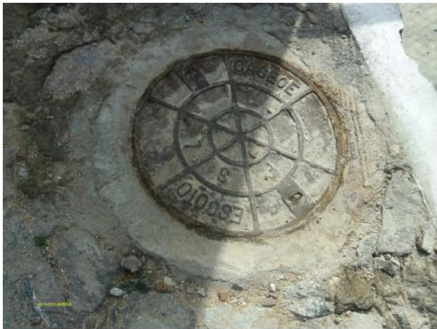
Foto 65 – Poço de visita.
