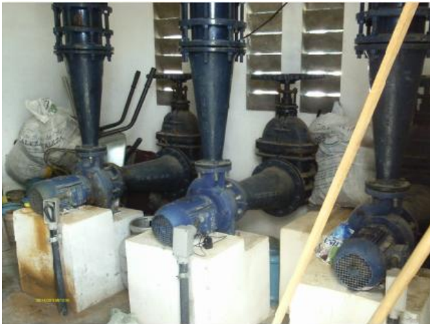
Foto 34 – EELF-01: conjunto moto-bomba.
