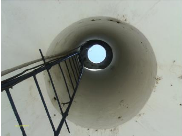
Foto 40 – REL-01: ausência de tampa de inspeção.
