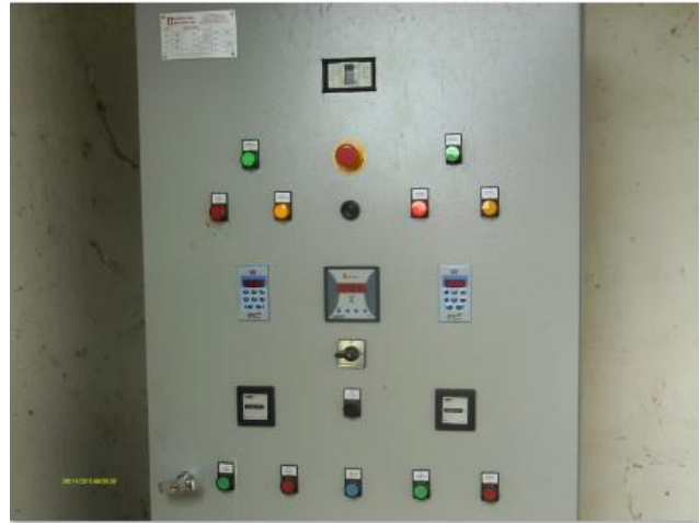
Foto 6 – Rio Sangue: quadro de comando da EECS.
