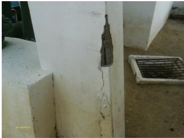
Foto 42 – REL-01: estrutura rachada e armadura exposta.
