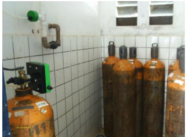
Foto 23 – Casa de química: cloro gasoso.
