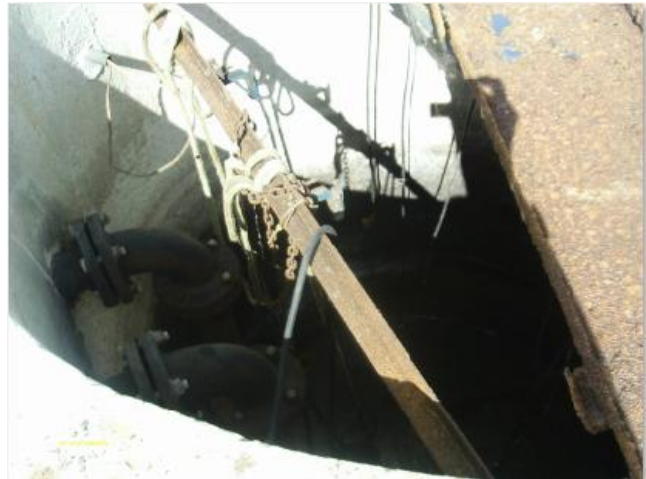
Foto 76 – Elevatória de recirculação.
