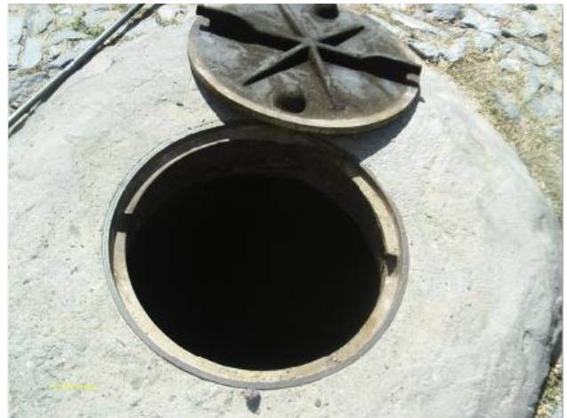
Foto 66 – Poço de visita.
