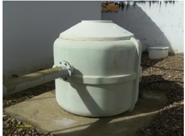
Foto 80 – Tanque de contato.
