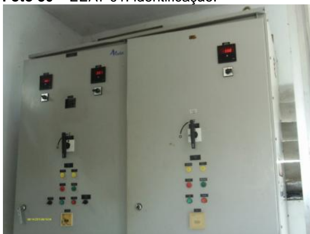
Foto 32 – EEAT-01: quadro de comando.
