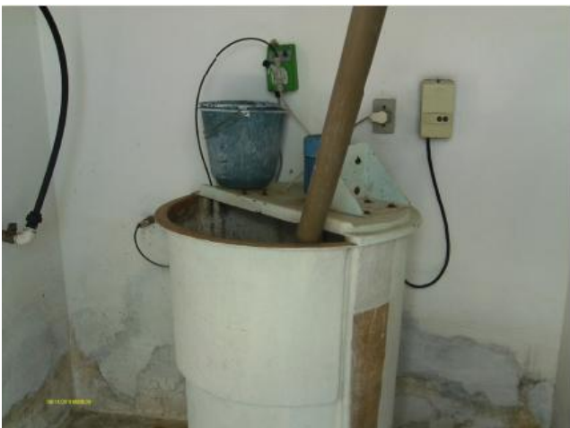
Foto 83 – Sistema de cloração
