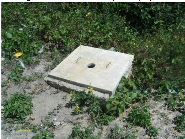
Foto 55 – Rede de distribuição: registro de descarga na Rua Manoel Castro Filho (2).
