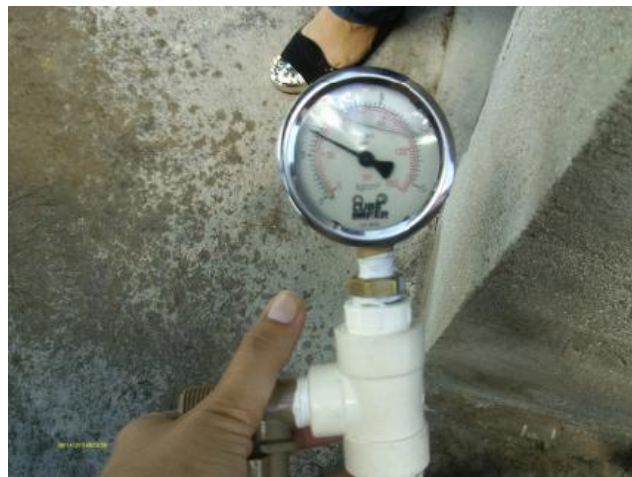
Foto 58 – Rede de distribuição: registro de descarga no Conjunto Manduca Bezerra.
