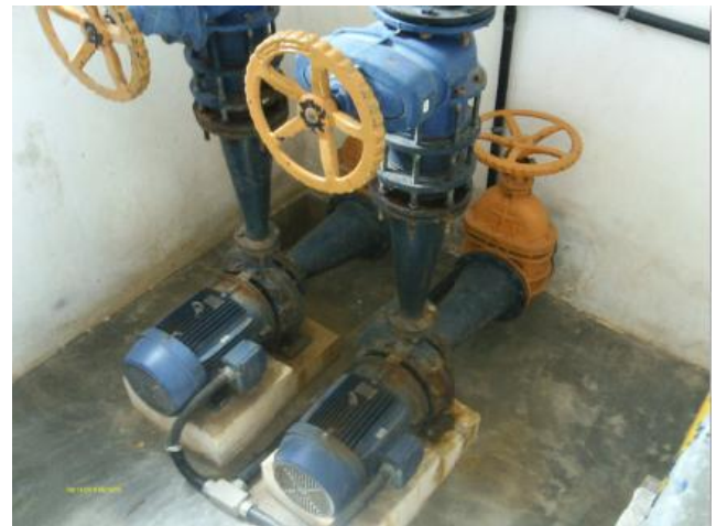
Foto 31 – EEAT-01: conjunto moto-bomba.
