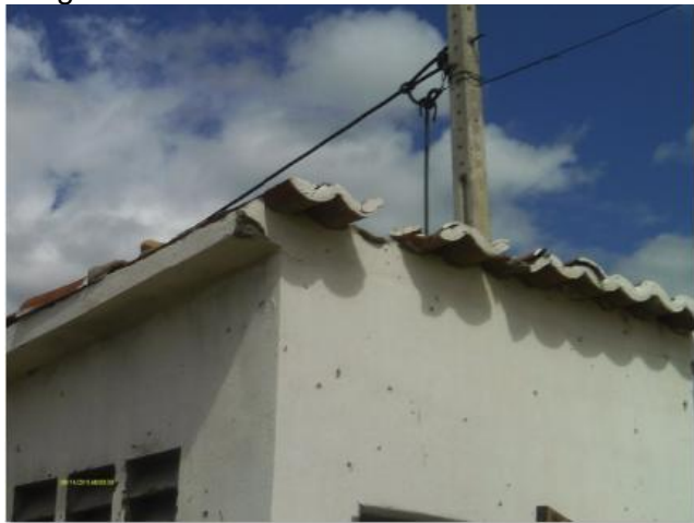
Foto 7 – Rio Sangue: telhado da casa de abrigo deteriorado.
