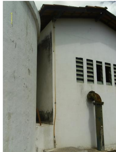
Foto 47 – RSE-01: medidor de nível.
