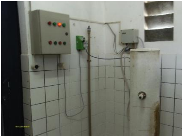
Foto 22 – Casa de química: sistema de fluoretação.
