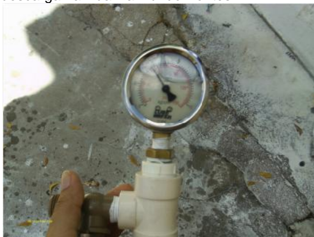
Foto 59 – Rede de distribuição: registro de descarga na Rua Tristão Gonçalves (Prédio da Prefeitura Municipal).
