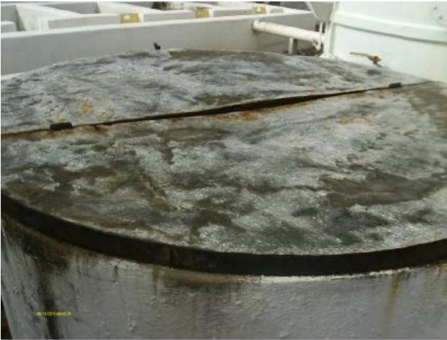
Foto 75 – Elevatória de recirculação.
