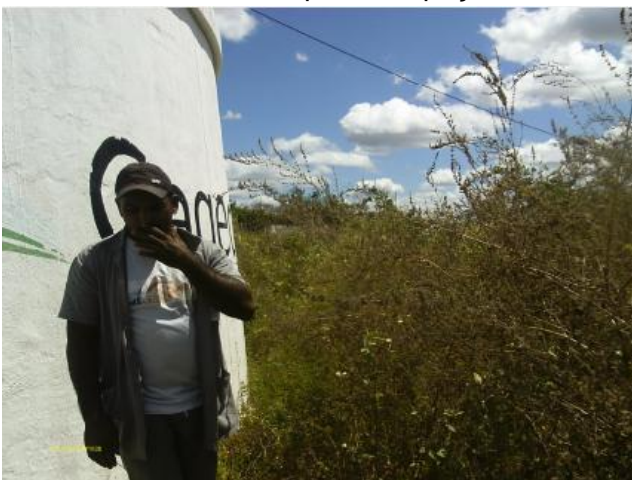
Foto 48 – RAP-02: vegetação alta em toda a área do reservatório.
