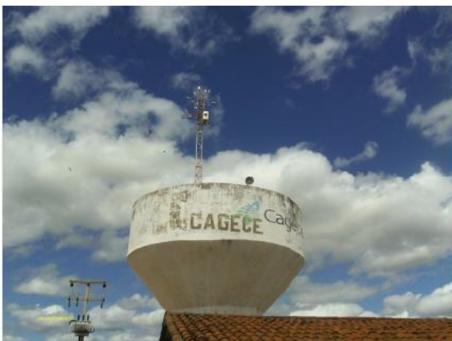
Foto 38 – REL-01: pintura deteriorada e ausência de identificação.
