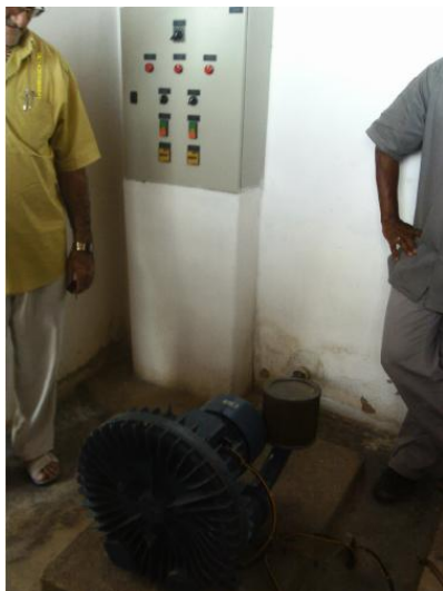
Foto 85 – Soprador do reator aeróbio.
