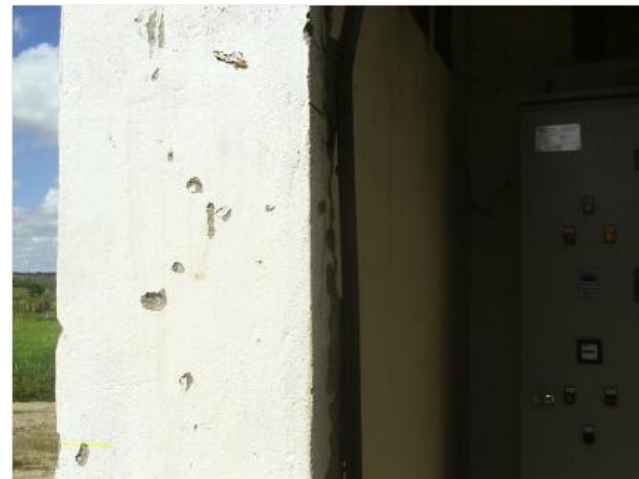
Foto 8 – Rio Sangue: estrutura da casa de abrigo do QC deteriorada..
