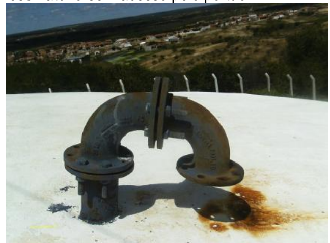
Foto 51 – RAP-02: tubulação de ventilação sem tela de proteção.
