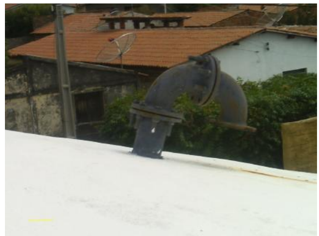
Foto 45 – RSE-01: tubulação de ventilação sem tela de proteção.
