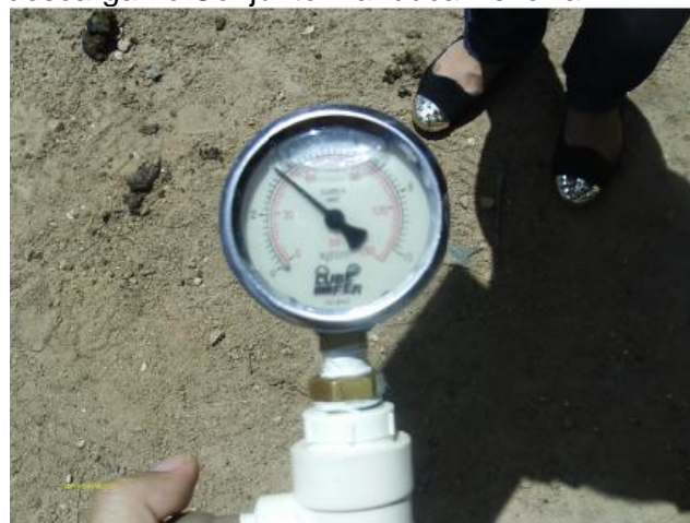
Foto 60 – Rede de distribuição: registro de descarga na Rua SDO – Parque Vaquejada
