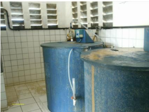
Foto 20 – Casa de química: tanques dosadores.
