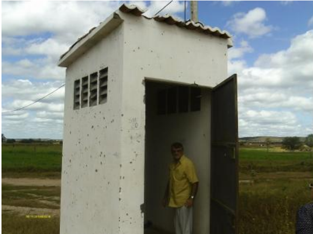
Foto 5 – Rio Sangue: estrutura da casa de abrigo do QC deteriorada.
