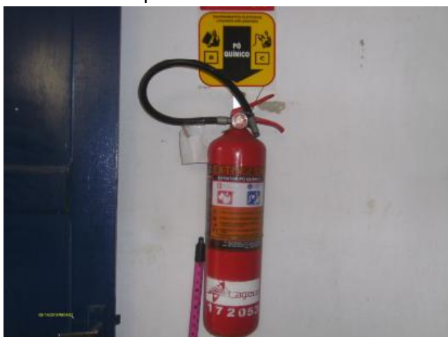
Foto 92 – Loja de atendimento: extintor de incêndio.
