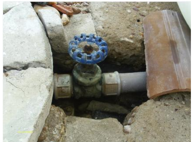
Foto 82 – Registro entre o reator aeróbio e o tanque de contato com vazamento.
