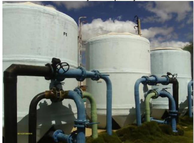
Foto 13 – Filtração: Filtros 1, 2 e 3.
