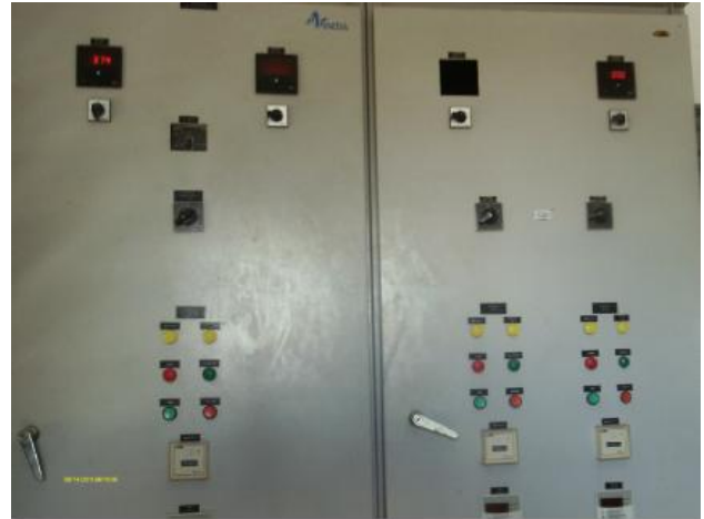
Foto 35 – EELF-01: quadro de comando.
