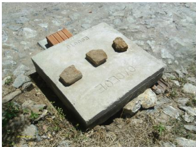
Foto 57 – Rede de distribuição: registro de descarga na Rua Raimundo Pontes.
