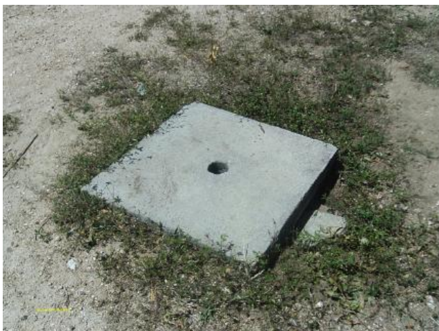
Foto 53 – Rede de distribuição: registro de descarga na Rua SDO – Parque Vaquejada.
