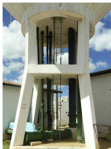
Foto 39 – REL-01: escada sem guarda-corpo.
