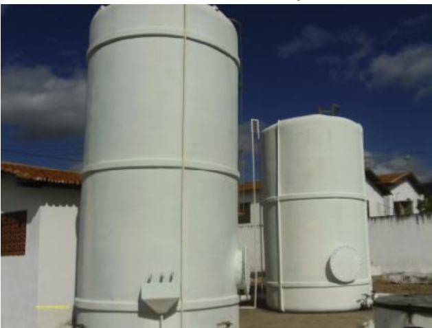
Foto 77 – Vista geral dos reatores.
