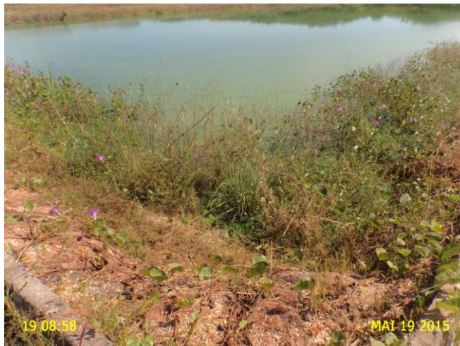
Foto 25 - ETE: vegetação excessiva nas paredes dos taludes das lagoas em série.
