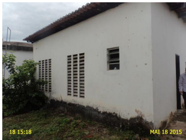
Foto 17 - EEAT-02: sem identificação.
