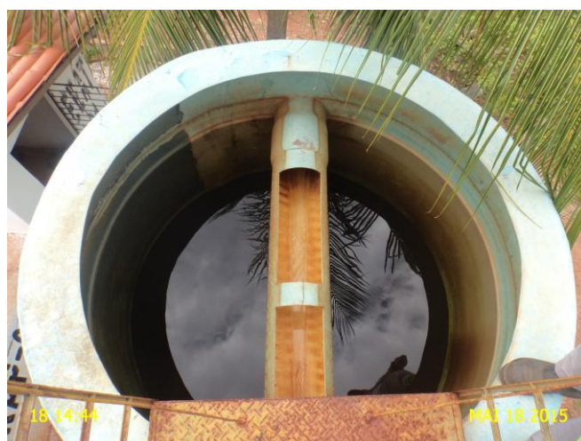
Foto 15 - F-01: tampa fora do local.
