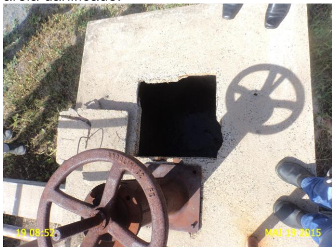
Foto 26 - ETE: caixa de chegada do esgoto bruto sem tampa.
