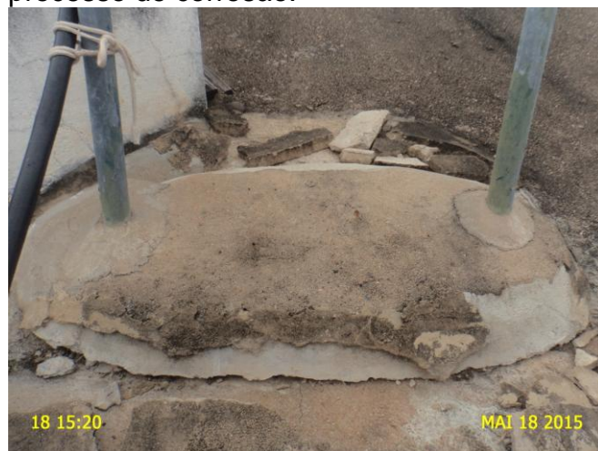
Foto 33 - RAP-02: escada de acesso sem fixação na base.
