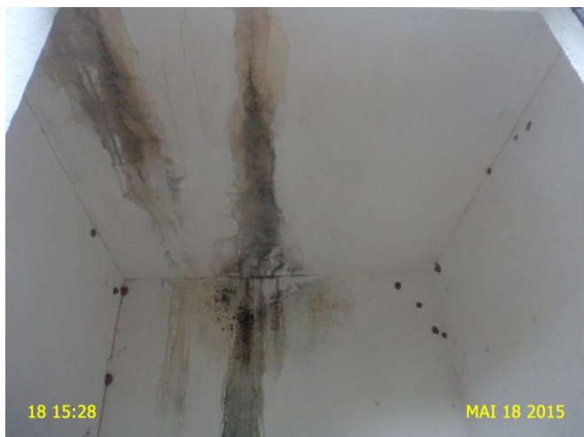
Foto 10 - PT-01: sinais de vazamento na parede da casa de abrigo do QC e pintura deteriorada.
