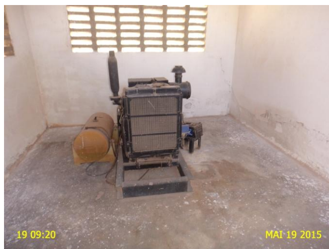
Foto 19 - EEE-01: grupo gerador de energia elétrica com defeito.
