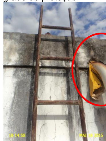
Foto 31 - RAP-01: parede deteriorada na entrada de água e escada de acesso em processo de corrosão.
