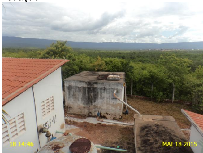
Foto 30 - RAP-01: pintura deteriorada.
