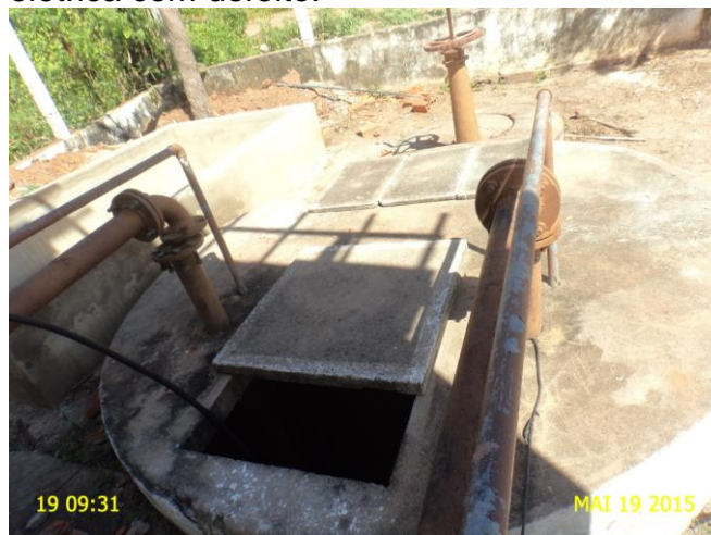
Foto 21 - EEE-02: tampa do poço de sucção sem vedação.
