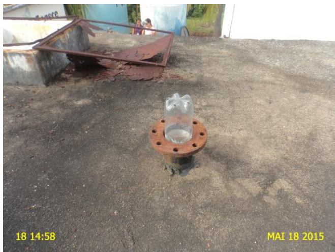
Foto 9 - RAP-01: tubulação de ventilação inadequada.
