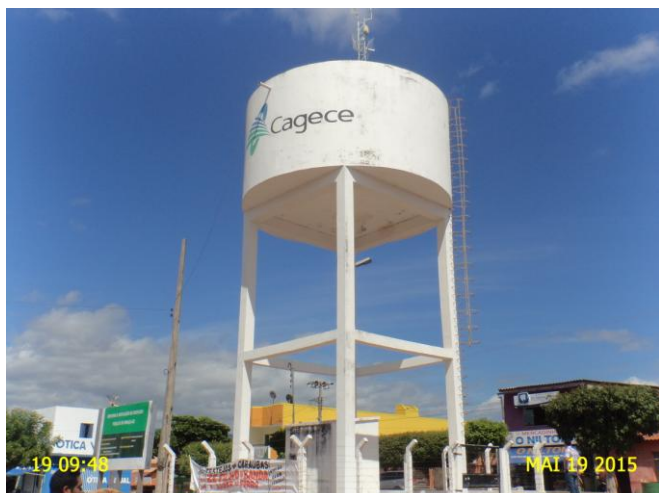
Foto 7 - REL-01: sem guarda corpo na laje de cobertura e pintura deteriorada.
