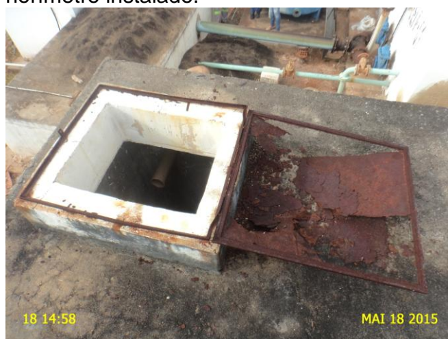
Foto 6 - RAP-01: sem tampa de inspeção.
