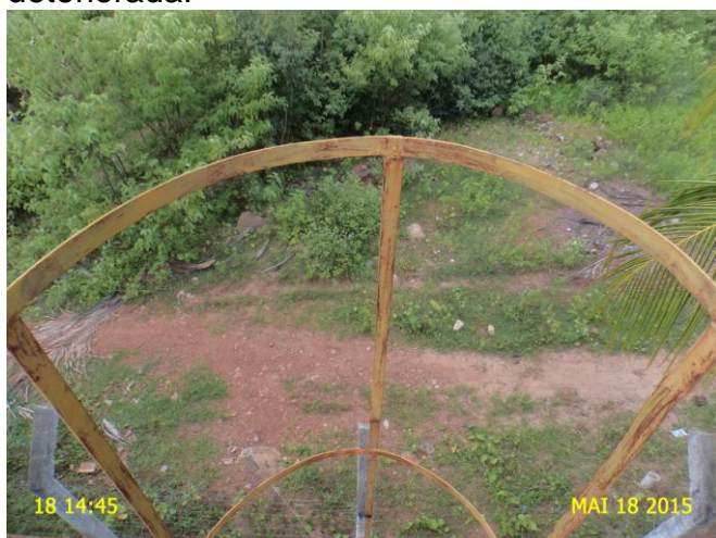
Foto 12 - F-01: guarda corpo da escada de acesso danificado.
