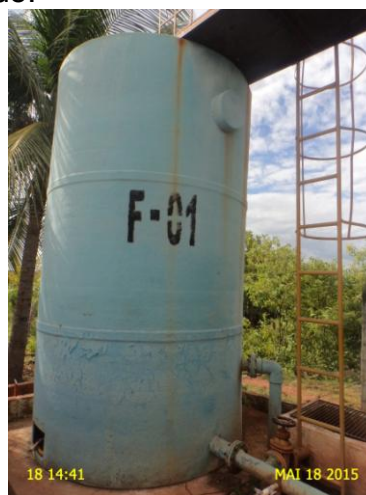
Foto 13 - F-01: pintura deteriorada.
