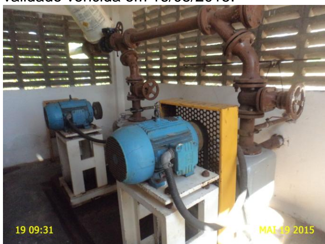
Foto 18 - EEE-02: apenas uma bomba funcionando.
