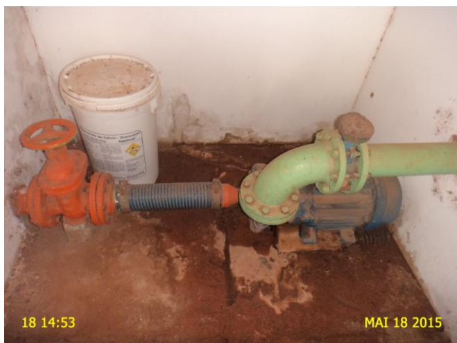
Foto 3 - EEAT-01: sem bomba reserva.
