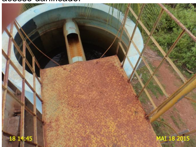
Foto 14 - F-01: guarda corpo em processo de corrosão.
