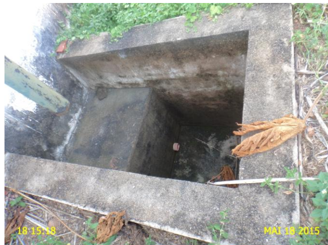
Foto 29 - RAP-02: tampa de inspeção sem tampa ou grade de proteção.
