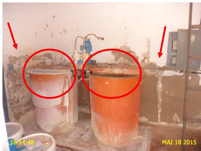
Foto 11 - Casa de química: tanques de dosagem sem tampa e parede com reboco deteriorado.
