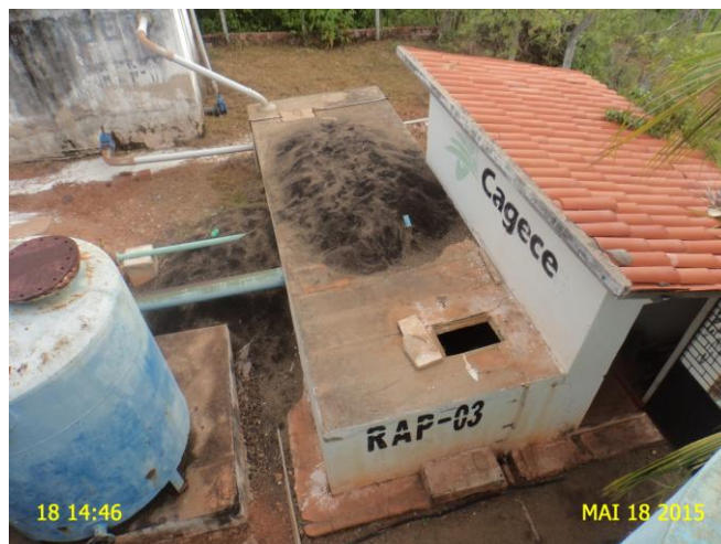
Foto 8 - RAP-03: pintura deteriorada, sem tubulação de ventilação, tampa de inspeção sem vedação e acúmulo de areia sobre a laje.
