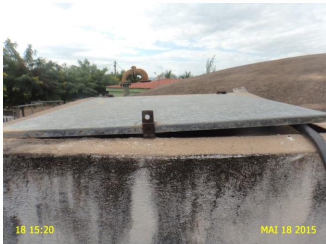
Foto 28 - RAP-02: tampa de inspeção sem vedação.
