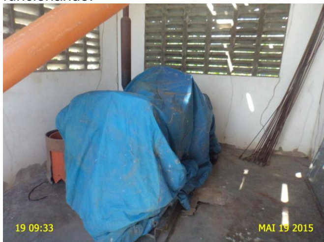
Foto 20 - EEE-02: grupo gerador de energia elétrica com defeito.
