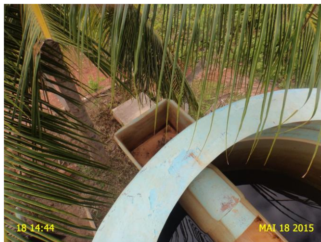
Foto 2 - PT-01: calha de saída de água sem tampa.
