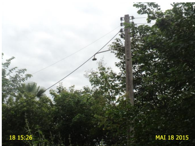
Foto 1 - PT-01: sem iluminação.
