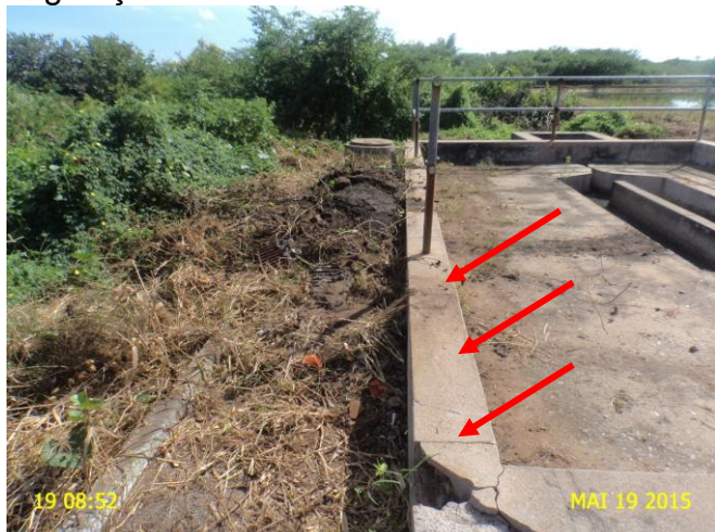
Foto 24 - ETE: guarda-corpo da caixa de areia danificado.
