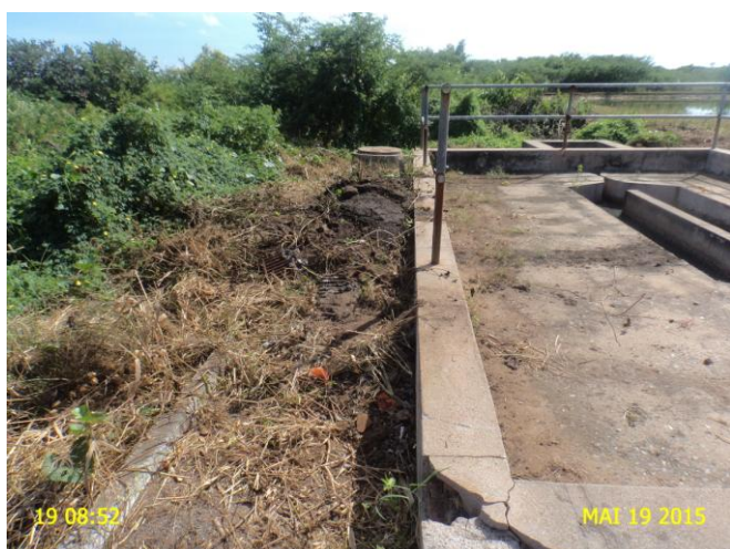
Foto 5 - ETE: sem leitos de secagem.
