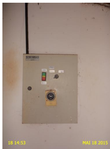
Foto 4 - EEAT-01: Quadro de Comando sem horímetro instalado.
