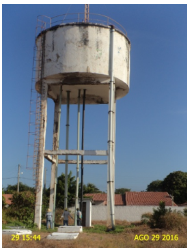
Foto 1 - REL-01: pintura deteriorada, escada e guarda-corpo em processo de corrosão, armadura exposta e sinais de vazamento.
