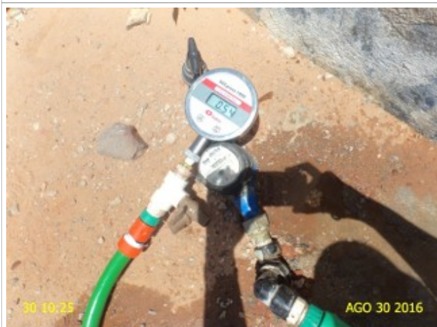
Foto 7 - Medição instantânea de pressão na rede de distribuição no endereço localizado na Rua Francisco Agostinho - Secretaria de Educação.
