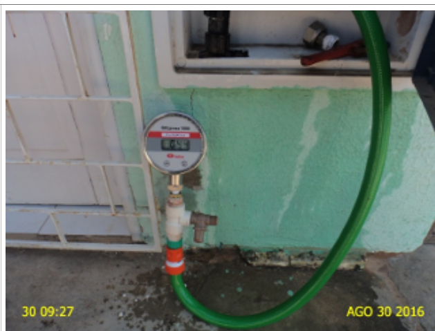
Foto 6 - Medição instantânea de pressão na rede de distribuição, no endereço localizado na Rua Cicero Teixeira, 200.
