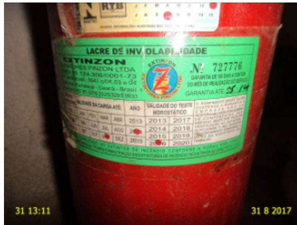
Foto 10 - Escritório: extintor de incêndio com data de validade da recarga vencida desde nov/16.
