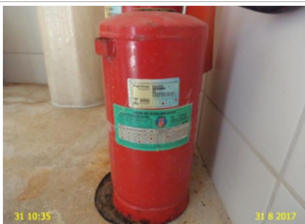
Foto 13 - Casa de Química (ETA): extintor de incêndio com data de validade da recarga vencida desde nov/16.
