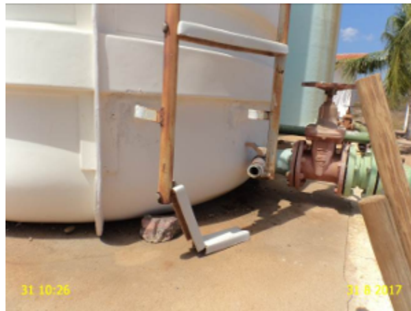
Foto 12 - F-02: escada danificada.
