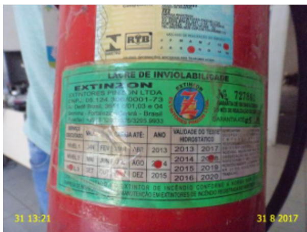
Foto 11 - Almojarifado: extintor de incêndio com data de validade da recarga vencida desde ago/14.
