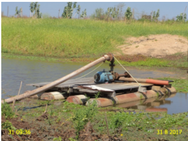
Foto 9 - EECS-03: ausência de identificação.
