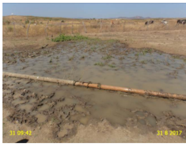
Foto 2 - AAB: vazamento no trecho da adutora que fica entre as elevatórias EECS-03 e EECS-02.
