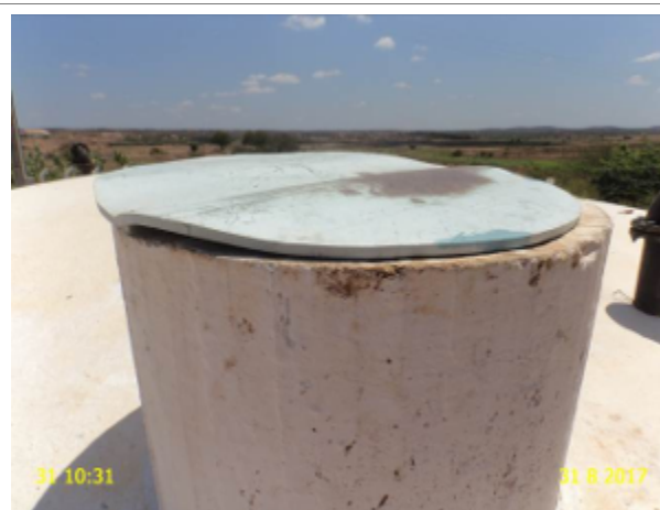
Foto 14 - RAP-01: tampa sem vedação adequada.
