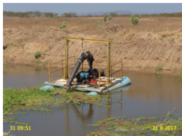
Foto 8 - EECS-02: ausência de identificação.
