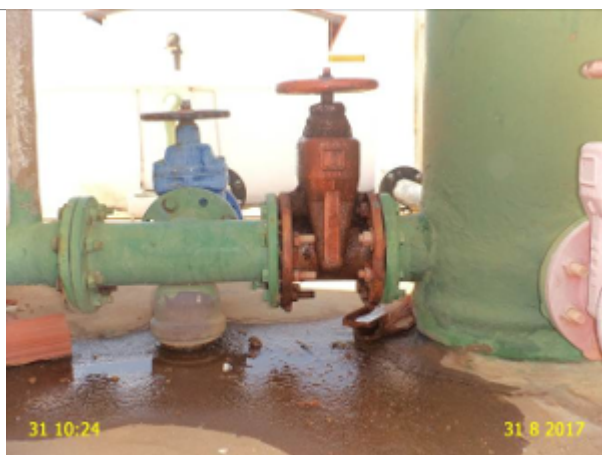
Foto 7 - Torre de equilíbrio: vazamento non registro.
