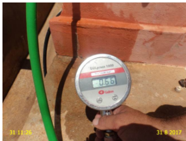
Foto 17 - RDA: medição de pressão instantânea no endereço: Rua Pedro Correa de Sousa, 362-2.
