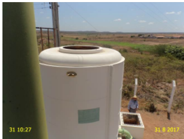
Foto 5 - F-02: parcialmente sem tampa.
